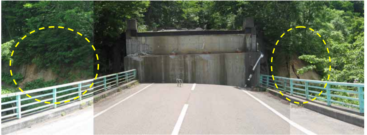
A1橋台の周囲には斜面崩壊の痕跡が認められる
