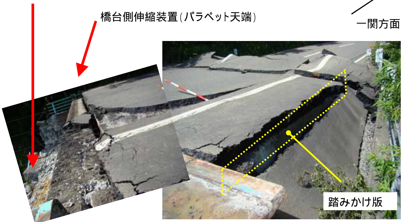
A2橋台背面には踏みかけ版ごと押し込まれたような路面の変状がみられる22
