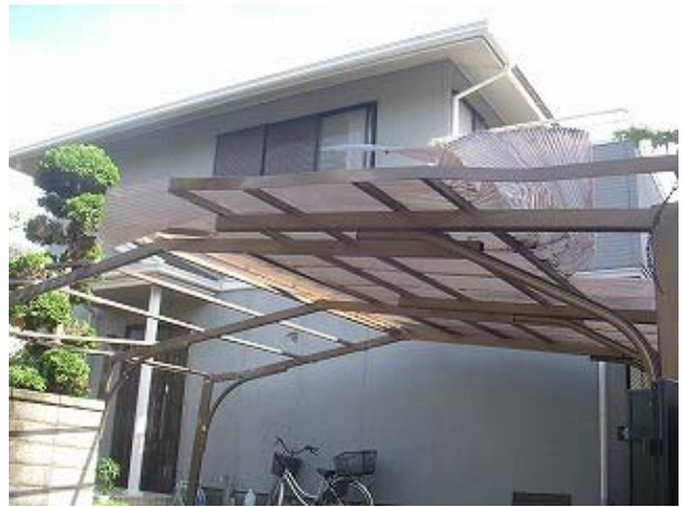
写真 36 カーポートの被害
