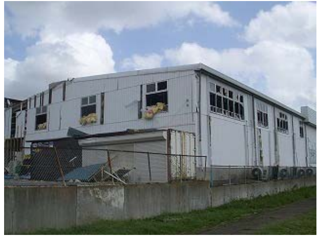
写真 16 窓ガラスの破損
