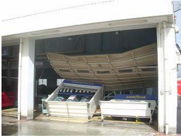
写真9 シャッターの被害とタイヤ収納棚の転倒
