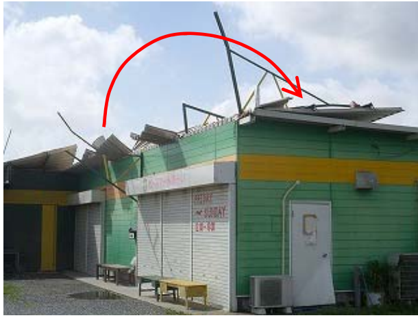
写真 21 折板の底部の損傷（裏返し）
