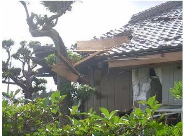
写真 34 壁面と屋根への飛来物の衝突
