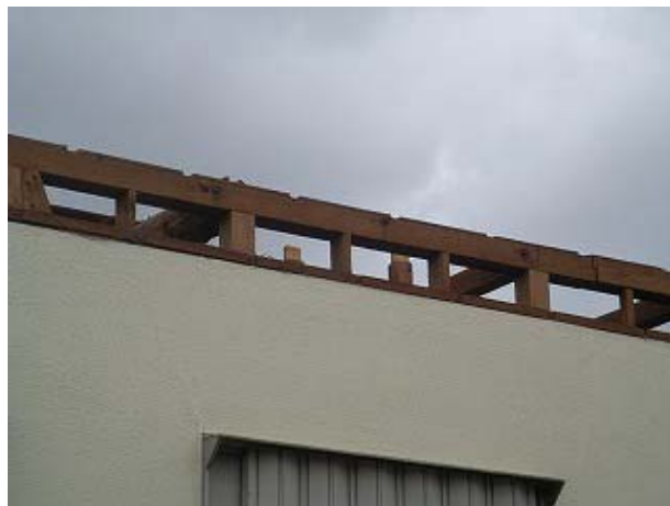
写真4 軒桁周辺の被害状況
