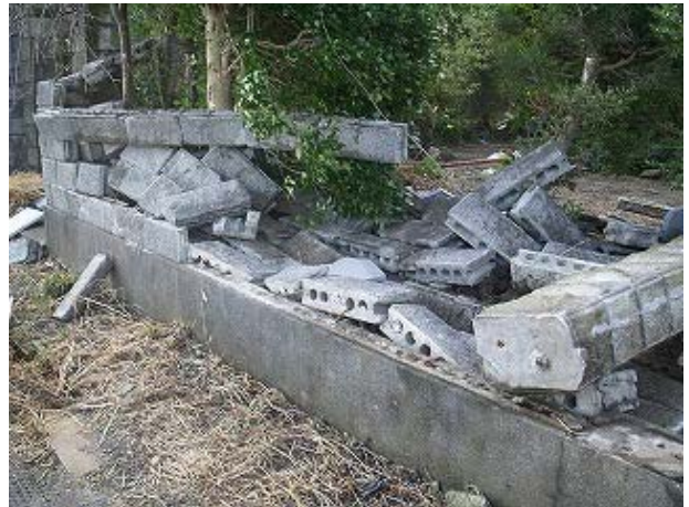
写真 38 ブロック塀の倒壊
