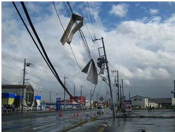
(a) 電線の垂れ下がりと飛来物
