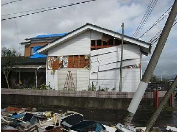
写真 27 壁仕上げ材のはく離と脱落
