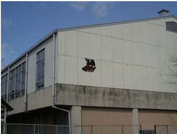
写真7 体育館壁面の飛来物による衝突痕
