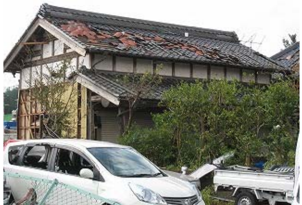
写真 24 屋根瓦の被害状況
