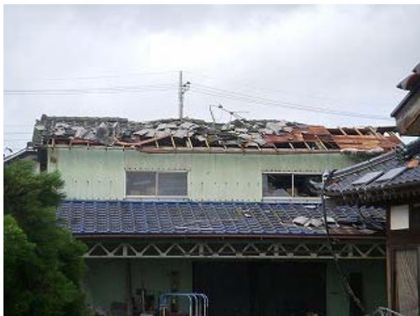
写真 25 屋根瓦と野地板の被害状況
