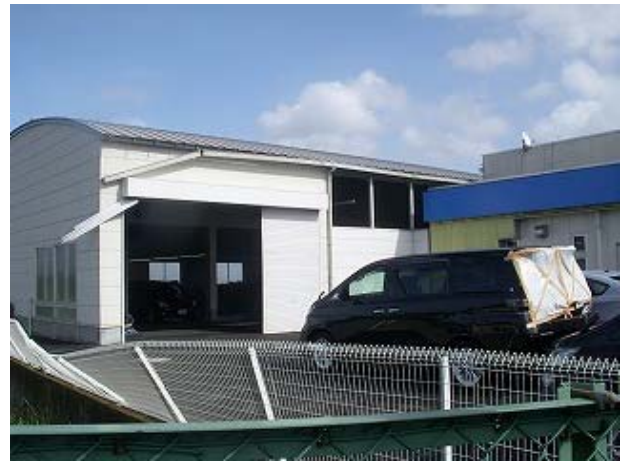
写真12 軒先端部と壁面の仕上げ材の脱落
