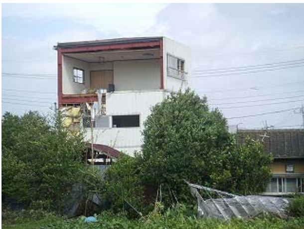
写真 31 鉄骨造の住宅壁面のはく離
