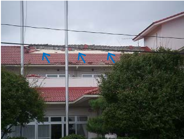
写真 17 屋根瓦の被害状況
