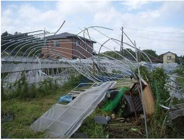
写真 39 パイプハウスの被害
