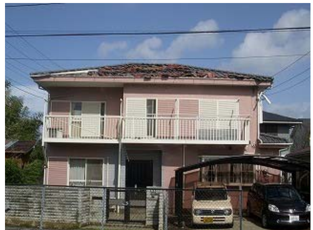
写真 26 屋根瓦の被害状況
