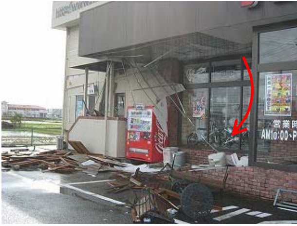
写真 15 エントランスの軒天井の脱落
