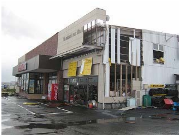
写真13 外壁のはく離
