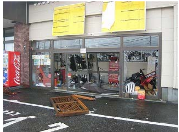
写真14 エントランスのガラス等の破損
