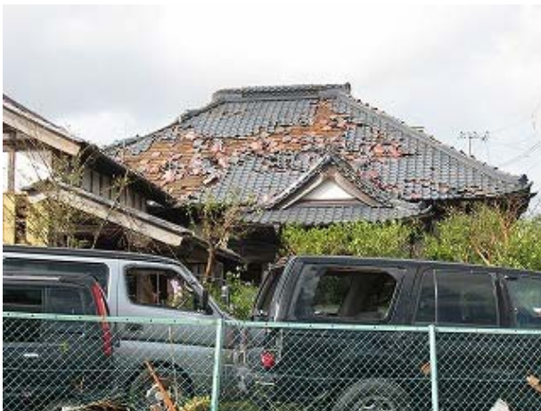
写真 23 屋根瓦の被害状況
