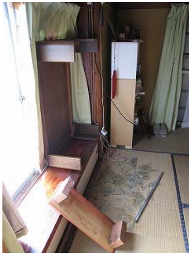
写真 29 室内に散乱した窓ガラスの破片
