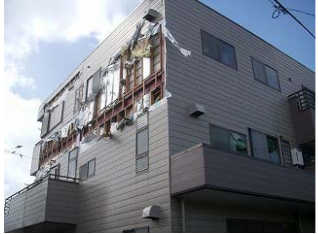
写真 28 壁仕上げ材のはく離
