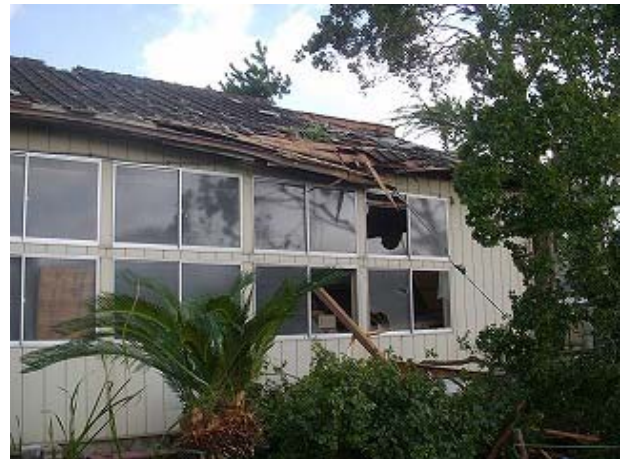
写真8 倉庫の窓ガラスと屋根の被害状況
