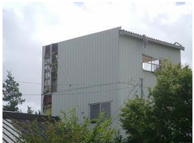
写真 32 隅角部の壁仕上げ材のはく離 (写真 31 と同一の住宅)
