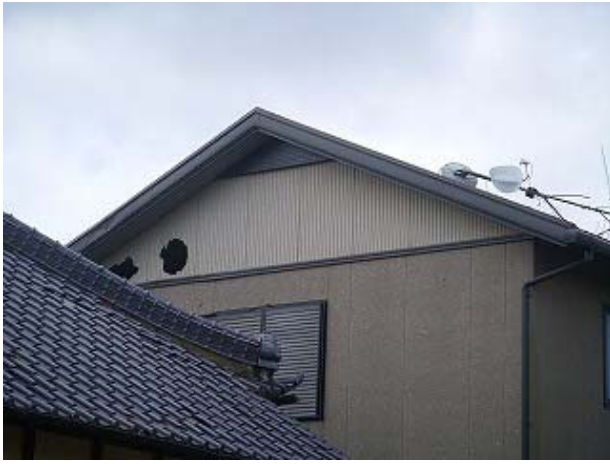
写真 33 妻面の飛来物による衝突痕とアンテナの折損
