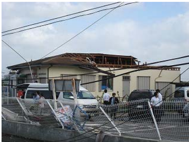
写真3 小屋組の損壊
