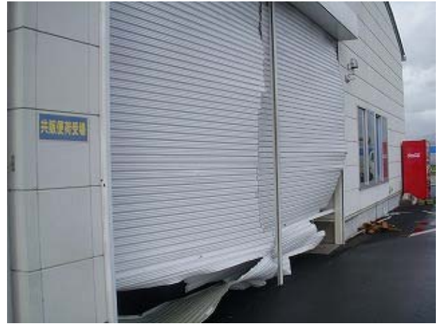
写真10 シャッターの破損
