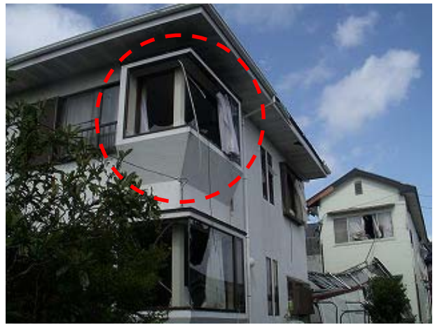
写真 30 出隅部の窓ガラスの被害
