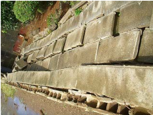
写真 37 ブロック塀の倒壊
