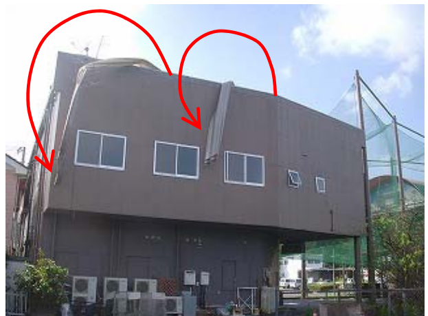
写真 20 折板屋根のめくれ
