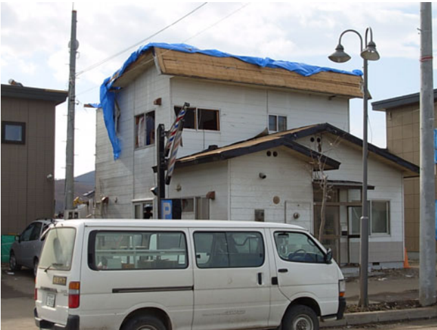
写真 18 屋根葺き材が飛散した住宅
