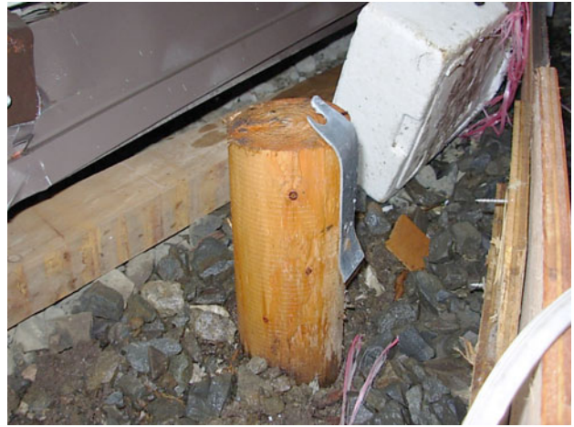
写真 13 渡り廊下の木ぐいに残った接合金物
