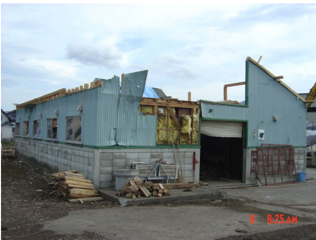
写真 26 屋根が飛ばされた倉庫
