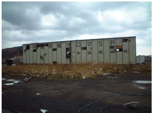
写真 21 飛来物による衝突痕が残る倉庫 (国土交通省北海道開発局提供)
