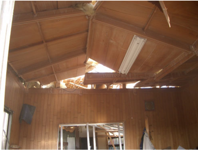
写真 16 天井が上部に引っ張られている住宅
