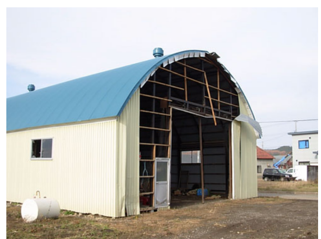
写真 27 外壁が飛ばされた倉庫
