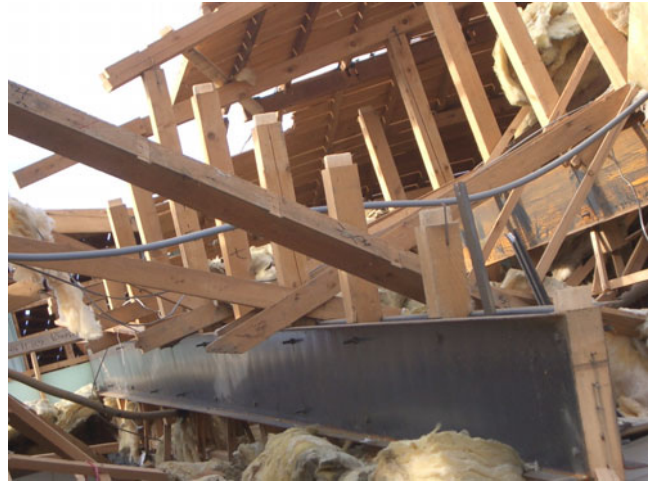
写真 17 小屋束とたるき間のかすがいが外れた住宅
