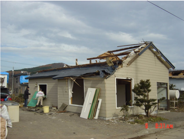
写真 22 屋根（下地材を含む）全体が飛散した住宅
