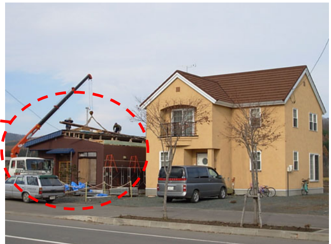
写真 35 屋根が飛散した住宅と健全な住宅
