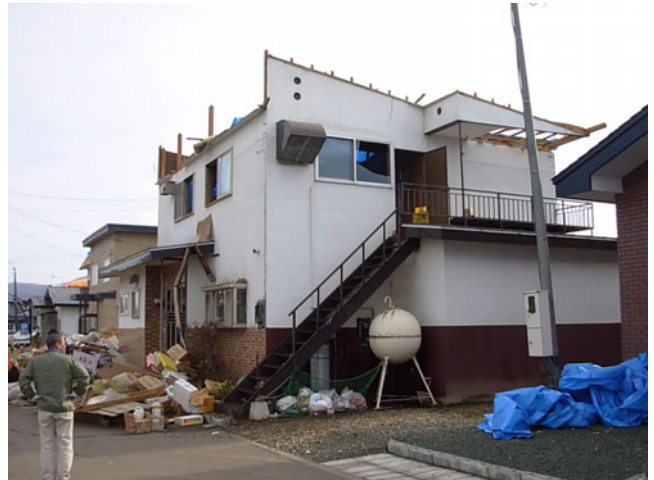
写真 19 屋根（下地材を含む）及び外壁の一部が飛散した住宅
