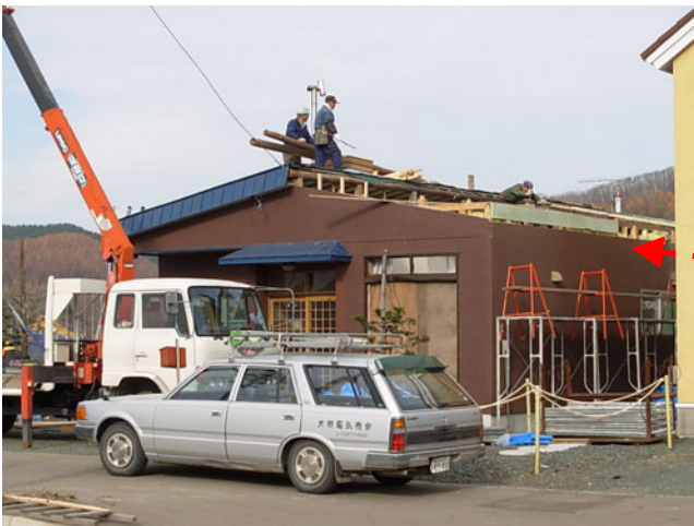
写真 34 屋根（下地材を含む）が飛散した住宅
