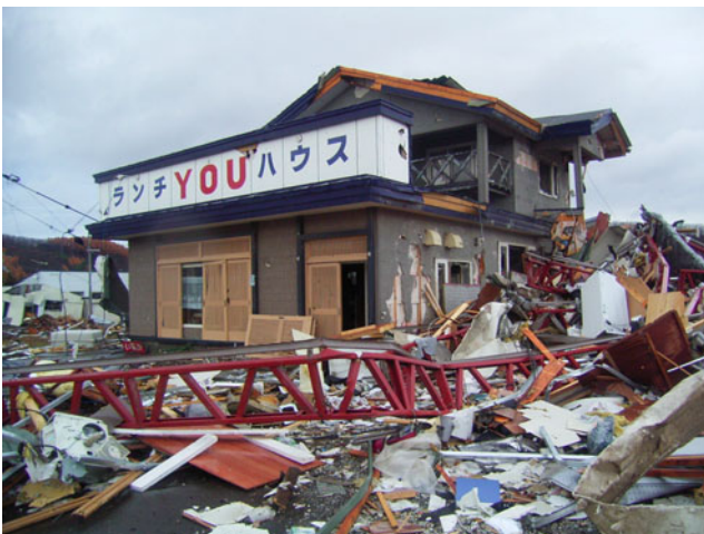
写真 20 飛来物による損傷の激しい店舗併用住宅 (国土交通省北海道開発局提供)
