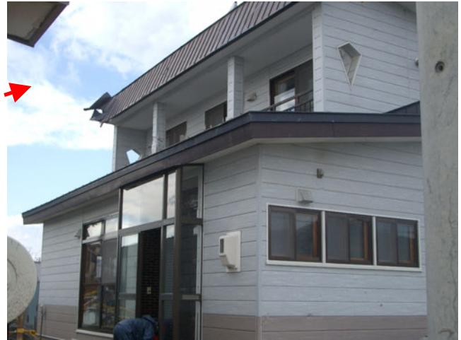
写真 33 屋根が一部損傷した住宅
