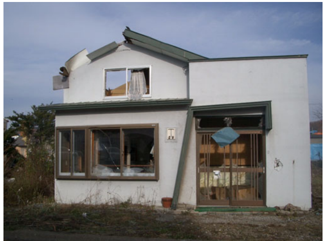
写真 25 窓ガラスの破損及び屋根が飛散した住宅
