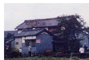
写真 2 瓦の著しいずれ・はく離（損傷程度：Ⅲ）
