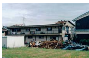
写真 1 野地板・小屋組の著しい損傷（損傷程度：V）
