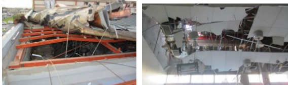
図5 越谷竜巻の被害事例(鉄骨造の文教関連施設の屋根ふき材と天井材の被害)
