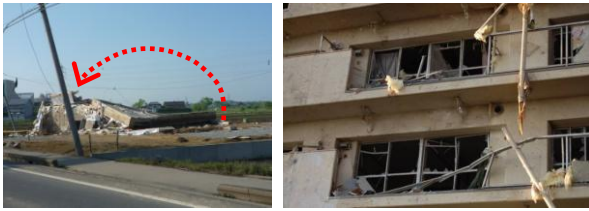
(c)住宅上部構造の転倒 (d)集合住宅建具の著しい損壊
