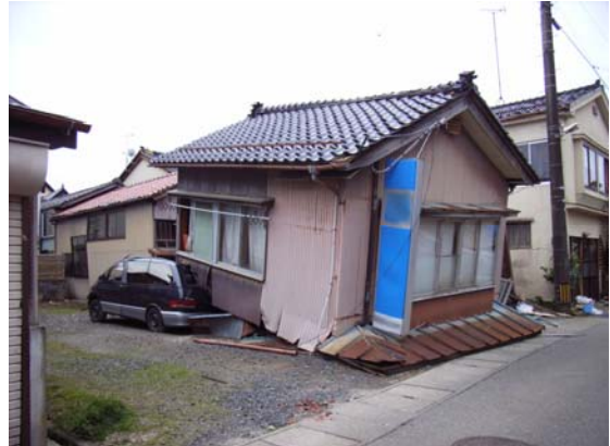
写真-4.42 倒壊し車両をつぶした家屋
