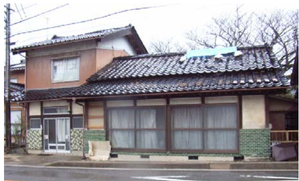
写真-4.56 西岸地区の屋根の被害例
