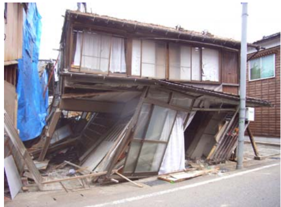
写真-4.44 倒壊寸前の建物
