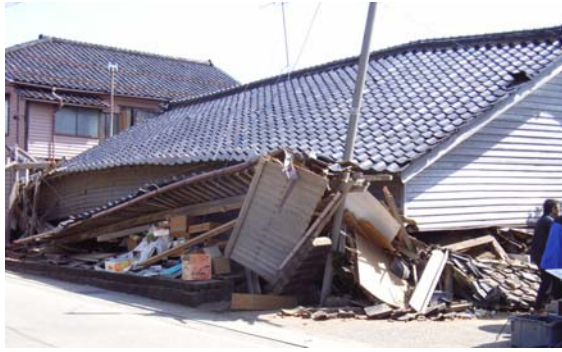
写真-4.27 比較的新しい構法と想像される 倒壊家屋
