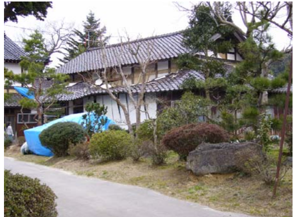
写真-4.54 奥原地区で大破した家屋
