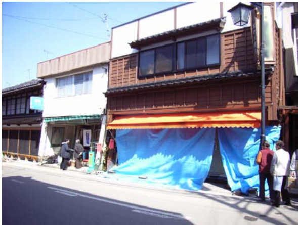
写真-4.21 大きな被害を受けた店舗併用住宅
