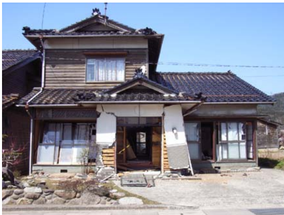
写真-4.25 外装、建具が大破した建物
