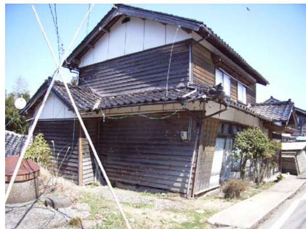
写真-4.14 道路側に大きく傾いた家屋
