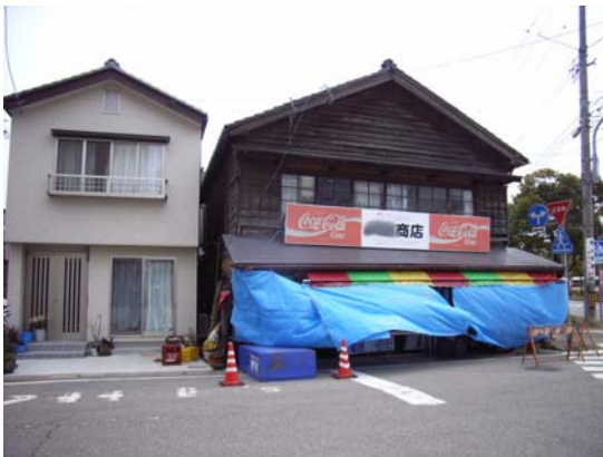
写真-4.41 倒壊した店舗
