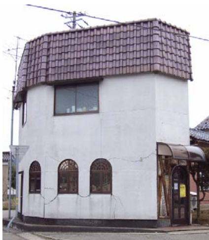
写真-4.47 躯体の腐朽が確認された店舗
