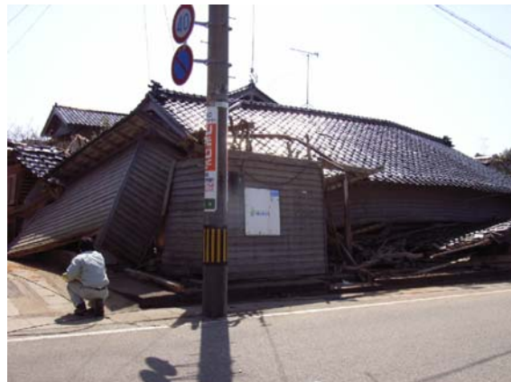
写真-4.26 比較的古い構法の倒壊家屋
