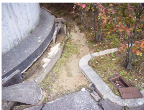
写真-4.51 田鶴浜支所裏の噴砂痕
