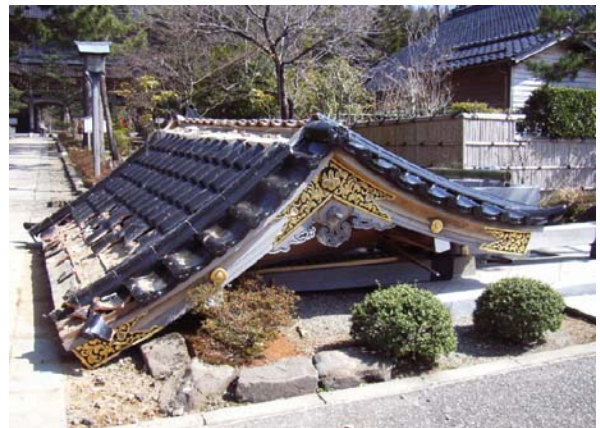
写真-4.18 倒壊した手洗い場の東屋
