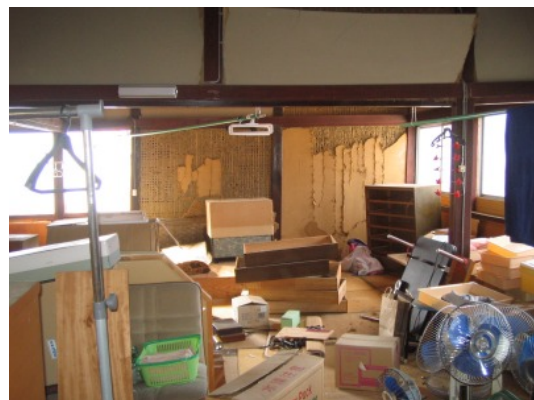
写真-4.96 土塗り壁の剥がれ
