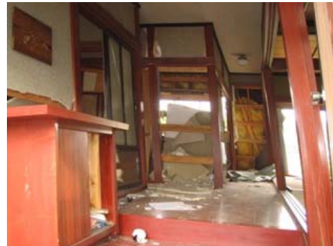
写真-4. 83 室内の被害状況
