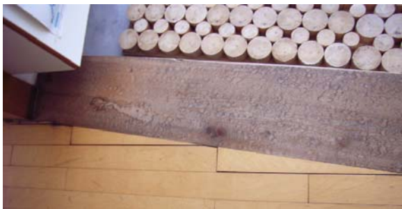
写真-4.169 床板のめくれ
