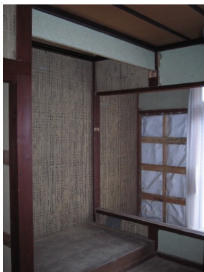
写真-4.139 土塗り壁の剥がれ
