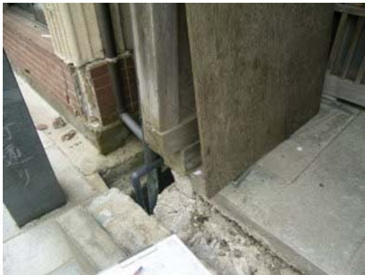
写真-4.60 土台のずれ
