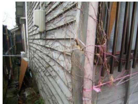
写真-4.119 南東隅の柱の折損
