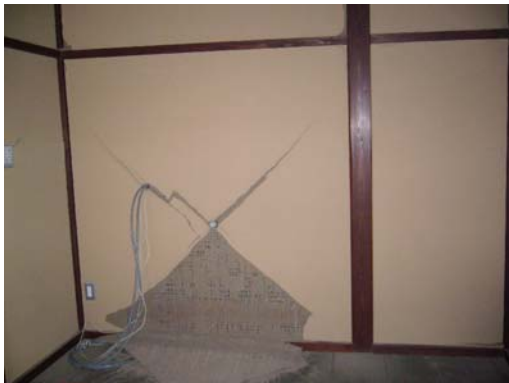
写真-4.104 せん断破壊した土塗り壁
