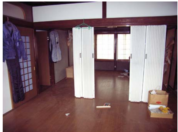
写真-4.73 店舗上部の居住スペースは被害軽微
