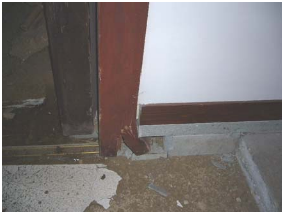
写真-4.106 基礎と土台のずれ
