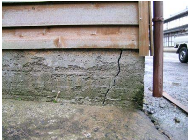
写真-4.152 コンクリート基礎のひび割れ
