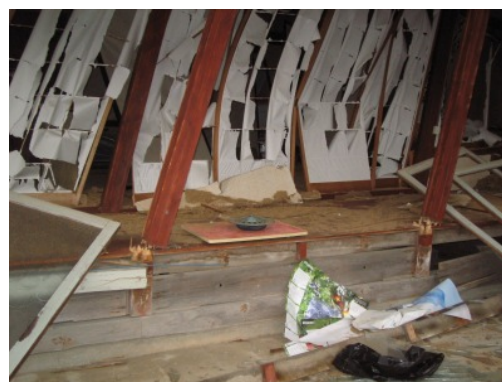
写真-4.144 下端部付近での柱の折損
