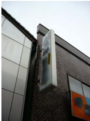
写真-4.78 隣接建物看板の衝突痕
