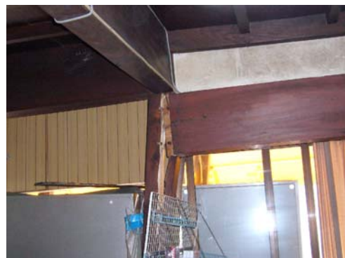
写真-4.75 いまにも外れて落ちそうな桁
