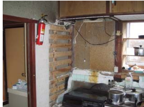
写真-4.87 仕上げ材の剥落
