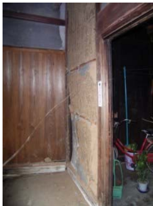
写真-4.124 土壁の剥落
