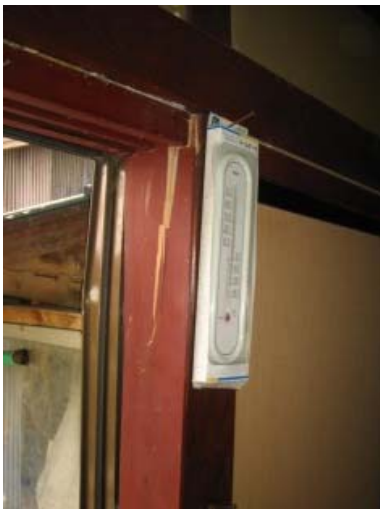
写真-4.88 柱の割裂
