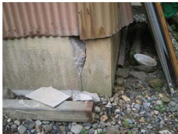
写真-4.89 基礎の割れ
