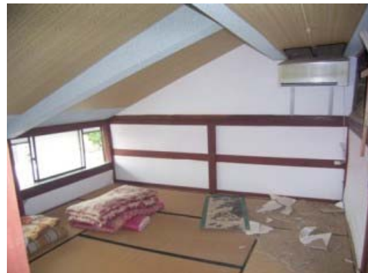
写真-4.121 2階の被害（壁の落下）
