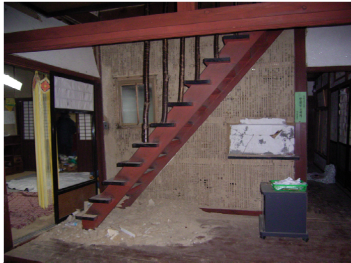
写真-4.130 土塗壁の剥落
