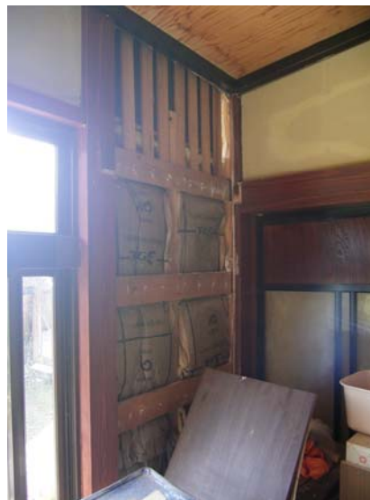
写真-4.93 壁の被害（ラスボード落下）
