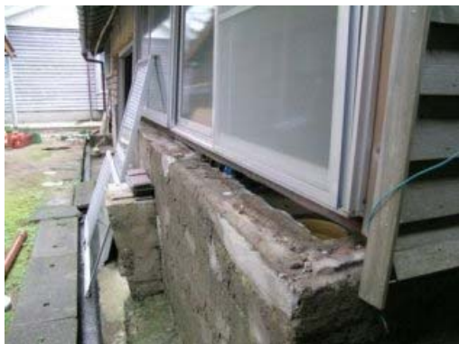
写真-4.147 背面側(コンクリート上で滑る)
