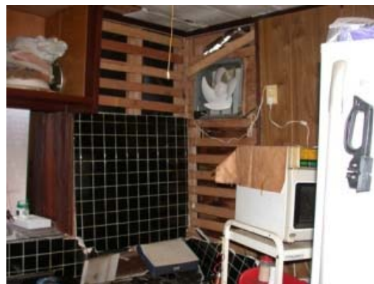
写真-4.125 台所の壁の被害
