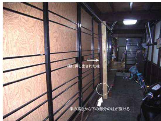
写真-4.67 床から下が折れた柱
