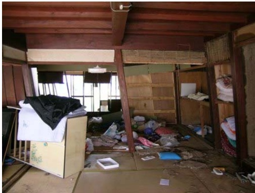
写真-4.116 内部。柱の折損、壁の脱落。
