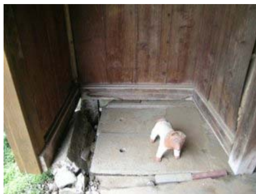
写真-4.146 外壁が道路側(左)に滑る
