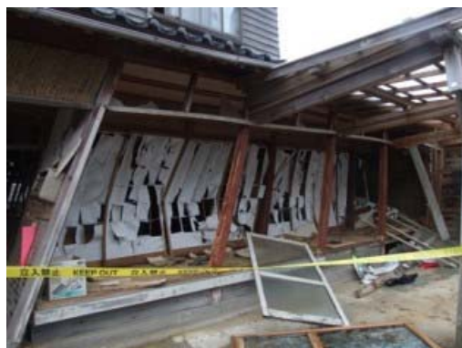
写真-4.143 大きく傾いた柱
