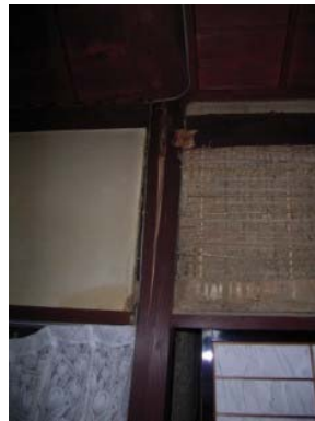
写真-4.127 裂けた柱
