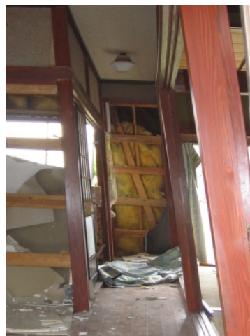
写真-4. 85 内壁仕上げ材の剥がれ
