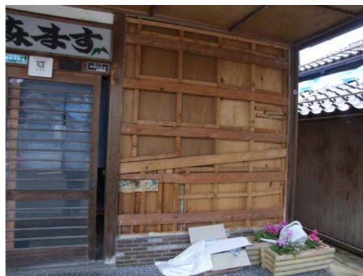
写真-4.95 外壁仕上げ材の剥落
