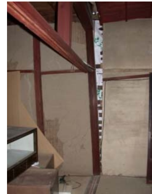
写真-4.128 梁の抜け出し
