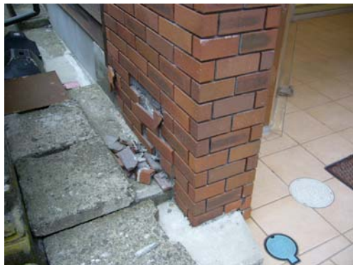
写真-4.80 店頭西側脚部の外装の破損
