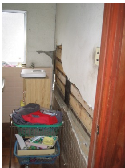
写真-4.140 内壁モルタルの剥落
