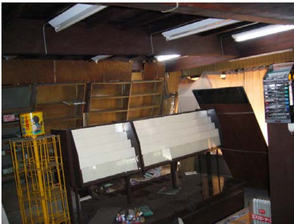
写真-4.72 店舗部分の被害
