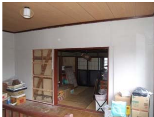
写真-4.138 せっこうボードの剥落
