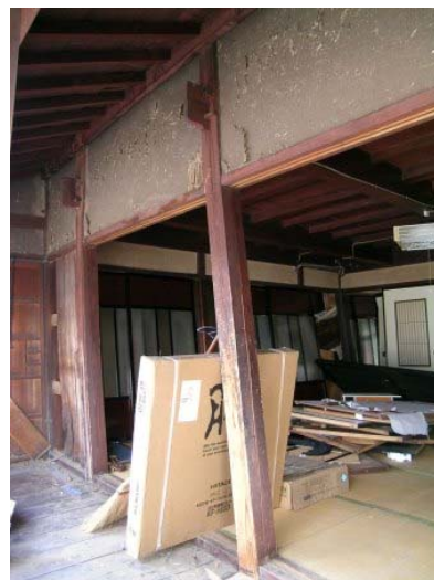
写真-4.117 2階床高さで通し柱折損
