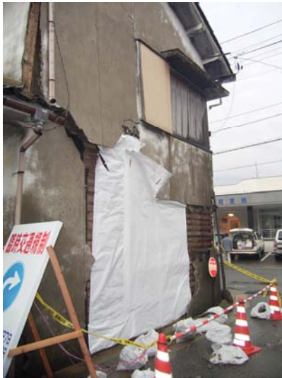
写真-4.129 モルタル壁の脱落
