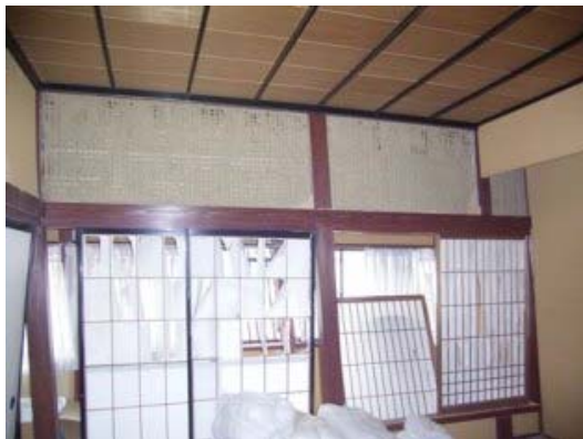
写真-4.120 室内の被害（土壁の剥落）
