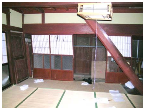
写真-4.148 通り庭内側の傾斜と柱折損
