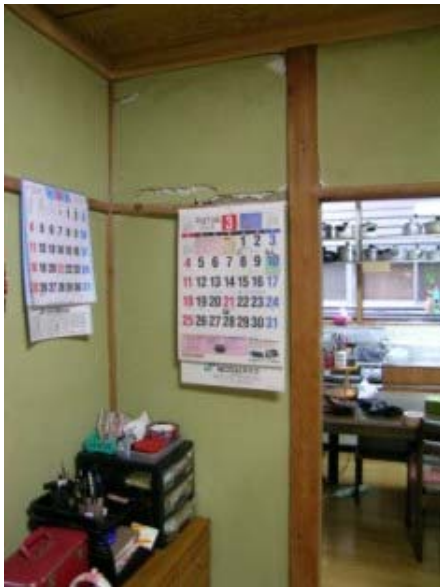
写真-4.151 内壁の損傷
