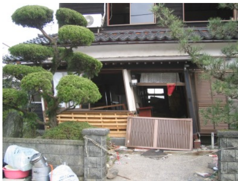
写真-4. 84 外壁モルタルの剥落
