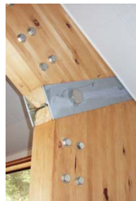
写真-4.168 接合部の被覆材の脱落
