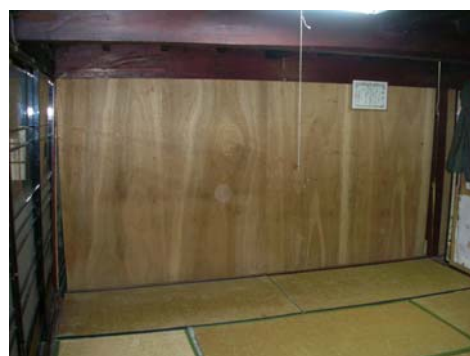
写真-4.69 梁 (差鴨居) の抜け出し
