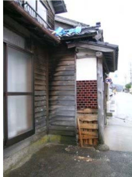
写真-4.150 玄関脇の外壁の剥落
