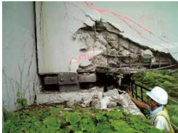
写真-7.15 桁端部下面のせん断破壊 (NEXCOホームページより引用)
