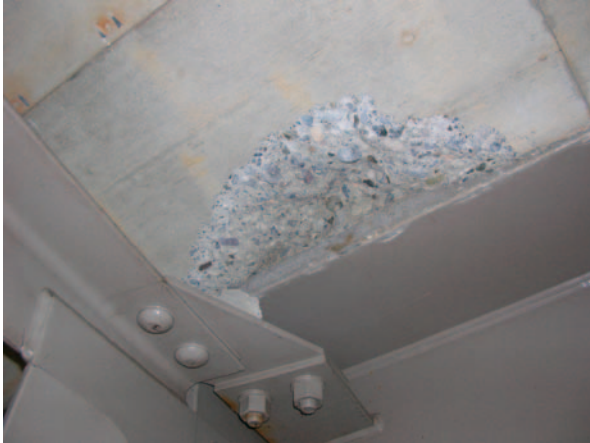
写真-7.25 床版コンクリートの剥離
