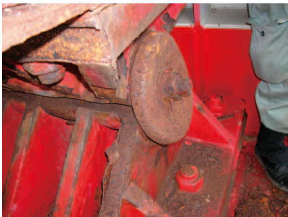
写真-7.11 3径間部の中間固定支承のアップリフト止めの変形
