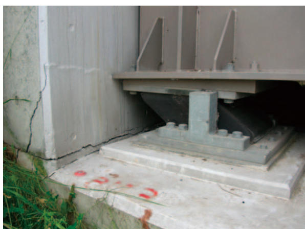
写真-7.23 支承の残留変位と橋台 パラペット基部のひびわれ
