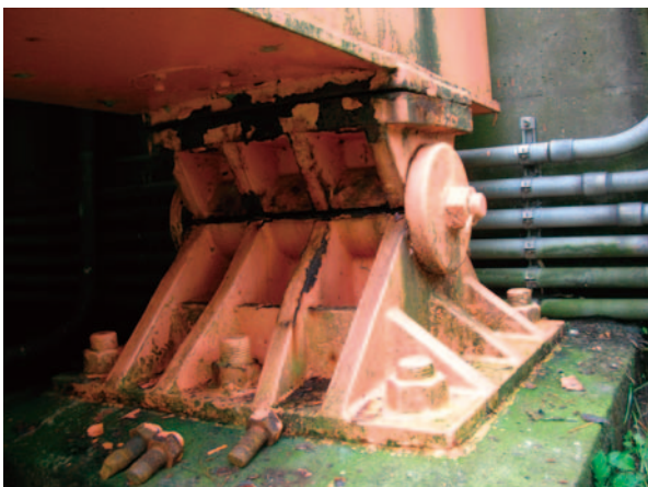
写真-7.6 固定支承のセットボルトの破断
