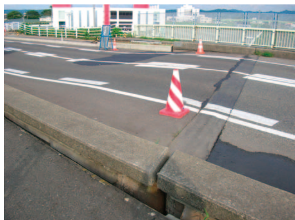
写真-7.34 跨線橋橋台背面土の沈下
