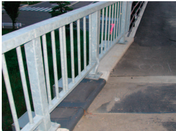
写真-7.21 高欄の座屈変形
