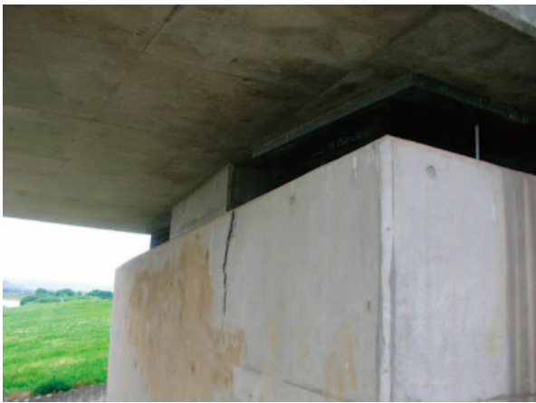
写真-7.29 たて壁前面のひびわれ
