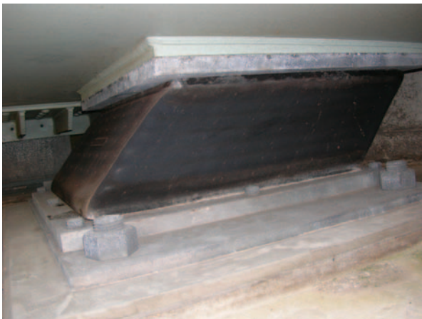
写真-7.18 支承の残留変形
