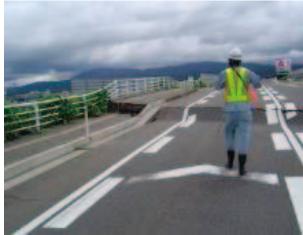
写真-7.35 ボックスカルバート背面土の沈下（北陸地方整備局ホームページより引用）
