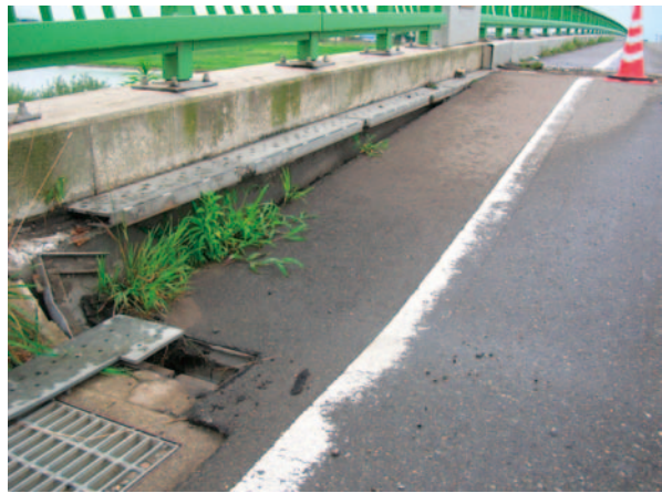
写真-7.30 橋台背面土の沈下
