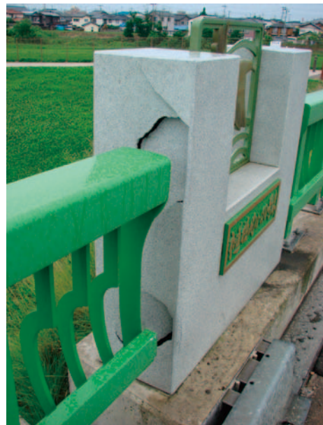
写真-7.32 親柱の損傷
