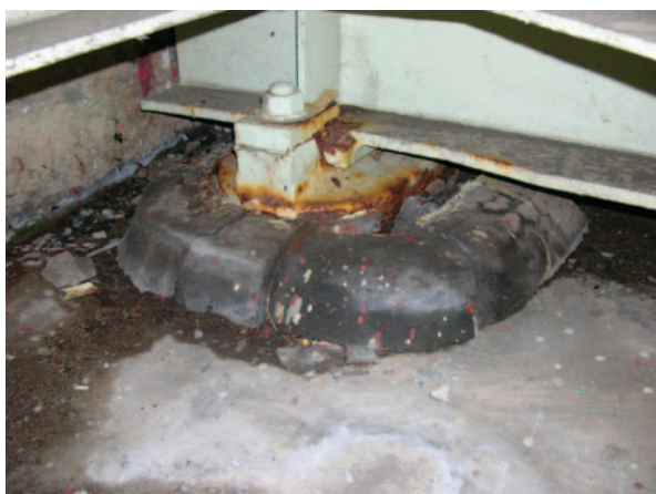
写真-7.33 沓座モルタルの破損
