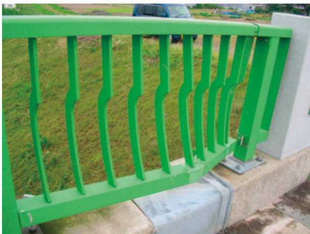
写真-7.31 高欄の座屈
