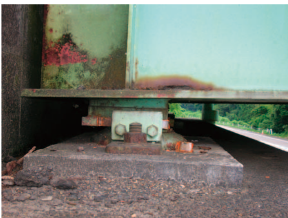
写真-7.40 固定支承の損傷
