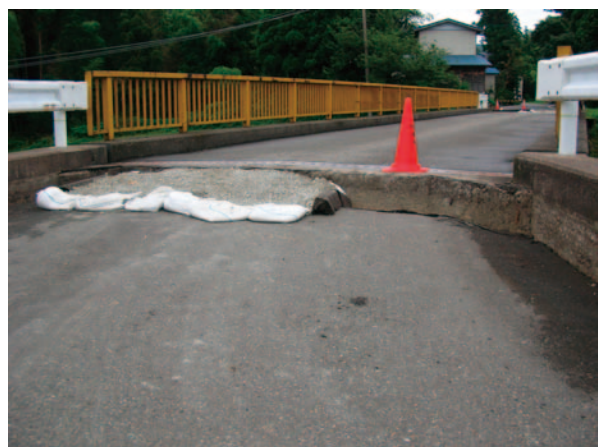
写真-7.41 橋台背面土の沈下
