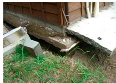
崖側の建物基礎が押し上 げられた状況
