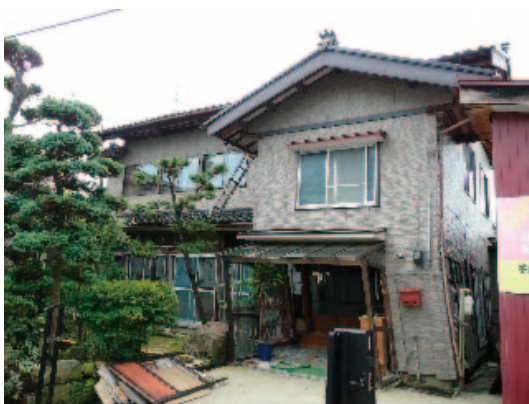
写真-9.4.14 残留変形が大きい住宅（外壁のみ改修し構造要素は土塗り壁等比較的古いものであると推測される）
