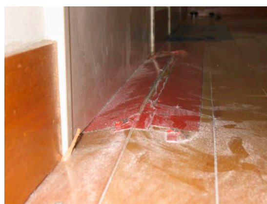
写真-9.6.8 床仕上材のせり上がり
