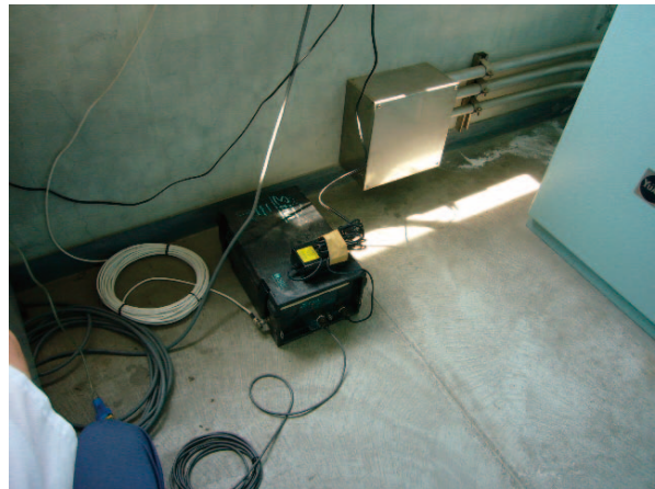
写真-9.3.4 柏崎市役所本館 7F 設置状況
