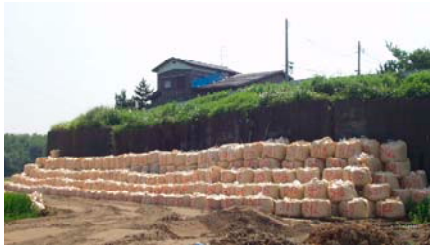
被災状況の全景（応急措置済）
