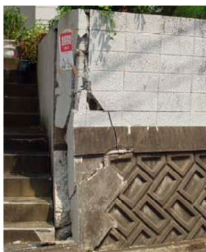
擁壁隅部の破壊
