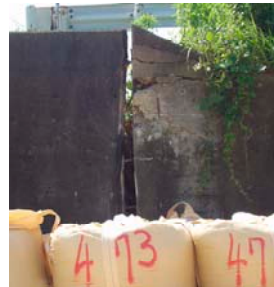
接合部右側擁壁のはらみ
