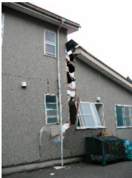
写真-9.4.22 写真-9.4.21 の下屋部分の接続部の破壊
