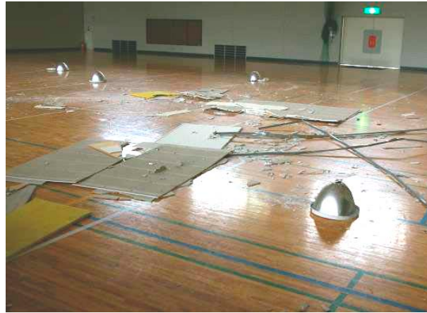
写真-9.6.6 脱落した様々な部材
