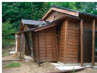
写真-9.7.2 刈羽村の液状化等に起因する地盤変動による新築住宅の被害
