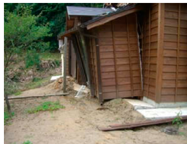
被災住宅 崖面側
