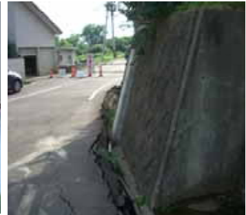
(背面地盤全体のすべりにより、擁壁が押し出されて前面の側溝がつぶされた状態)
