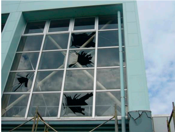
写真-9.6.3 ガラスの被害
