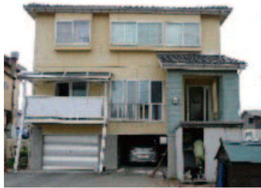
写真-9.4.20 地盤変状により傾斜が生じた高床式木造（1階部分RC造）
