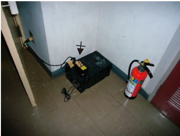
写真-9.3.3 柏崎市役所本館 B1F 設置状況
