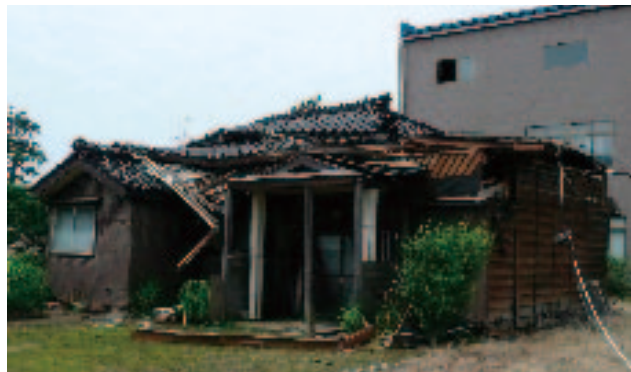
写真-9.4.9 2階が崩壊した例
