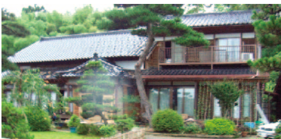
写真-9.4.27 増築部と既存部が分裂した被害例
