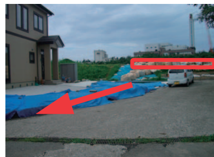
写真-9.7.16 橋場における大きな地割れ 地層境界付近の土手の陥没、赤く囲んだ範囲が沈下範囲(約 30cm)、地割れは矢印の方向
