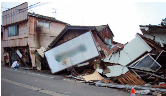
写真-9.4.3 倒壊した店舗併用住宅
