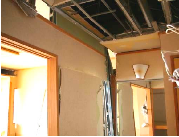
写真-9.6.10 客室内装の被害
