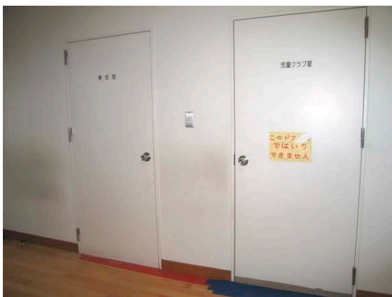
写真-9.6.7 開扉に支障を来した防火扉
