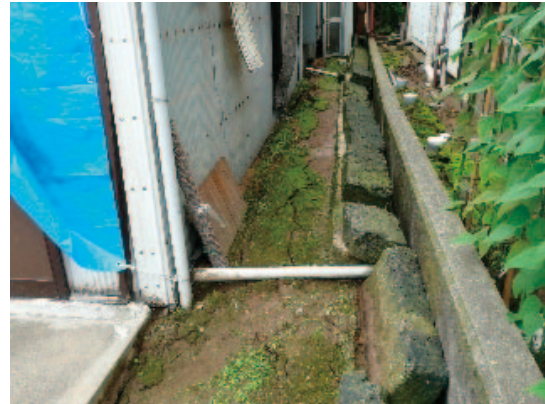
写真-9.4.15 地盤変状により倒れた極低い擁壁
