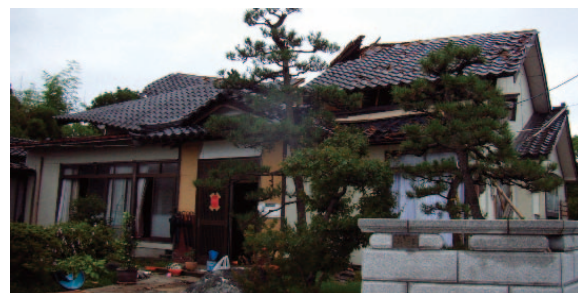
写真-9.4.28 小屋組の一部が崩壊する希少な被害例
