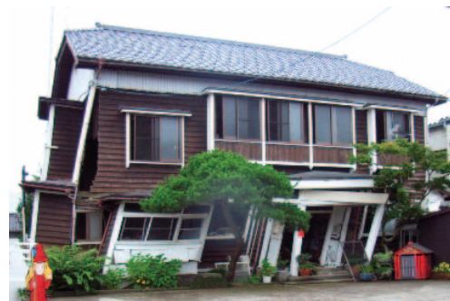
写真-9.4.4 残留変形が大きい総 2 階の比較的立派な造りの木造
