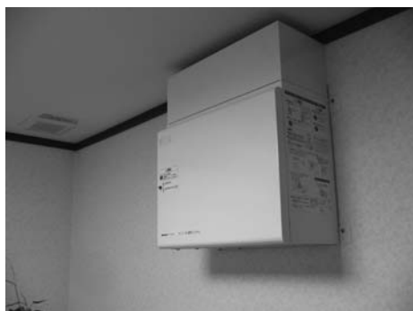
図4 壁設置の換気装置
