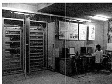
制御室（制御盤、制御用PC）
