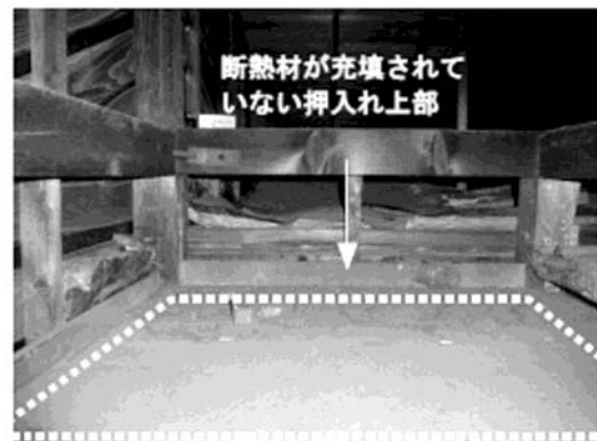
図5 押入れ上部の断熱欠損の例
