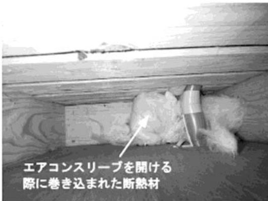
図4 エアコン設置工事の際に生じた断熱欠損の例
