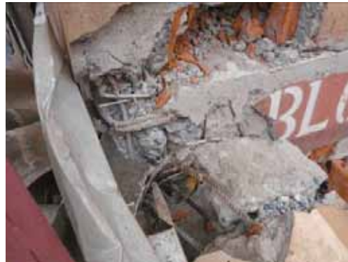
写真 5.25 柱梁接合部の破壊 (写真 4.14.4 を再掲)
