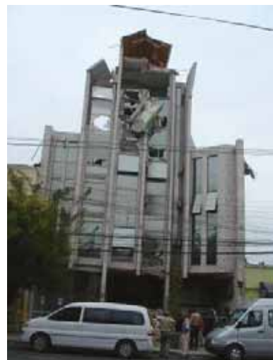
写真 5.35 外壁の脱落 （写真 4.19.1 を再掲）
