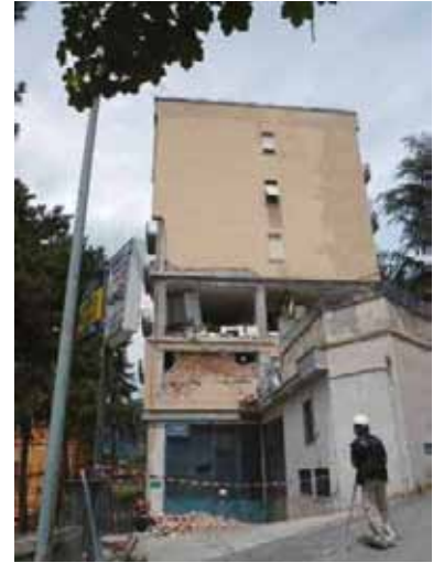
写真 5.32 れんが造壁の破壊（ラクイラ地震）
