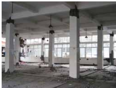
写真 5.19 柱頭の曲げ破壊 (四川大地震)
