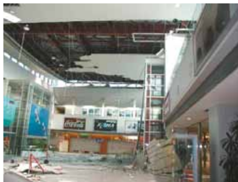
写真 5.39 釧路空港天井パネルの脱落(釧路空港ビル株式会社提供) 5-5)
