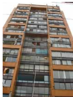
写真 5.37 窓ガラスの飛散
