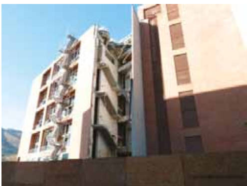
写真 5.34 外壁の脱落（写真 4.7.2 を再掲）
