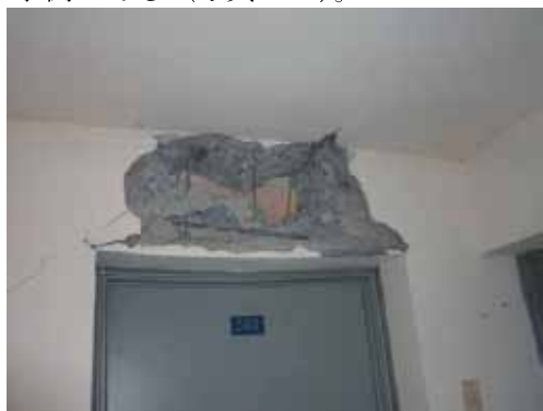
写真 5.20 せん断破壊した短スパン梁 (写真 4.20.3 を再掲)
