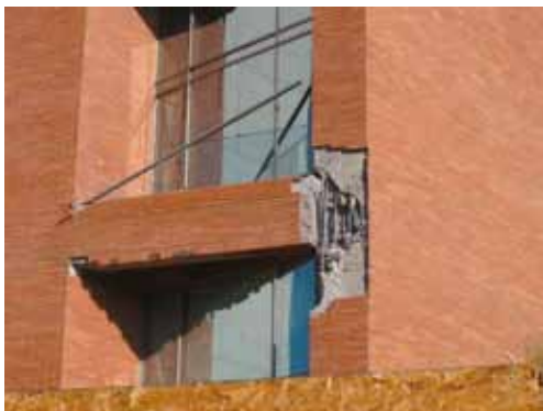
写真 5.24 柱梁接合部の破壊
