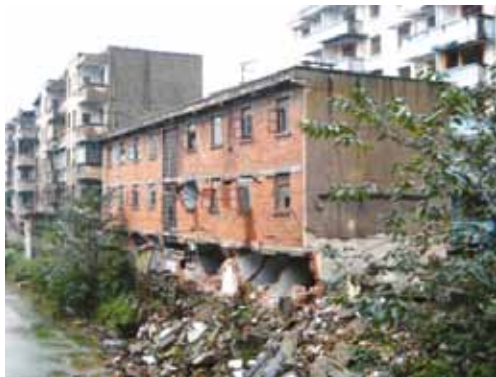
写真 5.14 1階が崩壊したれんが造建築物 （四川大地震）
