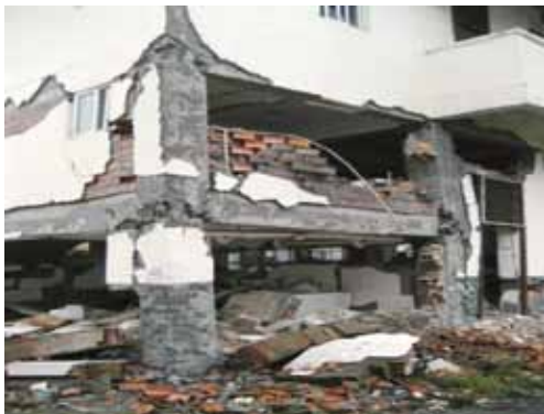
写真 5.26 柱梁接合部の破壊 (四川大地震)
