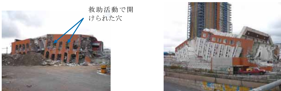
写真 5.1 転倒による被害（写真 4.25.2 を再掲）
