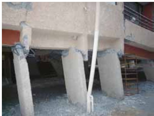
写真 5.18 曲げヒンジが生じた壁柱 (写真 4.9.3 を再掲)
