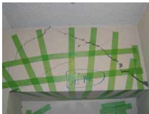
写真 5.21 せん断ひび割れが発生した 短スパン梁 (新潟県中越地震)
