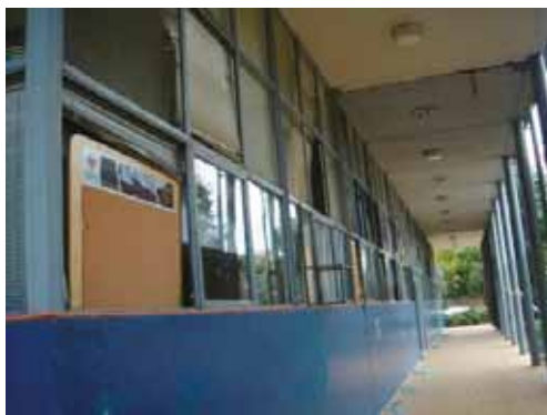
写真 5.36 窓ガラスの飛散(写真 4.20.2 を再掲)
