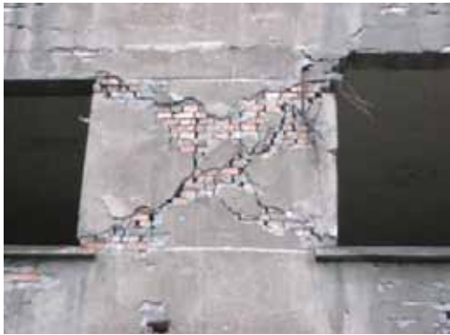
写真 5.31 方立て壁の破壊（四川大地震）
