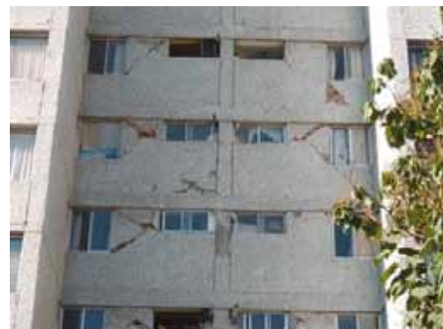
写真 5.30 れんが壁の破壊（写真 4.5.2 を再掲）
