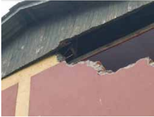
写真 5.22 妻壁頂部の梁の崩落 (写真 4.15.3 を再掲)
