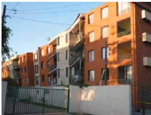
写真 5.6 1層部分の層崩壊 (写真 4.8.1 を再掲)
