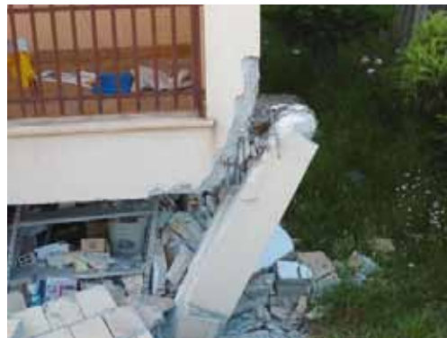
写真 5.27 柱梁接合部の破壊 (ラクイラ地震)
