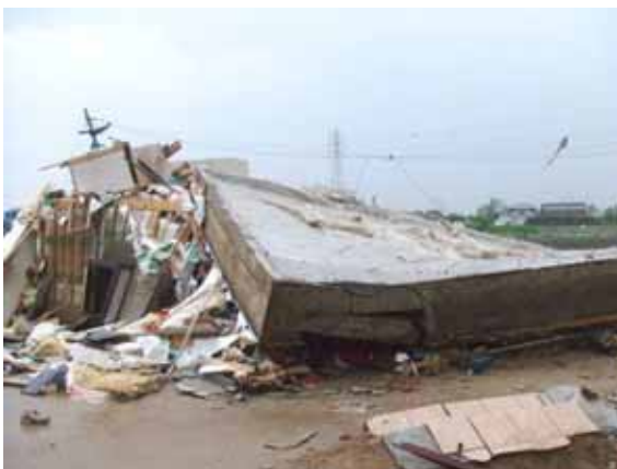
写真 3.1-3 写真 3.1-1 のべた基礎底面の露出
