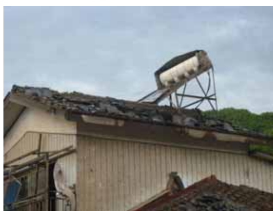
写真 3.4-2 屋根瓦の脱落
