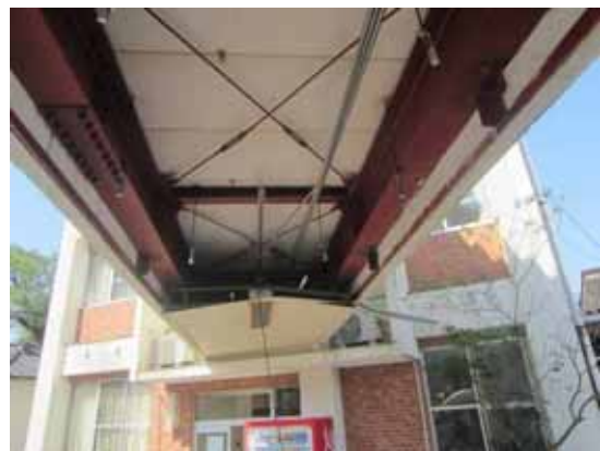
写真 3.4-20 渡り廊下底面の仕上げ材の脱落
