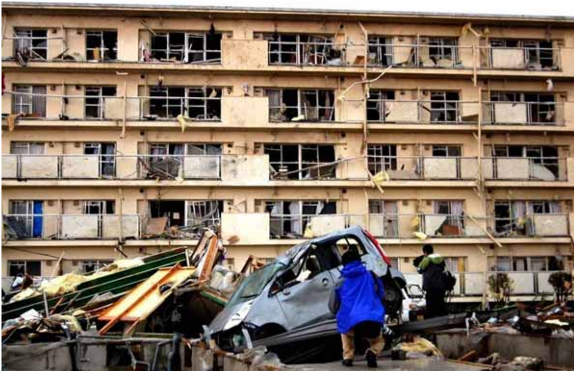
写真3.4-26 5階建て集合住宅南面の被害状況
