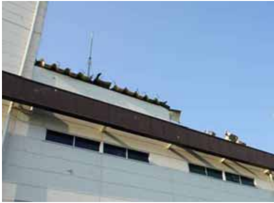
写真 3.4-9 屋根ふき材の損傷
