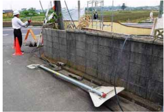
写真 3.5-6 道路標識の折損
