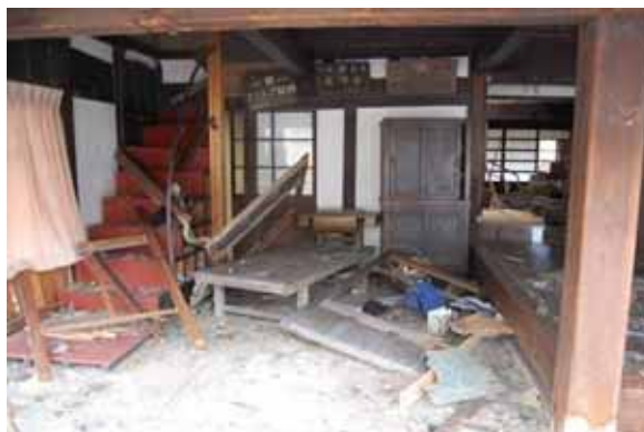
写真 3.4-24 店舗併用住宅の屋内の被害状況
