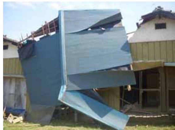
写真 3.4-7 飛来物（小屋組）の衝突
