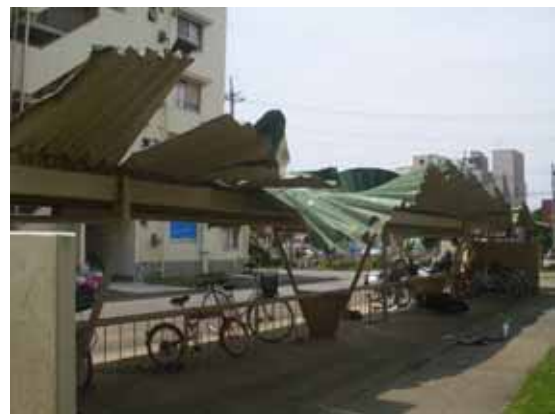
写真 3.5-2 駐輪場の折板屋根の著しい変形
