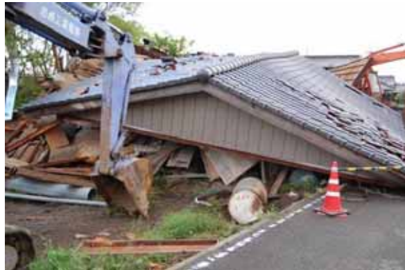
写真 3.1-23 倒壊した木造建築物
