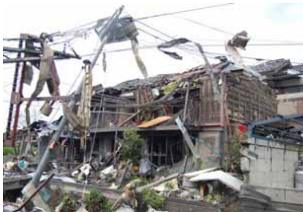
写真 3.1-28 傾斜した木造建築物
