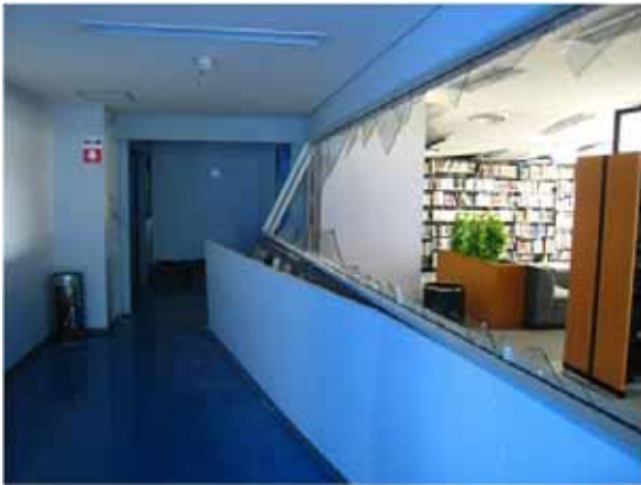
写真 3.4-38 内装材の被害
