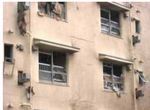
写真 3.4-32 北面の被害状況
