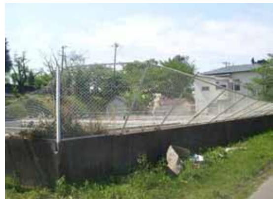
写真 3.5-10 フェンスの被害状況
