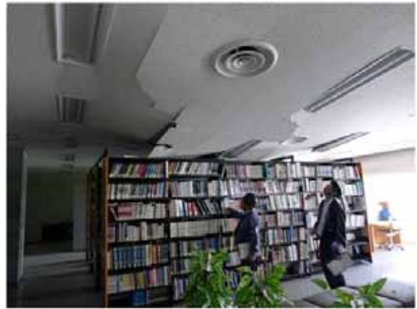
写真 3.4-39 天井材の被害
