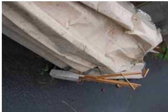
写真 3.4-8 飛散した折板屋根の状況
