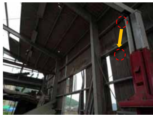
写真 3.2-6 引張ブレース端部のボルト破断
