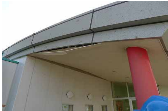
写真 3.4-18 軒天井の損傷
