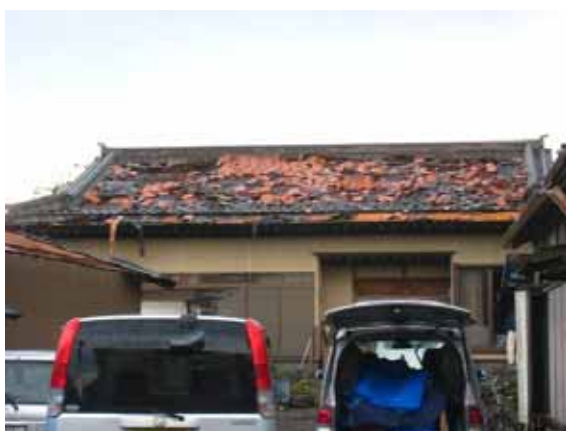
写真 3.4-1 屋根瓦の脱落
