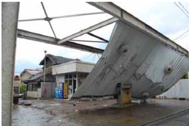
写真 3.5-1 ガソリンスタンドの折板屋根の脱落
