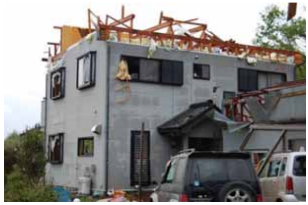
写真 3.1-33 切妻屋根の被害
