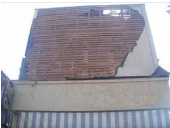
写真 3.4-11 モルタル外壁の脱落
