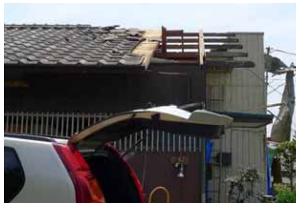
写真 3.4-4 屋根瓦の脱落と野地板の被害
