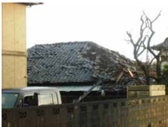
写真 3.4-3 屋根瓦の脱落
