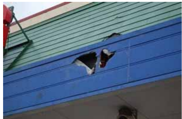
写真 3.4-34 エントランスでの飛来物の衝突痕
