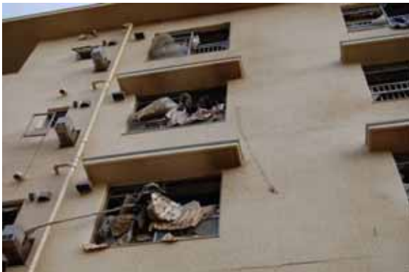
写真 3.4-31 北面の被害状況
