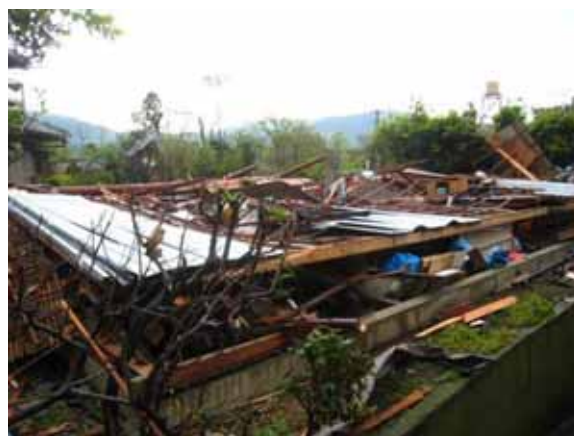
写真 3.1-25 倒壊した木造建築物
