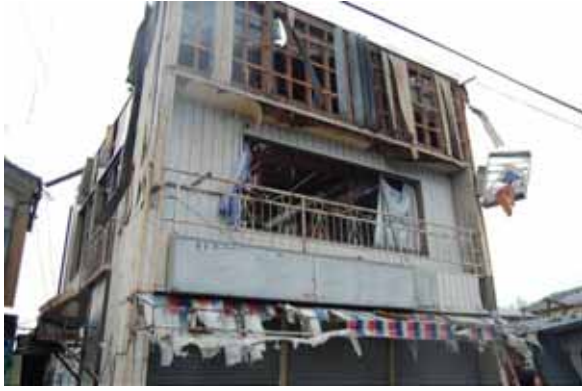
写真 3.4-15 外壁材の脱落
