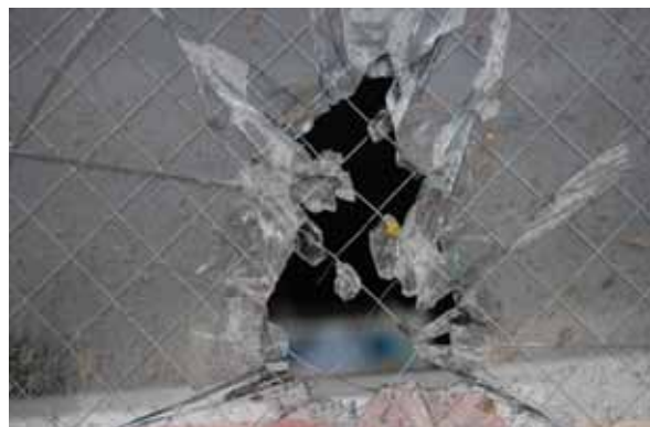
写真 3.4-36 ガラスへの飛来物の衝突痕
