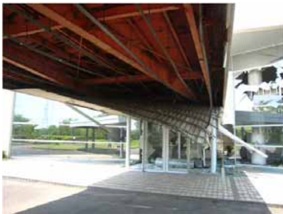
写真 3.4-19 渡り廊下底面の仕上げ材の脱落
