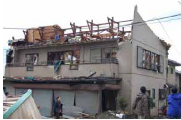
写真 3.1-35 片流れ屋根の被害
