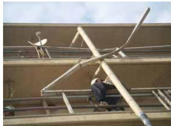
写真 3.4-30 屋外方向に引き抜かれたアルミ手すり
