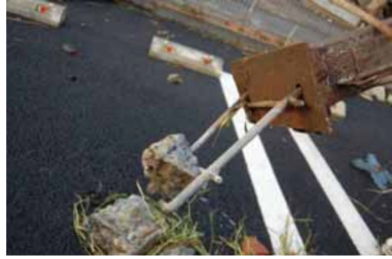
写真 3.2-9 写真 3.2-8 の柱脚の引き抜け状況
