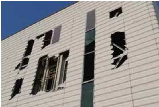
写真 3.4-17 外壁材とガラスの損傷
