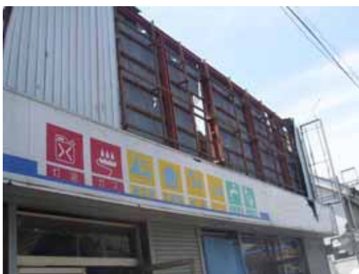
写真 3.4-13 外壁材の脱落
