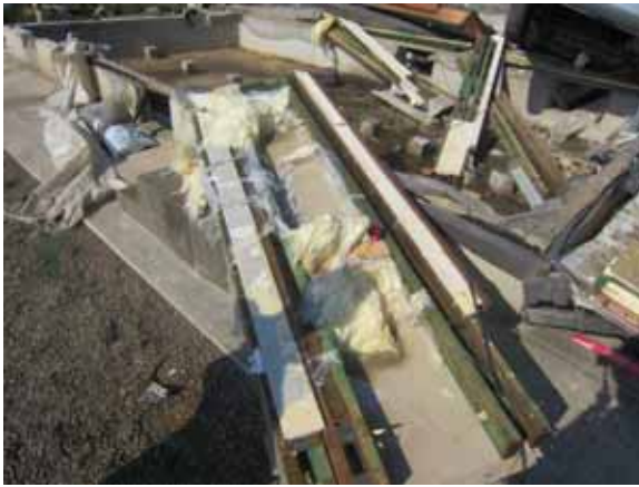
写真 3.1-11 写真 3.1-9 の飛散した部材
