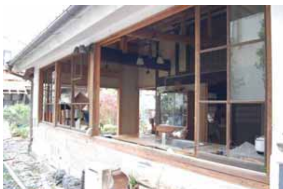
写真 3.4-25 店舗併用住宅の開口部の被害状況
