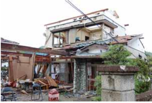
写真 3.1-32 切妻屋根の被害
