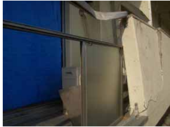
写真 3.4-28 RC造手すりの被害状況
