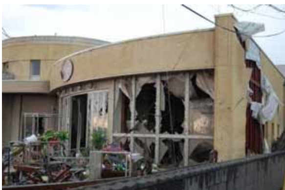
写真 3.4-21 店舗の窓ガラスの被害状況
