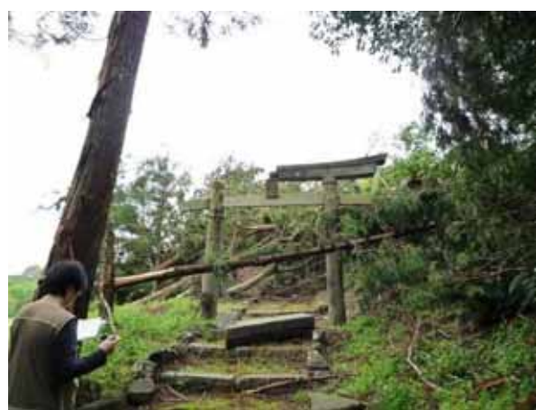
写真 3.5-16 樹木の折損と鳥居の被害
