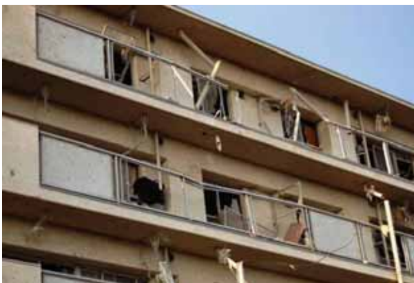
写真 3.4-29 4～5階の被害状況の例
