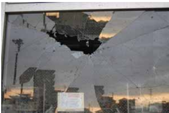
写真 3.4-35 ガラスへの飛来物の衝突痕
