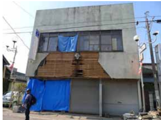
写真 3.4-12 モルタル外壁の脱落
