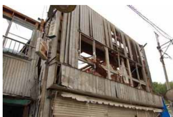
写真 3.4-14 外壁材の脱落
