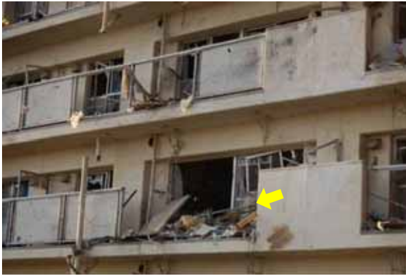
写真 3.4-27 2階ベランダの堆積物
