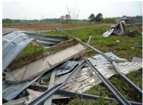
写真 3.2-3 部分的に破壊した基礎
