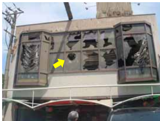
写真 3.4-22 店舗の窓ガラスの被害状況
