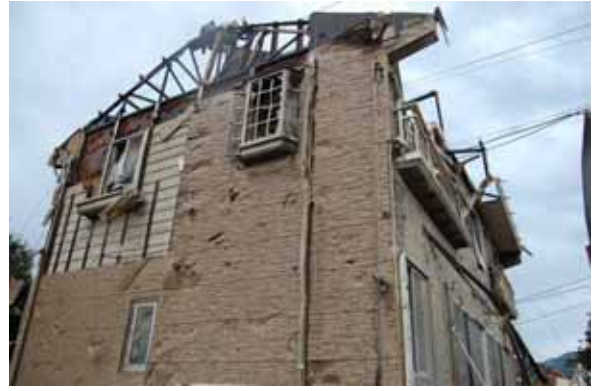
写真 3.4-16 軽量鉄骨造住宅の外壁材の脱落
