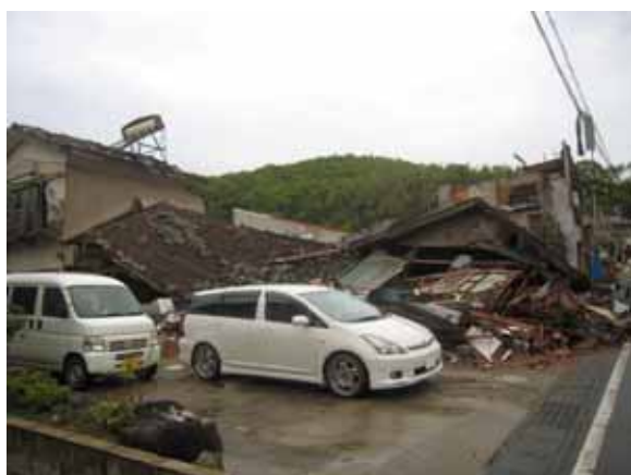
写真 3.1-24 倒壊した木造建築物
