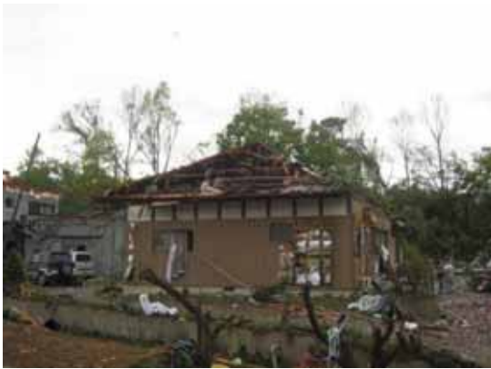
写真 3.1-34 寄棟屋根の被害
