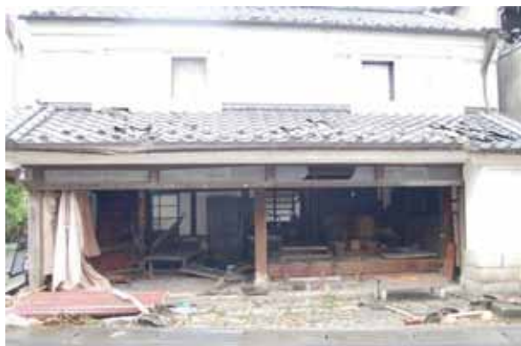
写真 3.4-23 店舗併用住宅の開口部の被害状況
