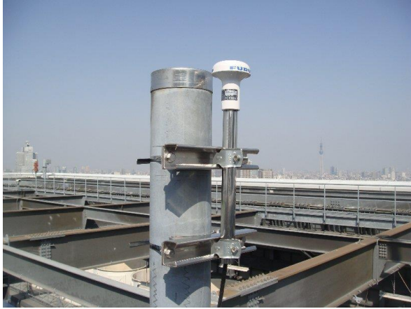
(1-1) 建物屋上設置 GPS アンテナ
