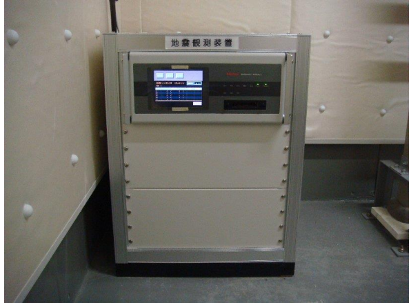
(1-2) 建物 33 階強震観測装置設置用ラック (強震観測装置, モデム, 検出器)
