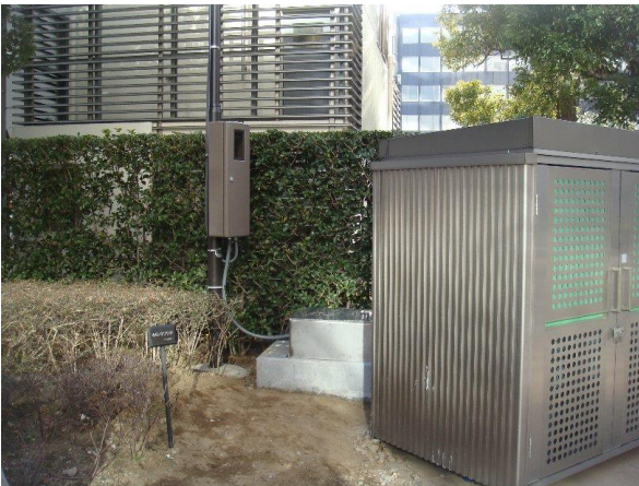
(2-1) 公園内強震観測装置カバー, 電源ポール (上部 GPS アンテナ設置)
