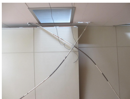
写真 5.4-122 ブレースの変形状況
