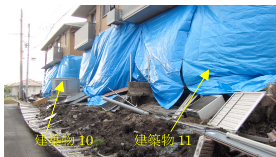
写真 5.4-24 宅地擁壁部分の崩壊
