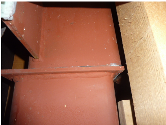
写真 5.4-20 パネルとダイアフラム間の溶接部の破断
