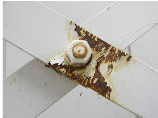
写真 5.4-92 ブレース交差部の塑性化と破断
