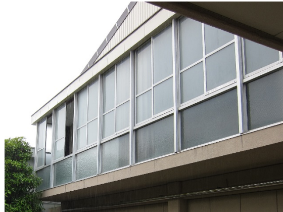
写真 5.4-83 窓ガラスの被害
