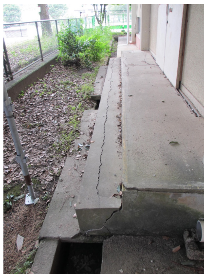
写真 5.4-52 周辺地盤の沈下
