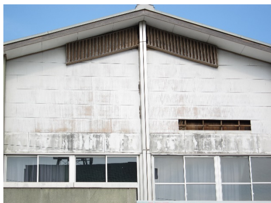
写真 5.4-136 妻面の外装材の脱落
