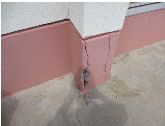
写真 5.4-51 柱脚部のコンクリートひび割れ
