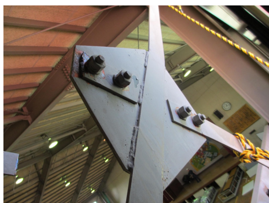
写真 5. 4-165 孔欠損部近傍での破断
