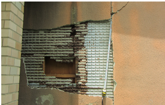
写真 5.4-116 入り口脇の外壁モルタルの落下
