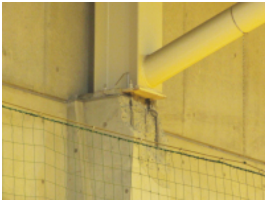
写真 5.4-184 体育館Bの屋根支承部のコンクリートの側方破壊
