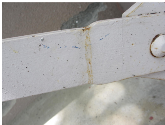
写真 5.4-90 ブレース母材と端部の幅広プレートの境界がわずかに降伏 (写真 5.4-89 の拡大)
