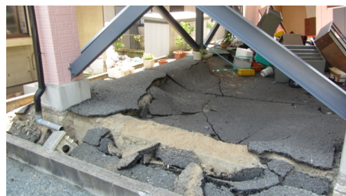
写真 5. 4-38 宅地の地盤変状
