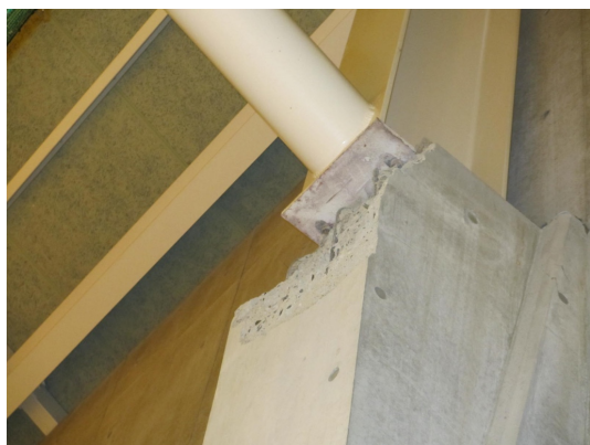
写真 5.4-57 支承部のコンクリートの側方破壊
