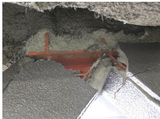
写真 5.4-198 ブレース交差部の耐火被覆の剥離
