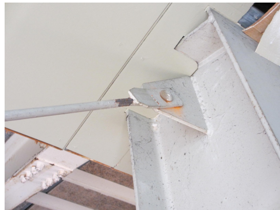
写真 5. 4-46 ガセットプレートの曲がり
