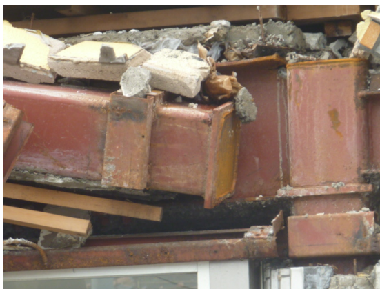
写真 5.4-2 パネルーダイアフラム間の溶接部の破断
