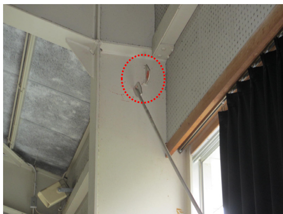
写真 5.4-80 鉛直ブレースのボルト破断
