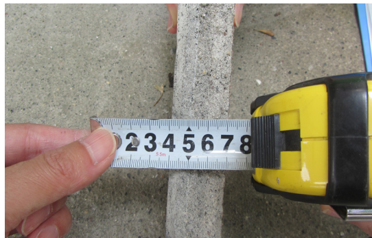
写真 5.4-117 左の落下したモルタル (厚さ約3cm)
