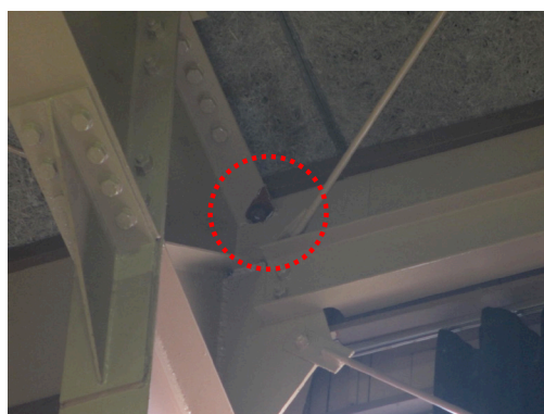
写真 5.4-135 取り替えられていない屋根面水平ブレースのボルト破断
