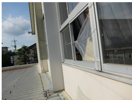
写真 5.4-137 妻面の窓ガラスの損傷
