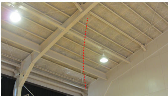
写真 5.4-77 屋根面水平ブレースのたわみ（隅角部）
