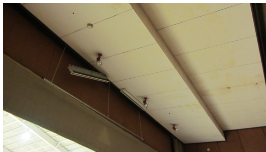
写真 5.4-105 舞台の天井（被害なし）と照明のぶら下がり
