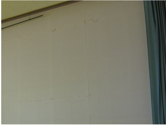
写真 5. 4-97 舞台背面壁の仕上げボード継ぎ目のずれ
