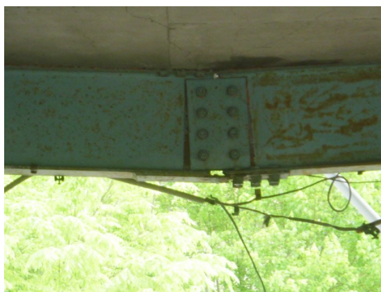
写真 5.4-6 梁下フランジ添え板の孔欠損部破断
