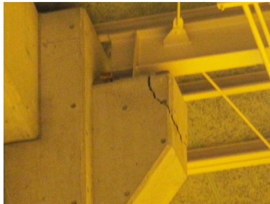
写真 5.4-185 体育館Bの屋根支承部のコンクリートのひび割れ
