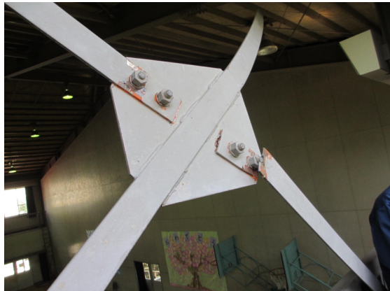
写真5.4-174 体育館Oのブレース孔欠損部の破断
