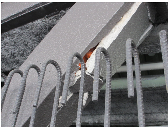
写真 5.4-197 ブレース端部の耐火被覆の亀裂
