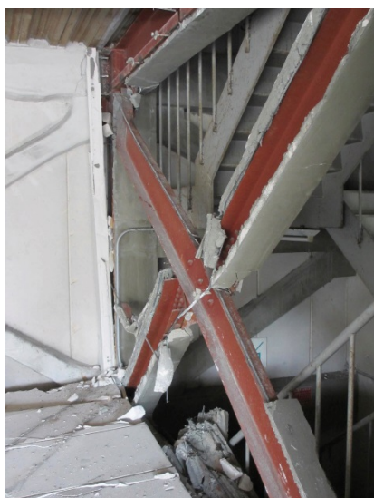
写真 5.4-192 溝形鋼ブレースの座屈
