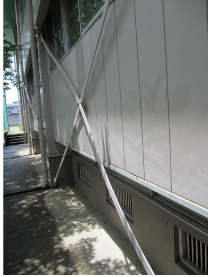
写真 5.4-86 平鋼ブレースのたわみ
