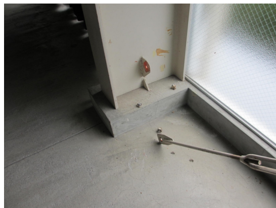
写真 5.4-79 鉛直ブレース接合部のボルトの破断
