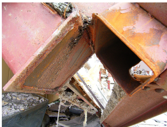
写真 5.4-3 パネルーダイアフラム間の溶接部の破断
