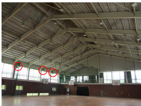
写真 5.4-78 内観（赤円内が安定器を留め付けた板が外れた箇所）
