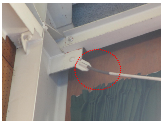
写真 5.4-120 ブレース端部の塑性化の様子
