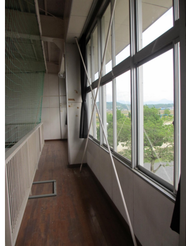
写真 5.4-129 2階のブレースのわずかなたわみ
