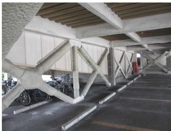
写真 5.4-189 建築物内のブレースの様子
