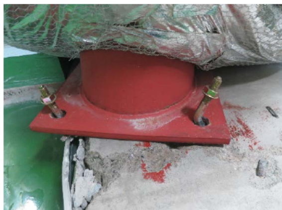
写真 5.8.3-8 屋上貯湯槽アンカー接合部の損傷
