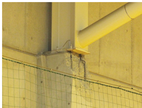
写真 5.8.2-47 支承部のコンクリートの側方破壊
