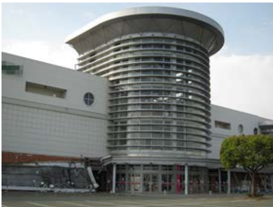
写真 5. 8. 2-26 上部から内装材が脱落した吹き抜け（熊本市）
