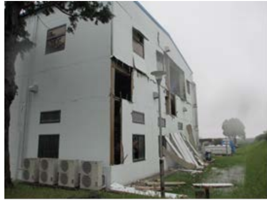
写真 5. 8. 2-55 工場の外壁の被害
