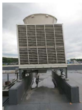
(b) 基礎部分から傾斜した冷却塔
