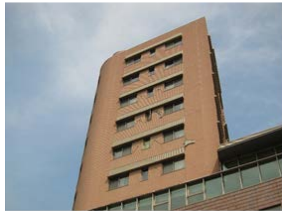
写真 5.8.2-53 外壁タイルの脱落
