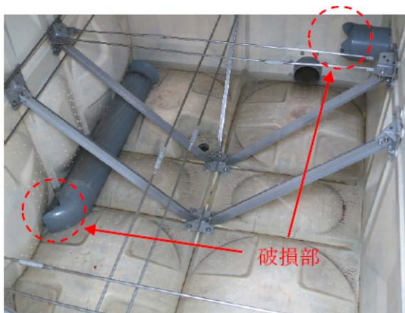
写真 5.8.3-5 病院 A における水槽内部のオーバーフロー管損傷傷
