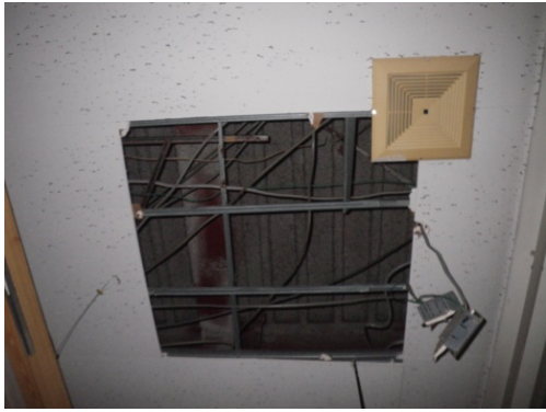
写真 5.8.2-70 1階天井板落下箇所
