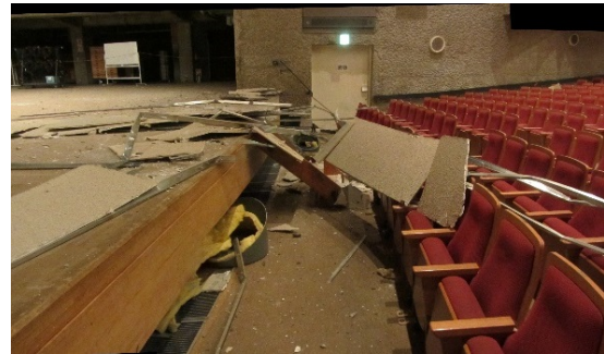
写真 5.8.2-4 1階客席前方に落下した天井(せっこうボード(厚さ 12.5mm)+吹付)
