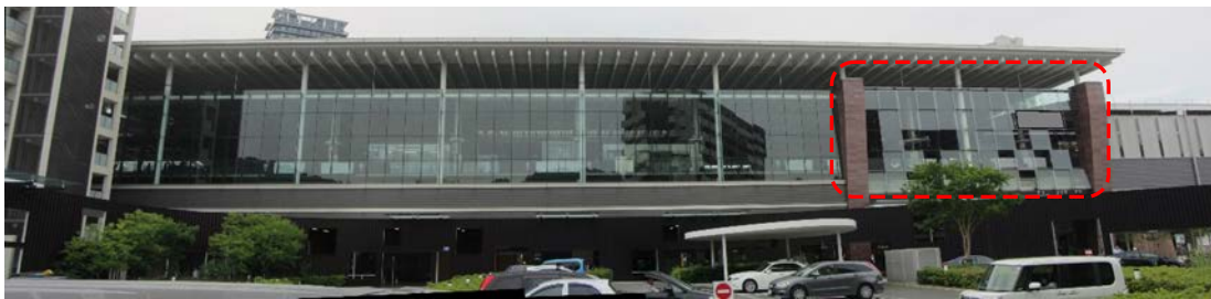
写真 5. 8. 2-37 駅舎のガラスの被害（全体）
