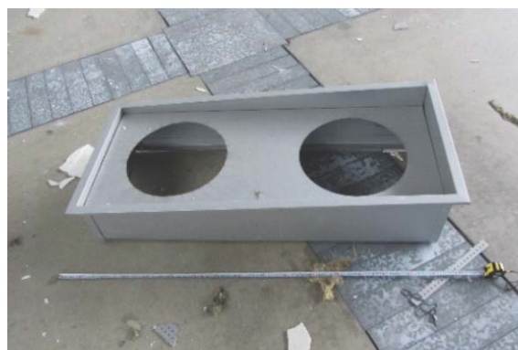
(b) 落下した照明カバー
