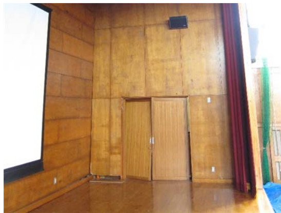
写真 5.8.2-43 舞台壁の損傷、引き戸の外れ
