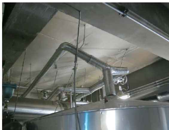
写真 5.8.3-10 機械室内貯湯槽の配管の損傷
