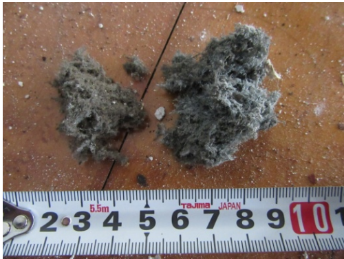
写真 5. 8. 2-91 ステージ床上落下物
