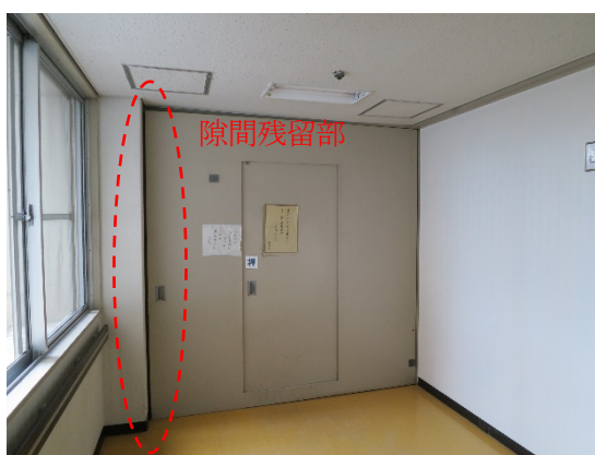
写真 5. 8. 2-63 完全には閉鎖しなくなった防火戸（SRC 造、熊本市東区）
