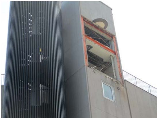
写真 5. 8. 2-56 駐車場の塔屋の被害
