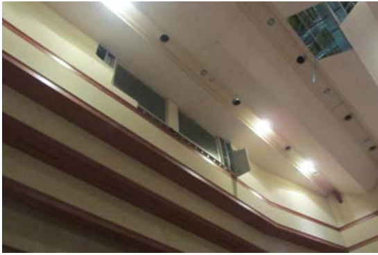
写真 5.8.2-39 客席後方上部の開口脇の内壁の損傷・脱落
