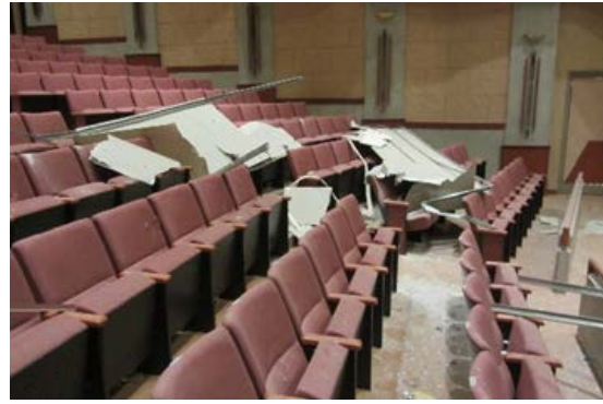
写真 5.8.2-8 脱落した天井
