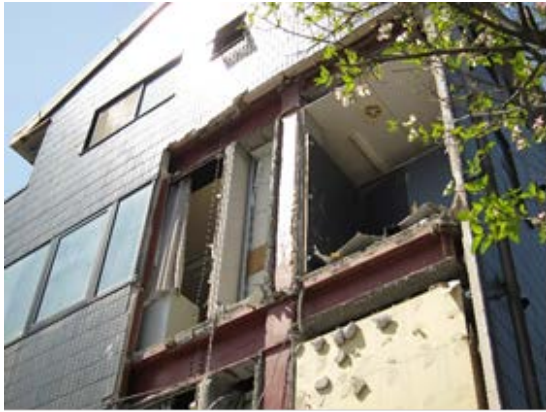
写真 5. 8. 2-54 乾式工法による外壁の脱落
