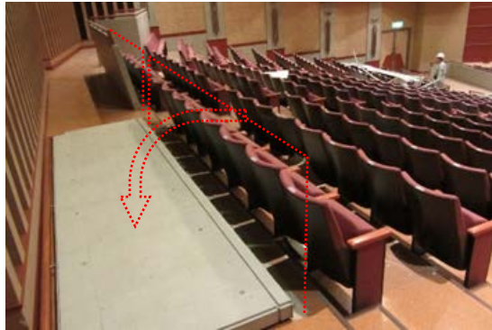
写真 5.8.2-49 最後方の客席とその後ろの通路を隔てる壁の転倒 (写真奥の壁では傾き発生)
