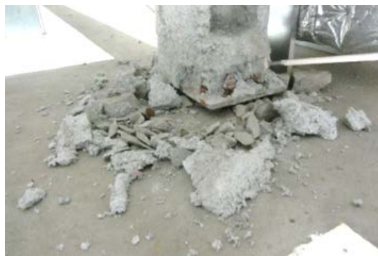
写真 5.8.2-45 屋根支承部の被害 (諸室棟)
