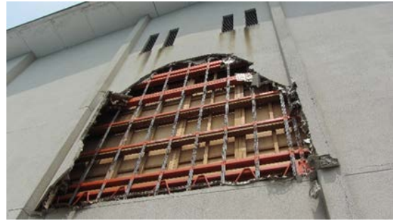
写真 5.8.2-51 舞台裏 ラスモルタル外壁の落下
