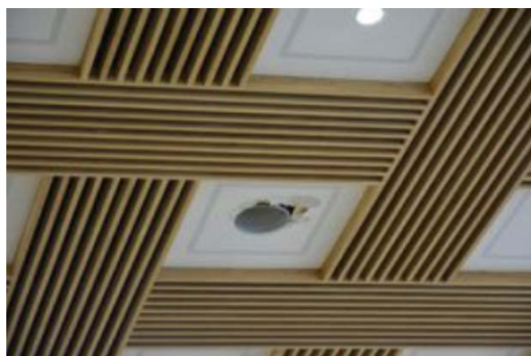
(a) 空港旅客ターミナルにおける アネモスタットの脱落
