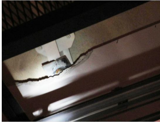
写真 5.8.2-48 ステージ上の下屋の支承部コンクリートの破損、落下
