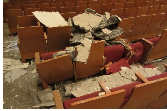
写真 5.8.2-2 1階客席へのラスモルタル天井の脱落
