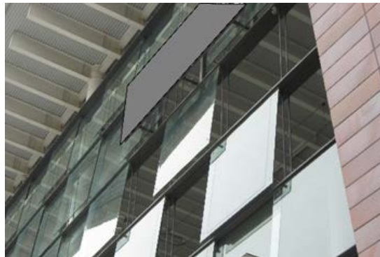
写真 5. 8. 2-38 駅舎のガラスの被害（拡大）
