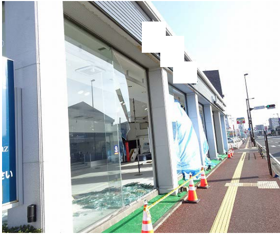
写真 5. 8. 2-35 店舗でのガラス破損
