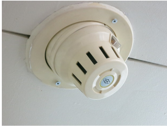
写真 5.8.3-16 病院Bにおける煙感知器の歪み
