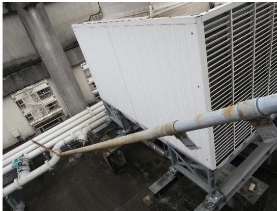
写真 5.8.3-17 病院Aにおける支持部の破損により転倒した避雷針
