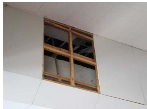
写真 5. 8. 2-88 アリーナ壁面破損状況
