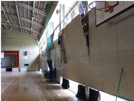
写真 5.8.2-41 損傷して傾いた内壁
