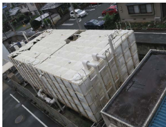
(b) 病院 A（1979 年竣工：熊本市東区）での被害
