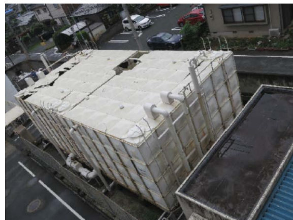
(b) 病院 A (1979 年竣工 : 熊本市東区) での被害
