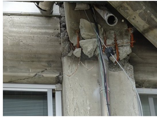
写真5.5-195 4階柱-5階梁接合部
