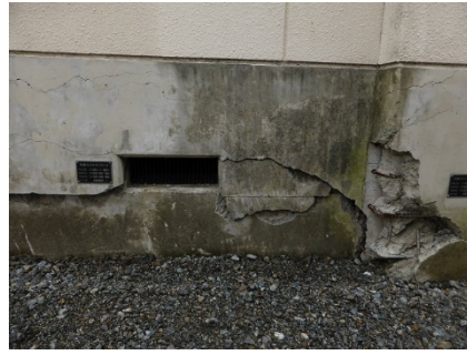
写真5.5-93 基礎立上り部の損傷
