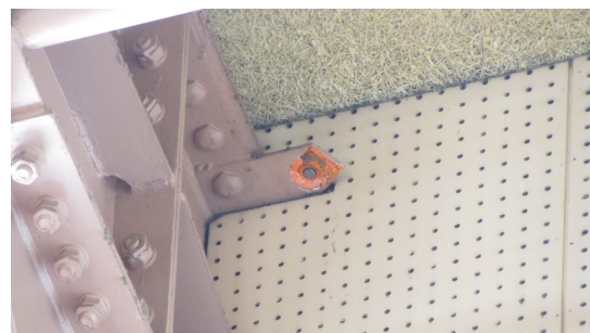
写真 5.4-66 左のガセットプレート拡大（ボルトが残っているように見える）
