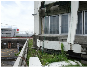
写真5.5-197 南側2階柱脚部の破壊
