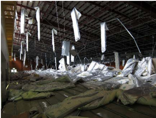
写真 5.8.2-19 天井脱落の状況
