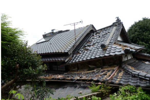
写真 5.3-26 倒壊した木造住宅
