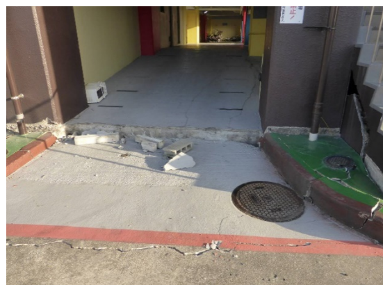
写真5. 5-253 地盤変状による建築物と地盤面の段差
