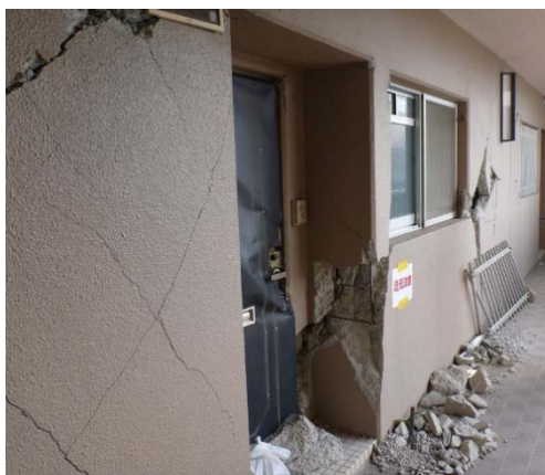
写真5.5-19 2階共用廊下側の方立壁の被害
