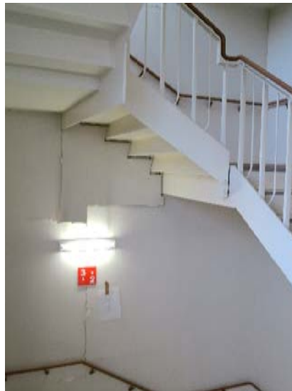
写真 5.8.2-68 階段室内の壁の被害 (RC+S 造、大津町)
