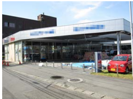
写真 5. 8. 2-27 軒天井の脱落、ガラスの破損（熊本市）
