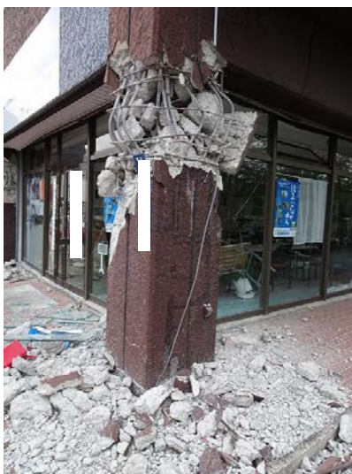
写真5.5-256 1 階柱の大破 (南東側)
