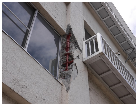
写真5.5-302 2階柱のコンクリートの剥落
