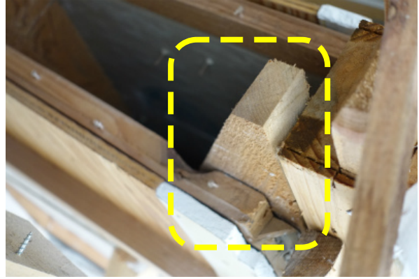
写真 5.3-47 アパート A の筋かい端部 (N70 釘 1~2 本打ちによる接合)
