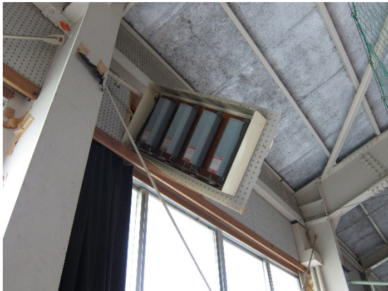
写真 5.4-84 安定器を留め付けた板の外れ
