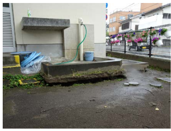
写真 5.6-58 小学校校舎の周辺地盤の沈下状況（熊本市南区近見）
