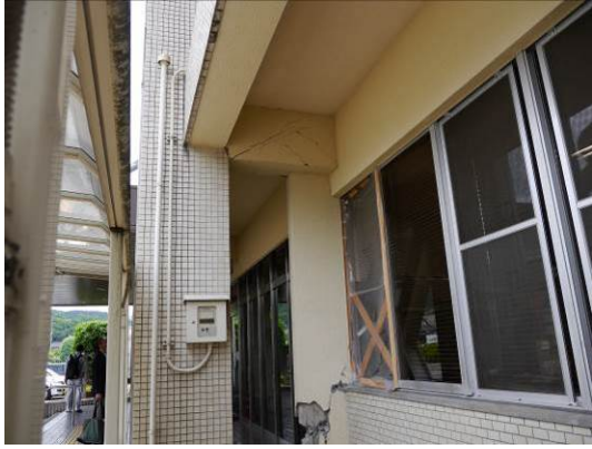
写真5.5-174 短スパン梁のせん断ひび割れ
