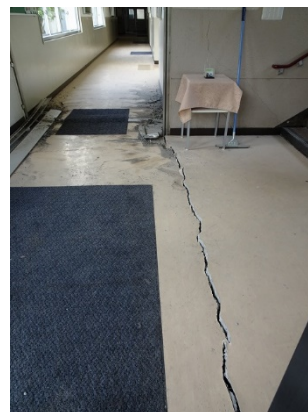
写真5.5-284 1階スラブのひび割れと段差
