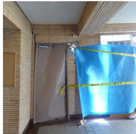
写真5.5-81 1階エントランスホール内部と住棟本体（左側）をつなぐ梁端の大きな残留ひび割れ
