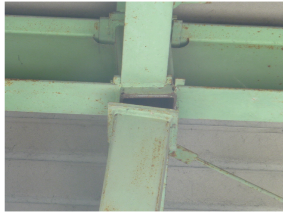
写真 5. 4-34 パネルとダイアフラム間の溶接部の破断
