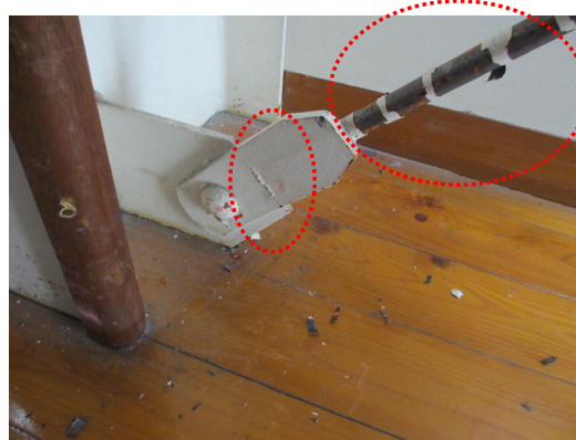
写真 5.4-121 ブレース端部の塑性化と羽子板の曲がり
