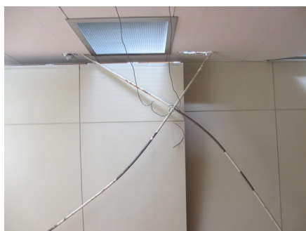
写真 5.4-122 ブレースの変形状況
