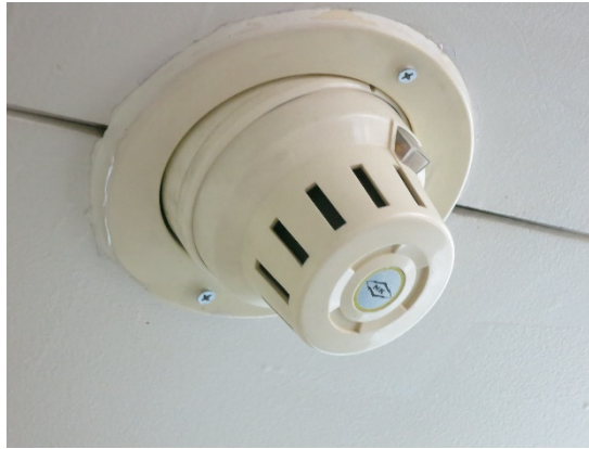
写真 5.8.3-16 病院Bにおける煙感知器の歪み
