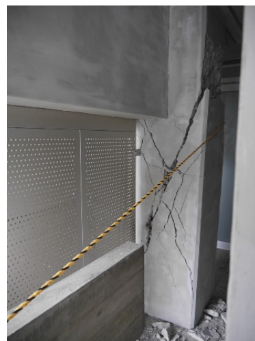
写真5.5-264 2階柱のせん断破壊
