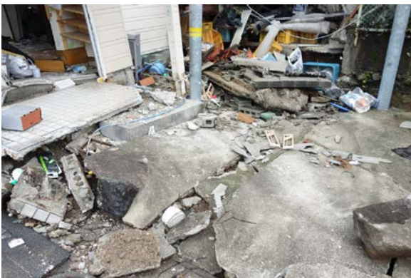
写真 5.6-34 写真 5.6-32 の建築物の周辺地盤。地盤変状は大きいと思われる。
