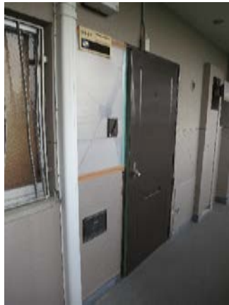
写真 5.8.2-65 開閉障害が発生した玄関扉（RC造、熊本市中央区）
