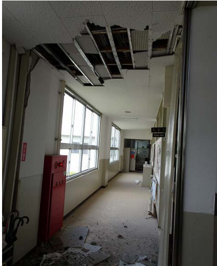
写真5.5-285 天井材の落下
