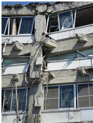
写真5.5-201 4、5階十字形柱梁接合部の損傷（南西側）
