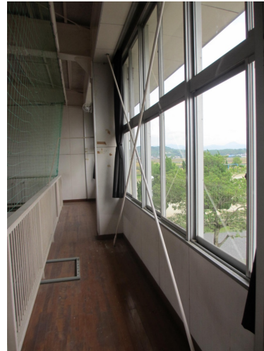
写真 5.4-129 2階のブレースのわずかなたわみ
