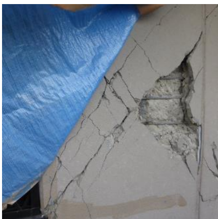
写真5.5-31 共用廊下側柱のせん断破壊
