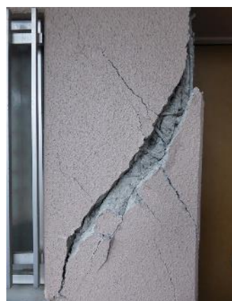
写真5.5-68 方立て壁のせん断破壊
