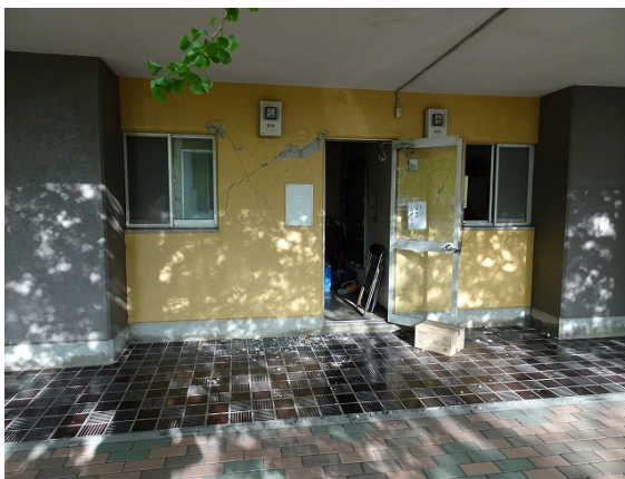
写真5.5-236 桁行方向1階の方立て壁のせん断破壊
