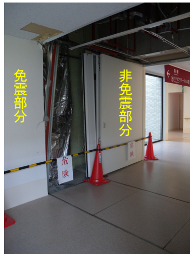
写真 5.7.2-4 破損したエキスパンションカバー（撤去済み）
