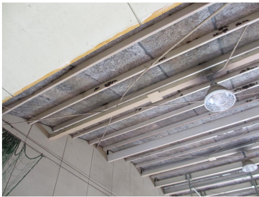
写真 5. 4-47 屋根面水平ブレースの曲がり
