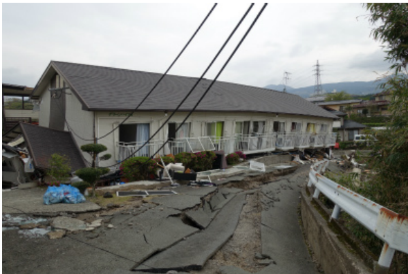
写真 5.3-52 倒壊したアパート C
