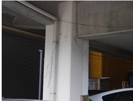
写真5.5-229 隣接建築物のピロティ柱のせん断ひび割れ
