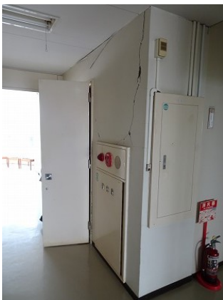
写真5.5-168 非構造壁の損傷
