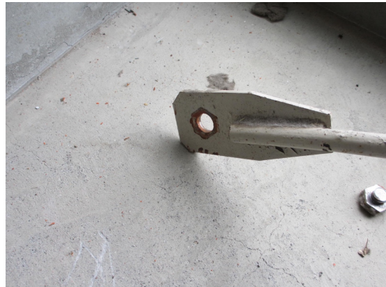
写真 5. 4-81 鉛直ブレースのボルト破断
