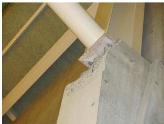
写真 5.4-57 支承部のコンクリートの側方破壊
