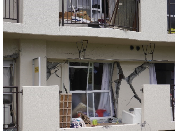
(b) 2階梁のひび割れ
