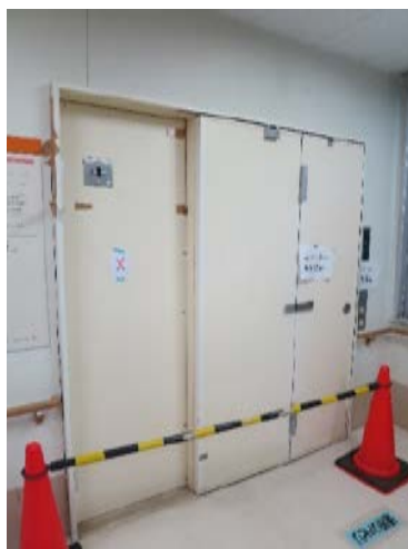
写真 5. 8. 2-62 脱落した折り畳み式防火戸（RC+S 造、大津町）
