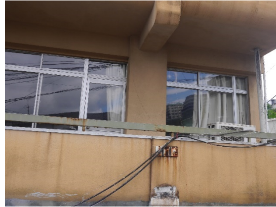
写真5.5-228 2階柱のせん断ひび割れ
