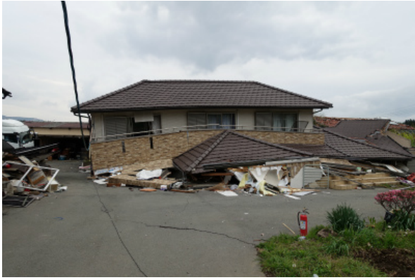
写真 5.3-70 倒壊した木造住宅（金物あり）
