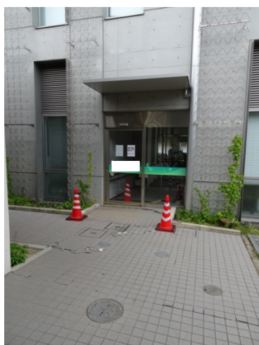
写真5.5-124 南側外構のひび割れ
