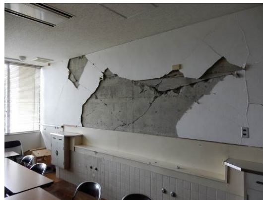
写真5.5-173 耐力壁のせん断ひび割れ
