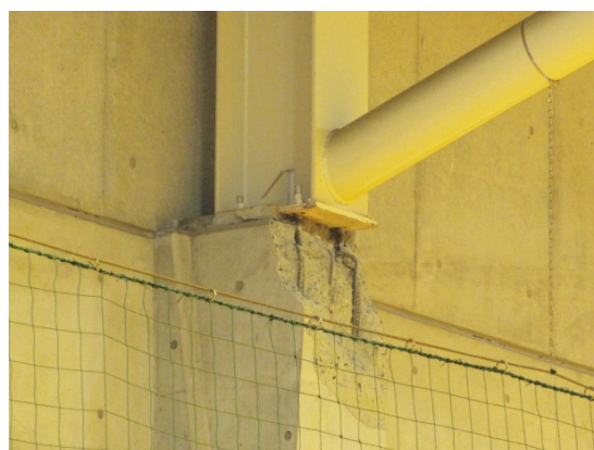
写真 5.8.2-47 支承部のコンクリートの側方破壊
