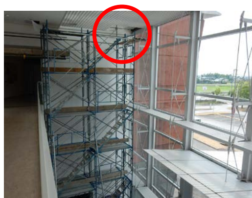
写真5.5-120 エントランス屋根上の鉄骨梁を支える RC 造コーベルの損傷
