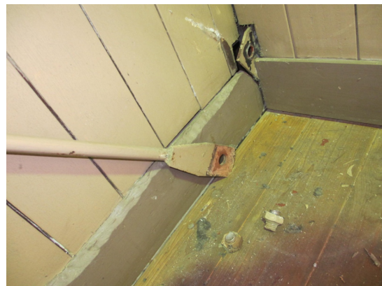
写真 5.4-131 取り替えられていない妻面ブレースのボルト破断
