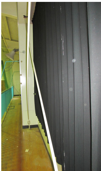
写真 5.4-95 2階ブレースのわずかなたわみ
