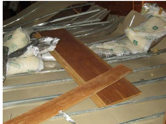
写真 5.8.2-20 脱落した天井材
