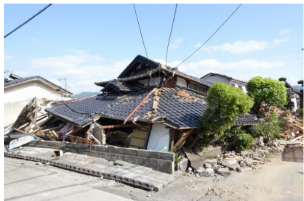
写真5.3-3 倒壊した木造住宅
