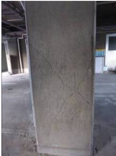
写真5.5-240 1階柱のせん断ひび割れ
