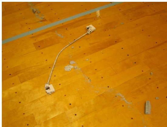
写真 5.4-60 落下した吊り金具
