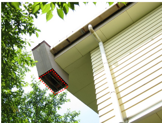
写真 5.4-171 外装材の脱落
