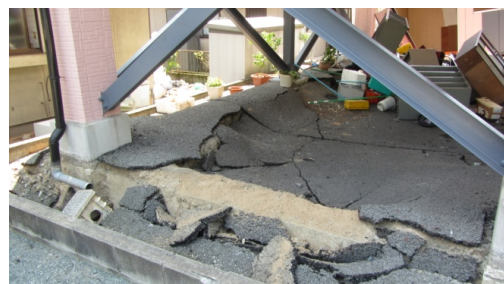
写真 5. 4-38 宅地の地盤変状
