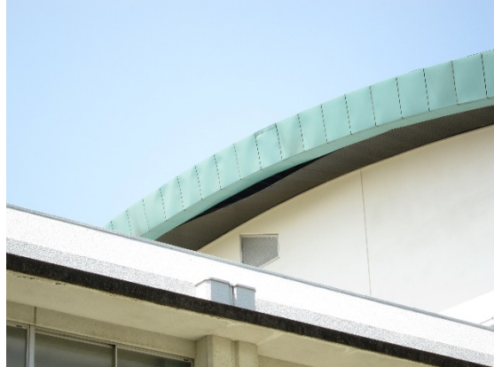
写真 5.4-162 軒天井の部分的な垂れ下がり
