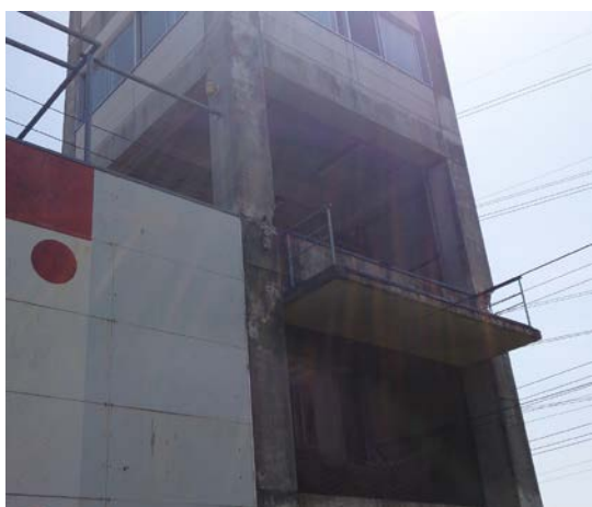
写真5.5-20 前震後の主訓練塔の被災状況
