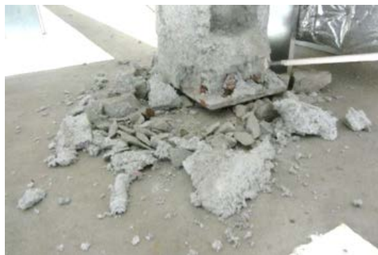
写真 5.8.2-45 屋根支承部の被害 (諸室棟)
