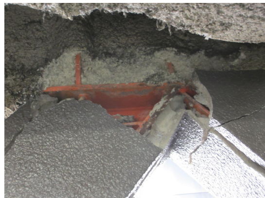
写真 5.4-198 ブレース交差部の耐火被覆の剥離
