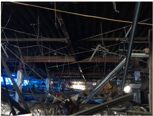
写真 5.8.2-74 2階天井崩落状況
