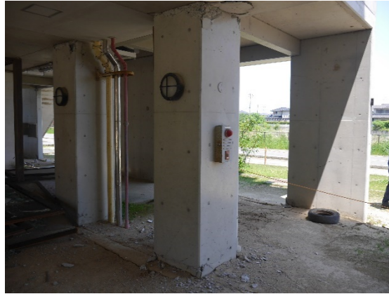
写真5.5-6 X5-Y3 柱（曲げ降伏、損傷度Ⅲ）
