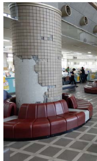
写真5.5-144 1F エントランス内の丸柱 のタイルの剥落
