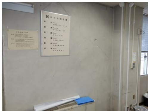
写真5.5-269 RC造壁のせん断ひび割れ
