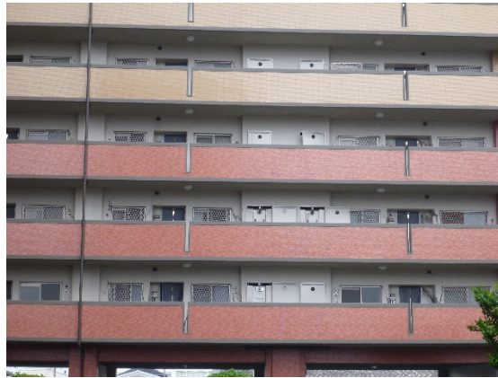
写真5.5-96 非構造壁の損傷
