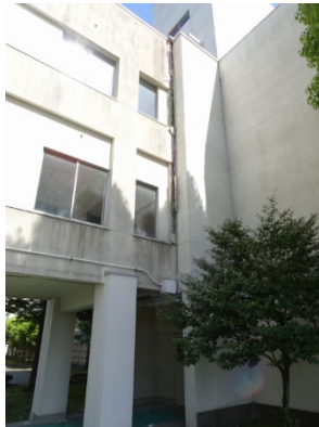
写真5.5-291 渡り廊下エクspansionジョイント部の破壊
