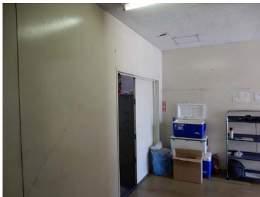
写真5.5-280 耐力壁のせん断ひび割れ
