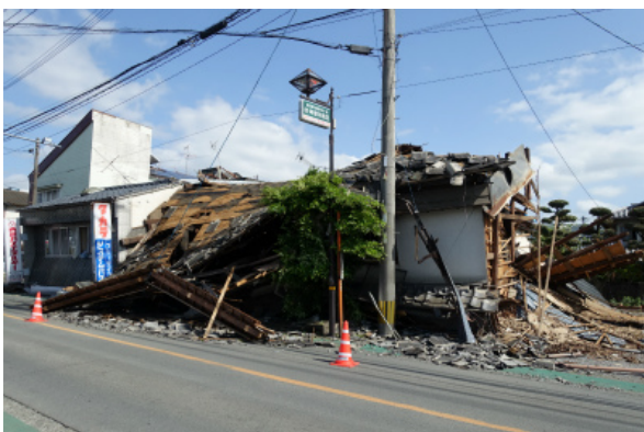
写真5.3-4 倒壊した木造住宅
