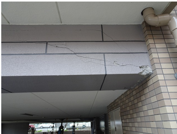
写真5.5-41 張間方向妻構面2階大梁端部のせん断ひび割れ
