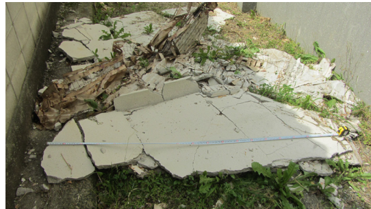
写真 5.4-70 左の壁面から脱落したモルタル (厚さ約3.5cm)
