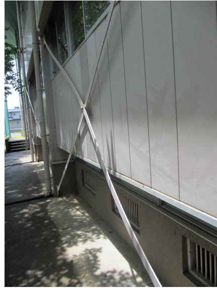
写真 5.4-86 平鋼ブレースのたわみ
