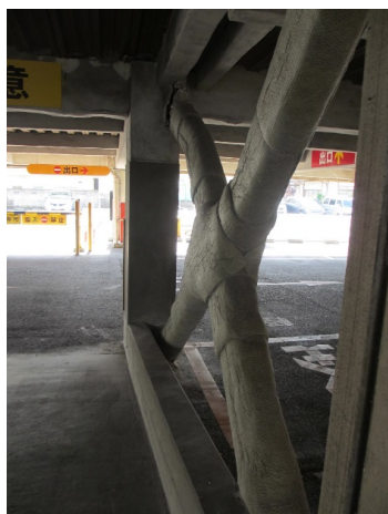
写真 5.4-190 ブレースの座屈
