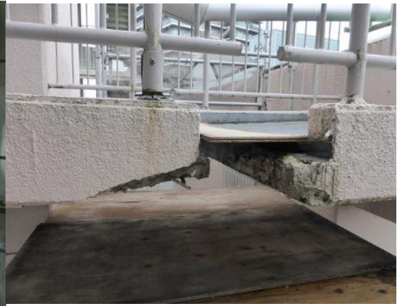
写真5.5-70 エキスパンションジョイント部の損傷・脱落
