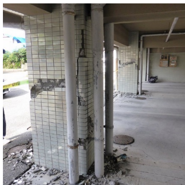
写真5.5-37 1階柱桁行方向のせん断破壊
