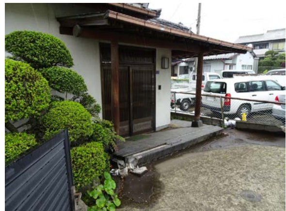
写真 5.6-48 写真 5.6-47 の建築物の 1 階玄関部分の沈下状況
