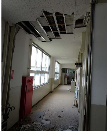
写真 5. 8. 2-25 天井材の落下
