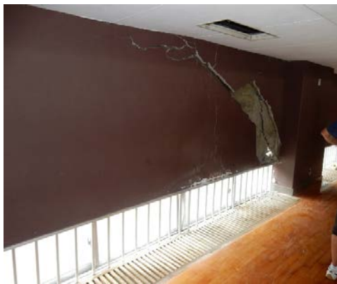
写真5.5-190 非構造壁のせん断破壊
