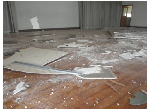
写真 5. 8. 2-90 ステージ床上落下物
