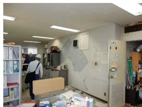
写真5.5-270 仕上げモルタルの剥落
