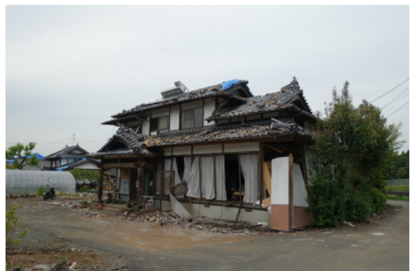
写真 5.3-43 大破した木造住宅
