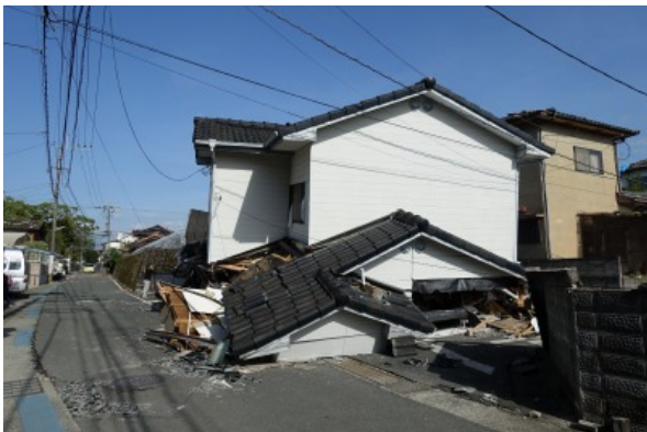
写真 5.3-10 倒壊した木造住宅
