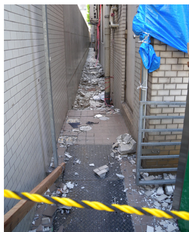
写真 5.7.2-16 隣接建物（右側）の外装材落下被害
