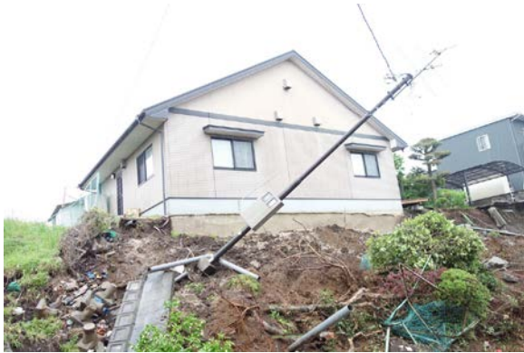
写真 5.6-25 軽微・無被害に見える建築物。擁壁は崩落、基礎に損傷なし（写真 5.6-23 より南の建築物）。
