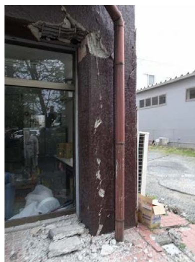
写真5.5-257 1 階柱 (北東側) の主筋付着割裂ひび割れと 2 階梁端部の破壊
