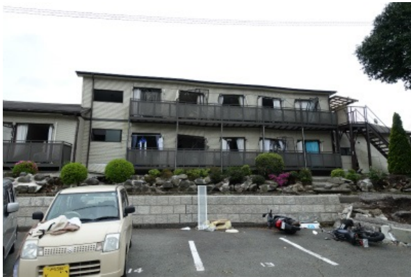
写真 5.3-62 大破した木造アパート
