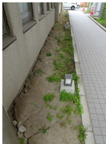
写真5.5-125 建築物に接する地盤のひび割れ
