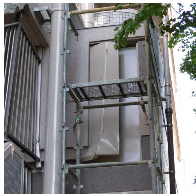
写真 5.7.2-48 同 状況③（カバーの変形）
