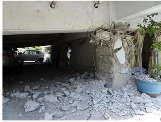
写真5.5-212 破壊した北側の1階柱
