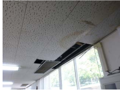
写真5.5-276 天井材の脱落
