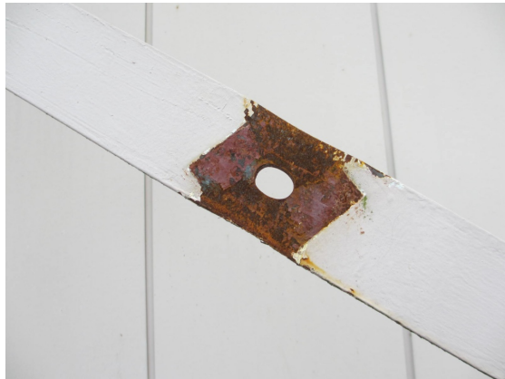
写真 5.4-93 ブレース交差部の伸び
