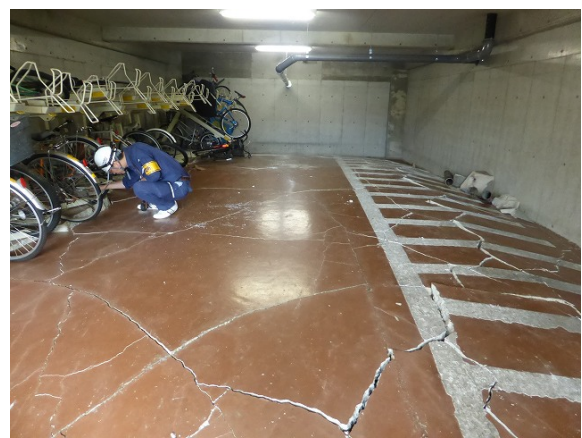
写真5.5-83 1階駐輪場土間スラブの上方向への残留変形と大きなひび割れ
