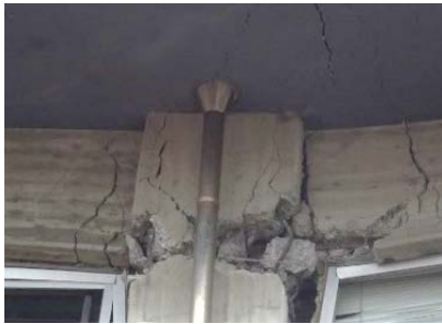
写真5.5-196 5階柱頭部の破壊
