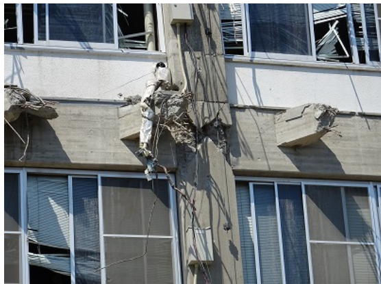
写真5.5-202 4階十字形柱梁接合部の損傷（南東側）
