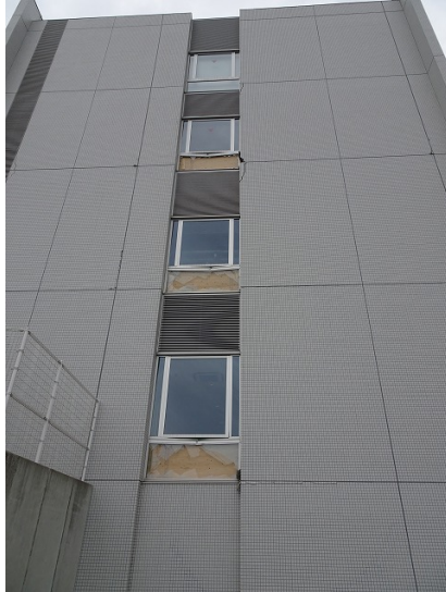
写真 5.8.2-28 境界梁部分にある窓ガラスの破損・落下
