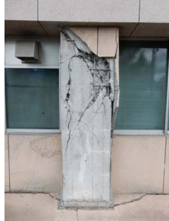
写真5.5-306 1階柱のせん断破壊
