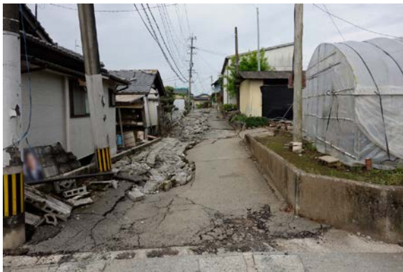
写真 5.6-10 A 通り・県道 28 号南側の道路の舗装の様子。北側に比べて損傷が大きく見える。
