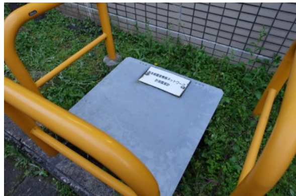
写真 5.3-25 震度計の設置状況
