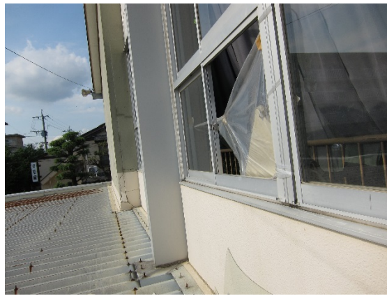
写真 5. 8. 2-34 妻面の窓ガラスの損傷
