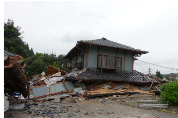
写真 5.3-27 倒壊した木造住宅
