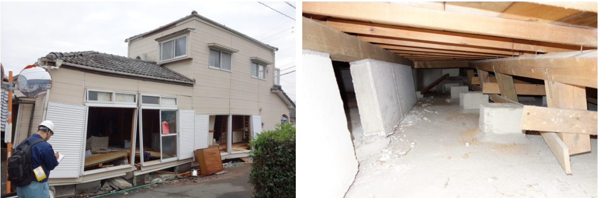
写真 5. 6-44 地盤変状が認められ、基礎に損傷が著しい事例 1
