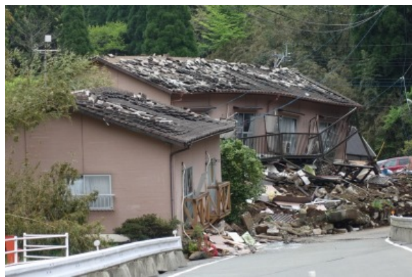
写真 5.3-63 倒壊した木造アパート
