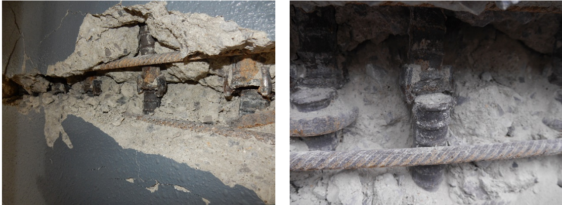
写真5.5-11 主筋破断部の拡大
