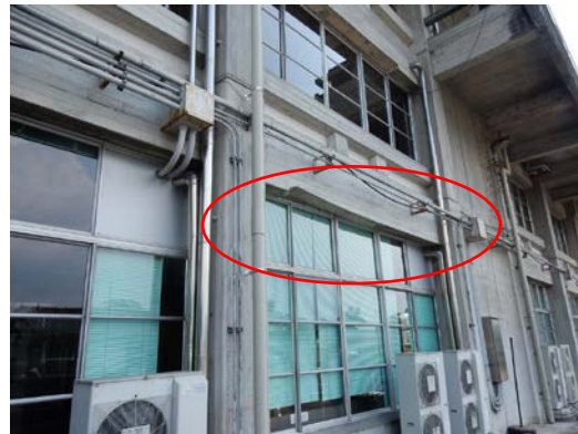
写真5.5-274 大梁下端のコンクリートの剥落
