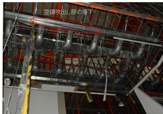
(b) 美術館（1992年改修/用途変更：熊本市中央区） における天井落下に伴う吹出し部の落下
