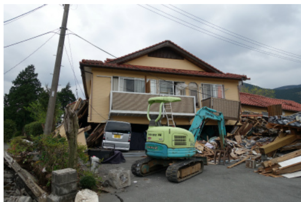
写真 5.3-65 倒壊した木造住宅
