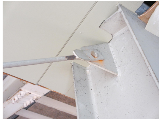
写真 5. 4-46 ガセットプレートの曲がり
