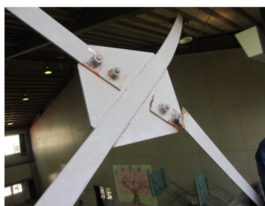
写真 5. 4-166 孔欠損部での破断
