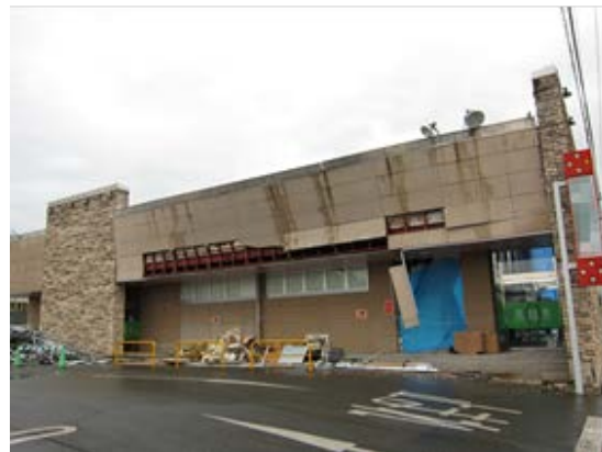
写真 5. 8. 2-57 外壁の損傷・傾斜
