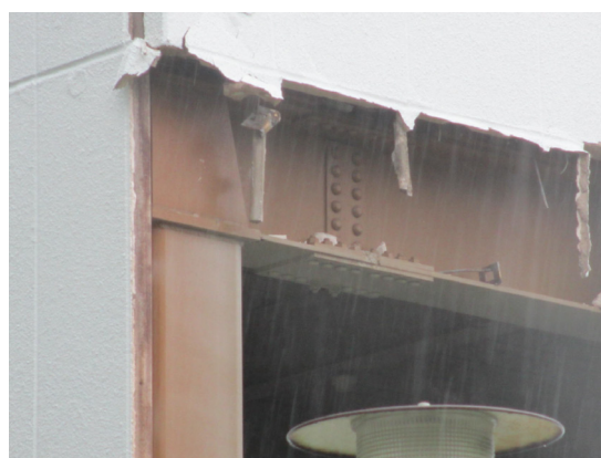
写真 5. 4-204 外壁落下で露出した柱梁接合部
