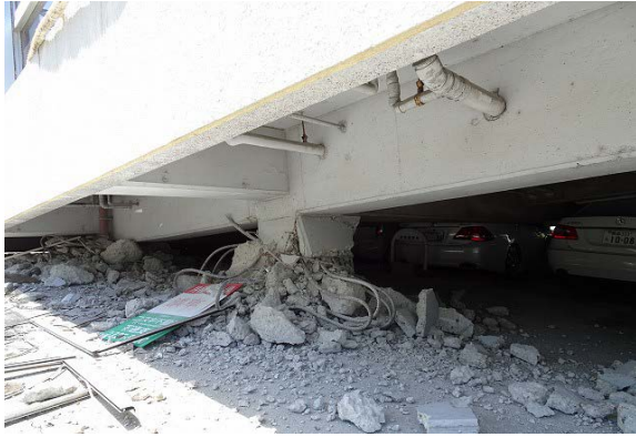
写真5.5-211 破壊した南側の1階柱
