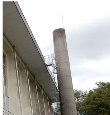
写真5.5-191 隣接する煙突の梯子の変形
