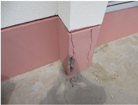
写真 5.4-51 柱脚部のコンクリートひび割れ
