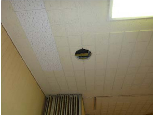
写真5.5-135 天井材の脱落
