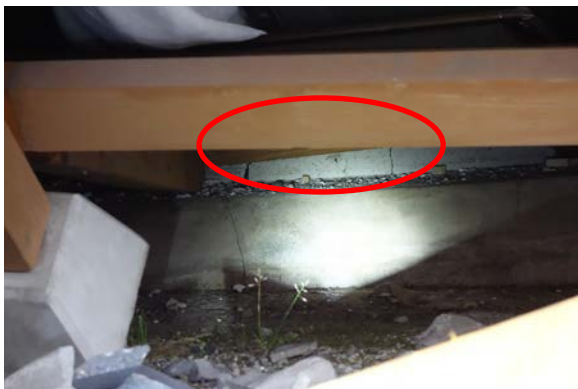
写真 5.6-27 写真 5.6-26 の建築物で確認できた基礎の様子。一部にひび割れを確認できる
