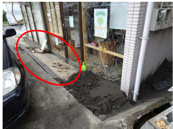
写真 5.6-52 写真 5.6-51 の建築物の1階部分の沈下状況
