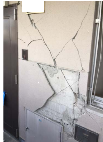
写真5.5-235 桁行き方向外廊下側玄関脇の方立て壁のせん断破壊
