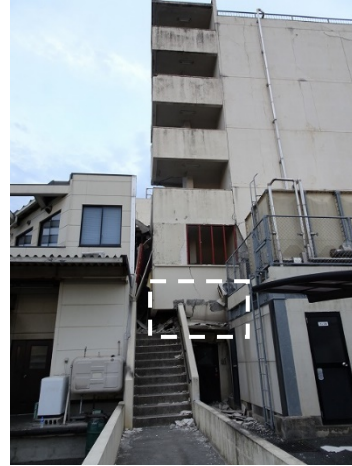
写真5.5-224 外観（西側） 2階部分の局部的崩壊
