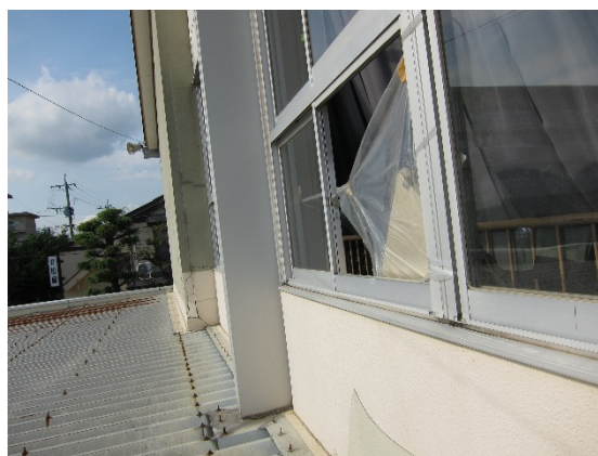
写真 5.4-137 妻面の窓ガラスの損傷
