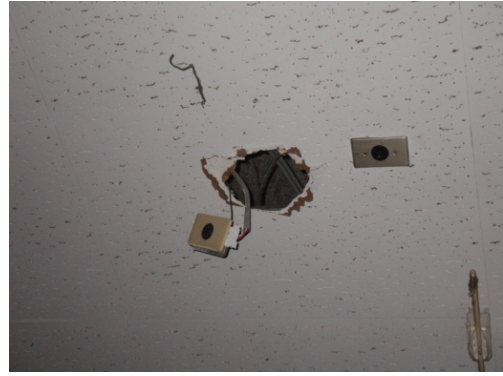
写真 5.8.2-71 1階天井板破損箇所
