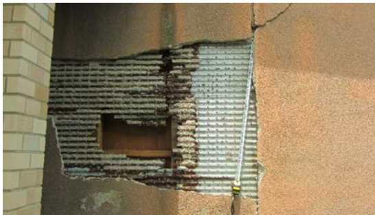
写真 5.8.2-52 入り口脇の外壁モルタルの落下
