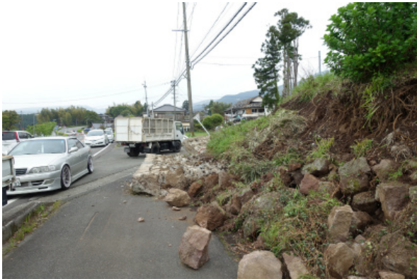
写真 5.3-30 崩壊した擁壁
