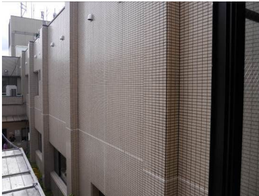
写真5.5-115 壁面のせん断ひび割れ
