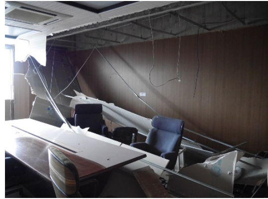
写真5.5-266 天井材の落下被害
