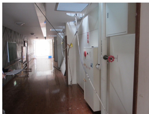
写真 5.4-119 1階の大きくたわんで変形したブレース
