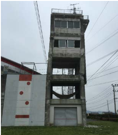
写真5.5-24 本震後の主訓練塔の被災状況
