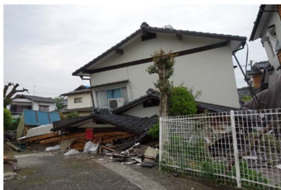
写真 5.6-2 1 階が倒壊している建築物
