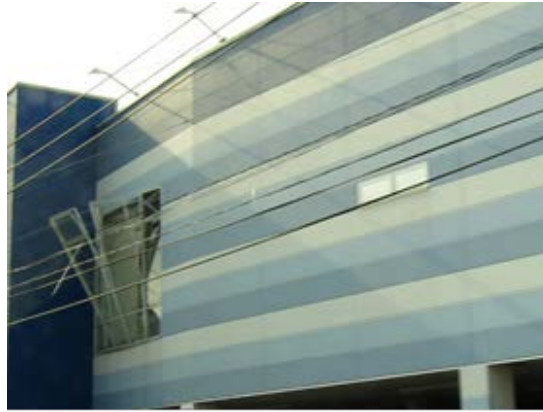
写真 5.8.2-31 窓サッシの損傷・外れ（熊本市）
