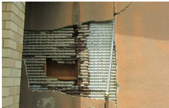
写真 5.4-116 入り口脇の外壁モルタルの落下
