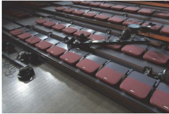
写真 5. 8. 3-3 会館での照明設備落下
