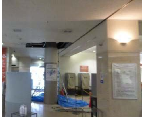
写真 5. 8. 2-23 天井仕上げ材の脱落（南側病棟）
