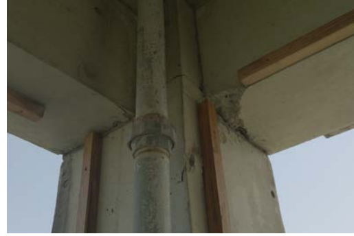
写真5.5-23 前震後の主訓練塔の 4階大梁の被災状況
