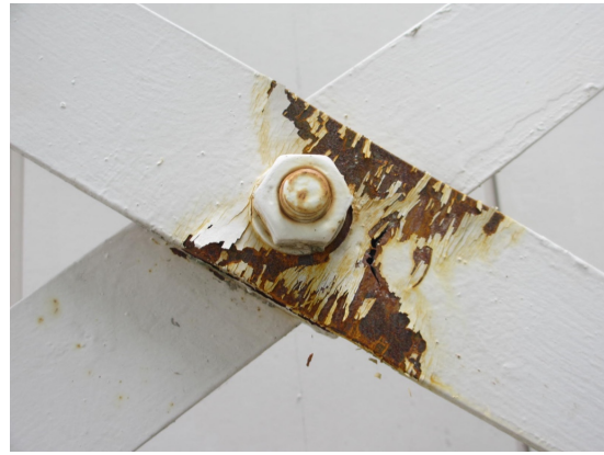
写真 5.4-92 ブレース交差部の塑性化と破断
