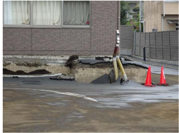
写真 5.6-56 写真 5.6-55 の建築物の周辺地盤の沈下状況（平成 28 年 4 月 23 日午後撮影）
