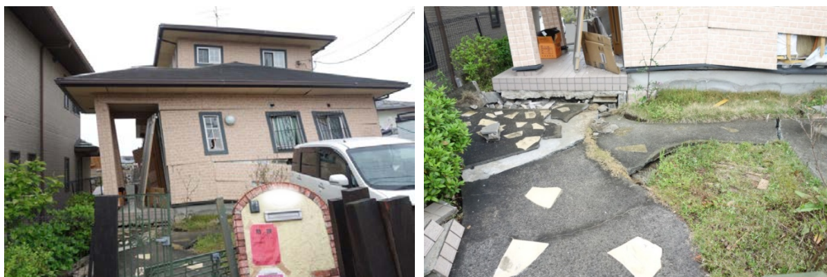
写真 5. 6-46 地盤変状が認められるが、基礎の損傷が軽微・無損傷の事例
