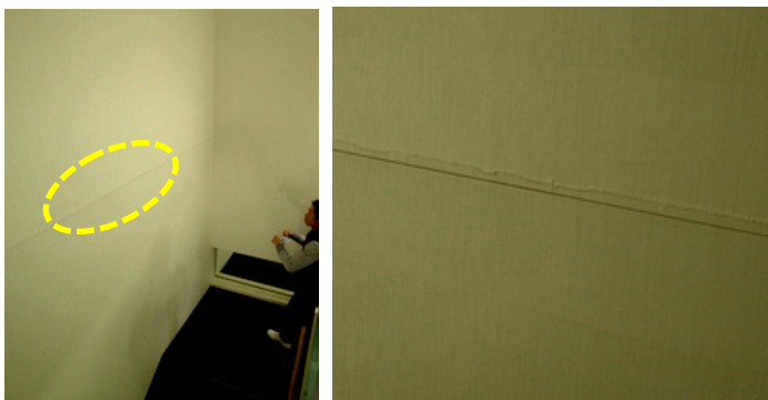
写真5.7.2-12 階段室の内装クロスの上り及び4階の窓サッシ部金具のずれ
