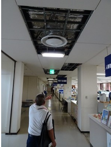
写真5.5-170 2階天井の脱落
