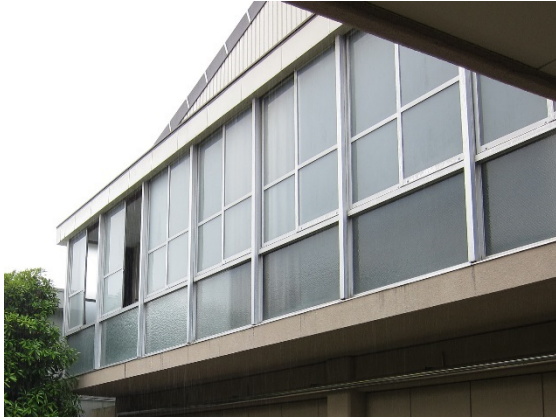
写真 5. 8. 2-32 体育館の窓ガラスの被害
