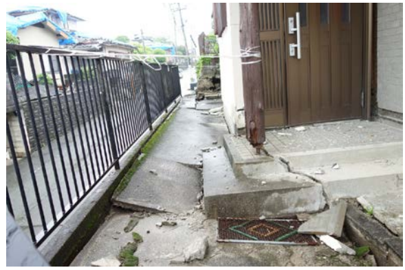
写真 5.6-24 写真 5.6-23 の建築物周辺地盤の様子。盛土擁壁に変位した形跡あり。
