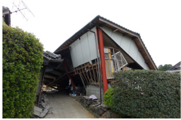
写真 5.3-45 倒壊した倉庫
