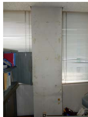
写真5.5-268 柱のせん断ひび割れ
