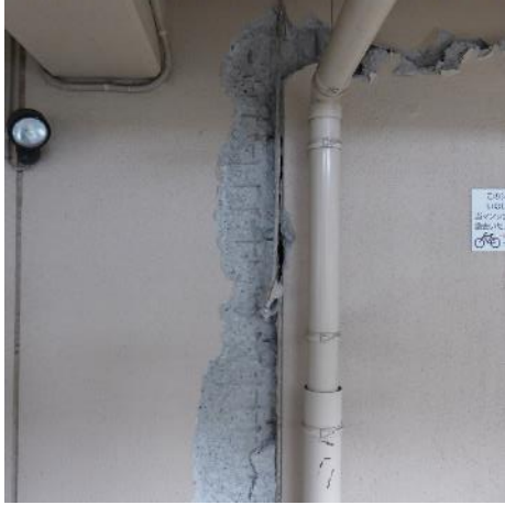
写真5.5-52 スリット深さ 20~30 mm程度 の非構造壁が取付く1階柱のコンクリー トの剥落
