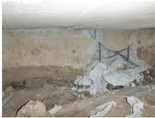
写真5.5-29 1階バルコニー下の基礎部分の損傷
