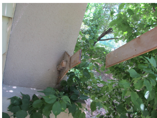
写真 5. 4-167 ブレース端部での母材破断
