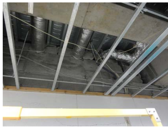
写真 5.8.2-42 ブロック壁（天井裏界壁）の被害
