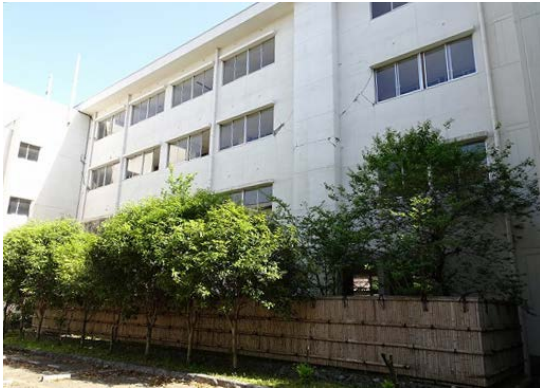
写真5.5-289 非構造壁のせん断破壊
