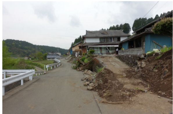
写真 5.3-41 崩壊した擁壁
