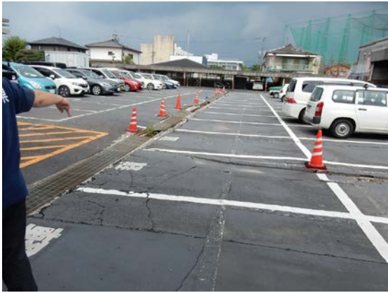
写真5.5-178 建築物周辺の地盤変状
