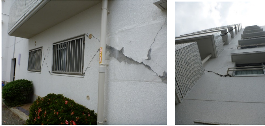
写真5.5-66 張間方向の妻壁の被害
