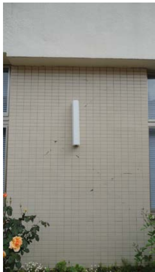
写真5.5-153 非構造壁のひび割れ
