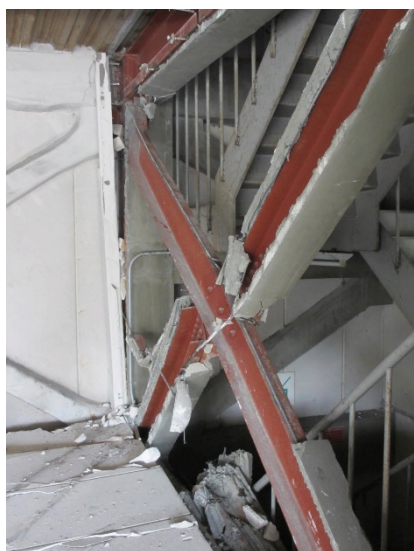
写真 5.4-192 溝形鋼ブレースの座屈
