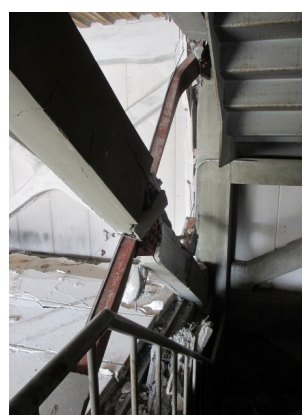
写真 5.4-191 ブレースの耐火被覆の剥落
