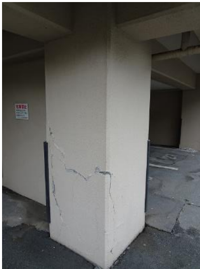
写真5.5-54 1階柱のひび割れ
