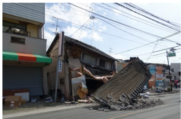
写真5.3-5 倒壊した木造住宅
