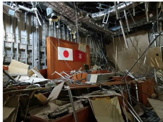
写真5.5-161 議会棟議場の崩落した天井
