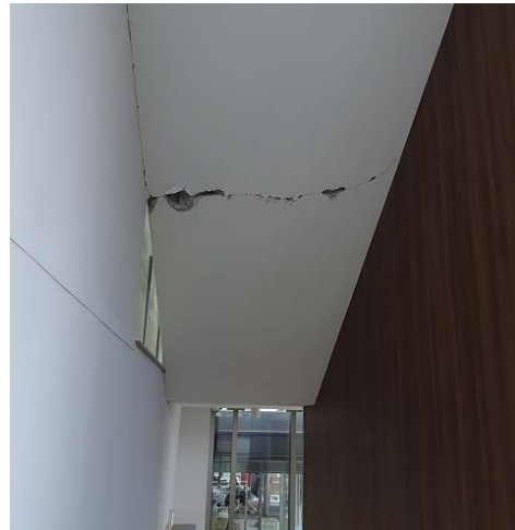
写真5.5-127 階段底面に見られたひび割れ
