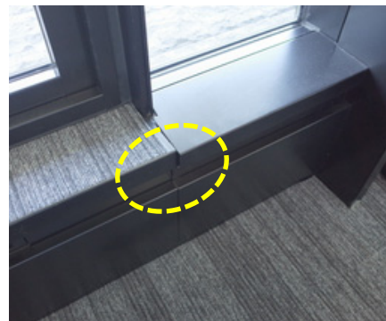
写真5.7.2-13 窓サッシ部金具のずれ
