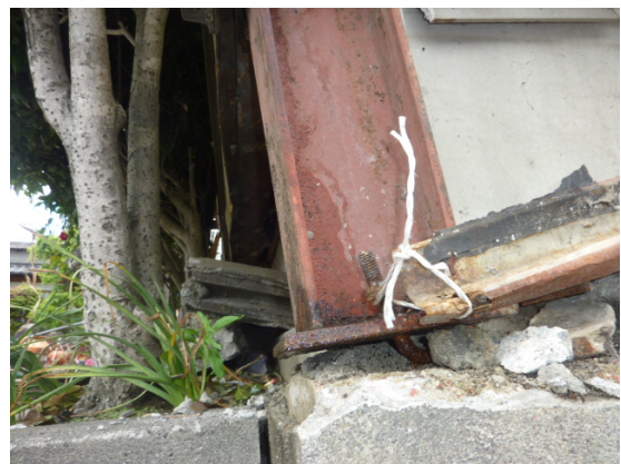
写真 5.4-8 柱脚部の損傷状況
