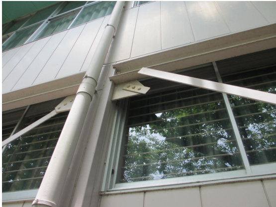
写真 5.4-87 平鋼ブレースの端部での破断
