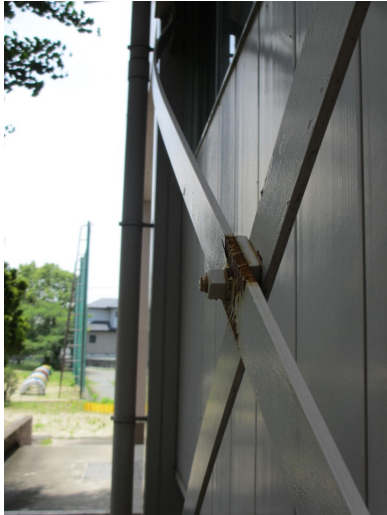
写真 5.4-91 ブレースのたわみ
