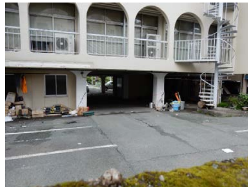
写真5.5-310 建築物南東構面における1階柱のせん断破壊
