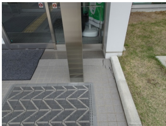
写真5.5-123 エントランス部分の床ひび割れ
