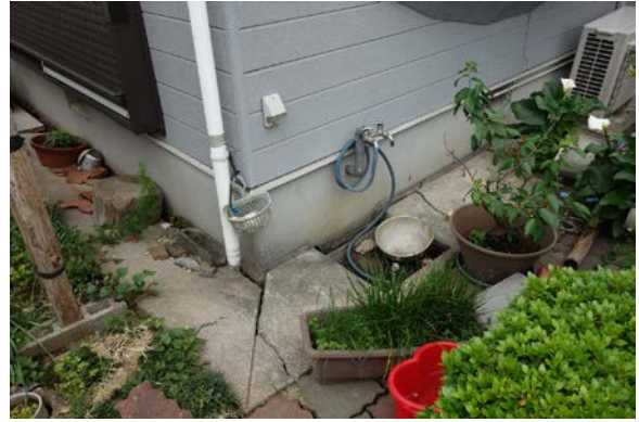
写真 5.6-15 写真 5.6-14 の基礎周りの様子。地盤変状が生じていると思われる損傷が見られる。
