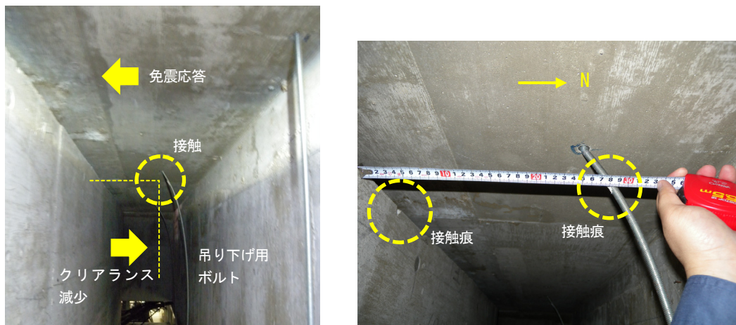
写真 5.7.2-28 配管吊り下げ用ボルトの変形（ボルトの接触痕から擁壁まで約28cm）
