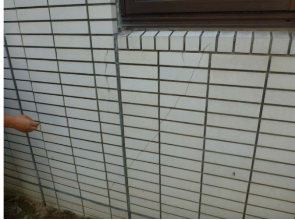
写真5.5-130 非構造壁のひび割れ
