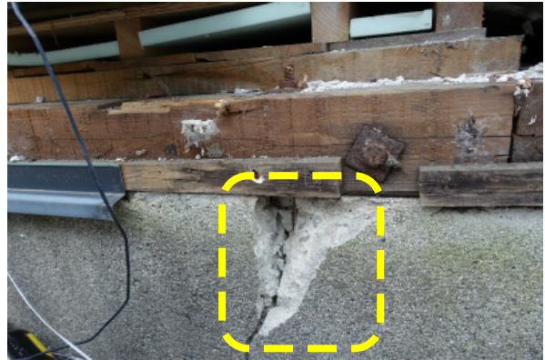
写真 5.3-49 アパート B の基礎亀裂部 (無筋コンクリート基礎+アンカーボルト)
