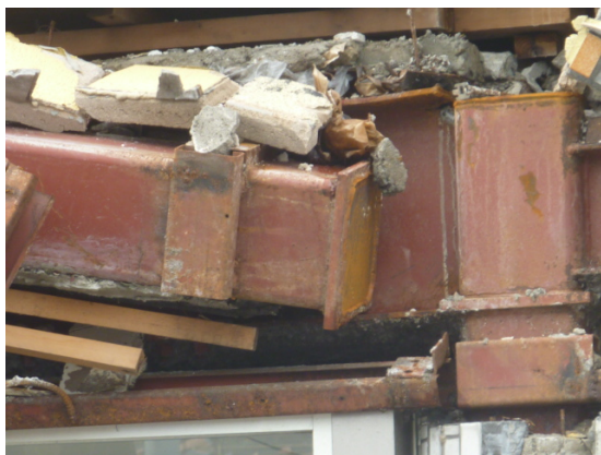
写真 5.4-2 パネルーダイアフラム間の溶接部の破断
