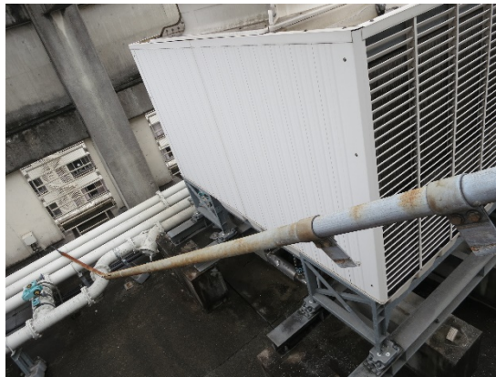
写真 5.8.3-17 病院Aにおける支持部の破損により転倒した避雷針
