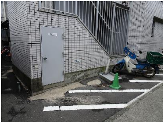
写真5.5-75 表層アスファルト路盤の凹凸
