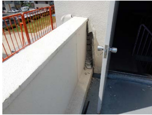
写真5.5-282 3階パラペットの損傷
