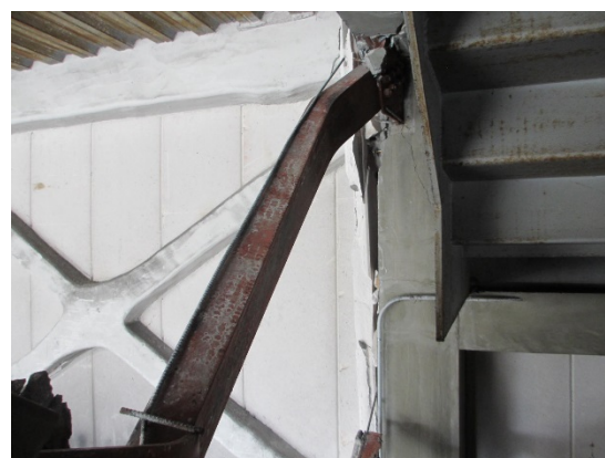
写真 5.4-193 溝形鋼ブレース端部の座屈
