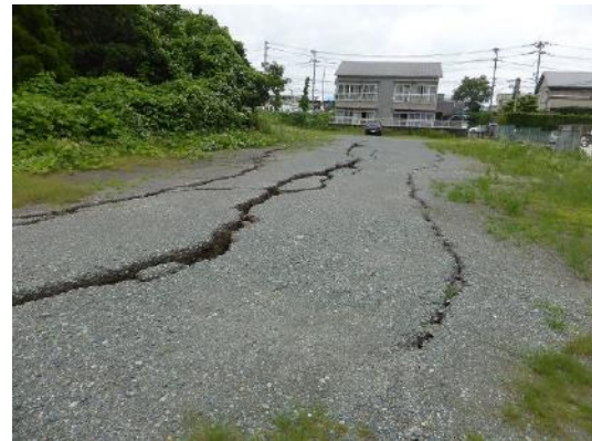
写真5.5-87 周辺地盤の地割れ
