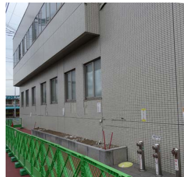
写真5.5-106 外壁タイルの剥落 （管理棟南側）
