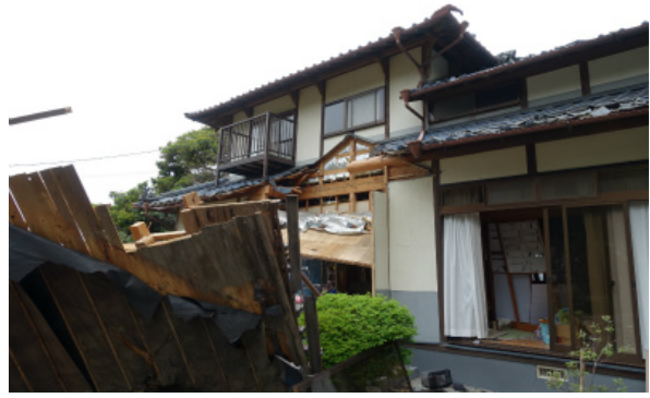
写真 5.3-29 玄関部分が部分破壊した木造住宅
