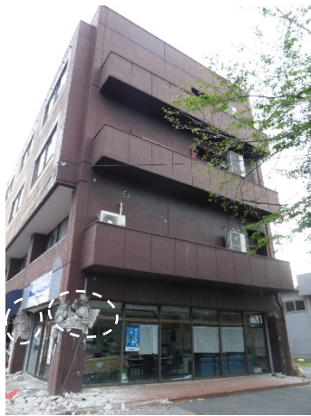
写真5.5-254 外観 (南東側) と大破した 2 本の柱
