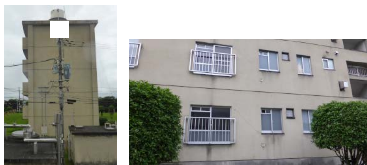
(a) 建築物東面 (b) 建築物北面 方立て壁のせん断ひび割れ
