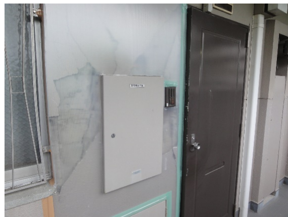
写真 5.8.2-66 方立て壁のせん断被害（等級IV）（RC造、熊本市中央区）
