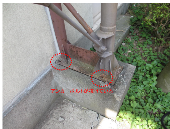
写真 5. 4-150 柱脚のアンカーボルトの破断
