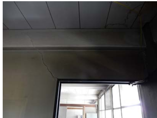
写真5.5-272 開口隅角部におけるひび割れ
