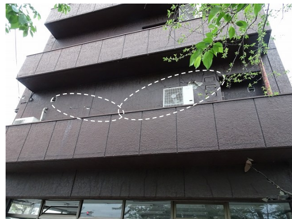
写真5.5-255 耐力壁のせん断ひび割れ (東側)
