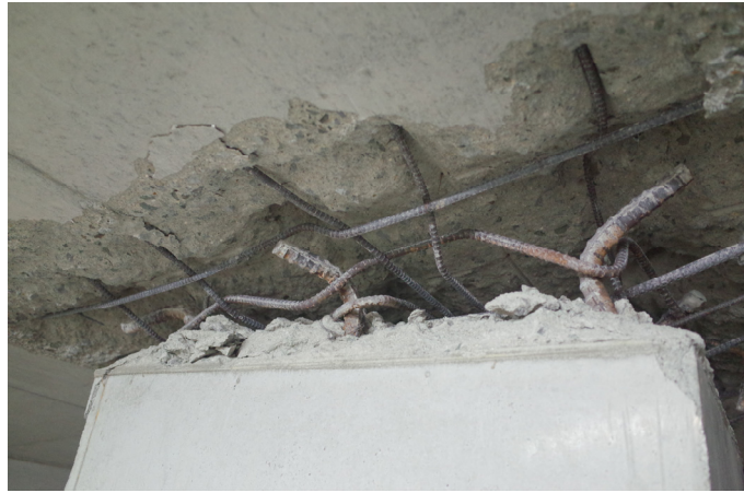
写真 5. 7. 2-50 鉛ダンパー取付け基部の損傷
