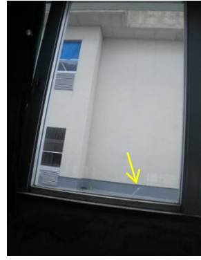
写真 5. 8. 2-92 開口部ガラス破損箇所
