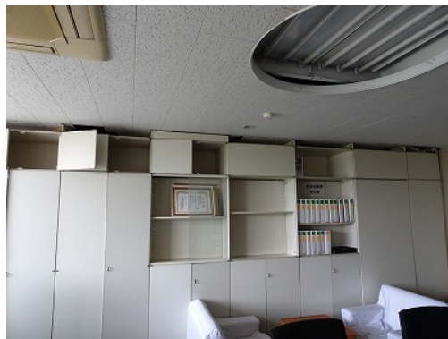
写真5.5-169 什器天端の天井材の被害
