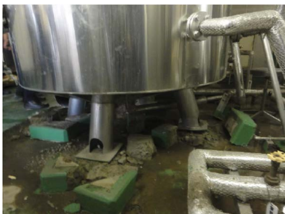
写真 5.8.3-9 機械室内貯湯槽の基礎部の損傷
