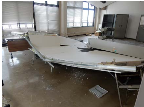
写真5.5-181 間仕切り壁の転倒
