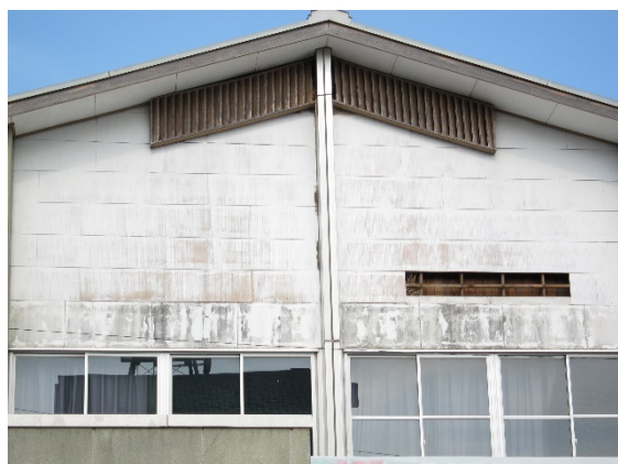
写真 5.4-136 妻面の外装材の脱落
