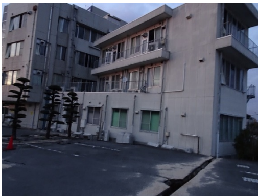
写真5.5-260 地盤の亀裂と液状化噴砂現象の痕跡
