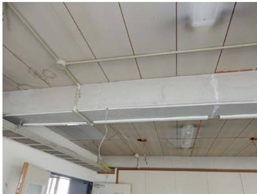
写真5.5-273 大梁のスパン中央付近のひび割れ
