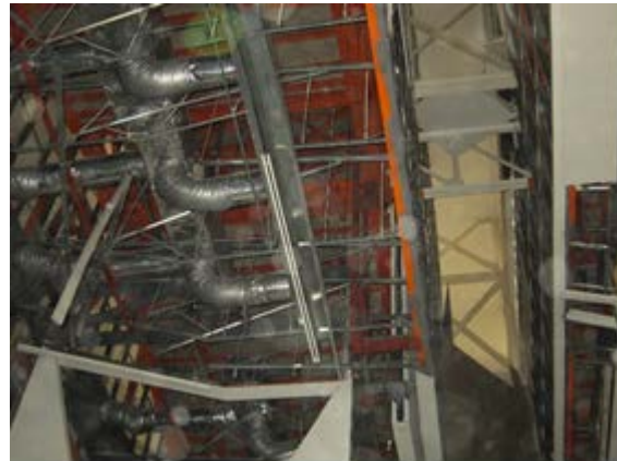
写真5.8.2-12 天井裏の状況（天井脱落箇所）
