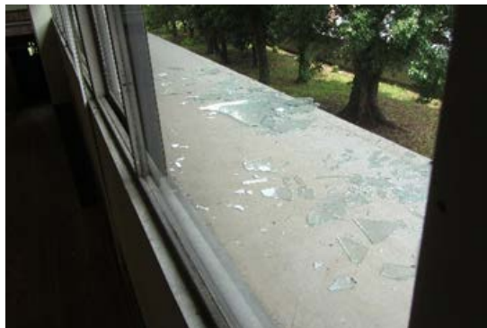
写真 5.8.2-30 剣道場ガラス破損
