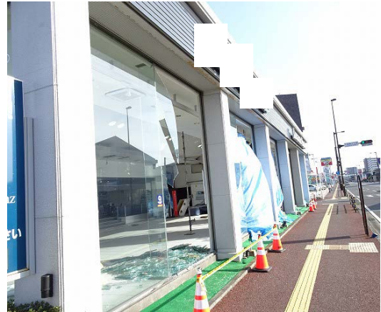
写真5.5-216 隣接店舗はガラス破損のみ
