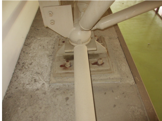
写真 5.4-187 体育館Nの桁行き構面の屋根支承部（長孔の端までボルトが移動）
