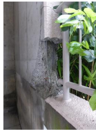
写真5.5-72 駐車場の桁行方向非構造壁の損傷
