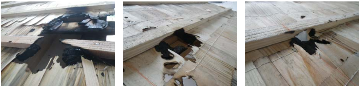
写真 5.3.6 瓦棧付近で燃え抜けた例
