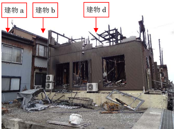
写真 3.3.9.2 建物 d の 1 階外壁の燃え残り
