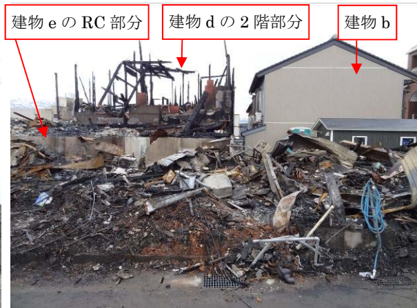
写真 3.3.9.3 建物 b 北側の火災跡と外壁面
