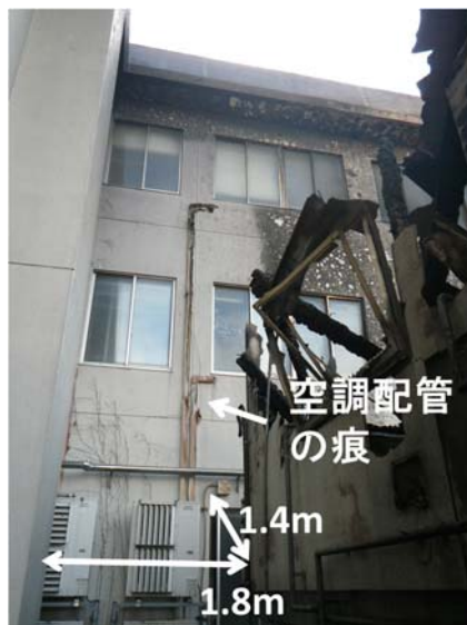
写真 3.3.3.2 北側外壁の様子 (配管の焼失と貫通部の露出 屋根軒先までの加熱痕)
