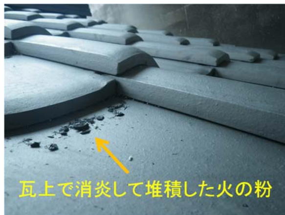
写真 5.3.6 瓦上部で消炎して堆積した火の粉
