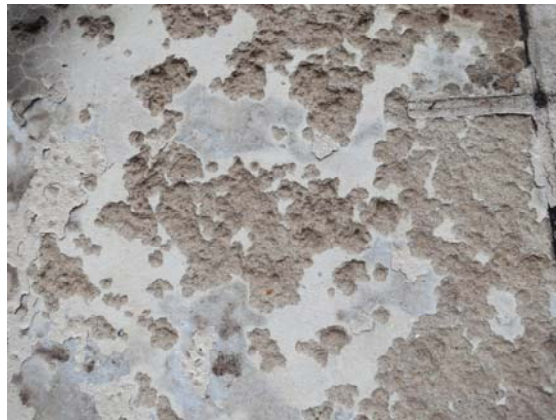
写真 3.3.17.4 爆裂した外壁の様子
