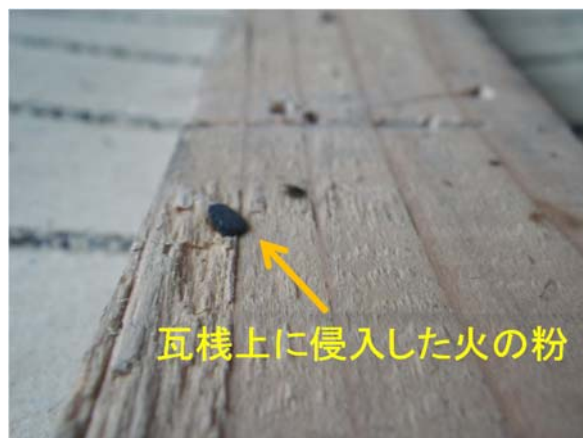
写真 5.3.8 屋根下地で確認された火の粉
