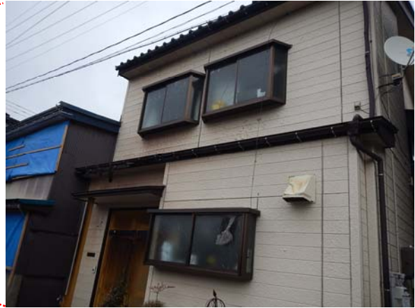
写真 3.2.3.7 東 5 焼け止まり線の開口部等 の損傷状況
