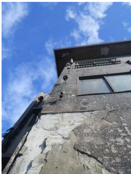
写真 3.3.3.1 西側外壁の様子 (モルタル表層剥離 雨樋溶融)
