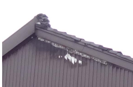
写真 3.3.6.2 西妻面の様子
