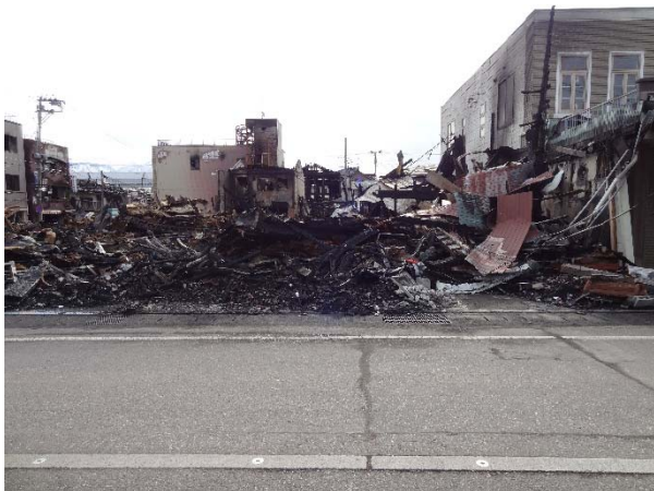
写真 3.2.2.7 西4焼け止まり線 (④金融機関建物 東壁面)
