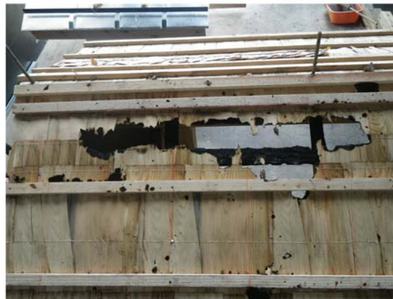
写真 5.3.5 棟部で屋根下地（巻木端）が燃え抜けた例
