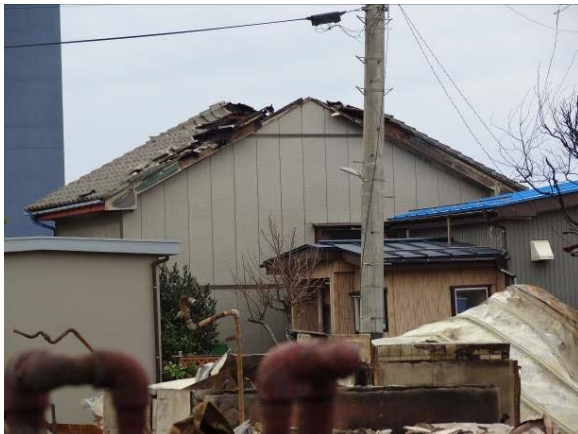
写真 3.3.15.3 飛び火によるとみられる屋根の損傷 (南東側から)
