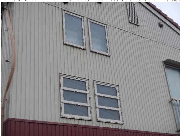
写真 3.3.12.3 網入りガラスの亀裂
