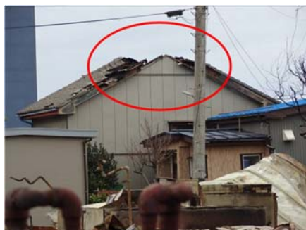
写真 5.1.1 瓦屋根への飛び火の事例
