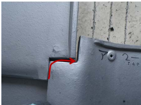
写真 5.3.7 火の粉の侵入経路
