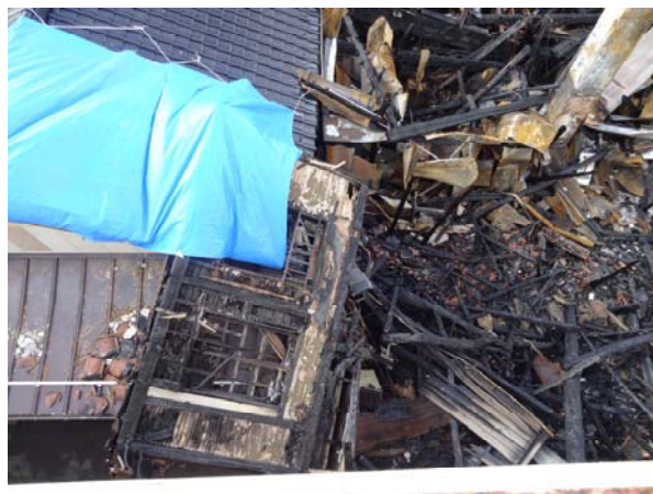
写真 3.2.1.5 南 3 焼け止まり線の様子 (写真 3.2.1.4 の手前部分を撮影)
