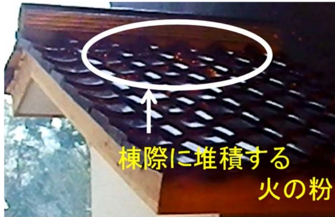
写真 5.3.3 棟際に堆積する火の粉
