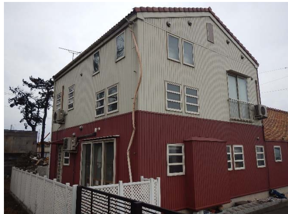
写真 3.3.12.2 戸建住宅の南東側の状況
