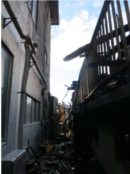
写真 3.2.1.6 南 4 焼け止まり線の様子 (東→西)
