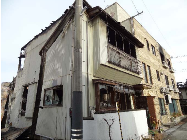
写真 3.2.2.5 西3焼け止まり線の様子
