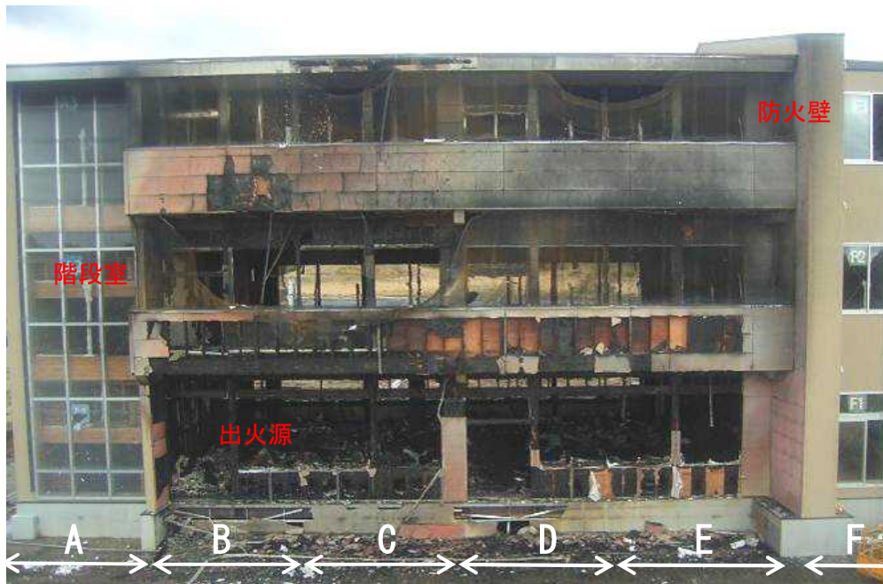
写真 3.7.7-6 実験後の実験建物（南面）
