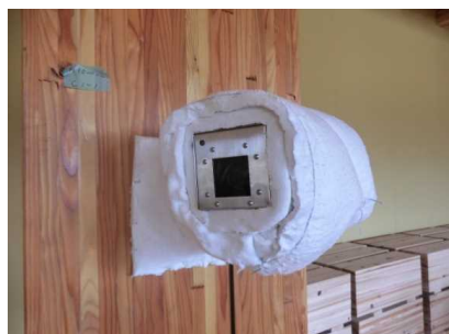
写真 3.5.2-1 建物内撮影用 CCD カメラ (耐熱加工したもの)
