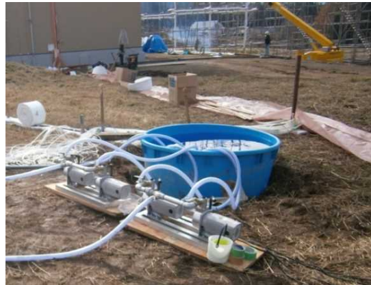
b) 配管設備
