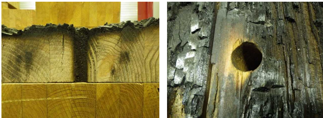
写真 3.7.7-38 ドリフトピン周りの状況
