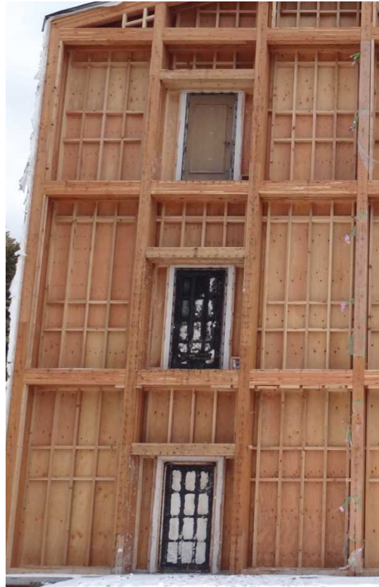
写真 3.7.7-25 防火壁防火戸の残存状況
