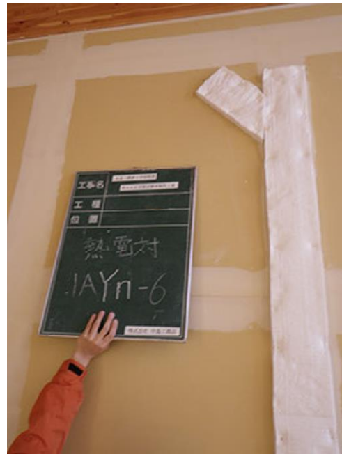
写真 3.5.3-4 熱電対の配線状況
