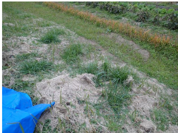
写真-5. 2. 18. 27 阿武隈川下流右岸 32. 4KP 法面の陥没
