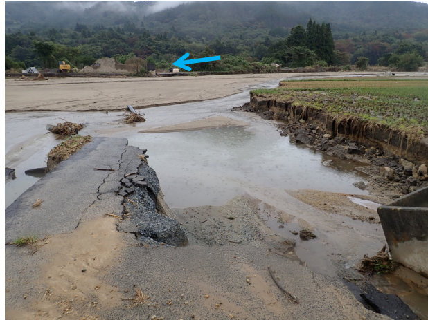
写真-5.2.10.10 道路が崩壊
