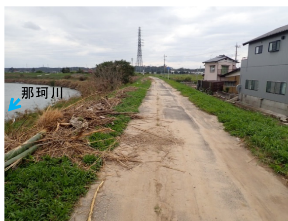
写真-5.2.7.8 堤防天端越流痕跡と漂流物
