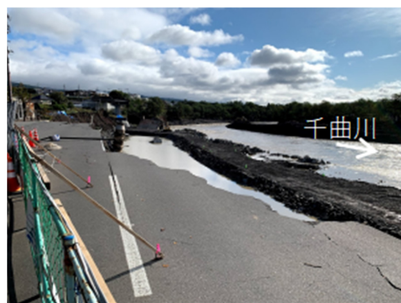
写真-5.2.9.2 崩壊した東御市道（白鳥神社線）上から被災箇所を望む
