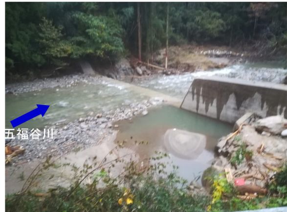
写真-5.2.10.14 満砂状態の砂防堰堤
