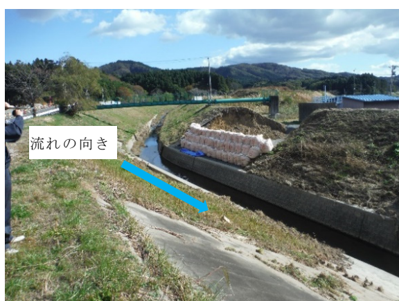
写真-5.2.17.20 決壊箇所
