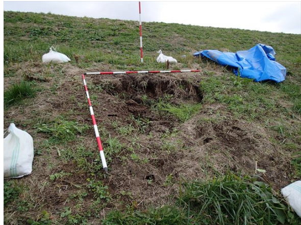
写真-5. 2. 18. 25 阿武隈川下流右岸 32. 4KP 法面の陥没
