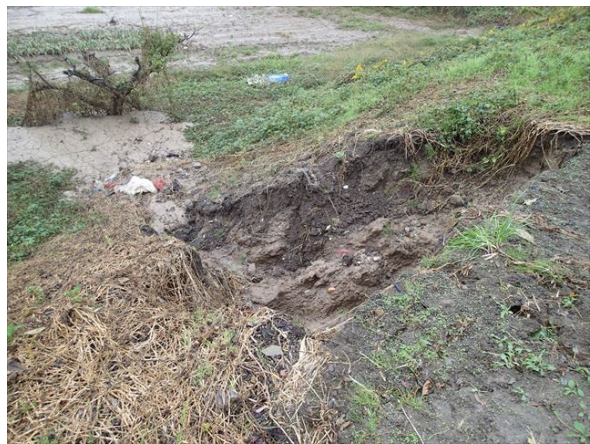
写真-5.2.5.34 谷田川 裏法面の侵食
