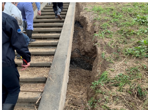
写真-5.2.3.13 小剣樋管階段脇の堤体侵食
