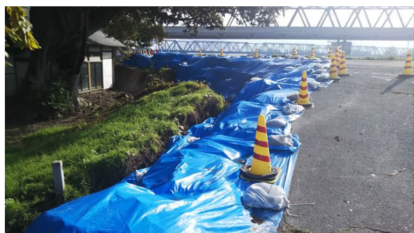
写真-5.2.13.17 千曲川左岸 79.0KP 裏法肩侵食
