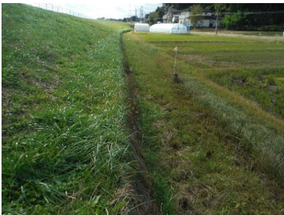
写真-5.2.17.3 阿武隈川下流左岸17.2KP (泥濘化・排水不良)
