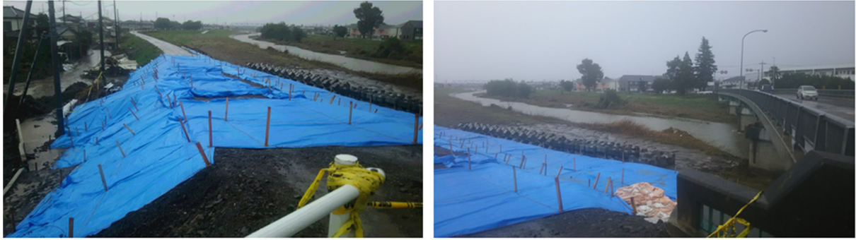
写真-5.2.8.2 秋山川右岸海陸橋上流被災状況
