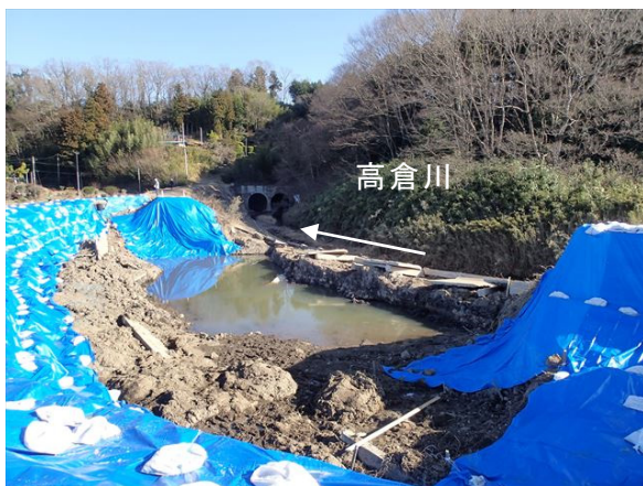
写真-5.2.19.1 高倉川左岸決壊箇所
