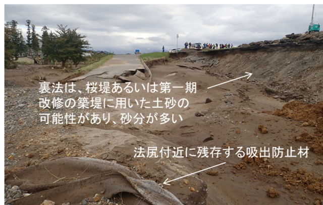
写真-5.2.1.5 決壊地点下流法尻
