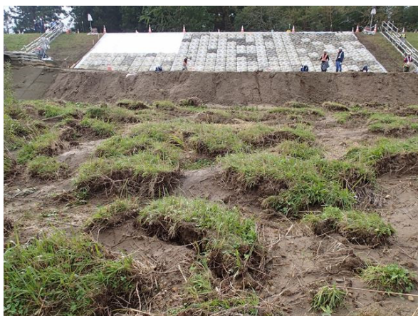
写真-5.2.5.13 鳴瀬川右岸 38.1、38.3KP 崩壊土堆積状況
