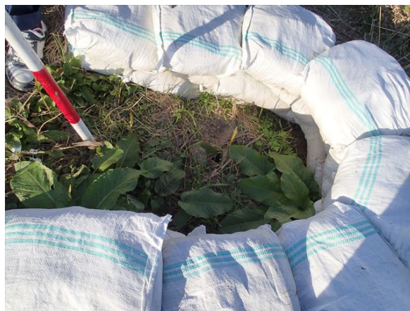
写真-5.2.18.21 阿武隈川下流右岸 30.0KP 月の輪内の噴砂
