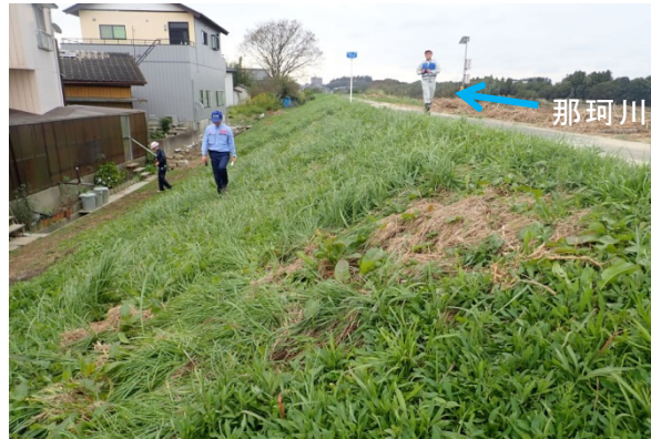
写真-5.2.7.9 川裏法面侵食状況
