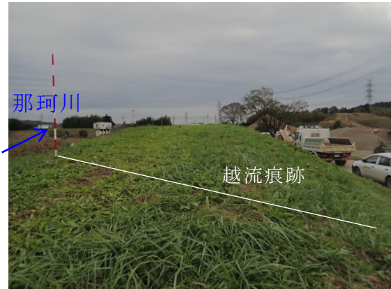
写真-5.2.4.4 決壊箇所下流部より下流を望む
