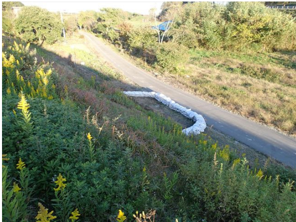
写真-5.2.18.13 阿武隈川下流右岸 13.3KP 月の輪工
