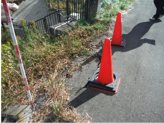
写真-5. 2. 17. 22 法肩の陥没
