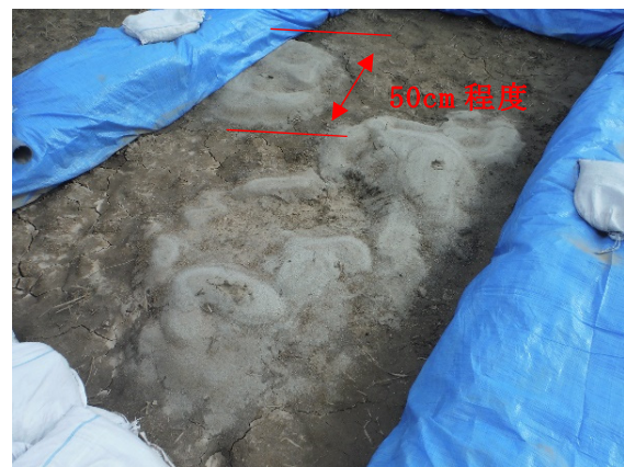
写真-5.2.17.9 阿武隈川下流左岸 18.0KP (漏水口)
