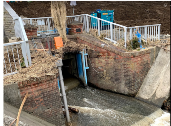
写真-5.2.3.11 決壊箇所直下流にある小剣樋管
