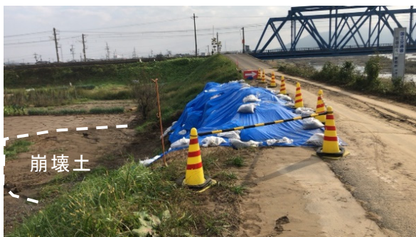
写真-5.2.13.14 千曲川左岸 79.0KP 川裏法崩れ
