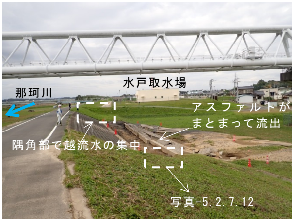
写真-5.2.7.10 水管橋条件護岸の被災状況 那珂川左岸 19.3KP 下流から
