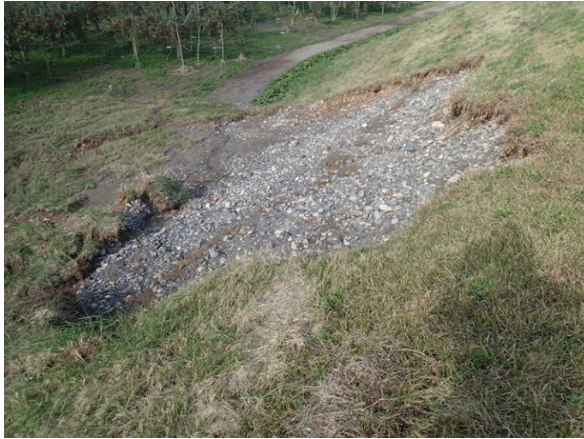
写真-5.2.13.7 千曲川左岸 57.0KP 法すべりの状況
