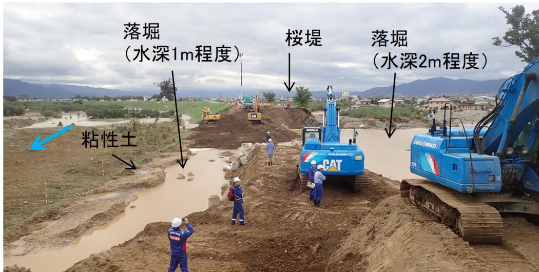
写真-5.2.1.1 決壊地点全景（下流から）
