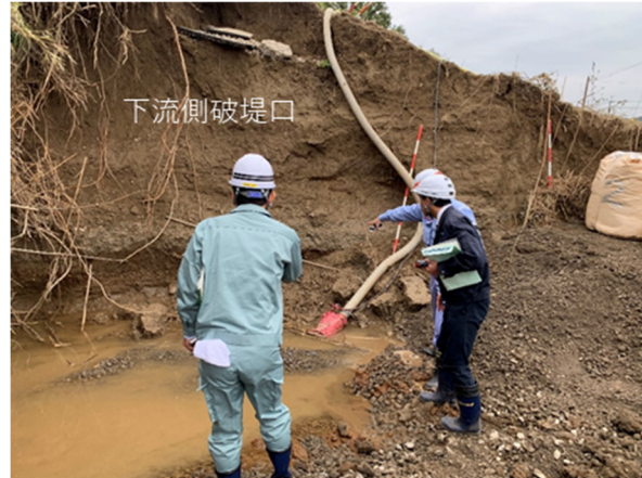
写真-5.2.3.16 堤体底面の砂礫層からの湧水
