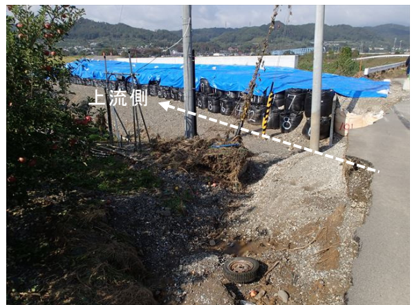
写真-5.2.13.4 千曲川右岸 49.0KP 応急措置の大型土のう
