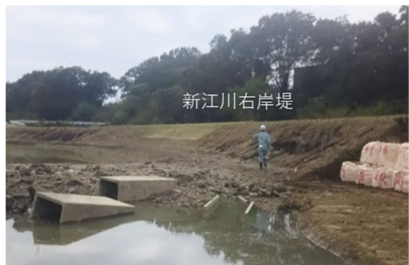
写真-5.2.3.18 決壊箇所上流側裏法面
