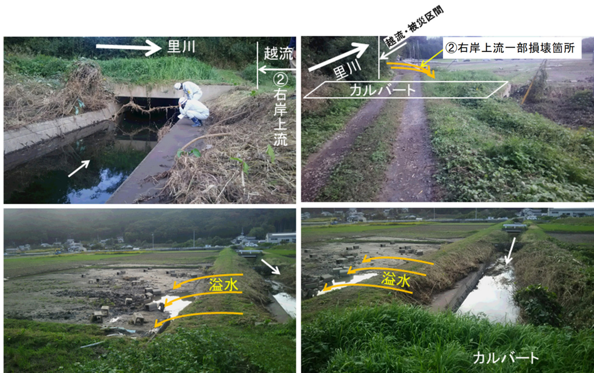
写真-5.2.6.14 ②右岸上流一部損壊と越流区間上流端カルバート付近の状況
