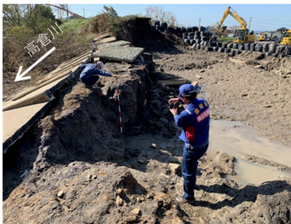
写真-5. 2. 12. 18 高倉川決壊口に残存する堤防表法面基部
