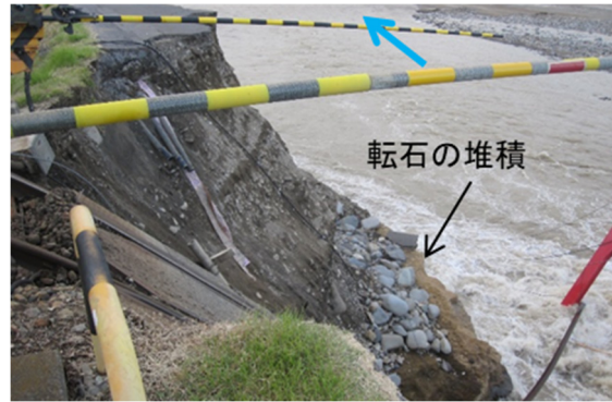
写真-5.2.1.13 上田電鉄橋梁橋台流出箇所
