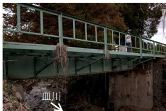
写真-5.2.9.8 決壊箇所直上流の JR 橋梁
