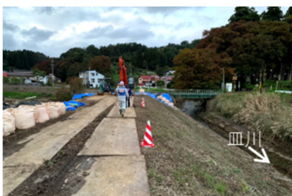
写真-5.2.9.7 決壊箇所を下流から望む
