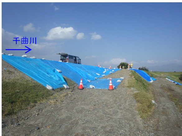
写真-5.2.13.10 千曲川右岸 56.5KP 川裏法面越流侵食箇所
