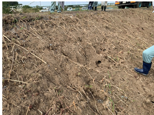
写真-5.2.3.20 侵食された裏法面
