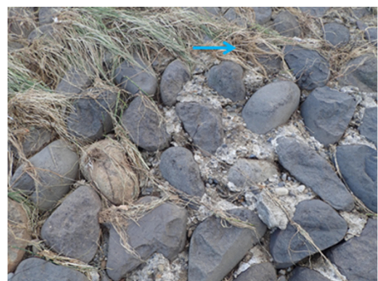
写真-5.2.1.11 欠損箇所上流護岸
