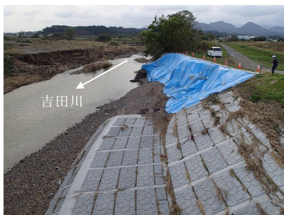
写真-5.2.5.15 吉田川左岸 31.0KP 付近 堤防の侵食状況
