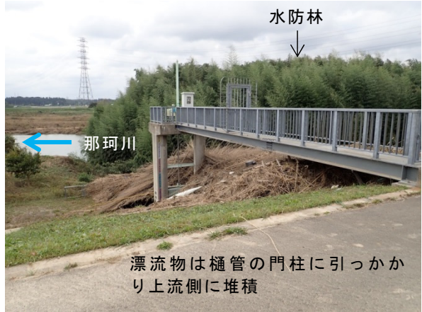
写真-5.2.7.18 漂流物堆積状況 那珂川左岸 19.8KP 天端から
