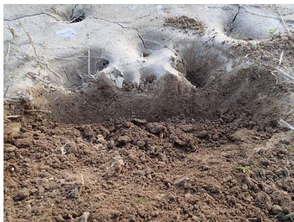
写真-5.2.18.23 阿武隈川下流右岸 30.0KP 窪み断面
