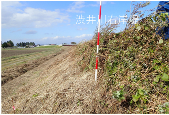
写真-5.2.12.3 渋井川 a 地点決壊箇所近傍 上流の堤体すべり
