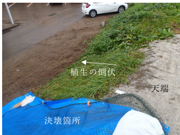
写真-5.2.5.32 濁川 越水痕
