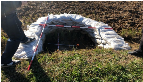
写真-5.2.18.7 阿武隈川下流右岸 5.4KP 月の輪工
