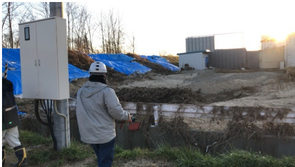
写真-5.2.19.11 谷田川左岸 決壊箇所上流側裏法
