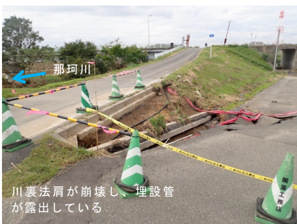
写真-5.2.7.13 取付道路の被災状況 那珂川左岸 19.5KP 下流から
