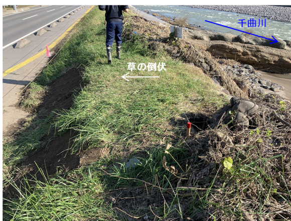
写真-5.2.13.20 千曲川右岸 107.0KP 天端・裏法越流侵食状況
