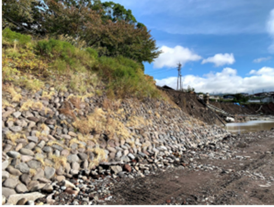
写真-5.2.9.3 残存した護岸（写真左） と侵食区間（写真右）
