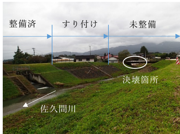
写真-5.2.5.28 佐久間川 決壊箇所と整備状況
