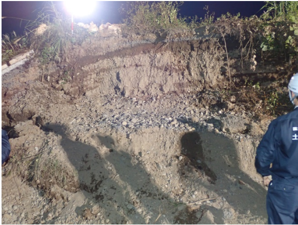
写真-5.2.4.25 決壊箇所堤防断面の観察
