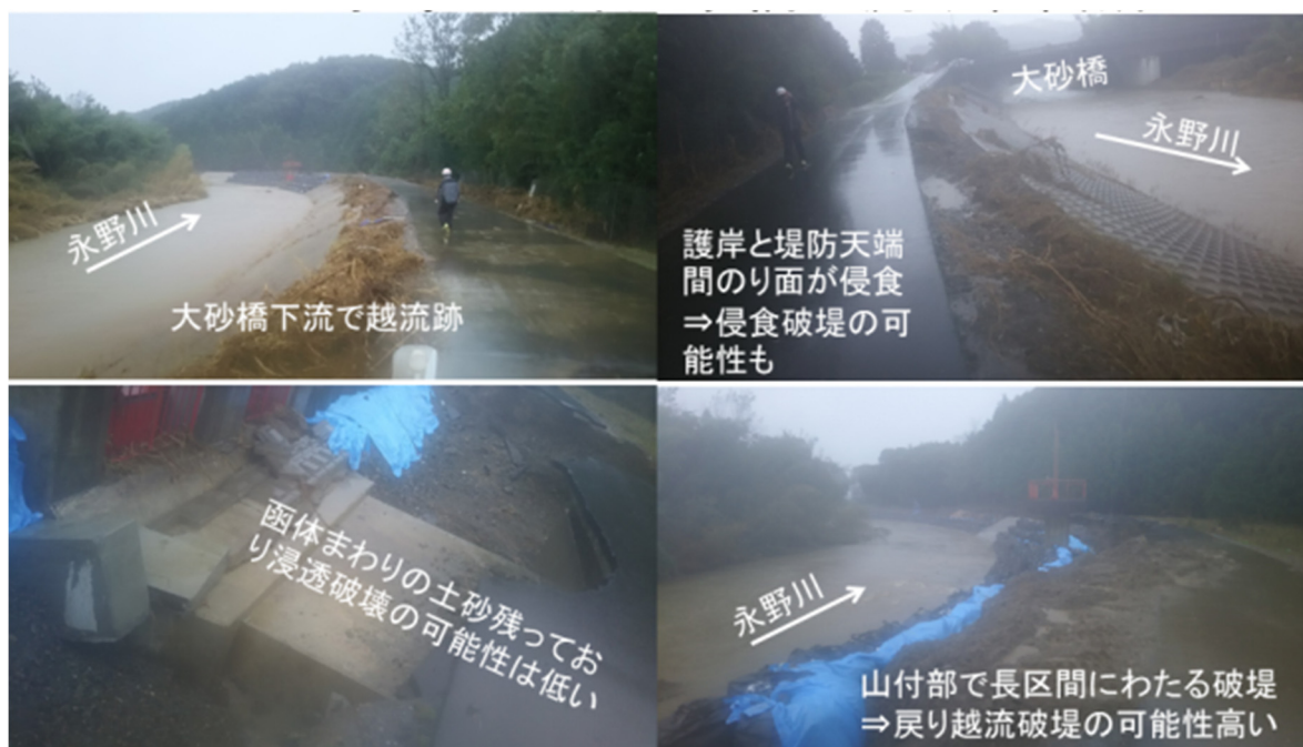
写真-5.2.8.4(2) 永野川右岸（大砂橋下流）現地調査時被災状況
