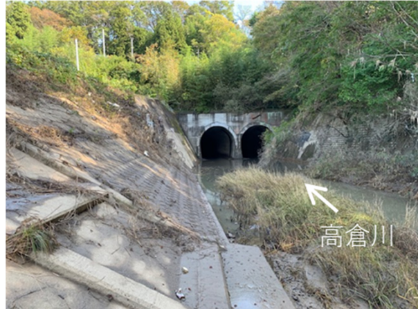
写真-5.2.12.20 決壊箇所下流のトンネル口
