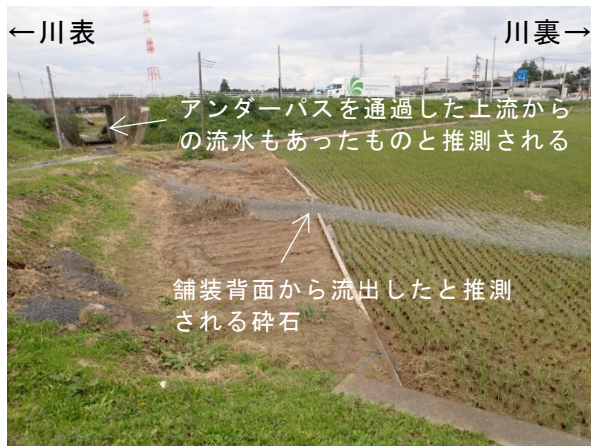
写真-5.2.7.15 碎石の流出状況 那珂川左岸 19.5KP 上流から
