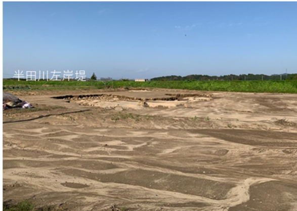
写真-5.2.12.23 決壊箇所より約 150m 上流 左岸の越水による堤防裏法面の侵食
