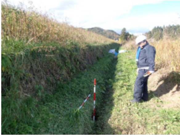
写真-5.2.18.28 阿武隈川下流左岸 36.6KP 被災箇所全景
