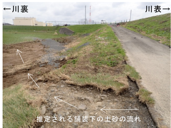
写真-5.2.7.16 舗装下の土砂の流れ（推定） 那珂川左岸 19.5KP 上流から
