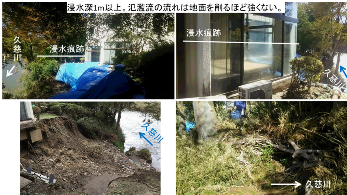
下には岩盤露出。岩盤の上で地下水しみ出し 下には岩盤露出。岩盤の上の河岸は一部侵食
