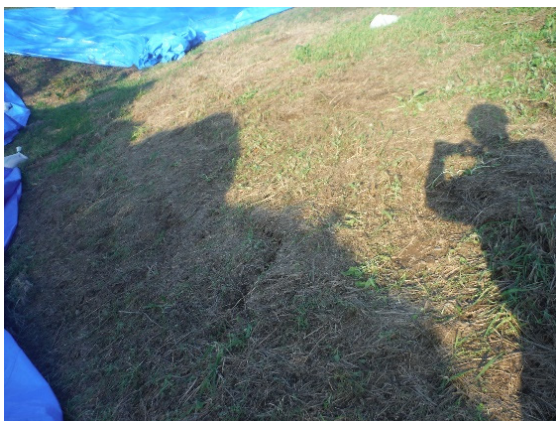
写真-5.2.17.18 阿武隈川上流左岸 10.7KP (阿武隈川上流左岸法面すべり)
