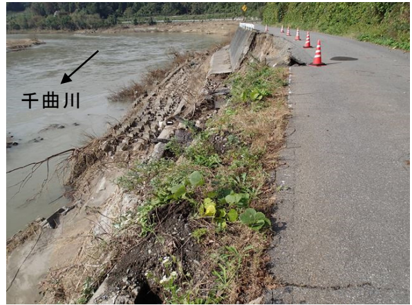
写真-5.2.13.2 千曲川左岸 40.0KP 崩壊箇所を下流から撮影
