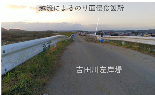
写真-5.2.12.15 吉田川左岸 15KP 堤防欠損箇所の天端を下流側から望む
