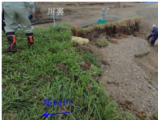
写真-5.2.4.5 決壊箇所下流部の侵食形状
