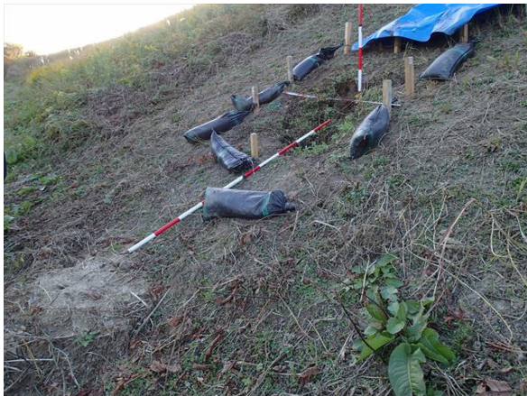
写真-5.2.18.9 阿武隈川下流右岸 13.2KP 法面陥没と噴砂
