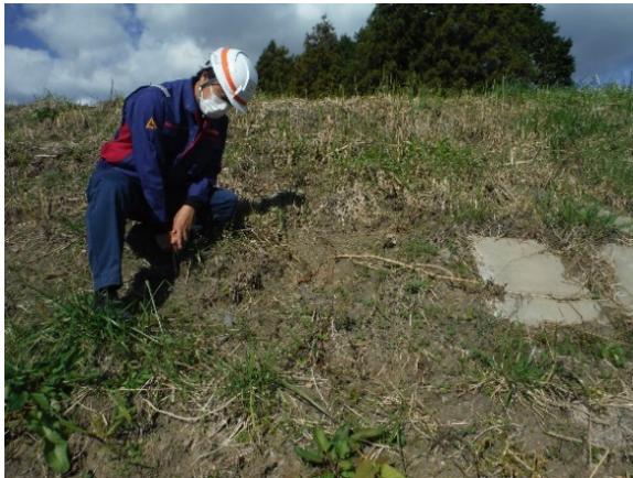
写真-5. 2. 17. 24 法肩の陥没
