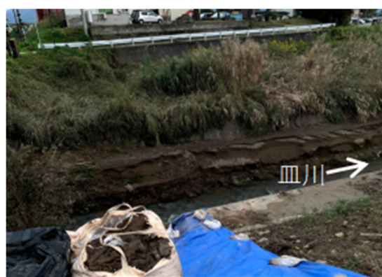
写真-5.2.9.10 応急復旧した堤防上から 河道を望む
