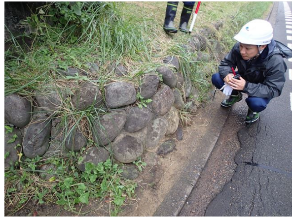
写真-5.2.11.4 信濃川右岸 15.3KP 石積みへの砂の付着
