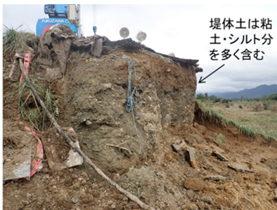
写真-5.2.1.4 決壊地点下流断面
