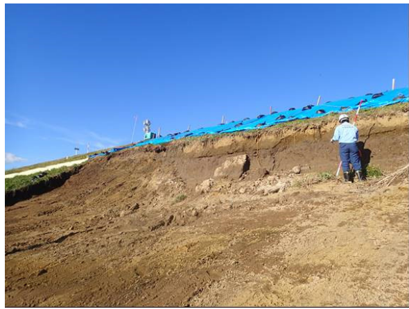
写真-5.2.5.8 鳴瀬川左岸 8.4～8.8KP 被災区間下流端滑落崖
