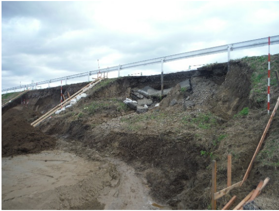
写真-5.2.17.1 阿武隈川下流左岸 17.2KP (法崩れ)
