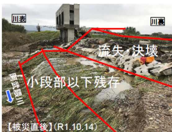
写真-5.2.2.2 決壊箇所（川表側より撮影） （出典：東北地方整備局 5) ）
