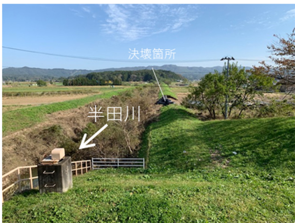
写真-5.2.12.21 決壊区間を下流（阿武隈川右岸堤上）から望む
