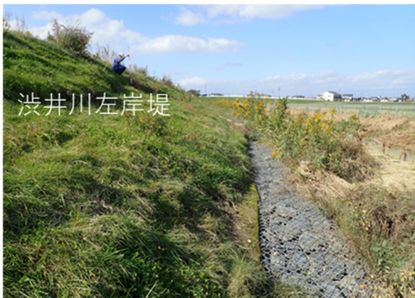
写真-5.2.12.5 渋井川 b 地点左岸裏法面 すべり発生状況
