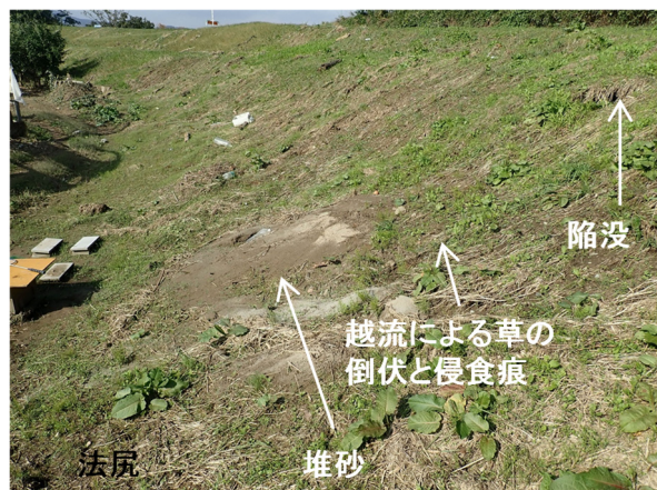
写真-5.2.13.9 松川（合流点付近） 越流侵食による堆砂状況
