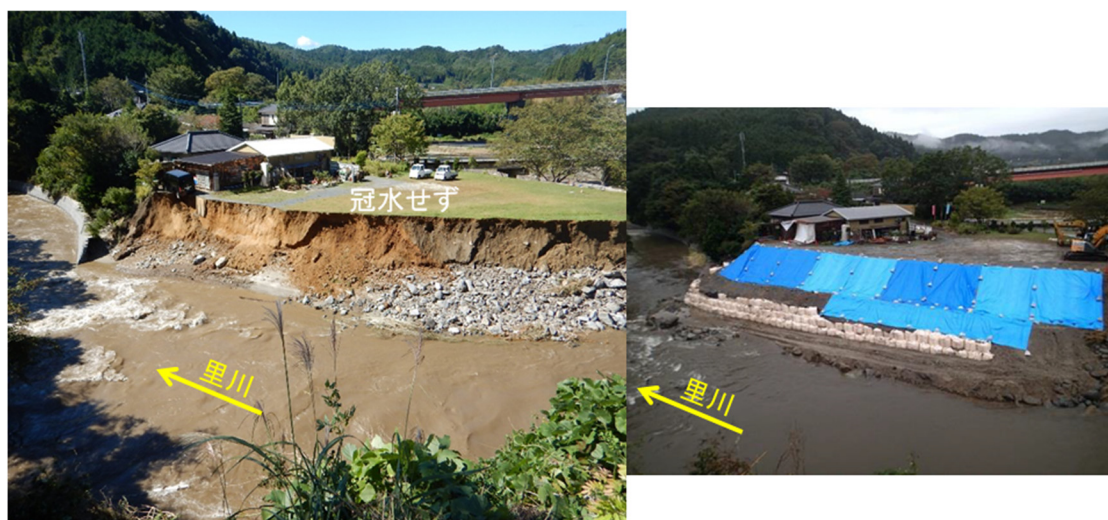
写真-5.2.6.6 応急復旧前後の状況（左写真は茨城県提供）
