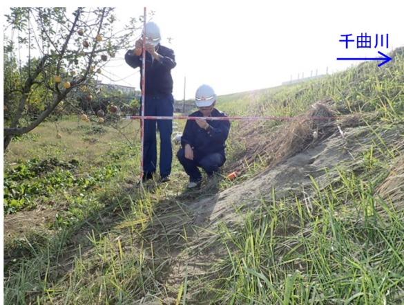
写真-5.2.13.12 千曲川右岸 56.5KP 堤内湛水と堆砂高さの関係
