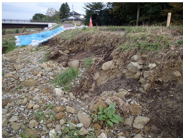
写真-5.2.5.18 吉田川右岸 31.0KP 付近 応急措置済み箇所の上流側
