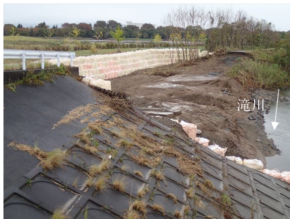
写真-5.2.5.24 滝川 決壊箇所
