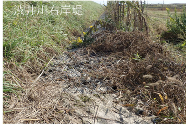
写真-5.2.12.4 渋井川 a 地点決壊箇所から 約 80m 下流の堤防法尻 (ドレーン)
