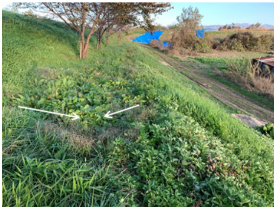
写真-5.2.17.16 阿武隈川上流左岸 10.7KP (佐久間川右岸小段の沈下)
