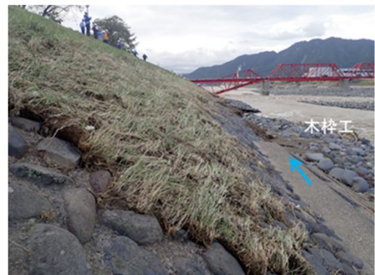
写真-5.2.1.10 欠損箇所上流護岸
