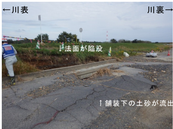
写真-5.2.7.23 堤防道路の被災状況 那珂川右岸20.5KP小段から
