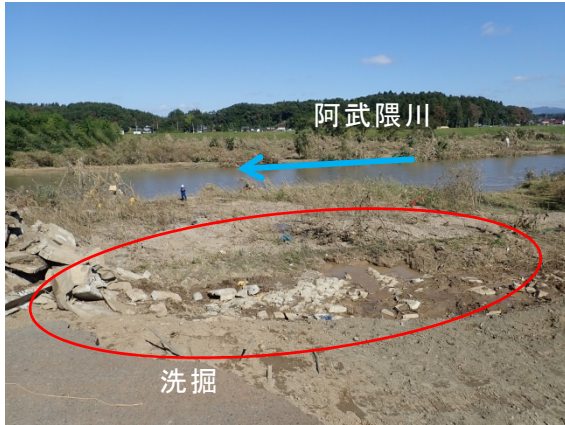
写真-5.2.2.3 川表側の洗掘状況
