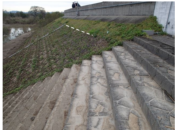
写真-5.2.11.6 信濃川右岸 15.3KP 痕跡水位
