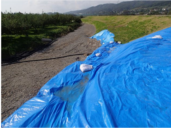
写真-5.2.13.5 千曲川右岸 49.0KP 被災区間川裏の状況
