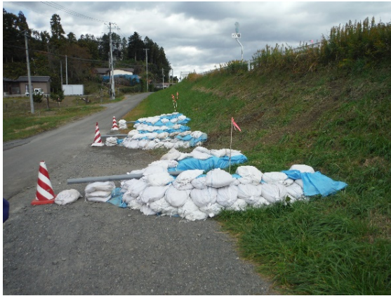
写真-5.2.17.6 阿武隈川下流左岸17.4KP (漏水箇所)
