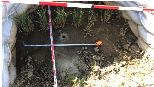
写真-5.2.18.8 阿武隈川下流右岸 5.4KP 月の輪内部の噴砂
