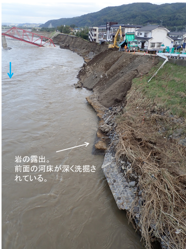
写真-5.2.1.9 欠損地点全景（下流から）
