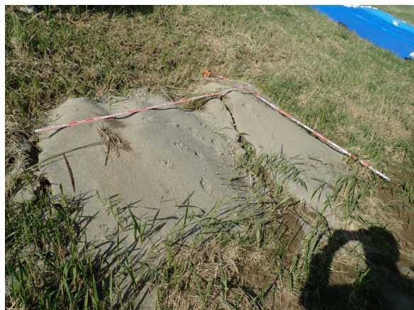
写真-5.2.13.11 千曲川右岸 56.5KP 川裏法面堆砂状況
