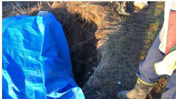
写真-5.2.19.12 谷田川左岸 決壊箇所上流側天端
