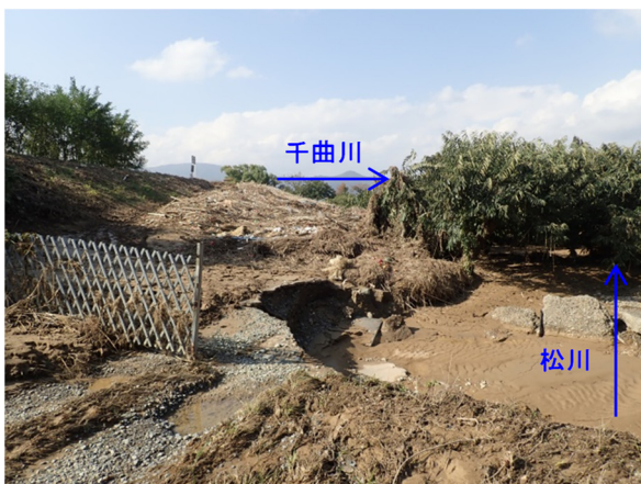
写真-5.2.13.8 松川（合流点付近） 河道内坂路侵食状況
