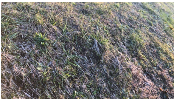
写真-5.2.19.13 谷田川左岸 決壊箇所上流側裏法越水痕
