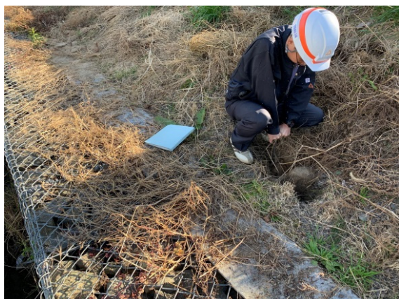
写真-5.2.17.10 阿武隈川下流右岸 32.0KP (陥没)
