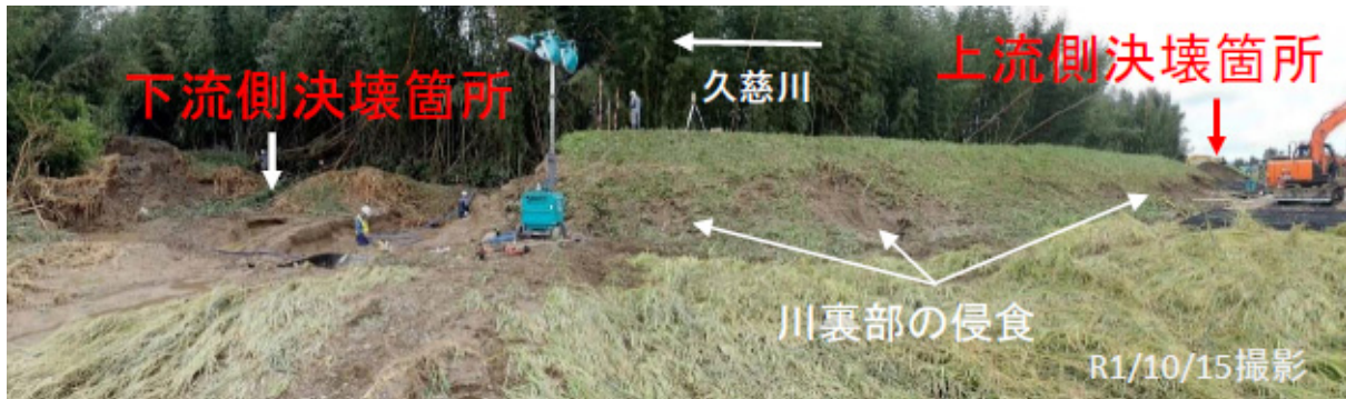
写真-5.2.4.24 被災状況（関東地方整備局 13) ）
