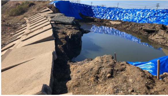
写真-5.2.19.3 高倉川左岸護岸と落堀
