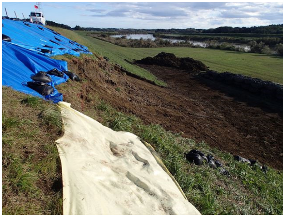
写真-5.2.5.7 鳴瀬川左岸 8.4～8.8KP 被災区間下流端全景
