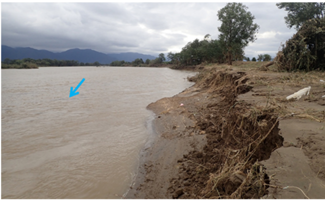
写真-5.2.1.8 低水路河岸（侵食状況）
