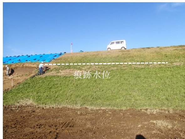
写真-5.2.5.10 鳴瀬川左岸 8.4～8.8KP 痕跡水位
