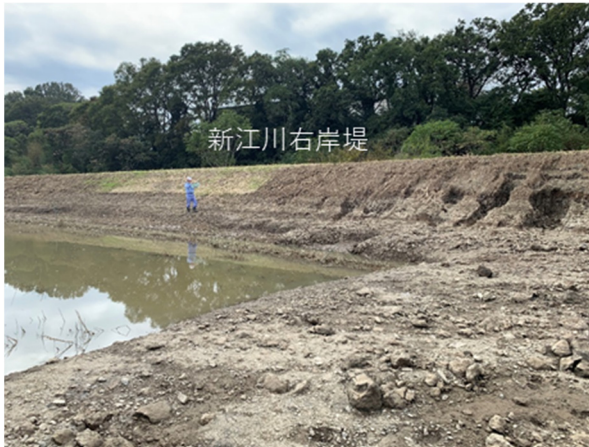
写真-5.2.3.19 決壊箇所の直上流の 堤防裏法面
