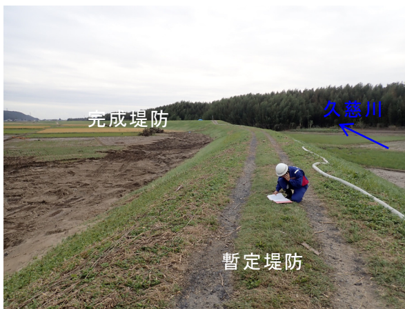
写真-5.2.4.17 決壊箇所下流天端状況
