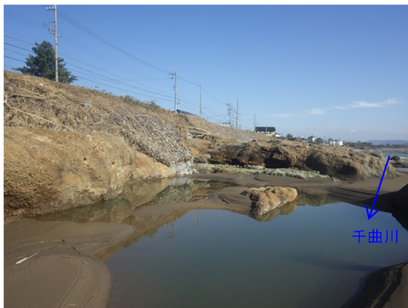
写真-5.2.13.18 千曲川右岸 107.0KP 川表侵食状況
