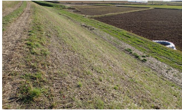
写真-5.2.18.6 阿武隈川下流右岸 5.4KP 川裏側の状況
