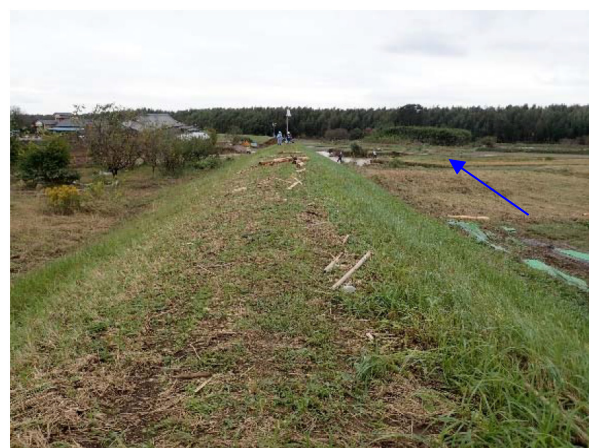
写真-5.2.4.18 堤防天端及び裏法の越流痕跡
