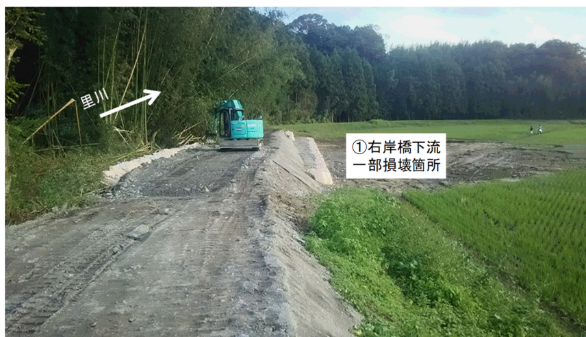
写真-5.2.6.15 ①右岸橋下流一部損壊箇所の状況
