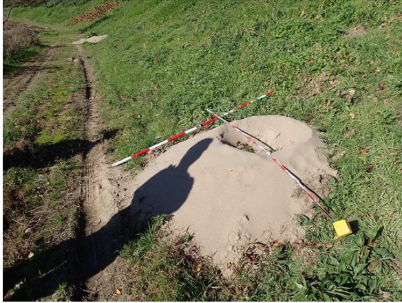
写真-5.2.18.36 阿武隈川上流左岸 10.7KP 佐久間川法尻の噴砂
