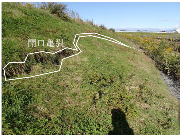
写真-5.2.5.23 渋井川右岸堤 ドレーン上部法面の変状
