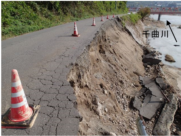
写真-5.2.13.1 千曲川左岸 40.0KP 崩壊箇所を上流から撮影
