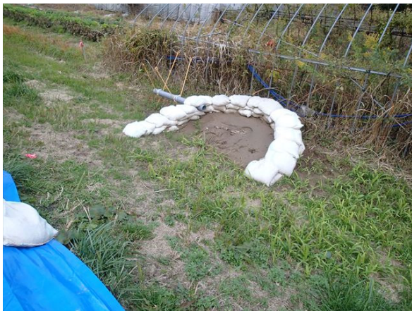
写真-5. 2. 18. 26 阿武隈川下流右岸 32. 4KP 被災箇所全景
