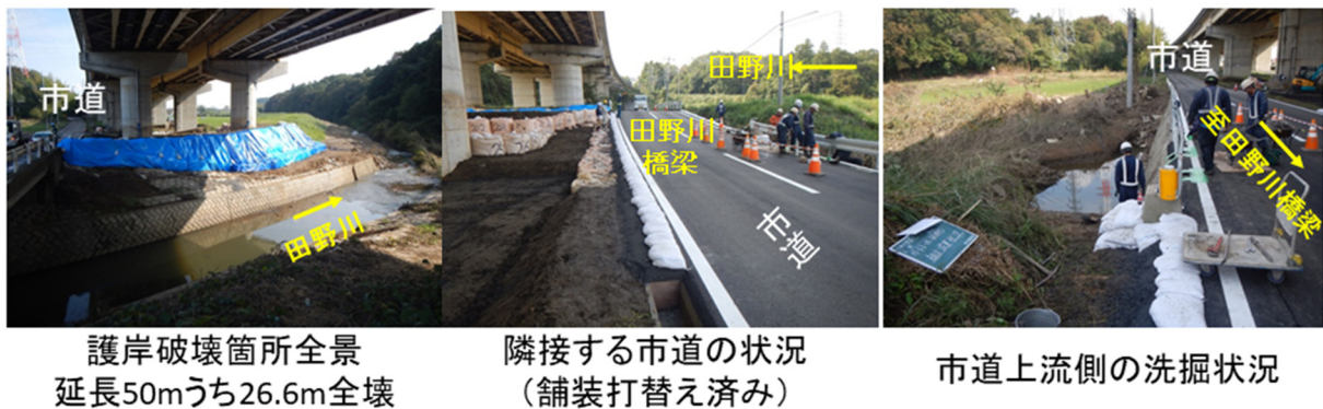
写真-5.2.14.3 ③田野川左岸被災状況
