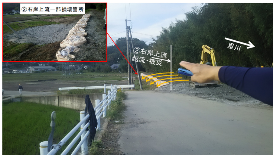
写真-5.2.6.13 ②右岸上流一部損壊箇所及び越流区間下流端
