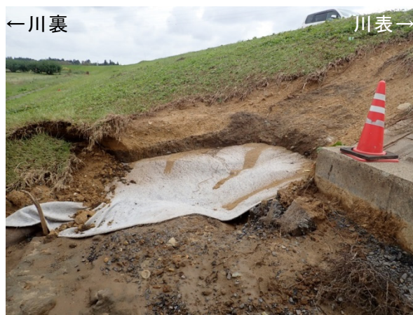
写真-5.2.7.12 侵食による吸出し防止シートの露出 那珂川左岸 19.3KP 上流から
