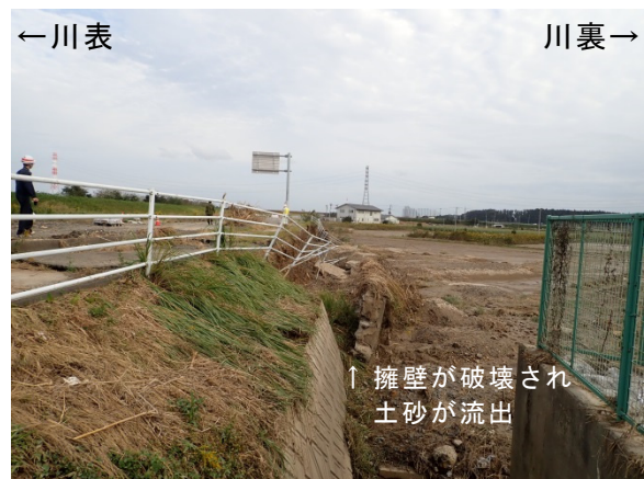
写真-5.2.7.24 法尻部の擁壁の被災状況 那珂川右岸20.5KP上流から
