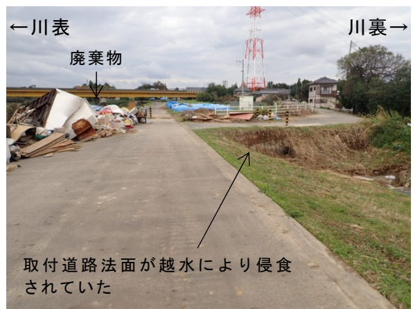
写真-5.2.7.20 取付道路法面の侵食状況 那珂川左岸 19.8KP 下流から
