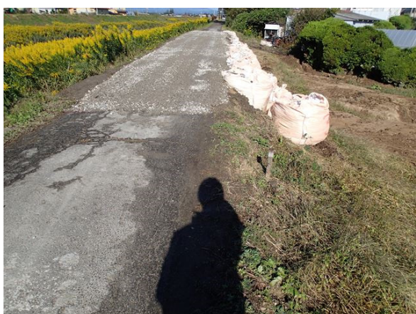
写真-5.2.5.21 渋井川左岸堤 越流侵食箇所の応急措置
