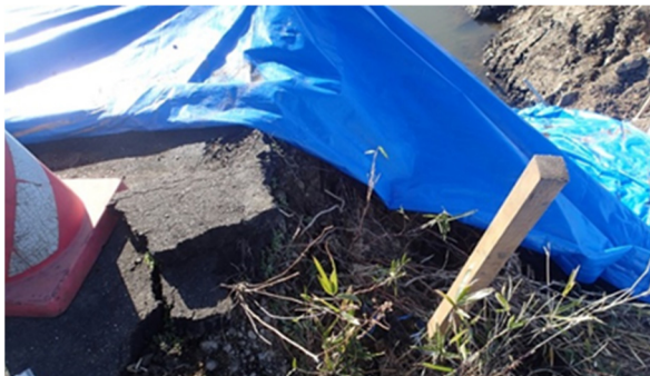
写真-5.2.19.7 高倉川左岸 決壊箇所下流堤防の法肩の侵食痕
