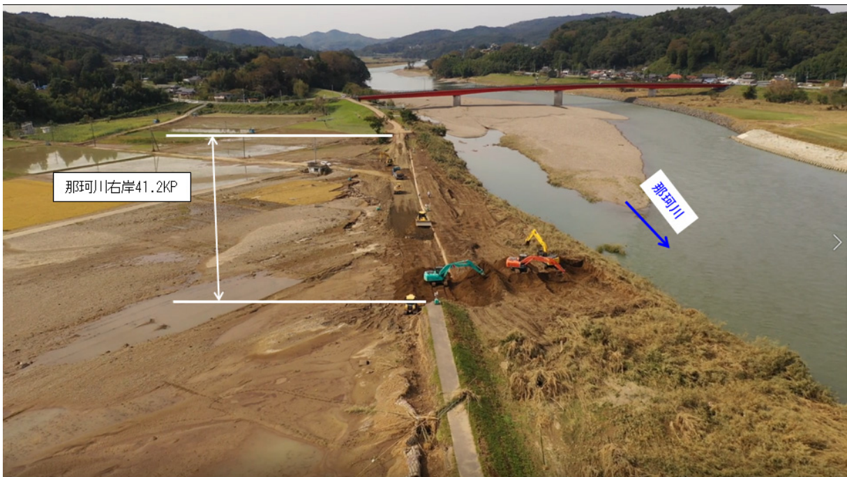
写真-5.2.4.13 決壊箇所下流の越流痕跡 (関東地方整備局 関東 River-SKY-i 15) )
