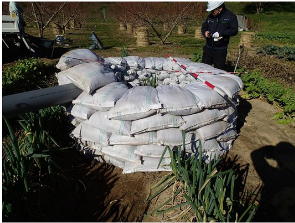
写真-5.2.18.38 阿武隈川上流左岸 10.7KP 釜段
