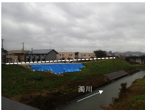
写真-5.2.5.31 濁川 決壊箇所
