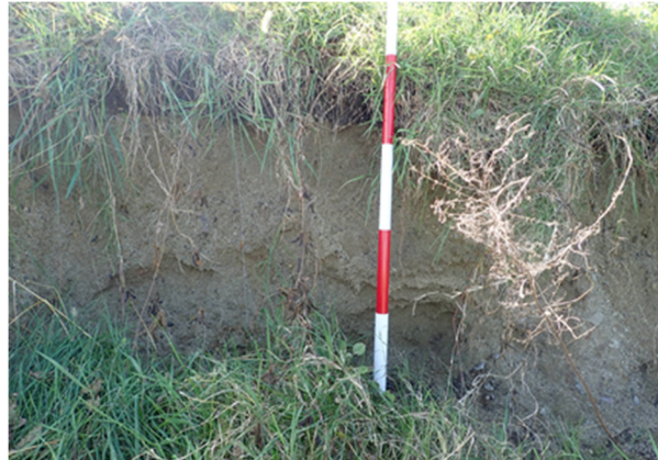
写真-5.2.12.6 渋井川 b 地点左岸裏法面 すべり上部の滑落崖
