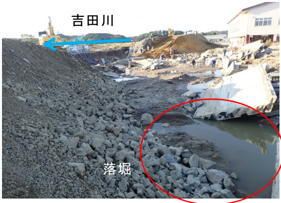
写真-5. 2. 2. 6 川裏側の落堀
