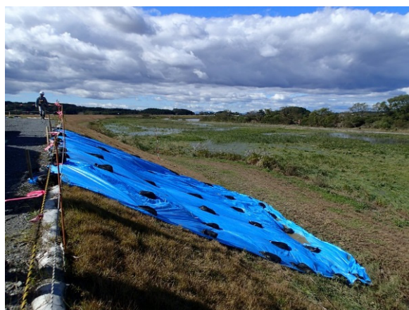
写真-5.2.5.4 江合川右岸 6.6KP 応急復旧状況(下流側)
