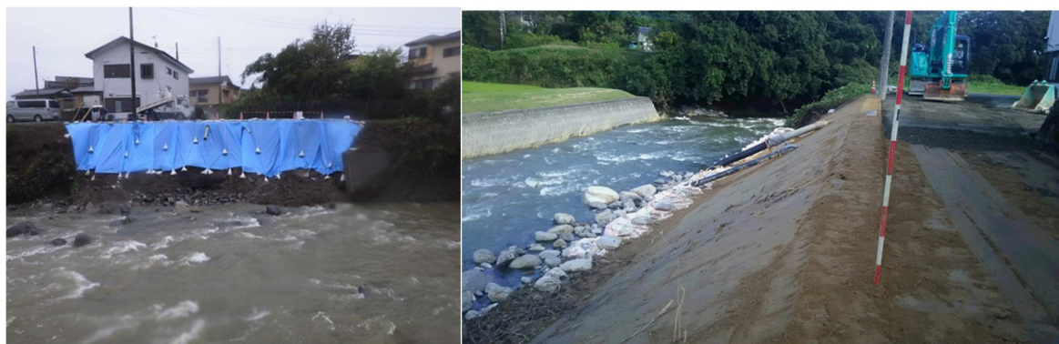
写真-5.2.6.4 応急復旧前の被災状況（左）（茨城県提供）と応急復旧状況（右）
