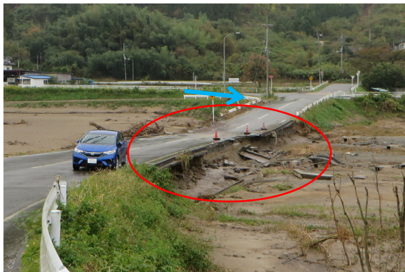
写真-5.2.10.11 道路の被災状況
