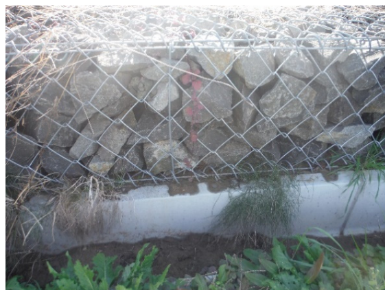
写真-5.2.17.11 阿武隈川下流右岸 32.0KP (ドレーン工内にたまった土砂)
