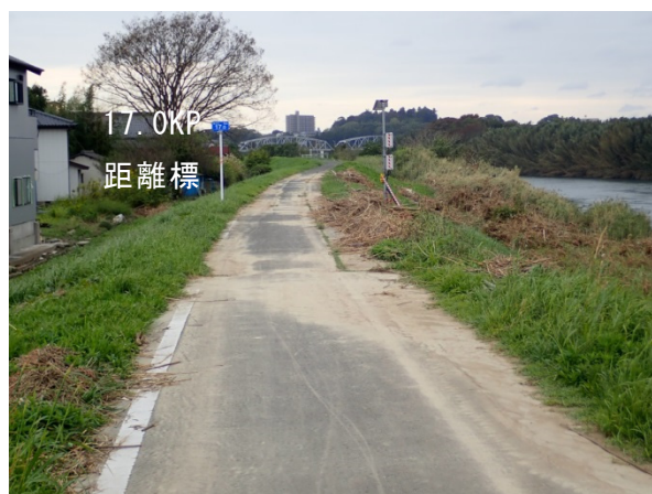
写真-5.2.7.7 堤防天端越流痕跡
