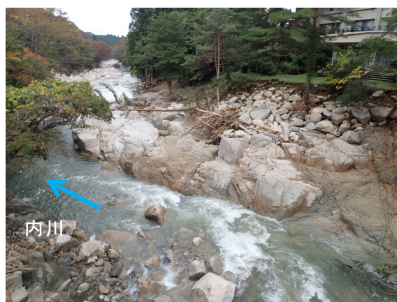
写真-5.2.10.3 細流橋下流の右岸が削られている様子
