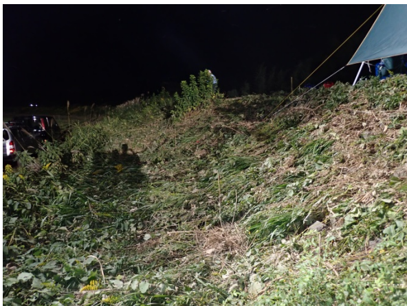
写真-5.2.4.28 周辺の裏法植生倒伏状況
