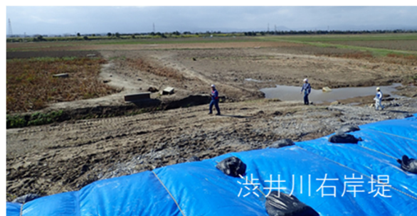
写真-5.2.12.2 渋井川 a 地点決壊箇所から 堤内地を望む
