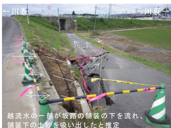
写真-5.2.7.14 越流水の浸透メカニズム (推定) 那珂川左岸 19.5KP 下流から
