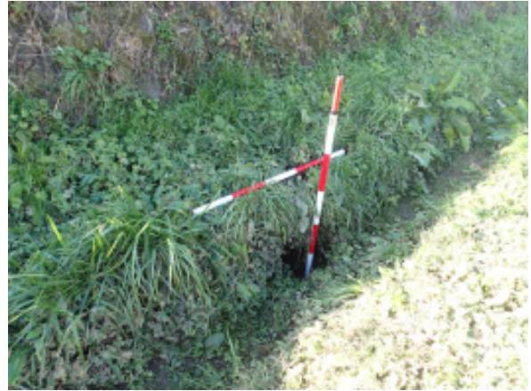
写真-5.2.18.29 阿武隈川下流左岸 36.6KP 堤脚水路脇の空洞
