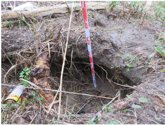
写真-5. 2. 10. 27 法面の陥没
