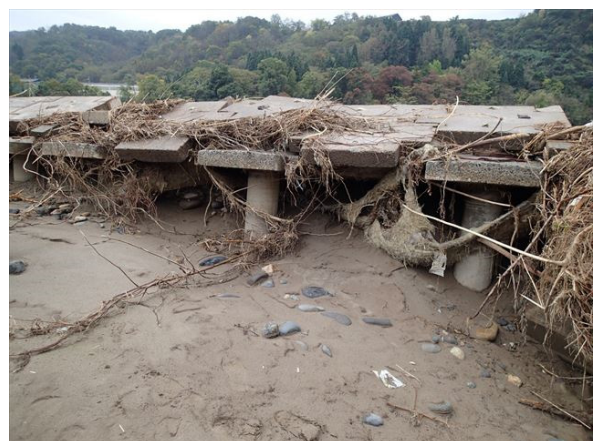
写真-5.2.11.10 信濃川右岸 37.0KP 変状の大きな護岸の状況
