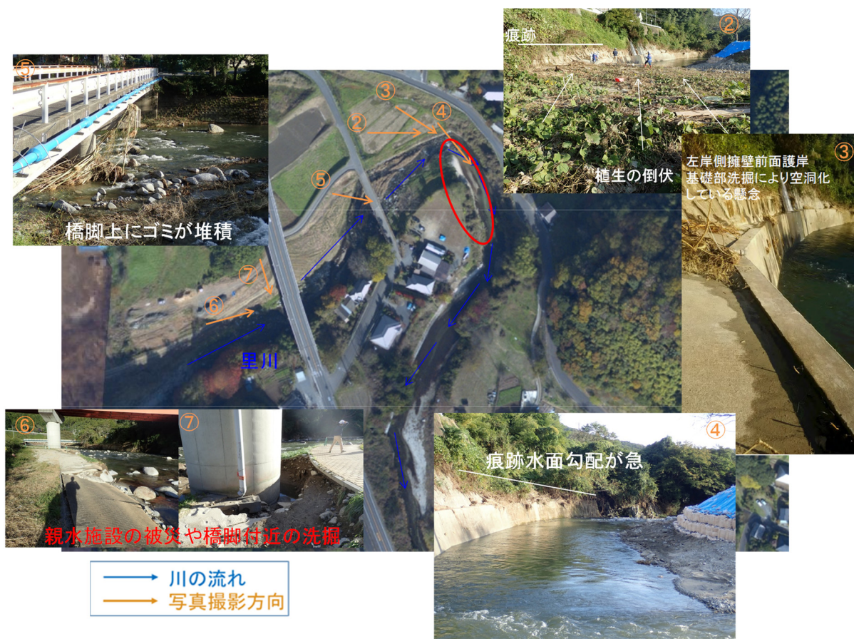
写真-5.2.6.7 被災箇所周辺状況（背景地図出典：国土地理院電子国土 Web）
