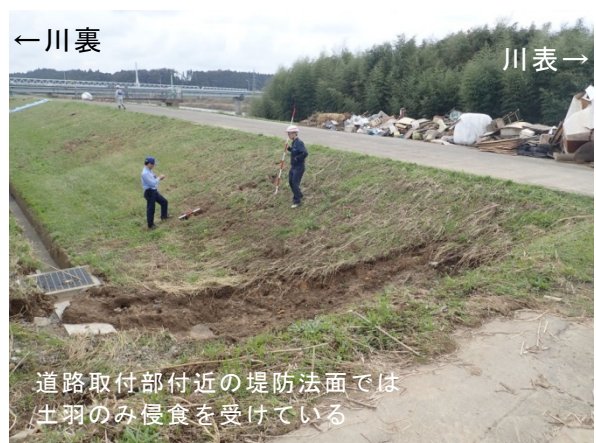
写真-5.2.7.22 道路取付部付近の被災状況 那珂川左岸 19.8KP 上流から
