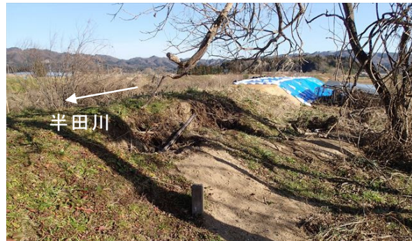
写真-5.2.19.8 半田川左岸決壊箇所
