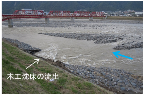
写真-5.2.1.12 欠損箇所上流木工沈床
