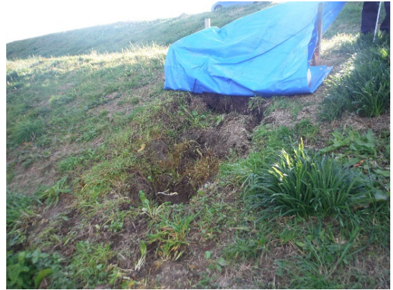
写真-5.2.17.13 阿武隈川下流右岸 32.4KP (陥没)
