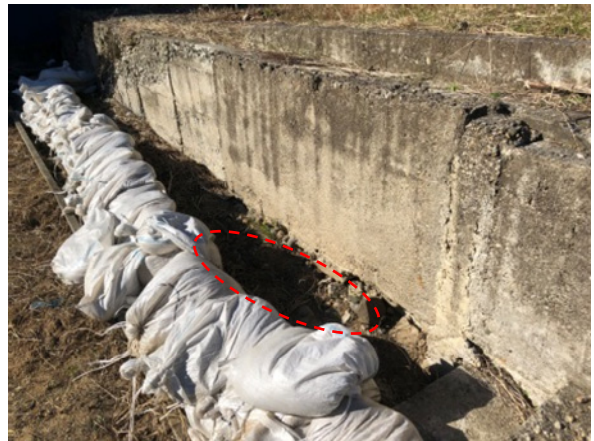
写真-5.2.18.41 荒川右岸 0.2KP 腰留め擁壁の損傷
