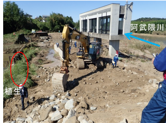
写真-5.2.2.4 川裏側の洗掘と周辺の植生
