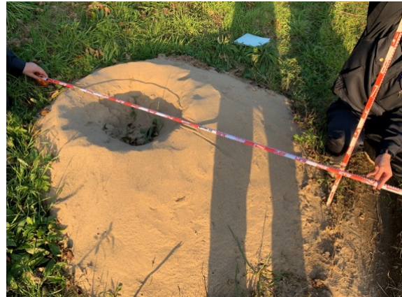
写真-5.2.17.15 阿武隈川上流左岸 10.7KP (漏水痕)
