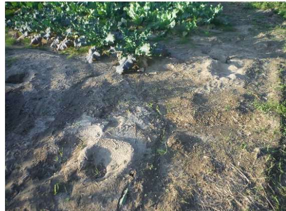
写真-5.2.17.19 阿武隈川上流左岸 10.7KP (耕作地内の漏水)
