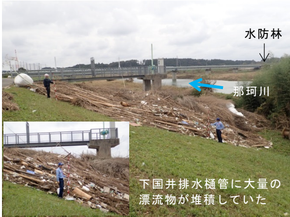
写真-5.2.7.17 樋管上流部の漂流物堆積状況 那珂川左岸 19.8KP 上流から
