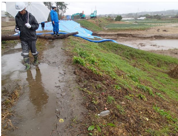
写真-5.2.5.33 谷田川 決壊箇所
