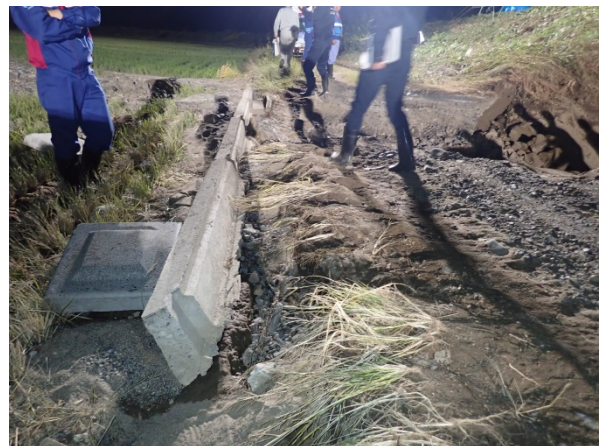
写真-5.2.4.29 川裏法尻の排水工流出状況
