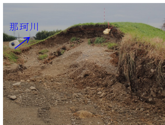
写真-5.2.4.6 決壊箇所の堤体断面（下流側）
