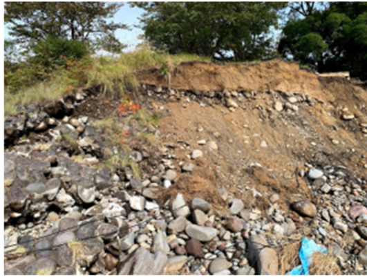
写真-5.2.9.4 侵食箇所下流端の様子
