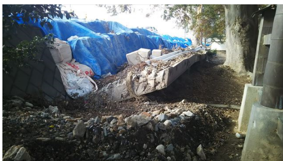
写真-5.2.13.16 千曲川左岸 79.0KP 擁壁の倒壊
