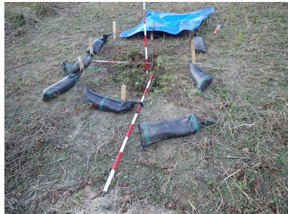
写真-5.2.18.10 阿武隈川下流右岸 13.2KP 陥没の状況
