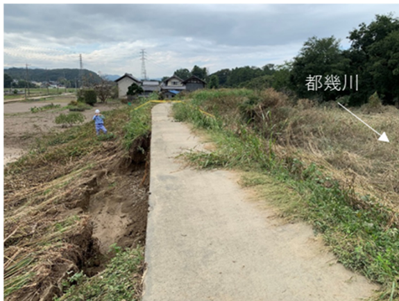
写真-5.2.3.14 決壊箇所上流側の状況
