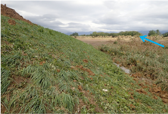
写真-5.2.1.6 決壊地点下流表法面
