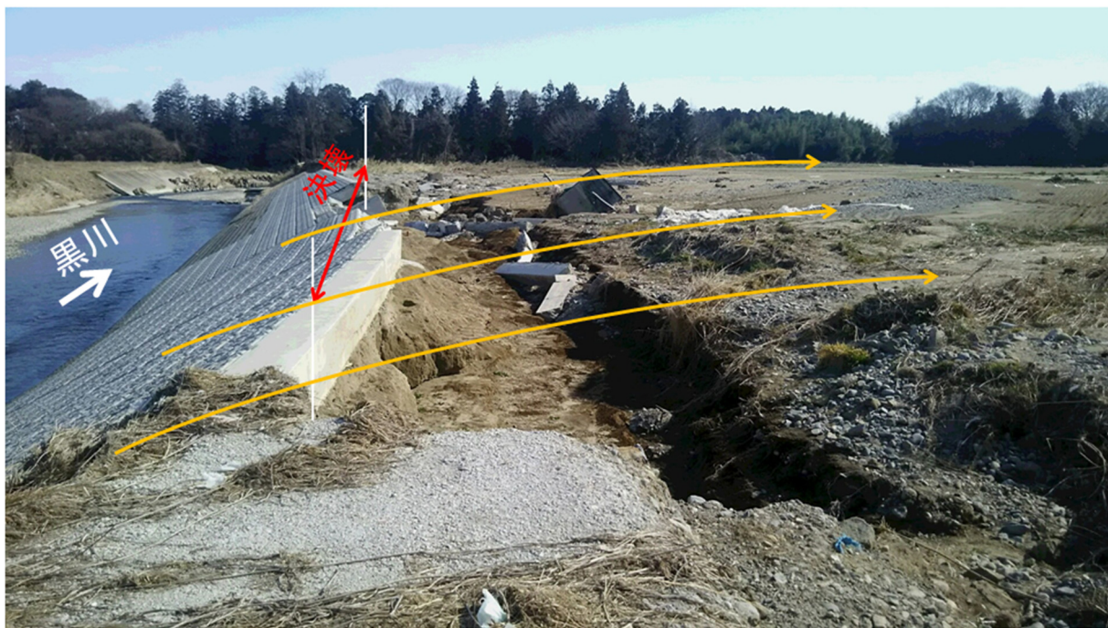
写真-5.2.8.8(2) 黒川右岸高速道路下流被災状況
