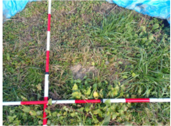
写真-5.2.18.33 阿武隈川下流左岸 37.0KP 釜段内部の噴砂
