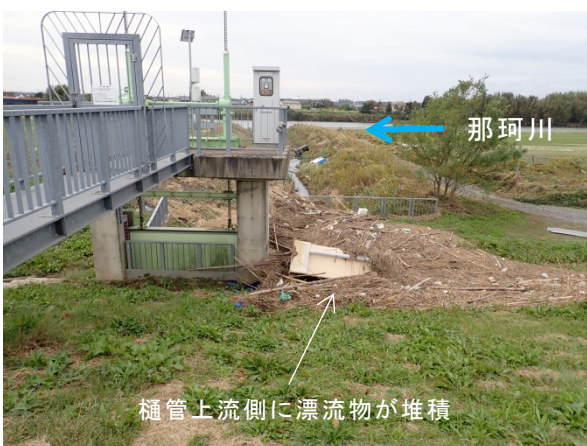
写真-5.2.7.5 樋管門柱の漂流物堆積状況 那珂川左岸 8.2KP 天端から
