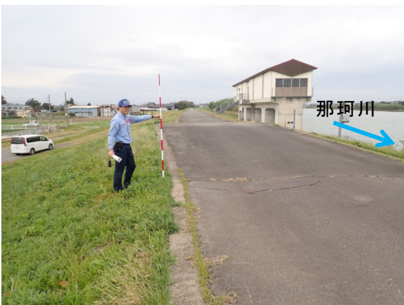
写真-5.2.7.3 フロンティア堤防天端部 那珂川右岸 7.0KP 下流から
