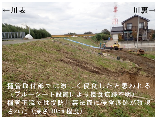
写真-5.2.7.19 樋管取付部の侵食状況 那珂川左岸 19.8KP 下流から
