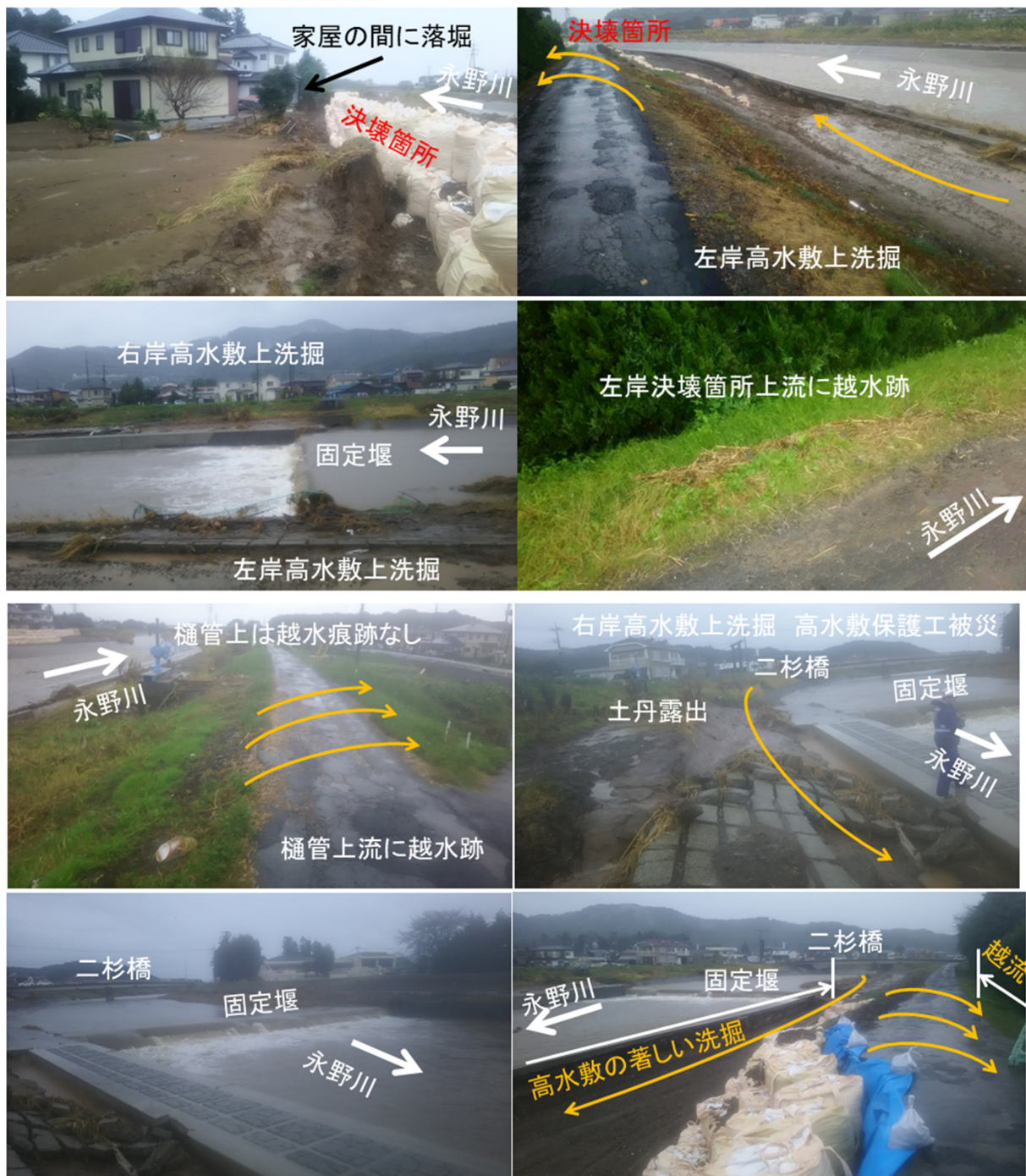
写真-5.2.8.6 永野川左岸二杉橋下流被災状況
