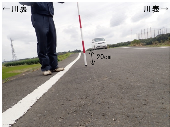
写真-5.2.7.11 水管橋付近の堤防天端の不陸 那珂川左岸 19.3KP 上流から
