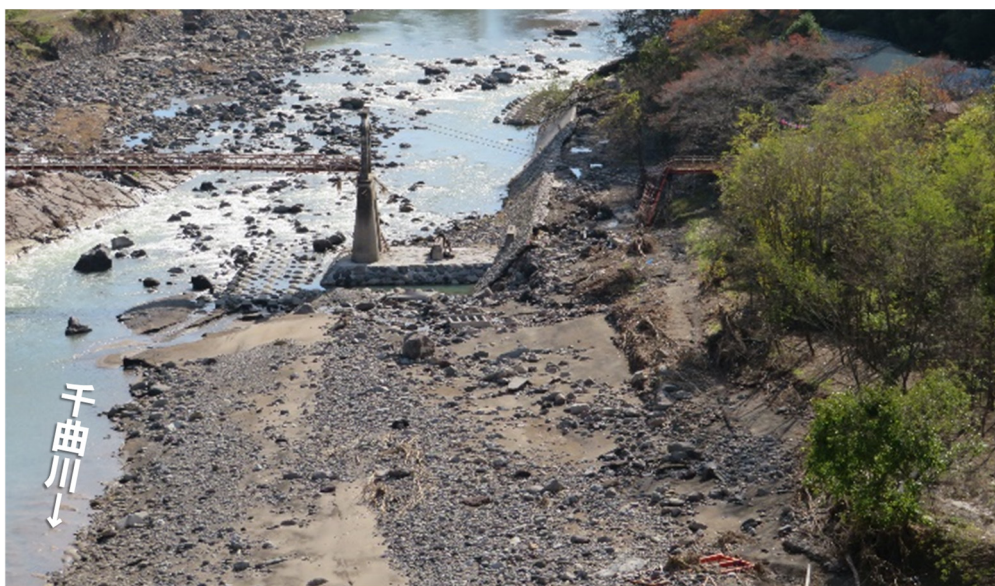
写真-7.2.56 左岸側側径間の上部構造及び橋脚の流出
