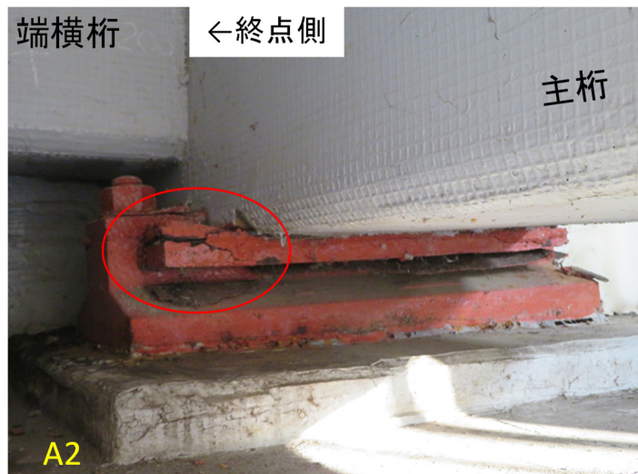
写真-7. 2. 32 A2 橋台上の支承のわれ
