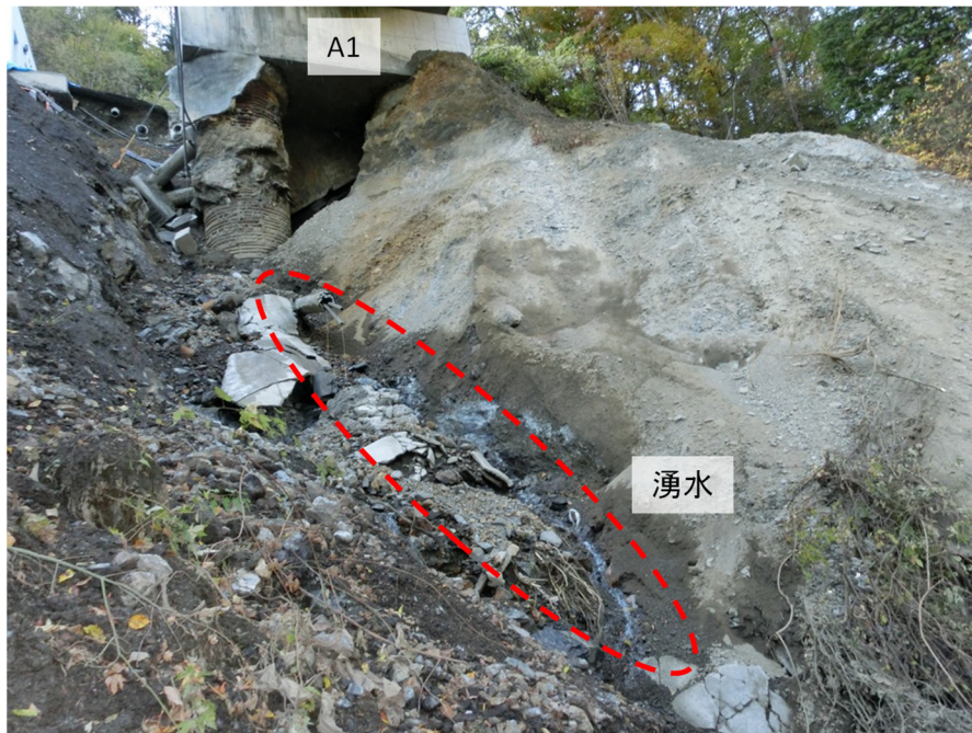
写真-7.2.22 層境界部からの湧水の状況（11月2日）
