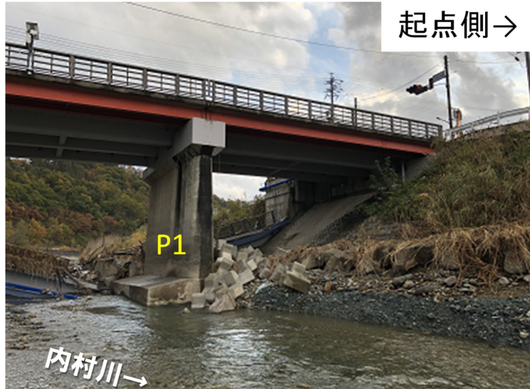
写真-7.2.30 護床ブロックの散乱
