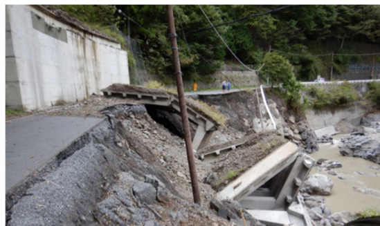
写真-7.3.4 県道中津川三峰口停車場線（TEC-FORCE 写真）
