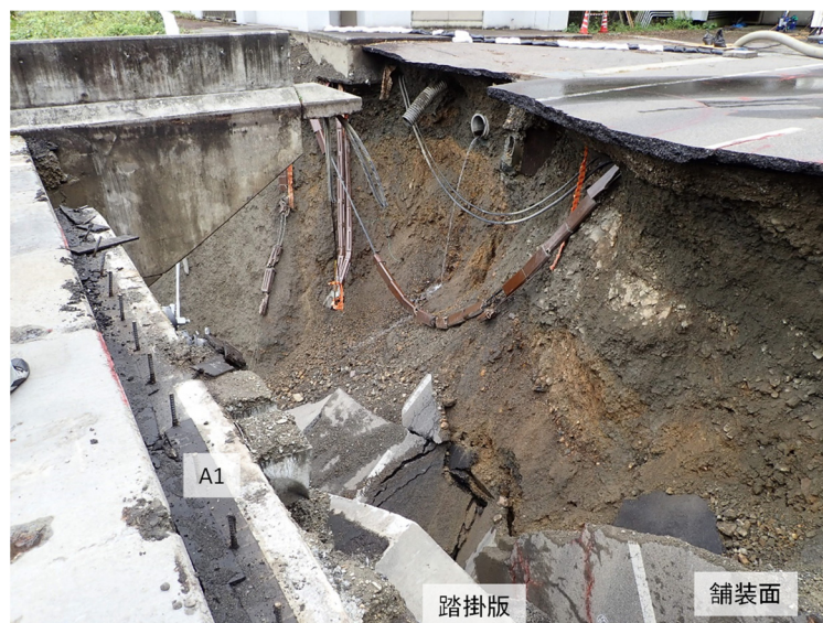
写真-7.2.18 A1橋台の背面部の踏掛版と舗装面の落下（10月22日）
