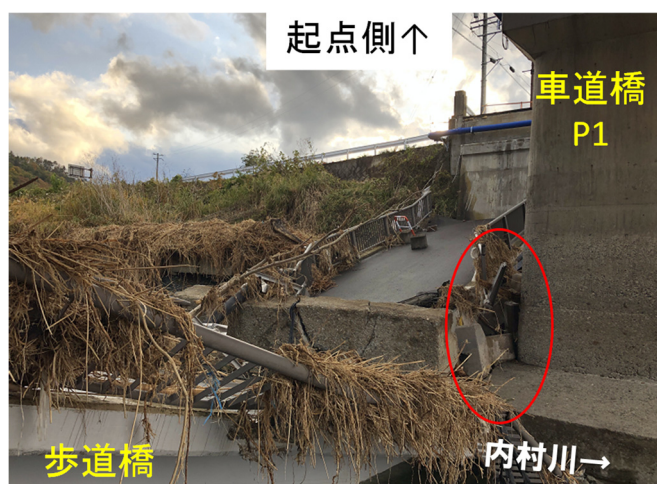
写真-7. 2. 34 上流側歩道橋と車道橋橋脚の接触
