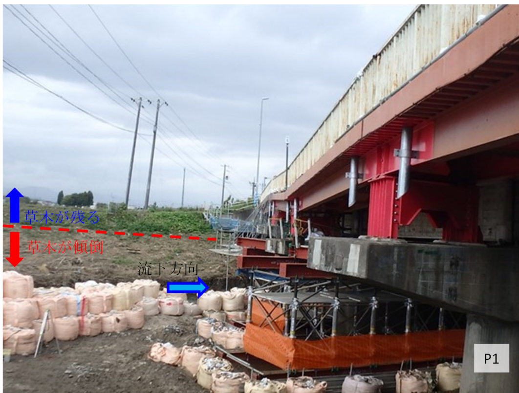
写真-7.2.15 堤防上の草木の状況
