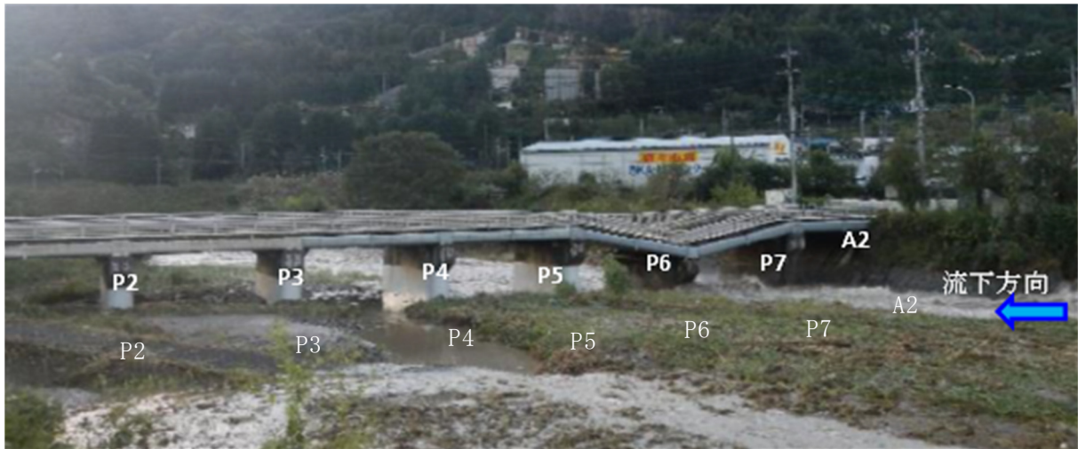
写真-7.2.1 災害直後の法雲寺橋の状況（上流側から撮影）
