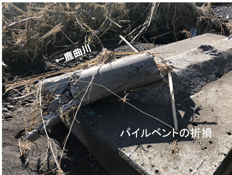
写真-7.2.52 パイルベント橋脚の折損
