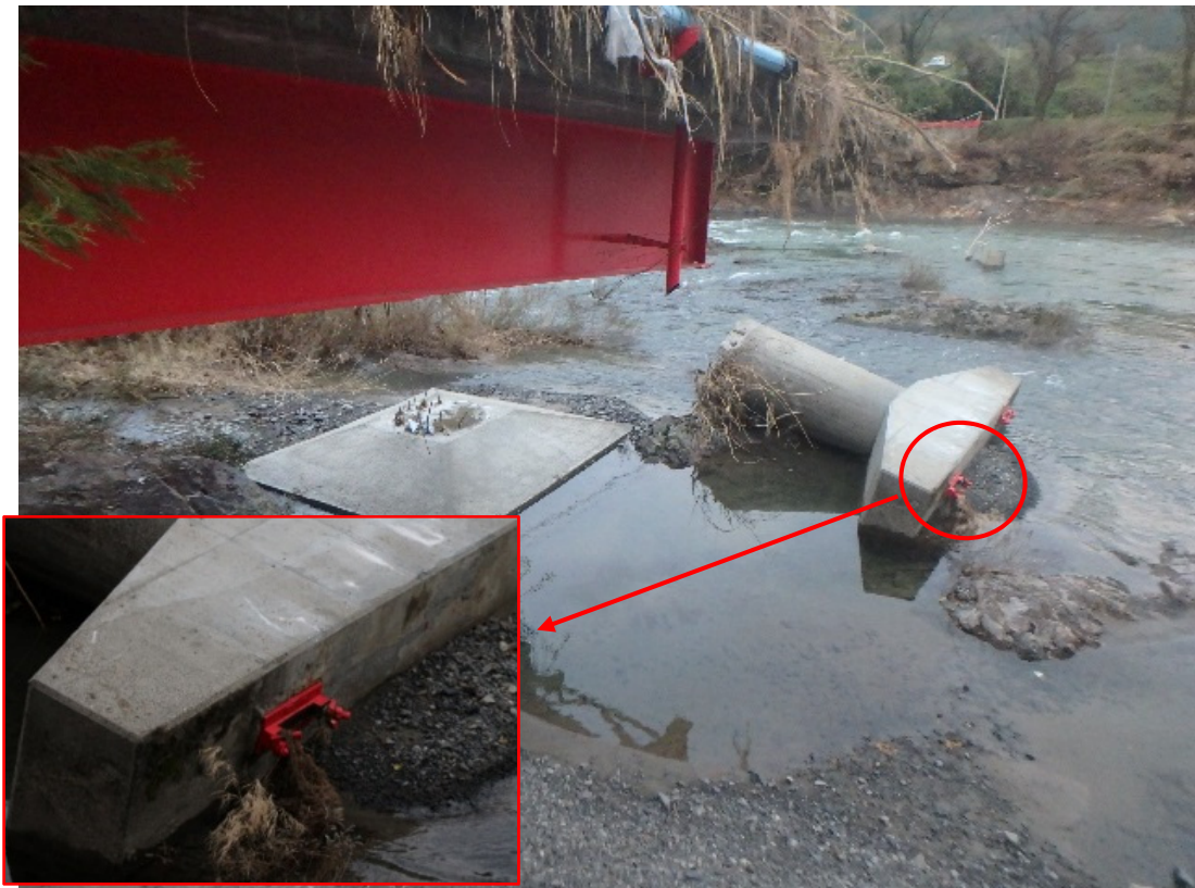
写真-7.2.66 P1 橋脚上流側支承部の変形 (10月30日)
