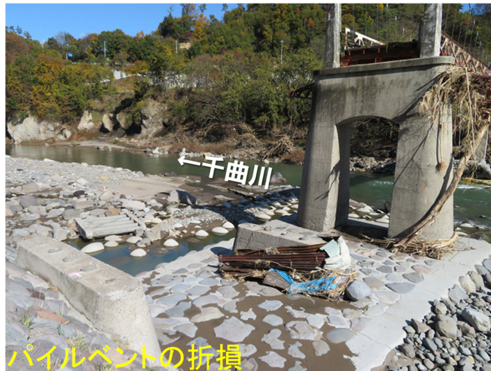
写真-7.2.58 パイルベント橋脚の折損
