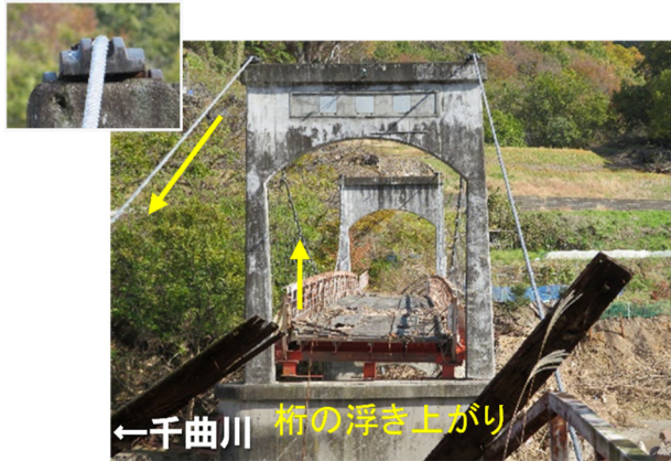
(左) 桁の浮き上がり
