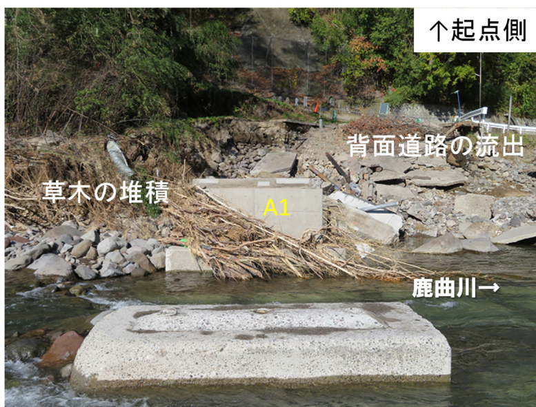
写真-7.2.53 A1 橋台背面の土砂の流出と草木の堆積
