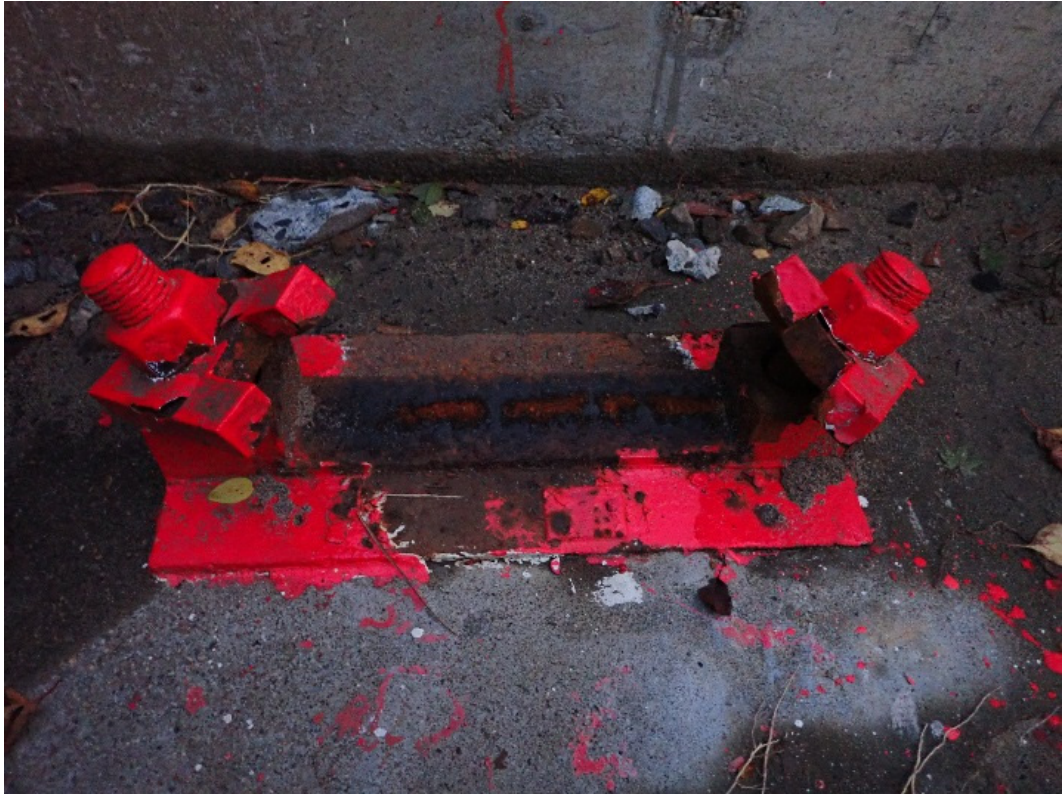
写真-7.2.65 A2 橋台上流側支承部の変形 (10月30日)
