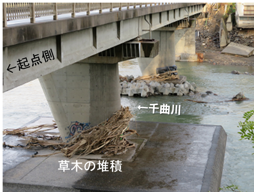
写真-7.2.25 橋脚基部の草木の堆積
