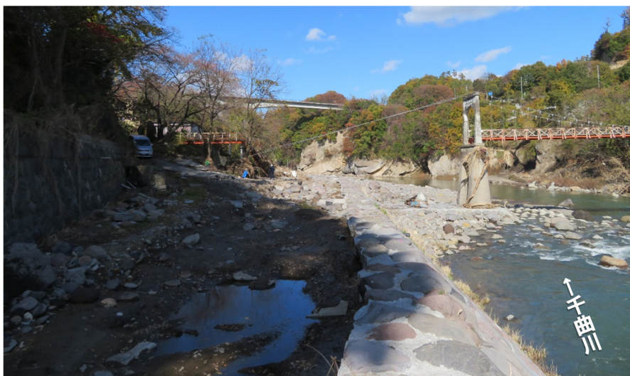
写真-7.2.59 左岸側堤防の洗掘
