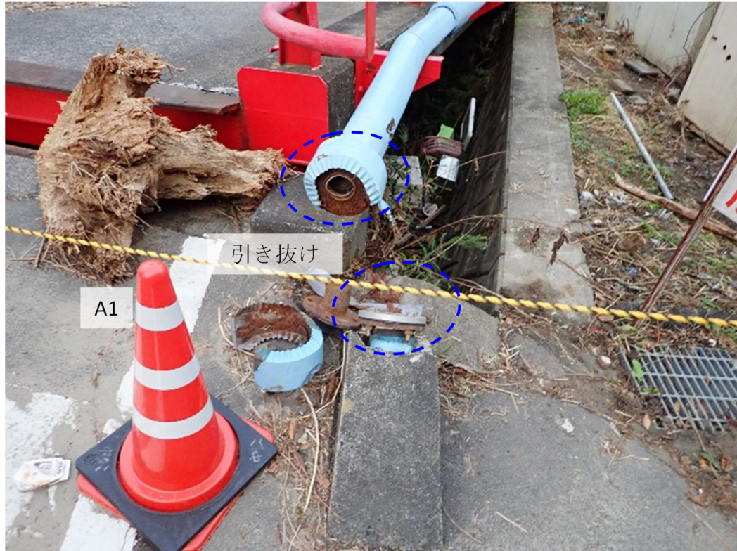
写真-7.2.62 A1 橋台のライフライン接続箇所の引き抜け (10月30日)
