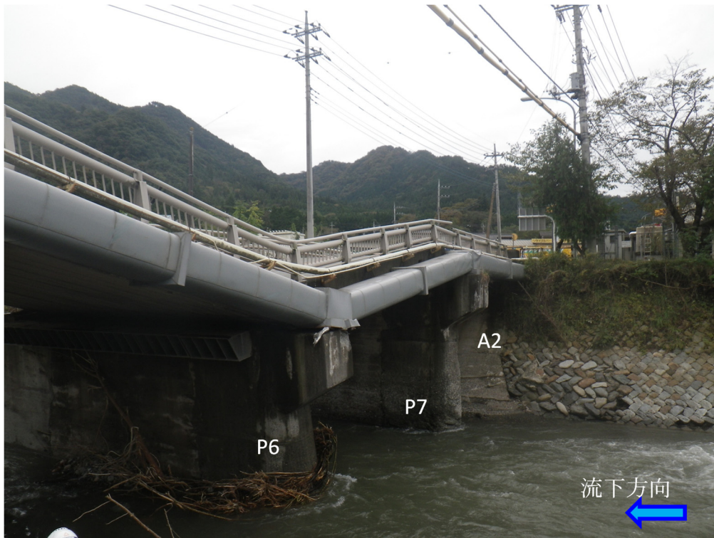
写真-7.2.2 P6 橋脚の沈下の状況 (10月21日)
