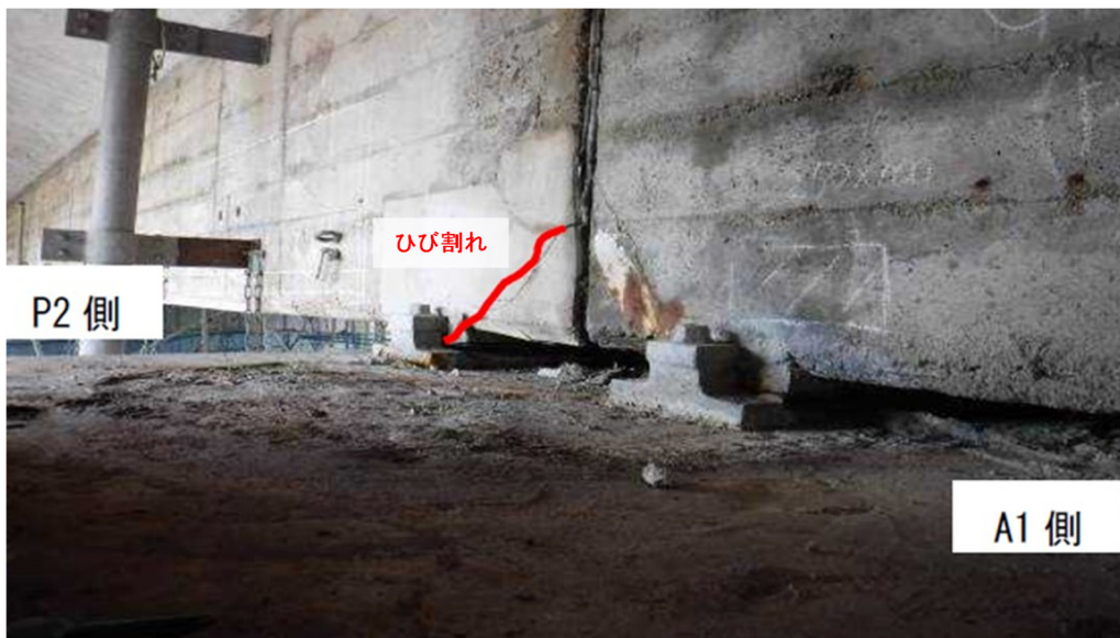
写真-7.2.7 P1 橋脚支承部周辺の桁端部のひび割れ【郡山国道事務所提供】
