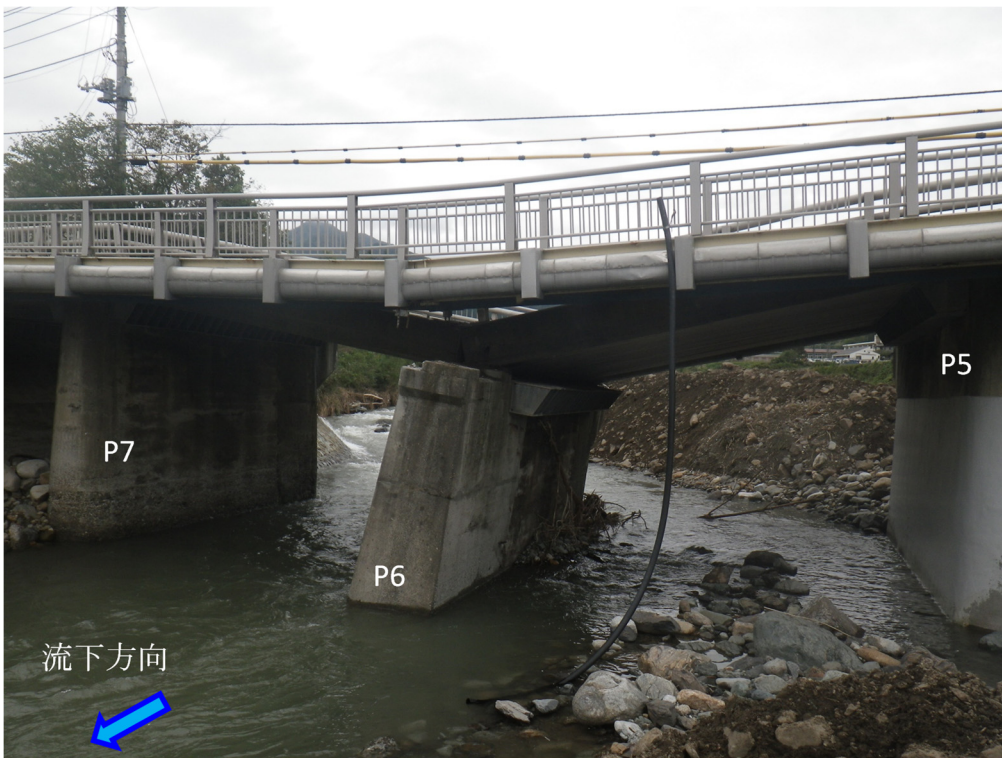
写真-7.2.3 P6 橋脚の傾斜の状況 (10月21日)
