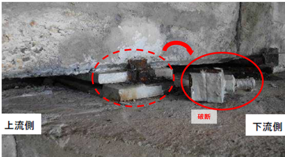
写真-7.2.9 P2 橋脚のアンカーボルトの破断【郡山国道事務所提供】
