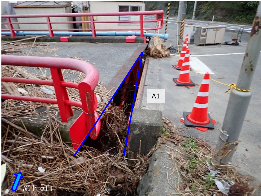
写真-7.2.61 A1 橋台と桁の開き (10月30日)
