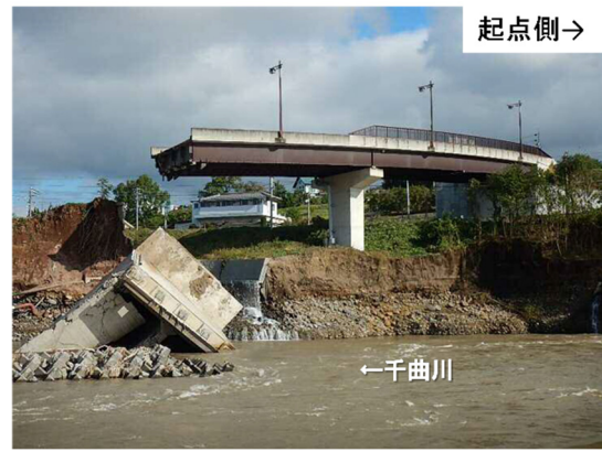
写真-7.2.37 A2橋台の転倒
