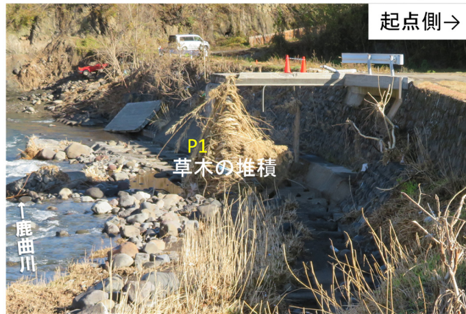
写真-7.2.47 橋脚の草木の堆積
