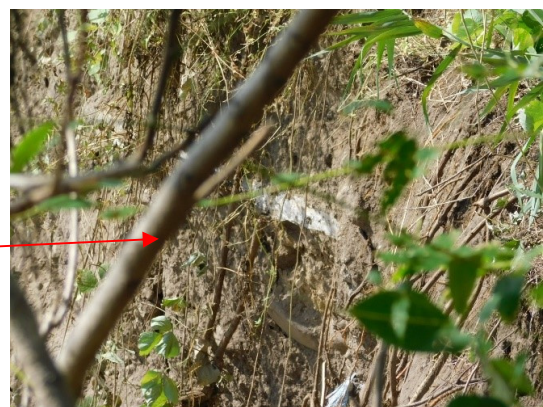
写真-7.2.39 P1橋脚基礎の端部の露頭
