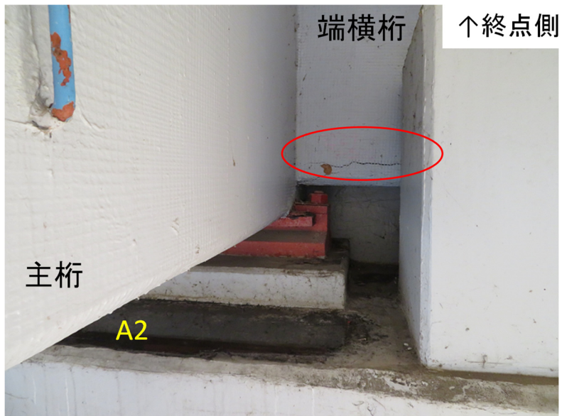
写真-7.2.31 A2 橋台上の端横桁のひびわれ
