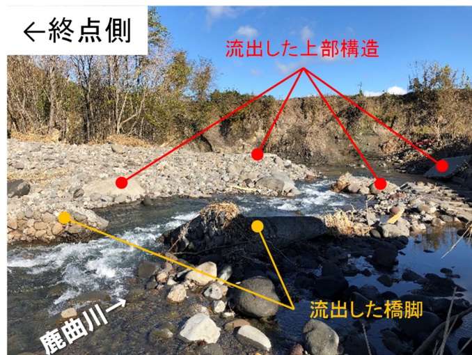
写真-7.2.46 上部構造と橋脚の流出
