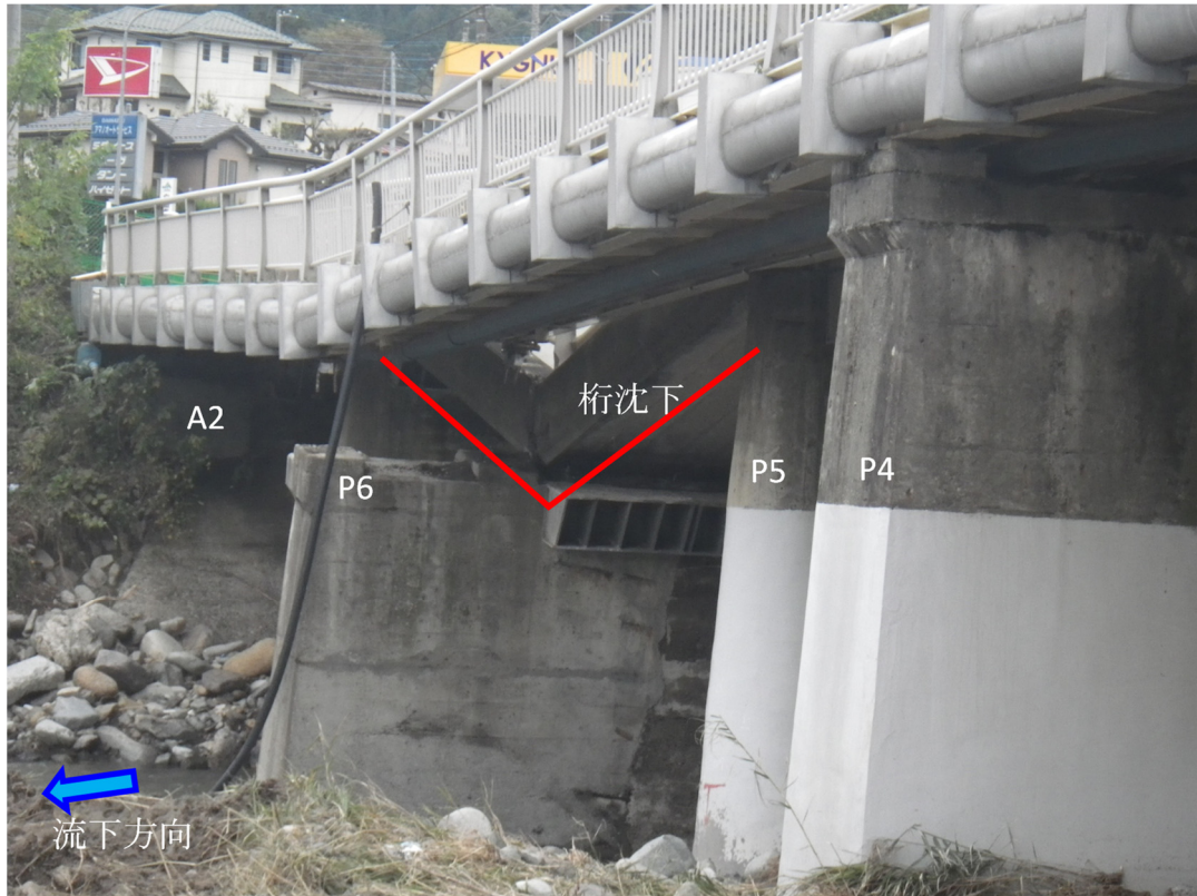
写真-7.2.4 P5～P6 間の桁の沈下状況（10月21日）
