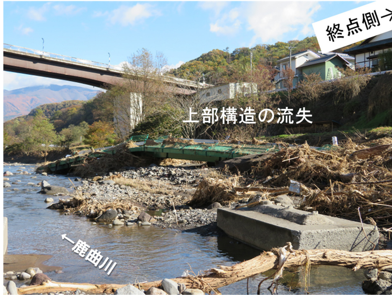
写真-7.2.50 上部構造と橋脚の流出
