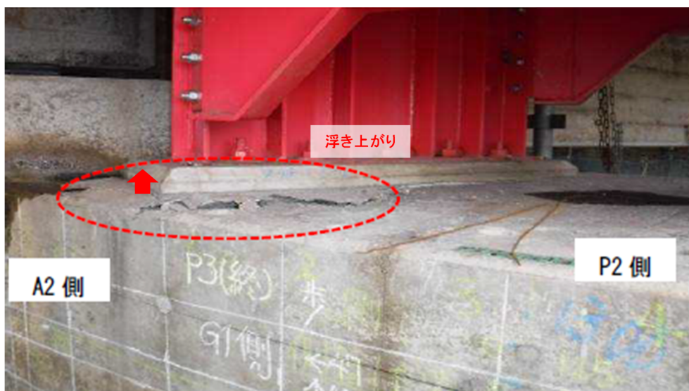
写真-7.2.10 P3 橋脚の側道橋の台座の浮き上がり【郡山国道事務所提供】
