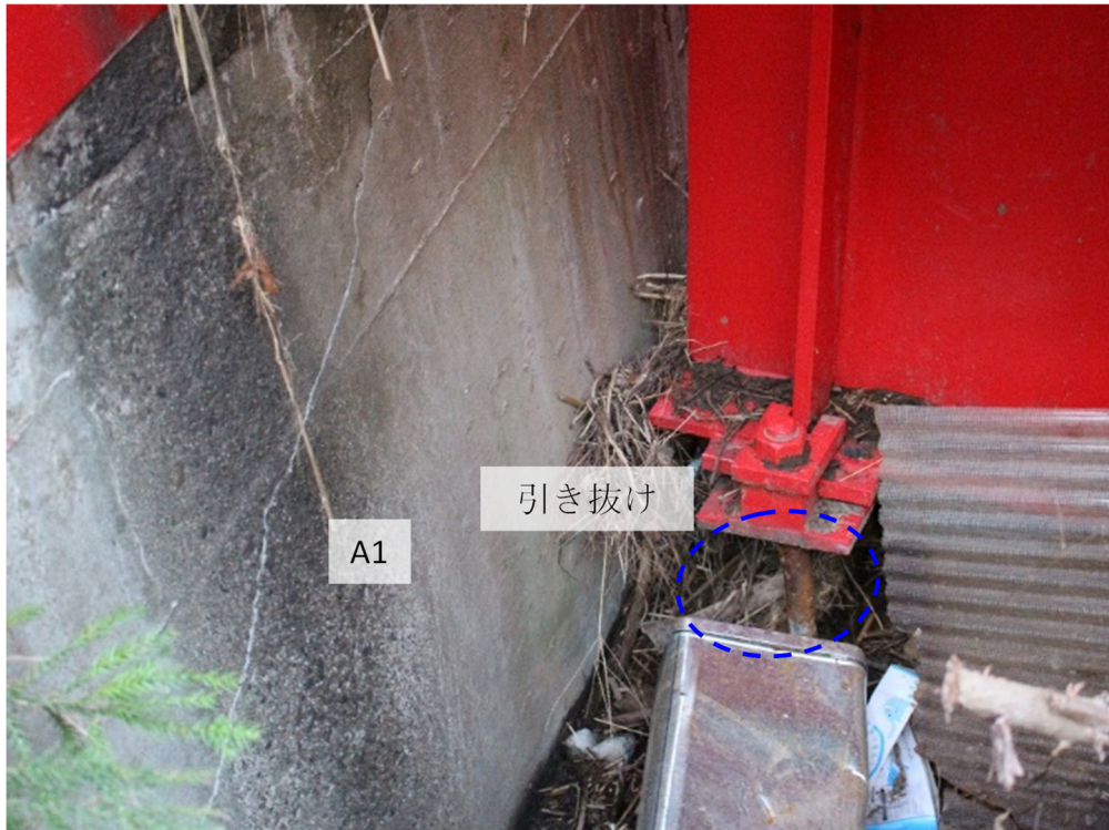
写真-7.2.63 A1 橋台の支承アンカー部の引き抜け (10月30日)
