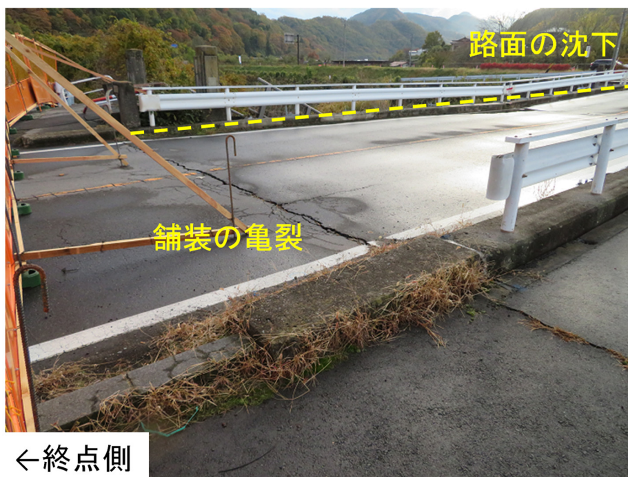
写真-7. 2. 29 路面の沈下と A2 橋台上の舗装の亀裂
