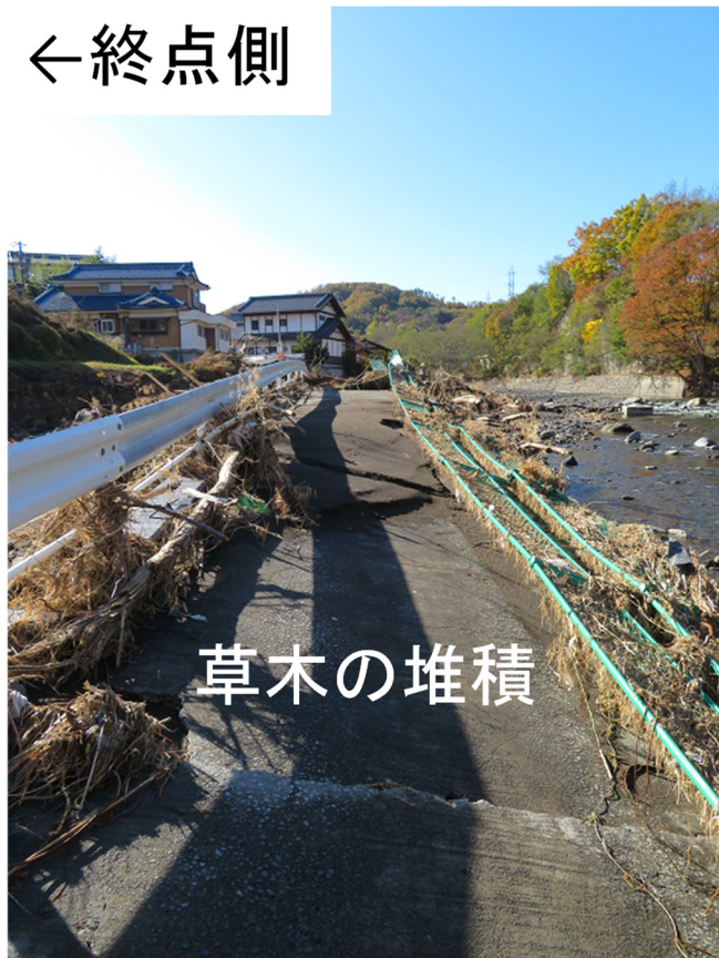
写真-7.2.51 橋脚の草木の堆積
