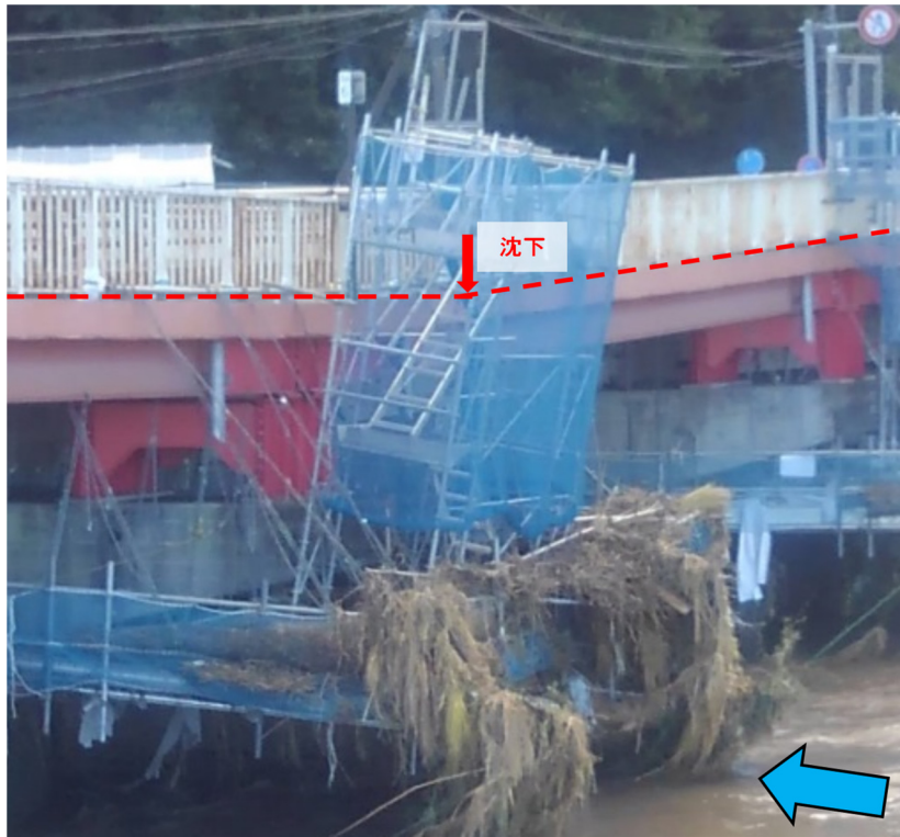
写真-7.2.6 P2 橋脚の沈下【郡山国道事務所提供】
