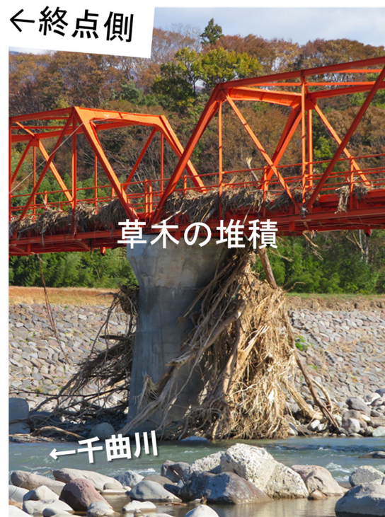
写真-7.2.44 上部構造及び橋脚の草木の堆積
