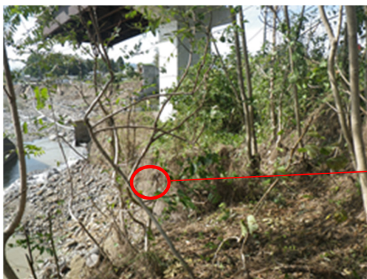
写真-7.2.38 P1橋脚基礎の支持層の流失状況
