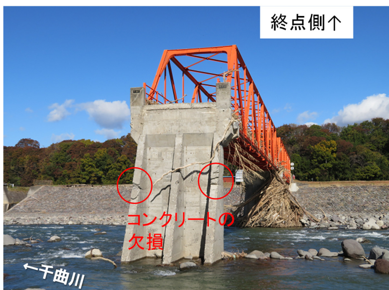
写真-7.2.43 A2 橋台背面の土砂の流出
