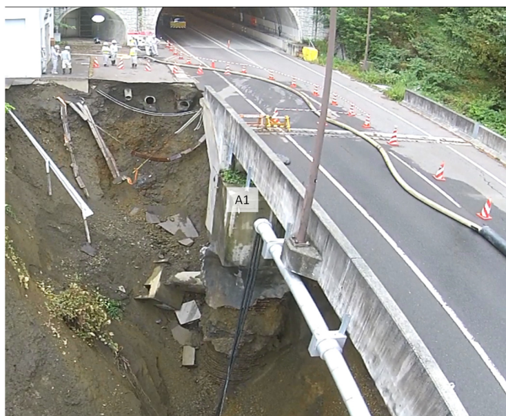
写真-7.2.17 橋梁被災状況（10月20日）【長野県伊那建設事務所提供】
