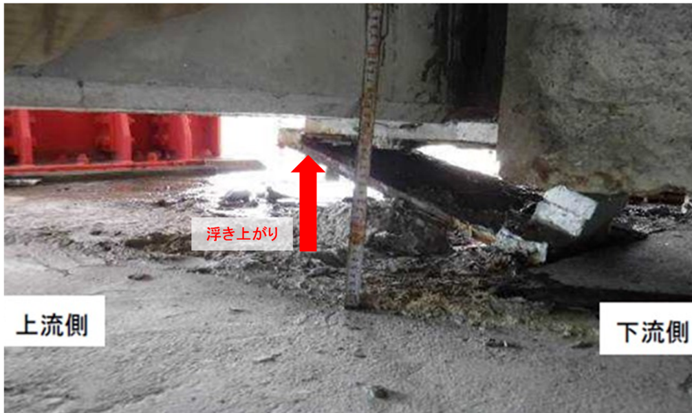
写真-7.2.8 P2 橋脚の桁端部の浮き上がり【郡山国道事務所提供】
