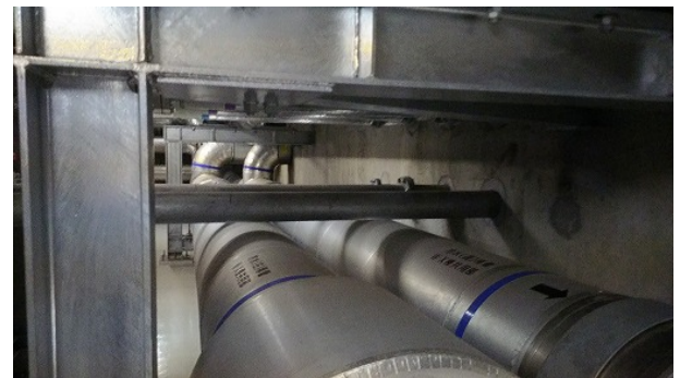
冷水配管 (行き・返り)
