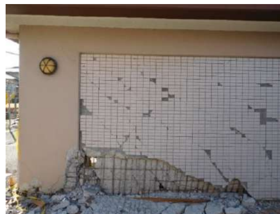
写真 4.3.1.2 1階 X5Y1 柱と X5 壁の損傷状況
