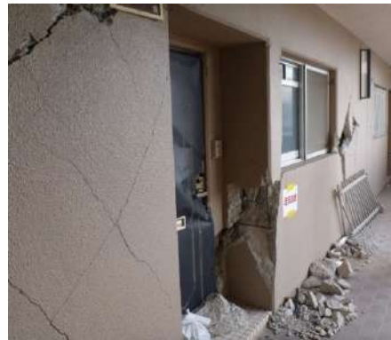
写真 4.3.1.6 2階共用廊下側の損傷状況
