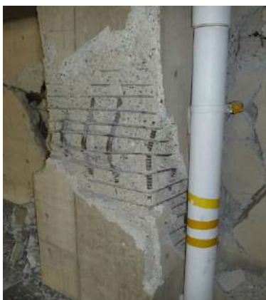
写真 4.3.1.1 1階 X4Y2 柱の損傷状況
