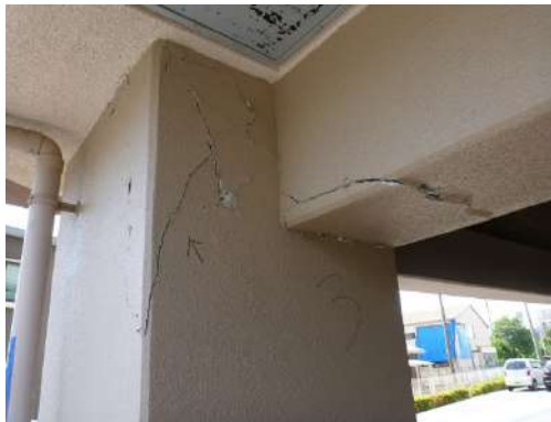
写真 4.3.1.5 2階 X1Y1 柱梁接合部の損傷状況
