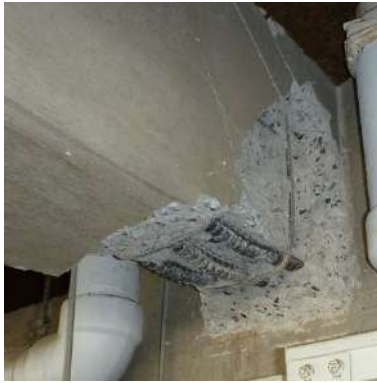
写真 4.3.1.3 2階大梁の損傷状況
