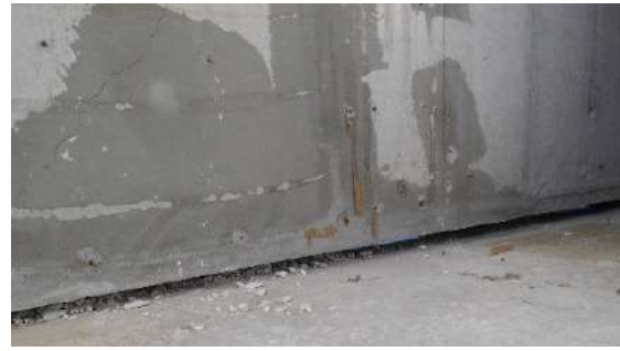
写真 4.3.1.4 2階戸境壁の脚部の離間
