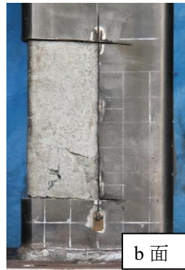
(j) b 面柱脚部 内部コンクリート
