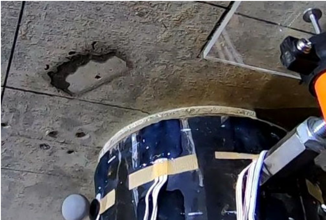
写真 5. 4. 3-1 正側 Case1, pRp=0.255\% 後除荷時の損傷状況
