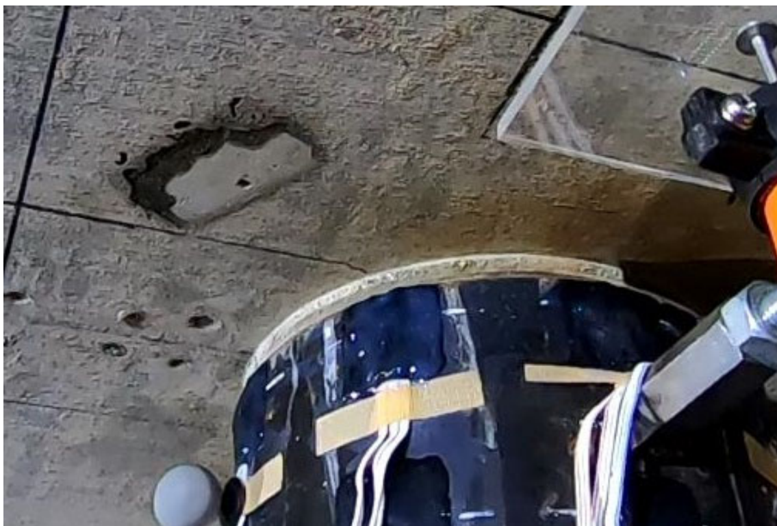
写真 5. 4. 3-3 負側 Case1, pRp=-0.072\% 後除荷時の損傷状況
