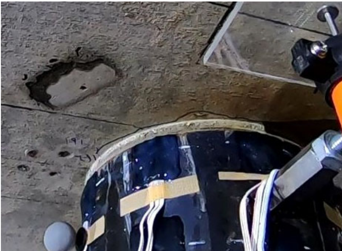
写真 5. 4. 3-1 正側 Case2, pRp=0.970\% 後除荷時の損傷状況
