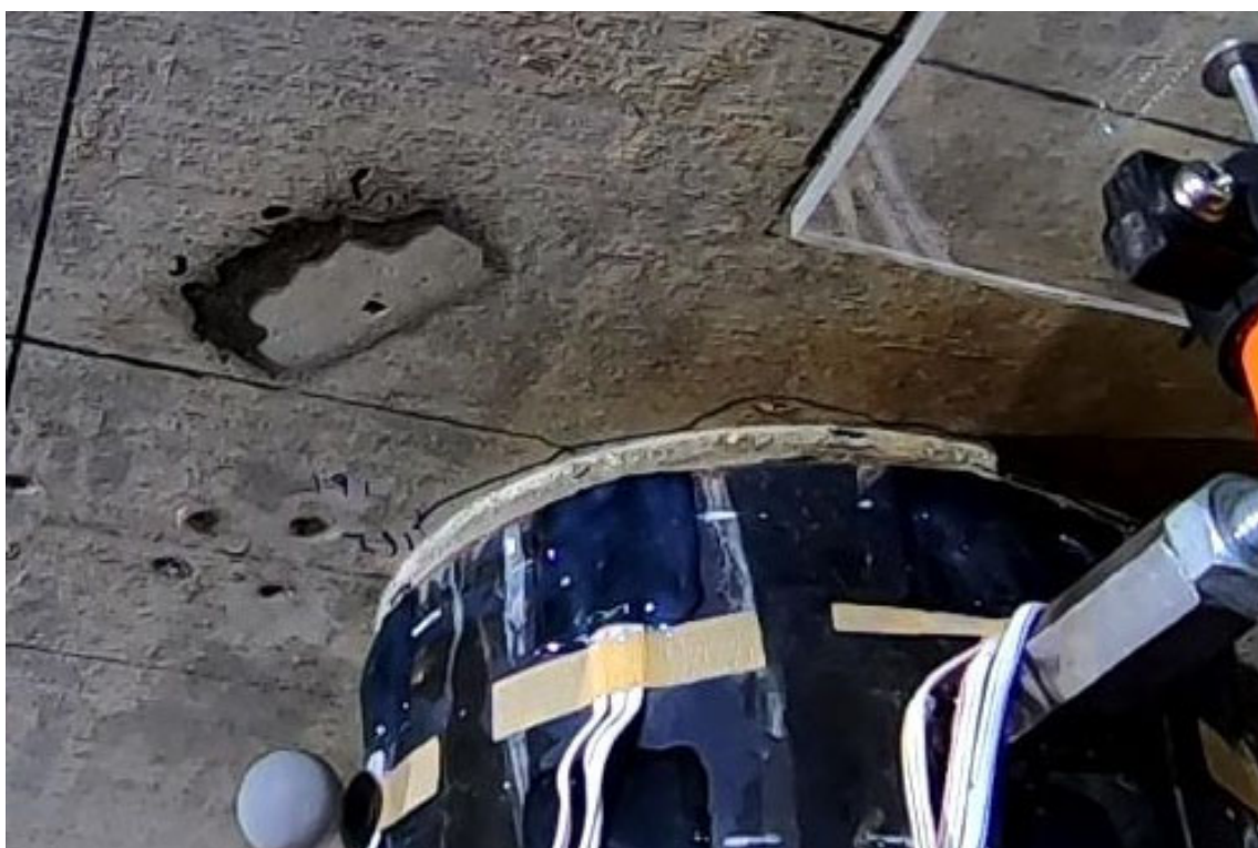
写真 5. 4. 3-4 負側 Case2, pRp=-0.724\% 後除荷時の損傷状況
