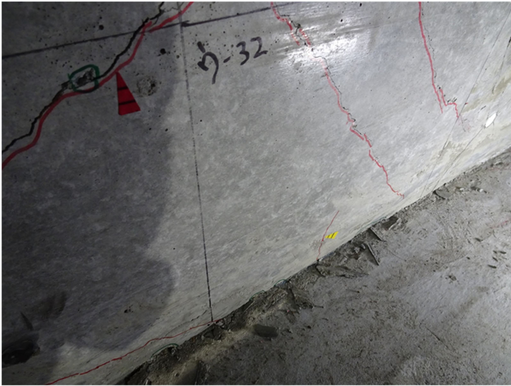
(i) 壁とスラブの境界に損傷
