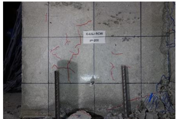
(f) 袖壁脚部コンクリート圧壊
