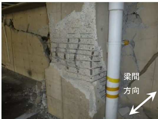
図 2.2.1-1 X4Y2 柱のせん断破壊
