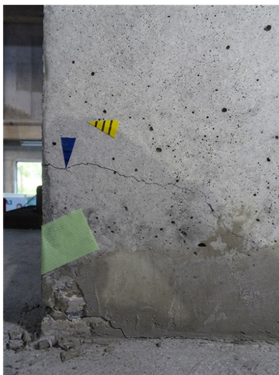
(d) 1C1 西側（正面）柱脚部コンクリート剥落
