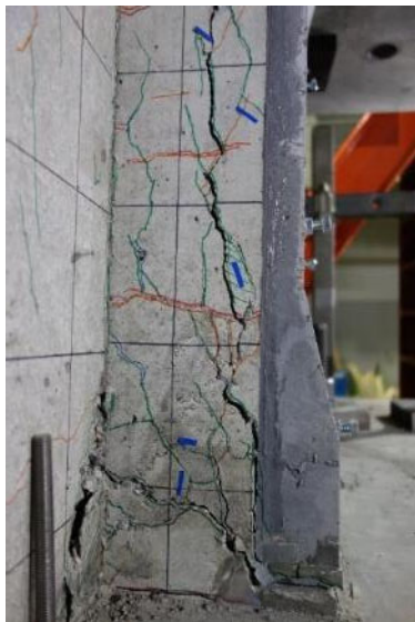
(c) パネル界面の縦および斜めひび割れ
