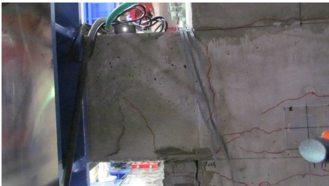
(e) 1/50 時柱梁接合部破壊
