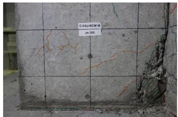
(f) 袖壁脚部コンクリート圧壊
