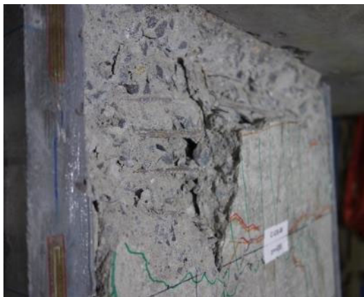
(e) 主筋座屈部分のカバーコンクリートの孕み
