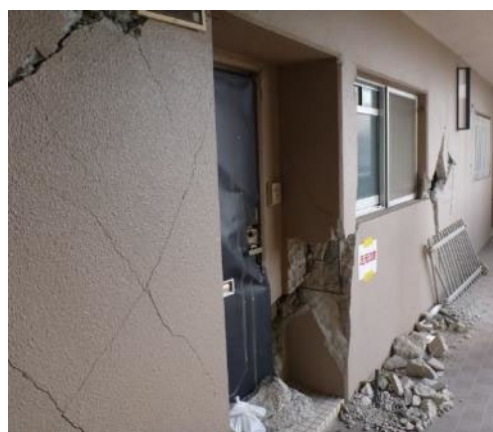
図 1.1.3-7 2階共用廊下側の方立壁の被害
