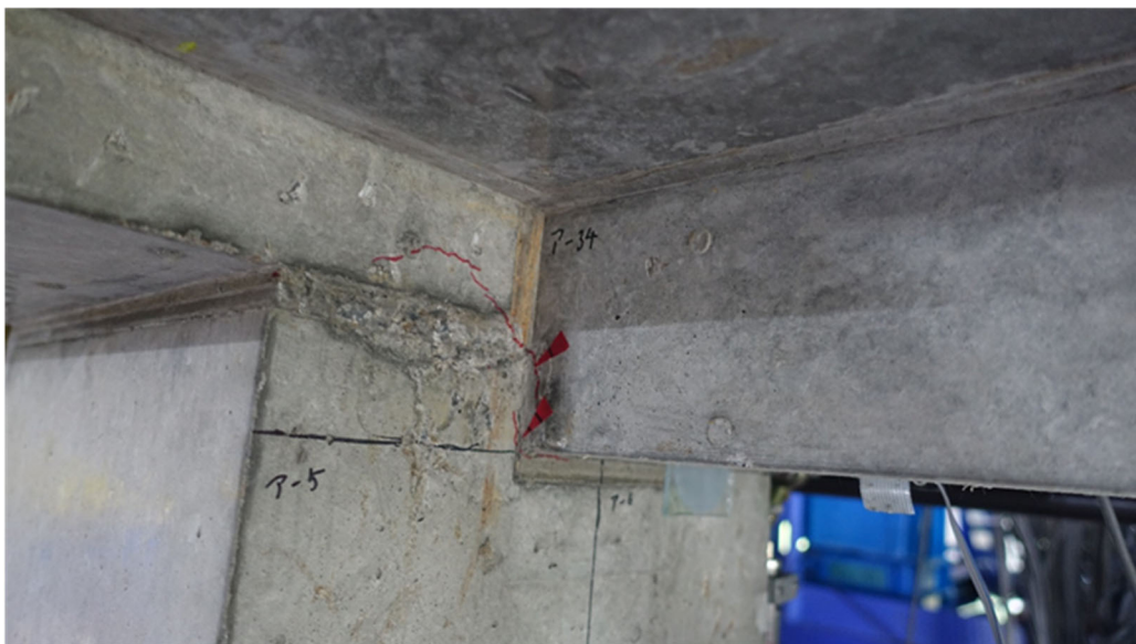
(b) 北側柱梁接合部の損傷
