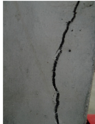
図 A1.3.3-9 ②面端部のひび割れ
