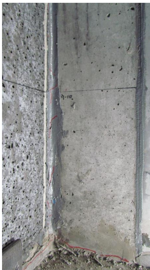
(b) 1/400 時柱、袖壁の境界線のずれ
