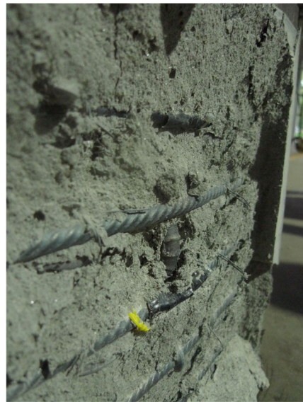
図 A1.3.4-9 主筋の座屈
