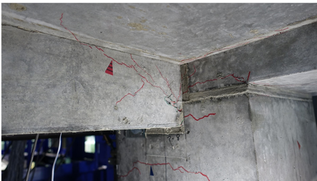
(h) 梁端部の破壊
