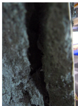
図 A1.3.2-9 かぶりコンクリート部の剥落
