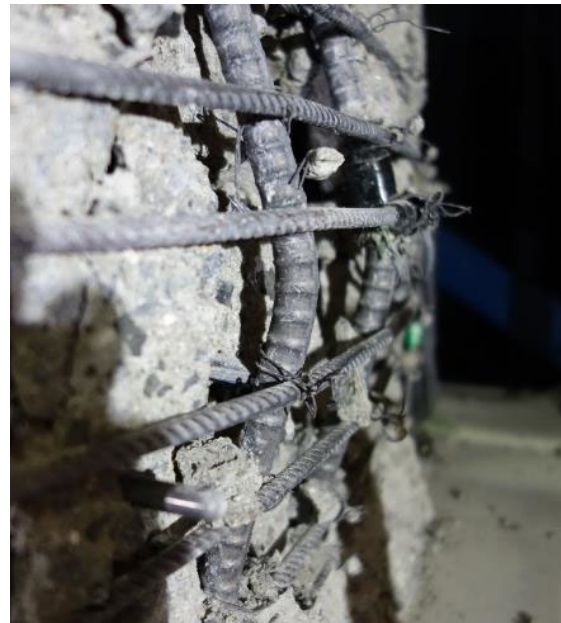
(d) 南面柱脚主筋の座屈
