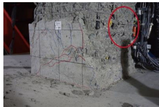
(d)南面柱脚主筋の座屈
