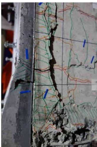
(e) パネル界面縦ひび割れ
