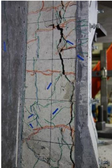
(f) 柱パネル接着面縦ひび割れ
