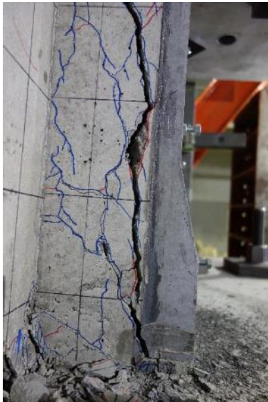
(c) パネル界面の縦ひび割れ
