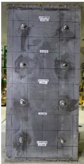
パネル損傷状況
