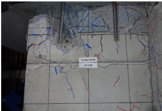
(e) 袖壁頂部圧壊ひび割れ
