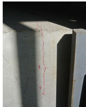
基礎梁のひび割れ (8サイクル)
