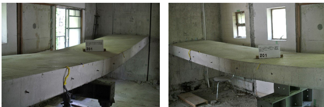
写真 3.3.6-3 201号室 最終破壊状況
