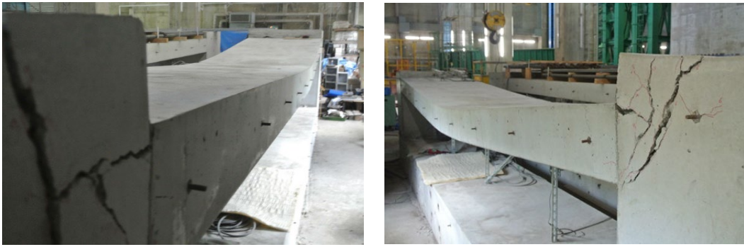
最終破壊状況 全景
