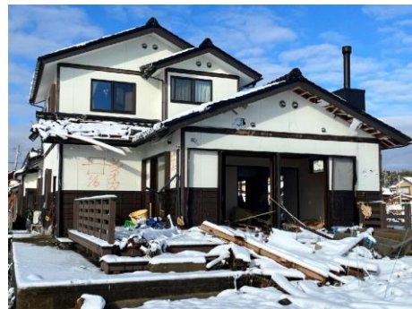
写真 5.7-14 流失を免れた建築物
