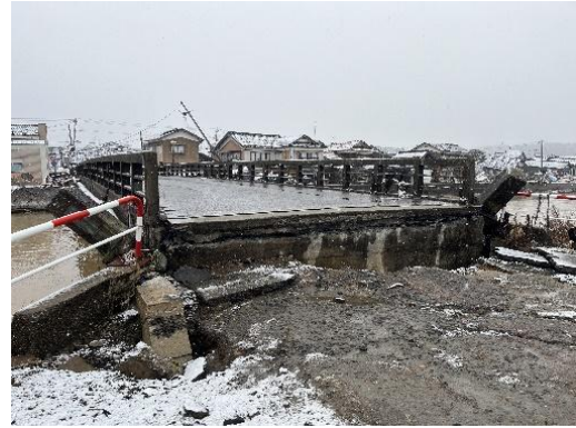
写真 5.7-18 橋と道路との間の段差
