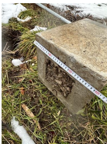
写真 5.7-2 フェンスの引き抜けた基礎
