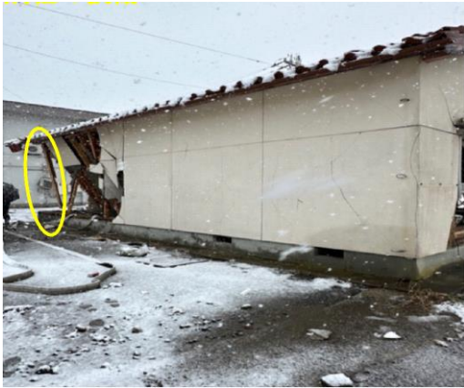
写真 5.7-20 津波の波圧による損傷
