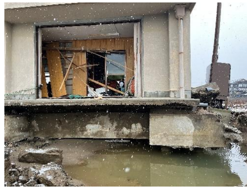
写真 5.7-12 RC造建築物周囲の地盤の洗掘
