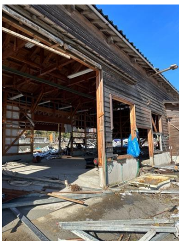
写真 5.7-26 海側の開口部の損傷
