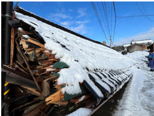
写真 5.7-40 倒壊した建築物の瓦屋根
