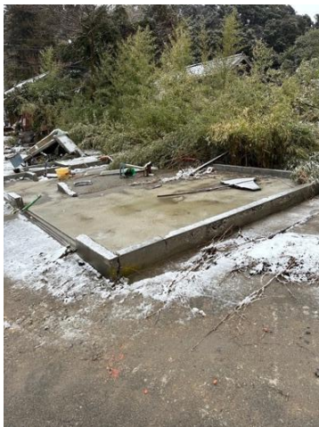
写真 5.7-22 上部構造の流失
