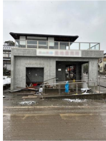
写真 5.7-25 RC造建築物の被害状況
