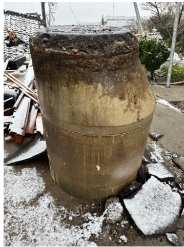
写真 5.7-19 突出したマンホール
