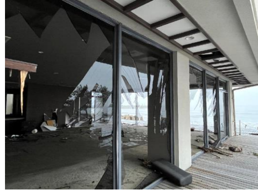
写真 5.7-9 1階の窓ガラスの損傷(2)
