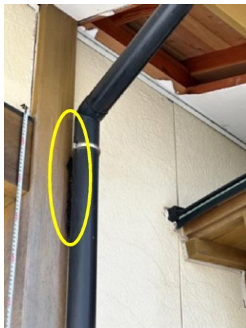
写真 5.7-15 津波の痕跡高さ
