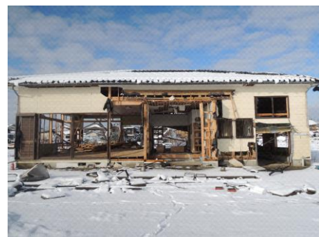
写真 5.7-16 津波による前面の被害
