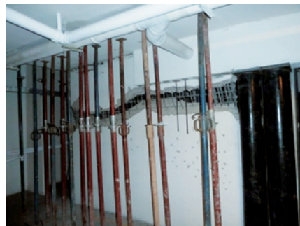
■写真4 地下階耐力壁の損傷
