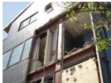
写真12 大判ガラスの被害
