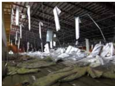
写真10 内装材(吊り天井)の脱落
