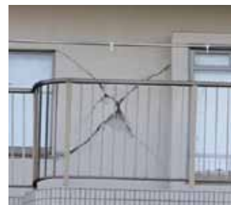
写真11 外装材(乾式工法)の脱落
