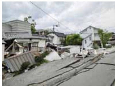
写真3 路盤崩壊と倒壊家屋
