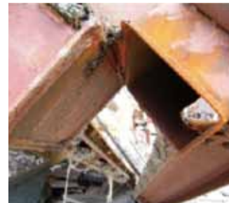
写真7 柱はり接合部の溶接破断
