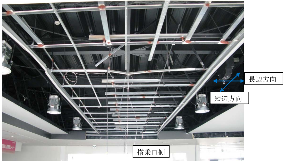
写真6 天井Bの下地と幕板の破損
