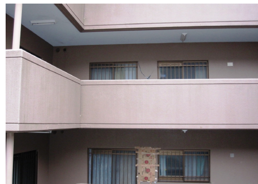
写真 87 非構造壁のせん断破壊
