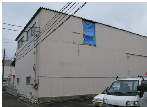
写真 126 外装材の被害 3
