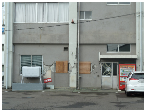
写真99 腰壁付き短柱のせん断破壊
