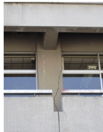
写真30 2階柱のせん断
