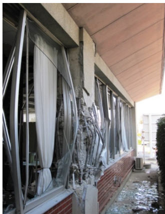
写真28 1階柱のせん断破壊
