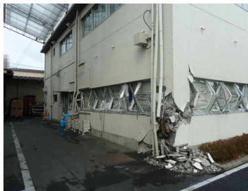
写真101 腰壁付き短柱の軸崩壊
