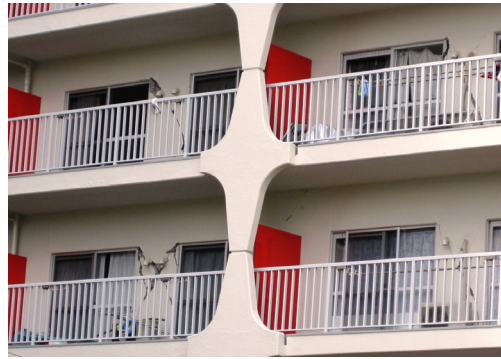
写真 119 ベランダ側方立て壁の損傷
