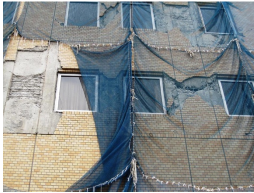
写真 66 RC 造柱および非構造壁の損傷
