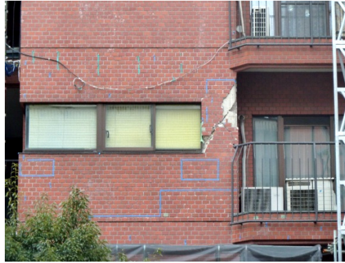
写真 79 短スパンの間柱のせん断破壊
