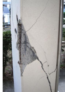
写真 97 1F 柱のせん断破壊
