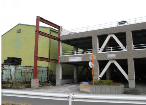
写真 124 外装材の被害 1
