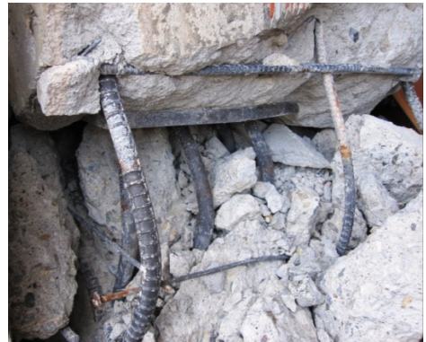
写真 18 SRC 柱脚部の損傷
