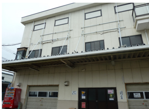
写真 105 外装材（ALCパネル）の損傷
