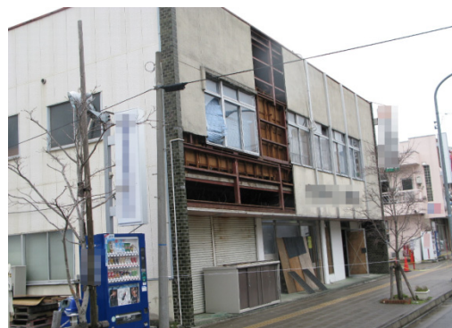
写真 127 外装材の被害 4
