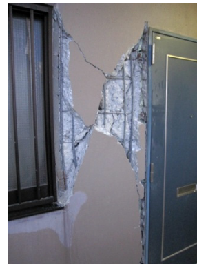
写真 89 非構造壁のせん断破壊
