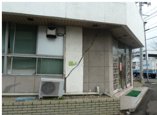
写真 103 袖壁付き短柱のせん断破壊
