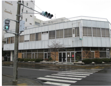
写真 134 窓ガラスの破損
