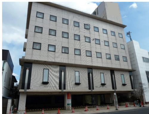
写真 44 外壁の損傷、タイルの落下
