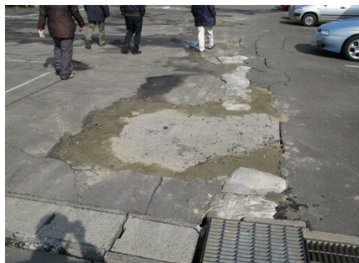
写真 139 地盤の変状の跡
