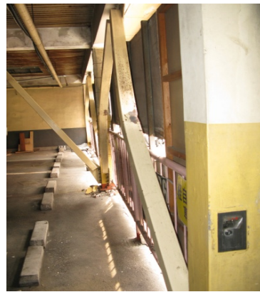
写真65 鉄骨造ブレースの座屈
