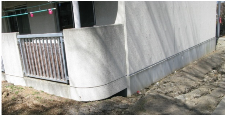
写真11 a棟 (沈み込みの大きい妻面)
