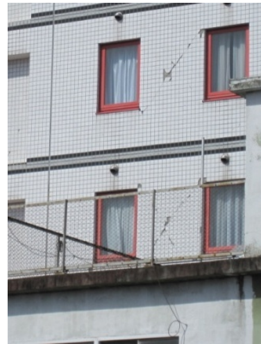
写真 43 非構造壁のせん断ひび割れ
