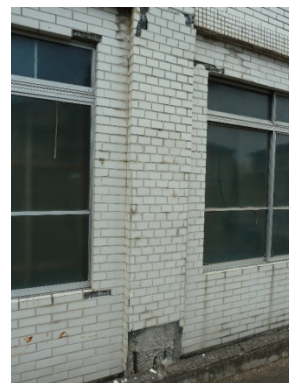
写真 36 柱脚部の損傷
