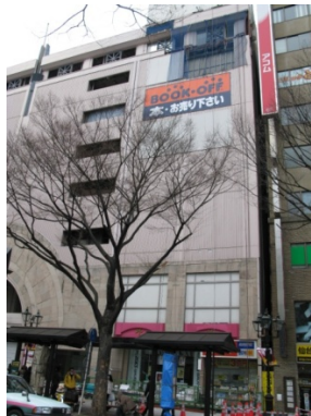
写真 67 外装材の脱落
