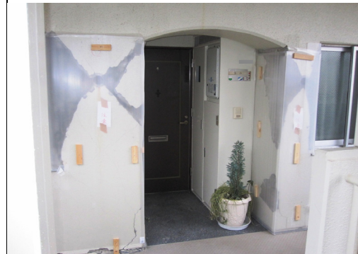
写真 84 非構造壁のせん断破壊 (損傷部分が養生されている)
