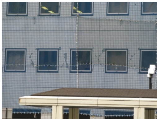
写真 69 外壁タイルの剥落
