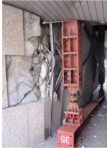
写真 46 1階柱のせん断破壊
