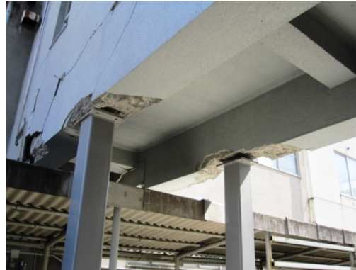
写真 32 渡り廊下の損傷
