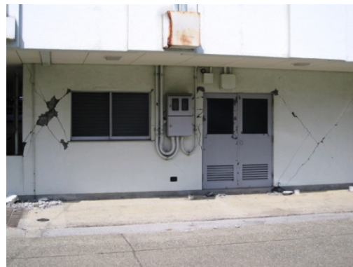
写真 50 袖壁付き短柱のせん断破壊 および非構造壁のせん断ひび割れ
