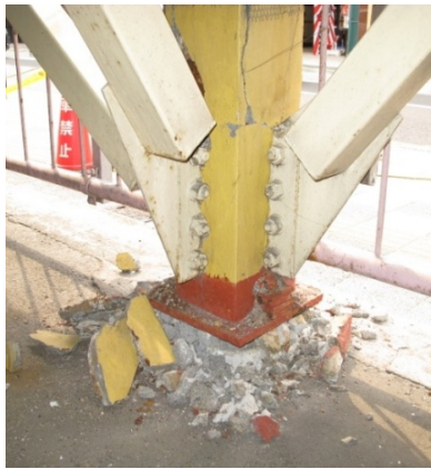
写真64 鉄骨造柱脚部の損傷
