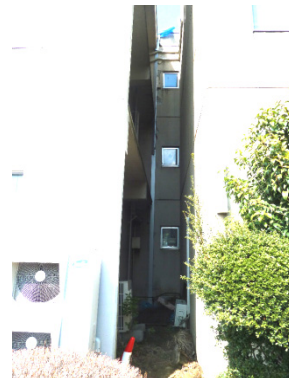
写真 121 エキスパンションジョイントの被害
