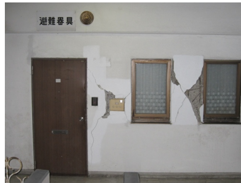
写真 81 非構造壁のせん断ひび割れ
