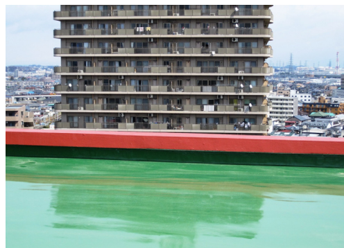
写真 117 屋上床の傾斜 (パラペットの天端が遠方建築物の床の水平ラインから傾いている)
