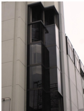
写真 71 エレベータ回りのガラスの落下
