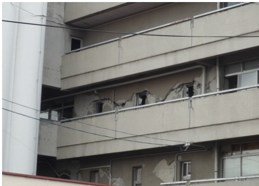
写真 31 非構造壁の損傷
