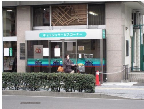
写真 72 ガラスの割れ
