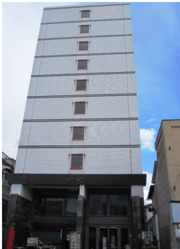
写真 41 建物外観 1 (3階壁にせん断ひび割れ)
