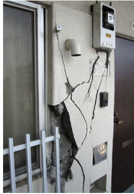
写真 118 玄関回りの非構造壁の損傷
