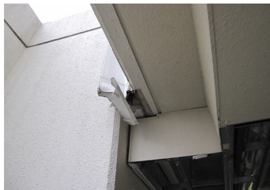
写真 85 エキスパンションジョイントの損傷
