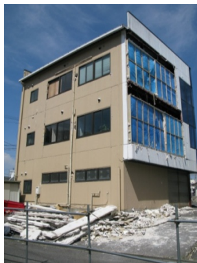
写真 22 ALC パネルの落下
