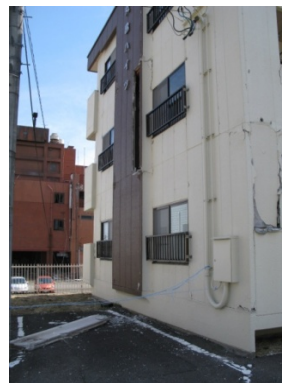
写真 23 ALC パネルの落下
