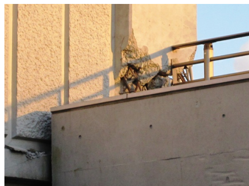
写真 91 高層棟 3F 側柱脚部の圧壊
