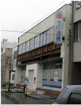
写真 128 外装材の被害 5
