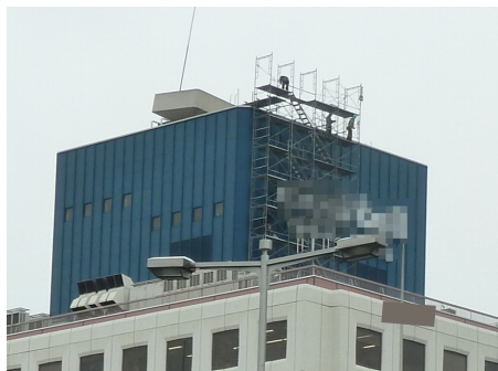
写真 74 ペントハウスの傾斜
