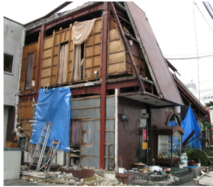
写真 129 外装材の被害 6
