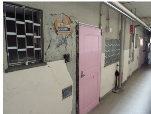
写真 77 非構造壁のせん断破壊
