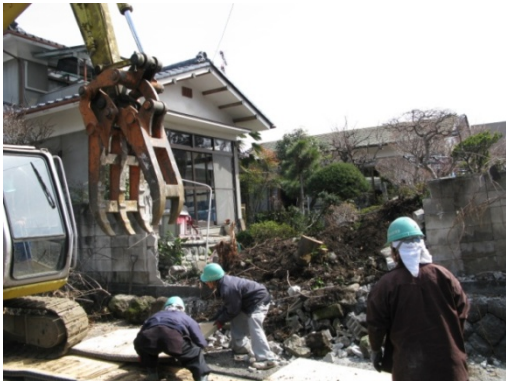
写真5 被災したブロック塀（解体中）
