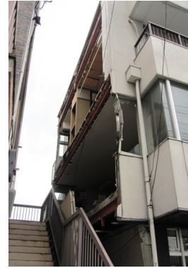
写真 130 外装材の被害 7
