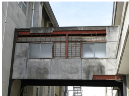
写真7 鉄骨造渡り廊下のモルタル壁の剥落
