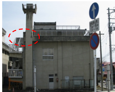
写真2 煙突の曲げひび割れ
