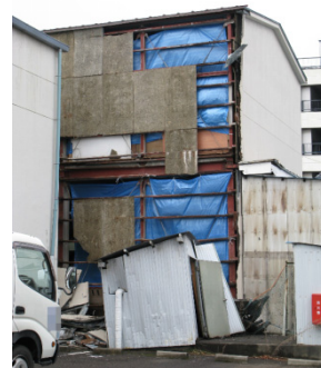
写真 125 外装材の被害 2
