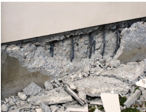
写真 55 1階袖壁脚部のコンクリートの剥落と壁筋の座屈
