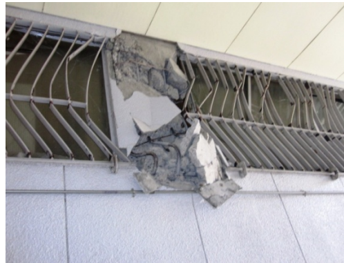
写真 48 2階の短柱のせん断破壊
