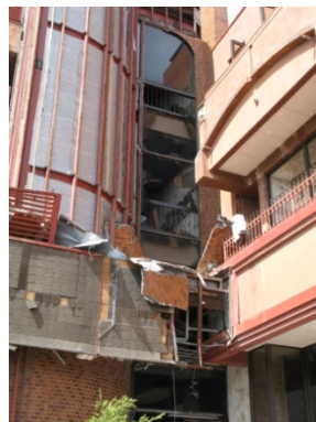
写真 20 外壁仕上げの落下
