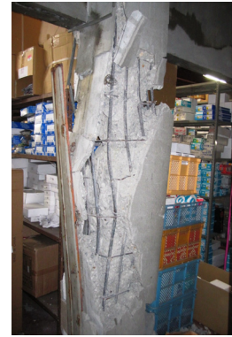
写真 107 長柱のせん断破壊
