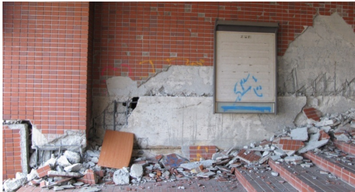
写真 17 壁及び SRC 柱脚の損傷
