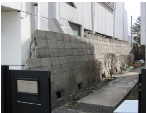
写真 61 コンクリートブロック塀の倒壊
