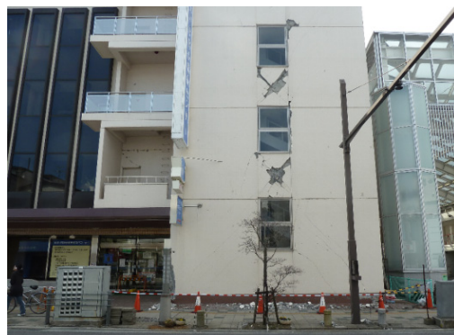
写真 54 壁の縦開口隅角部を結ぶせん断ひびわれ
