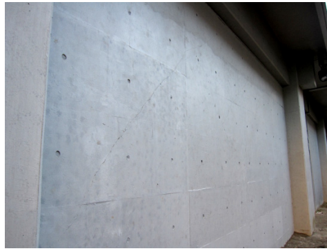
写真 92 低層棟 1F 耐震壁のせん断ひび割れ
