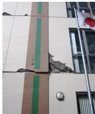
写真 56 2階袖壁脚部の損傷と打ち継ぎ部の水平ひび割れ
