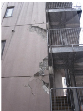
写真 73 鉄骨造外階段手すりとの接続部の損傷
