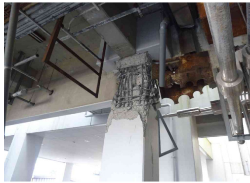
写真 123 柱頭での曲げ破壊
