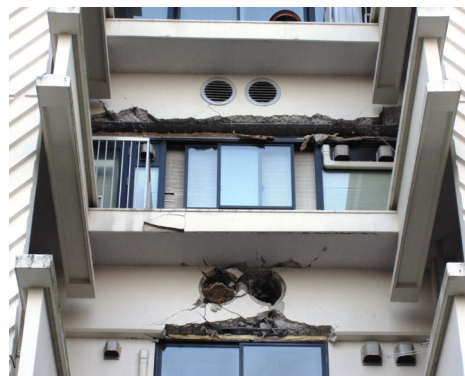
写真 95 開口付き境界梁の付着割裂破壊 (上階) とせん断破壊 (下階)
