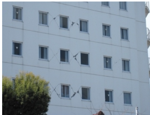
写真 40 非構造壁のせん断ひび割れ
