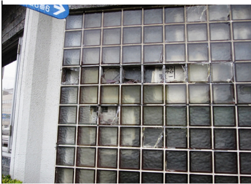
写真 133 ガラスブロックの破損
