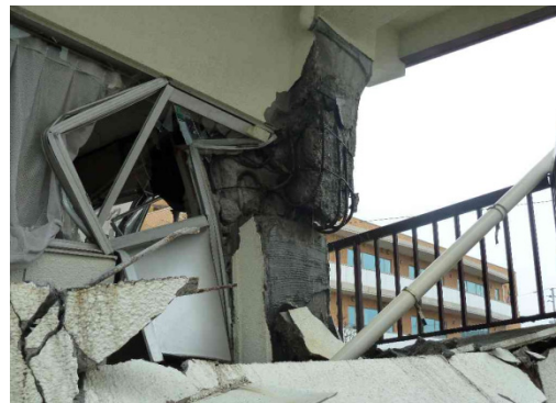
写真 109 腰壁付き短柱の軸崩壊
