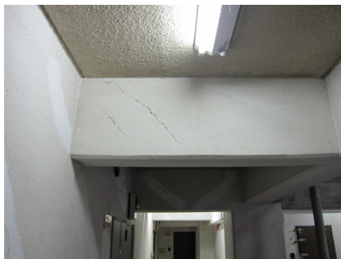
写真 82 短スパン梁に生じたせん断ひび割れ
