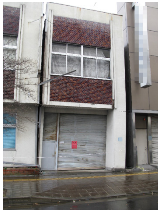
写真 131 建物の残留変形が生じた建築物
