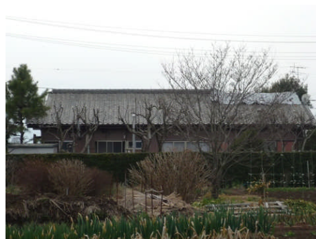
写真 2 屋根瓦の落下（龍ヶ崎市高須町）
