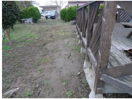
写真 12 液状化による噴砂痕
