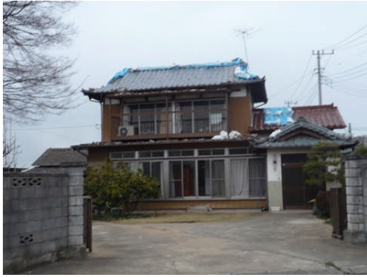
写真 11 常総市上蛇町の屋根瓦の被害
