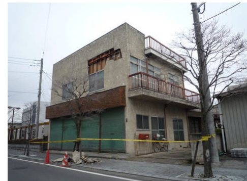
写真8 鉄骨造建築物の外壁落下
