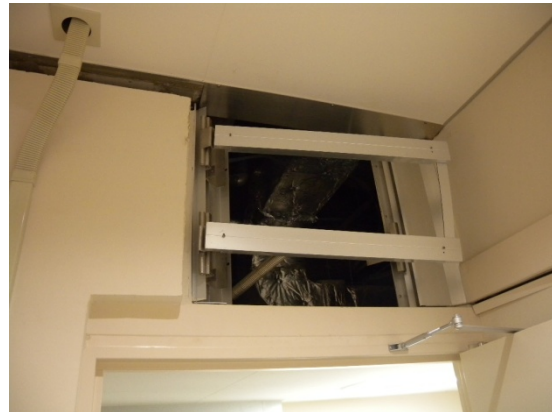
(b) カバーの脱落
