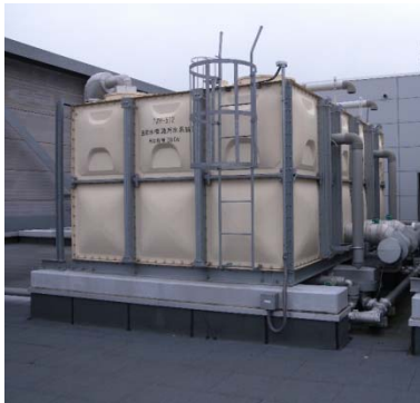
(a) 無被害の貯水槽
