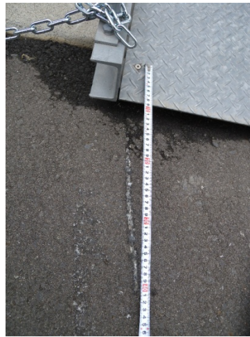
図 4.12-3 屋外エキスパンションジョイント金具におけるすべり痕
