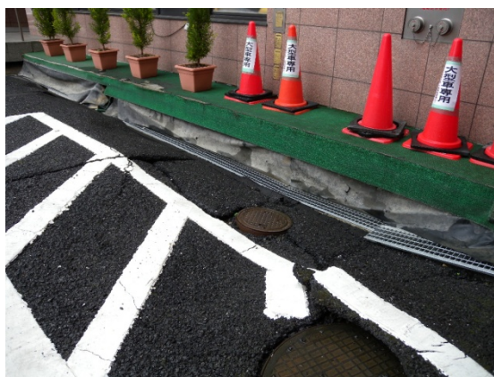
図 4.9-3 建築物周囲の地盤の沈下
