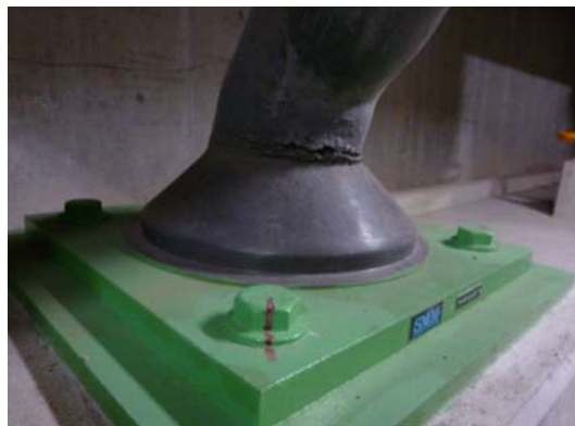
図 4.16-4 鉛ダンパー湾曲部のひび割れ
