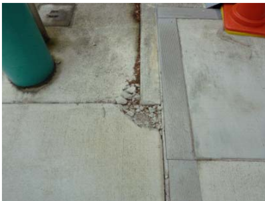
図 4.15-4 玄関部のクリアランス部の損傷
