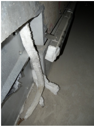
図 4.1-5 免震スリット目地充填材のずれ
