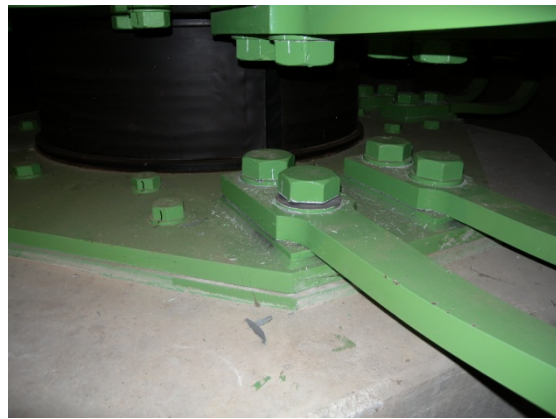
図 4.13-5 鋼材ダンパー基部のボルトの緩み
