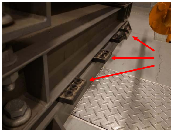
図 4.13-9 設備機器用防振ゴムのはみ出し（塔屋）
