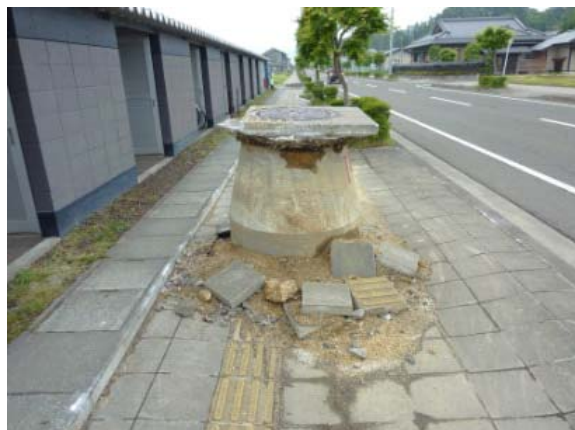
図 4.17-5 白石市鷹栖西の液状化被害
