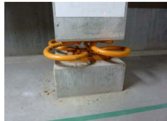
図 4.16-5 鋼材ダンパーの塗装の剥落
