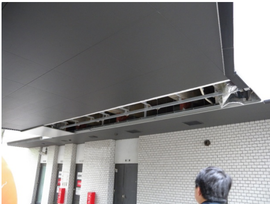
(c) 天井カバーの脱落
