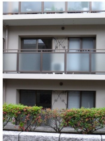
(b) 方立て壁のせん断ひび割れ
