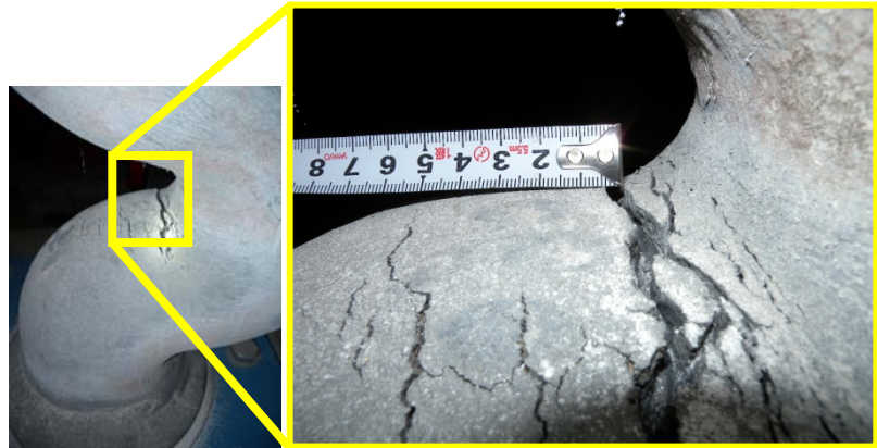
(b) 屈曲部のひび割れの状況
