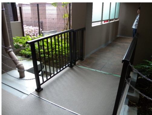
図 4.5-5 エキスパンションジョイント部段差
