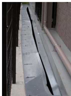
図 4.5-6 クリアランス部カバー破損
