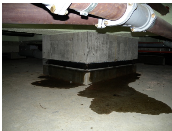
図 4.10-4 転がり支承及び周囲への油漏れ（あふれ出し）
