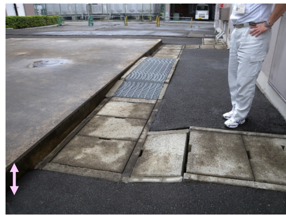
図 4.11-5 地下埋設物の周囲に生じた段差
