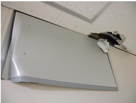
(a) 衝突等によるカバーの破損
