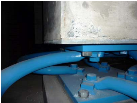
図 4.15-2 鋼材ダンパー上部コンクリートの剥落
