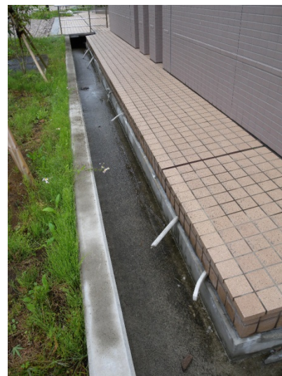
図 4.11-7 シール材のはみ出し
