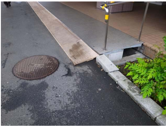
図 4.11-4 段差解消の応急措置
