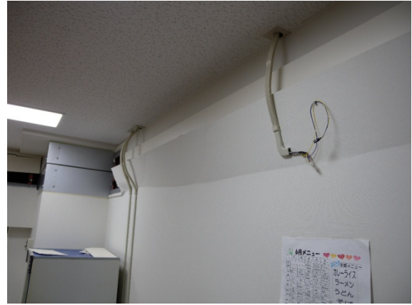
図 4.1-4 免震スリット位置での内装の折れ・はがれ
