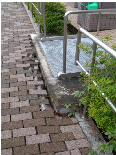
図 4.11-6 インターロッキングの乱れ
