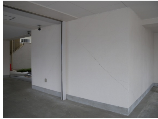
図 4.3-3 駐車場壁のひび割れ
