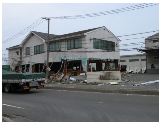
図 4.2-3 隣接する区画での津波被災状況
