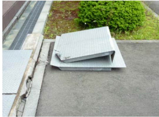
図 4.16-3 変形して取り外した側溝の蓋
