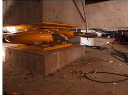
図 4.9-7 鋼棒ダンパーの塗装剥がれ
