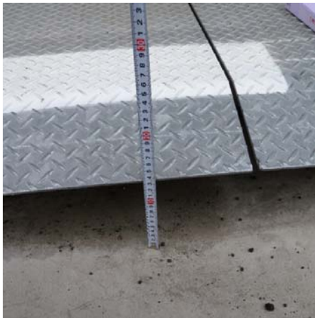
図 4.3-4 周囲地盤の沈下による段差
