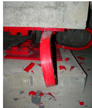
(2) 鋼材のゆがみ
