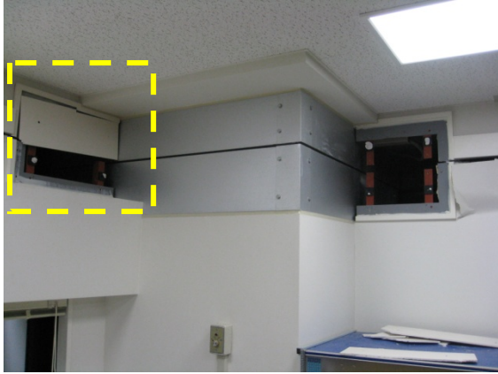
図 4.1-3 免震部材（被覆つき）周囲のカバー破損
