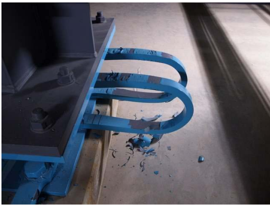
図 4.13-4 鋼材ダンパーのゆがみ・塗装剥がれ
