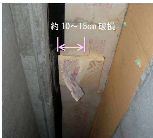
図 4.4-4 スチロール破損状況 (左に擁壁立上り部)
