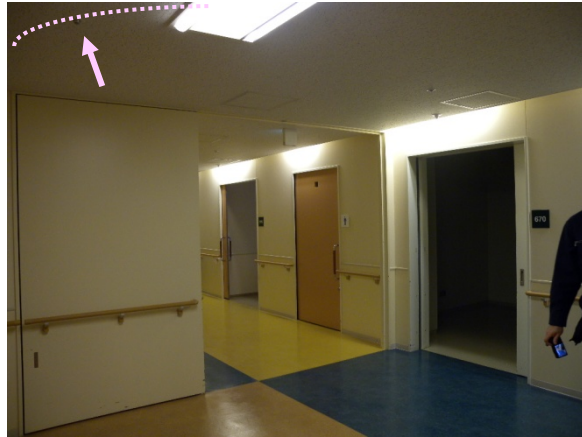
図 4.13-7 防火戸が地震時開いた際に接触した天井消火栓と蛍光灯（カバー）
