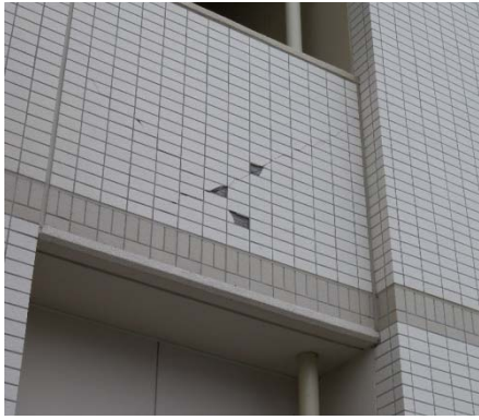
図 4.3-2 外装タイルの落下
