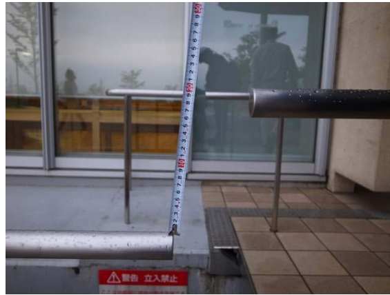
(b) 手すりに生じた段差 (約 20cm)
