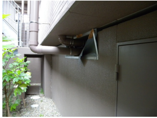
図 4.6-3 配管用カバーの破損・脱落
