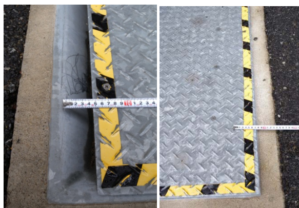
図 4.10-6 エキスパンション部分のずれ
