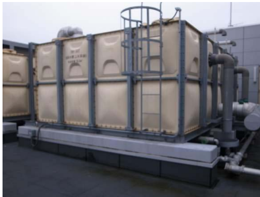
(b) 底部が破損した貯水槽
