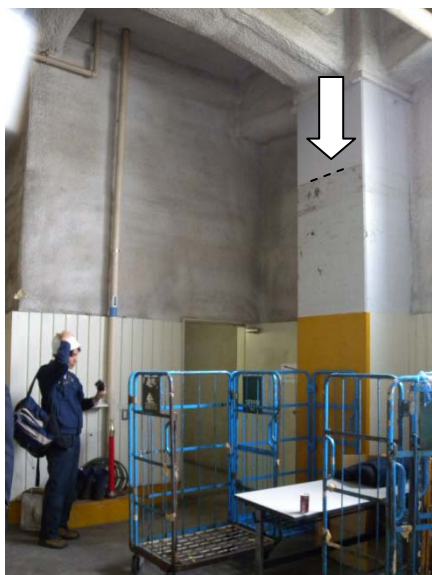
図 4.2-2 隣棟内の津波の痕跡
