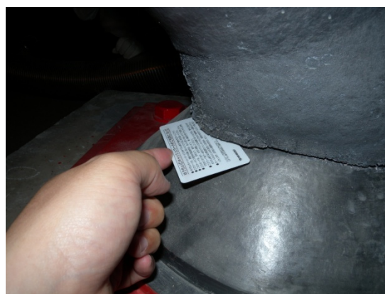
図 4.9-5 鉛ダンパーのひび割れ状況
