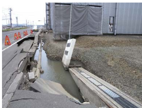
図 4.2-5 建築物周囲の地盤変状
