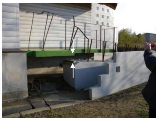
写真 5.5.2.1-35 スロープ部の段差
