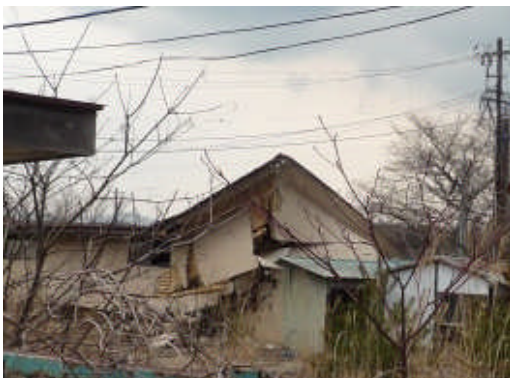
写真 5.2.6-27 倒壊した建築物
