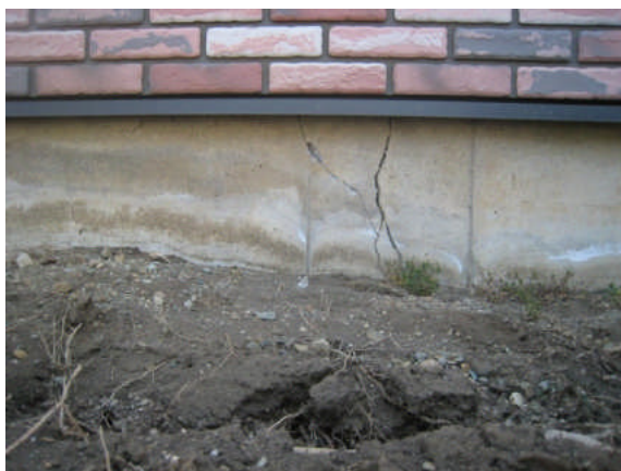
写真 5.5.2.3-35 写真 5.5.2.3-33 の住宅の基礎の損傷と盛土の変状
