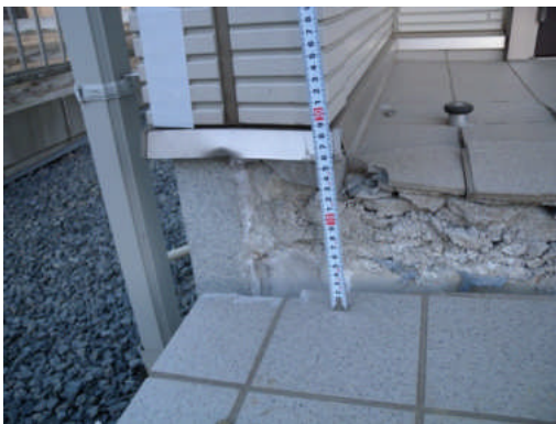
写真 5.5.2.1-41 建築物入口付近の段差
