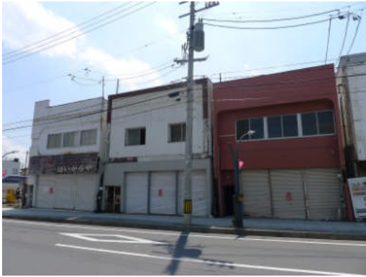
写真 5.2.2-29 傾斜した店舗併用住宅 3 棟
