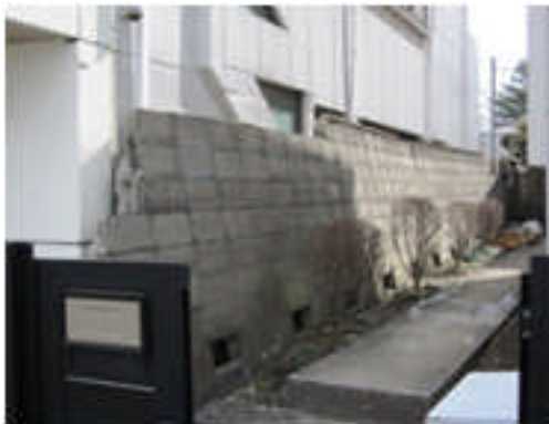
写真 5.4-153 コンクリートブロック塀の倒壊
