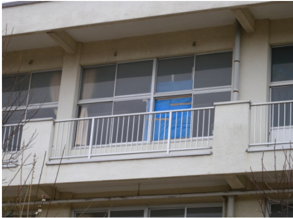
写真 5. 6-32 窓ガラスの被害
