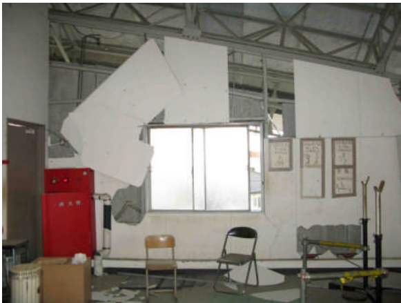
写真 5.3-48 内装仕上げの落下 (HKT-2)
