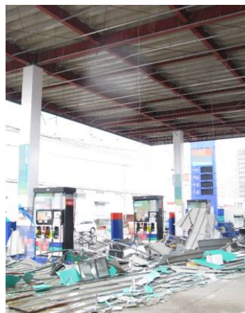
写真 5. 6-13 ガソリンスタンドの天井の被害
