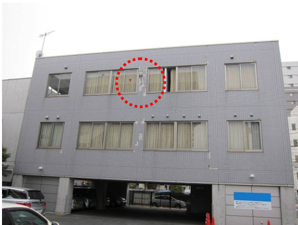
写真 5.6-30 ALC パネル外壁の被害
