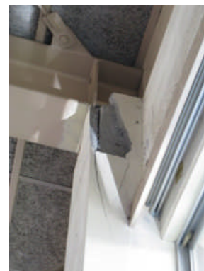
写真 5.3-22 仕上げモルタルの剥落 (MIT-27)
