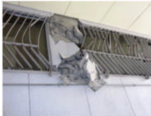
写真 5.4-142 2階の短柱のせん断破壊
