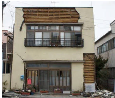
写真 5.2.6-6 外壁モルタルが剥落した住宅
