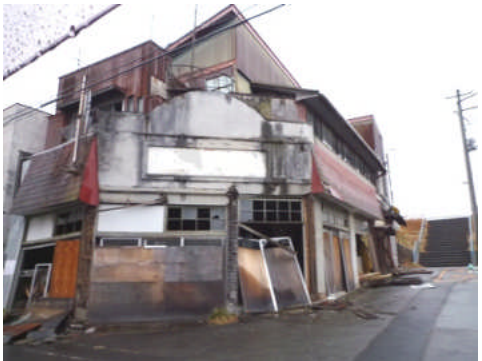
写真 5.2.1-12 老朽化した商店建築物の被害
