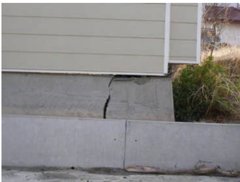
写真 5.2.8-9 住宅基礎の割れ
