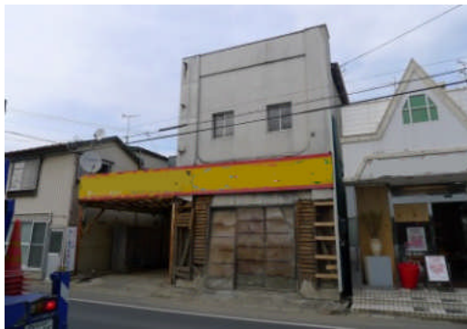
写真 5.2.4-7 外壁が剥落した店舗併用木造住宅
