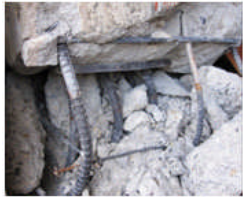
写真 5.4-172 SRC柱脚部の損傷
