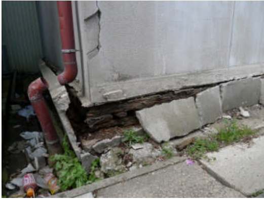
写真 5.2.2-27 写真 5.2.2-26 の剥落部の 土台の腐朽
