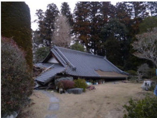
写真 5.2.9-1 1階が完全に崩壊した住宅
