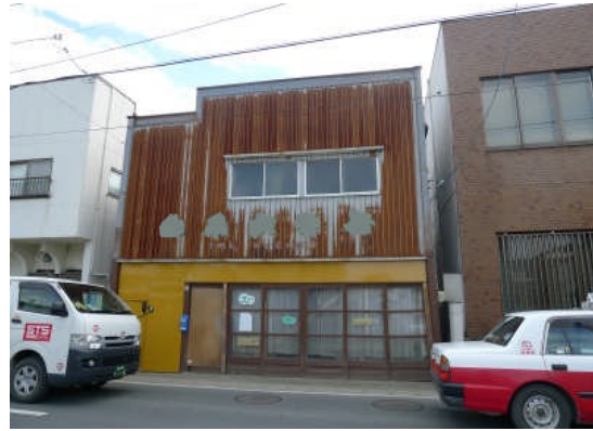
写真 5.2.4-6 傾斜した店舗併用木造住宅
