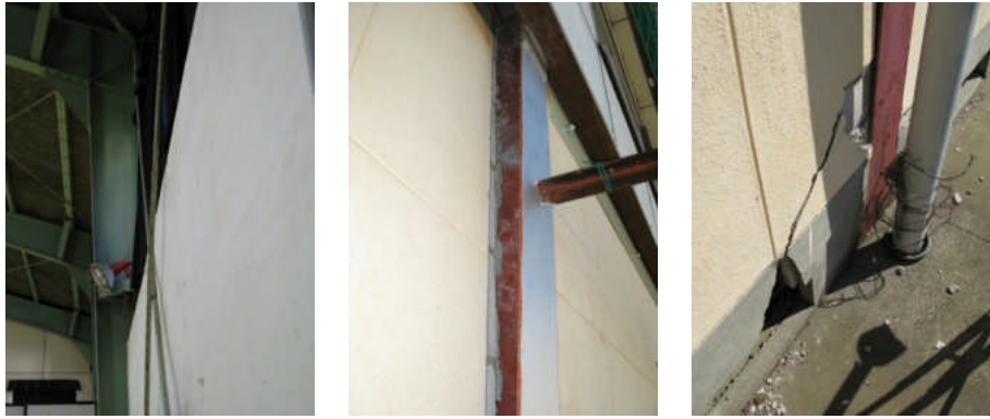
(a) 内部 (b)外部 (c)壁の脚部の損傷
