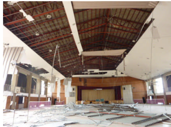
写真 5.3-43 天井材脱落 (MIT-7)
