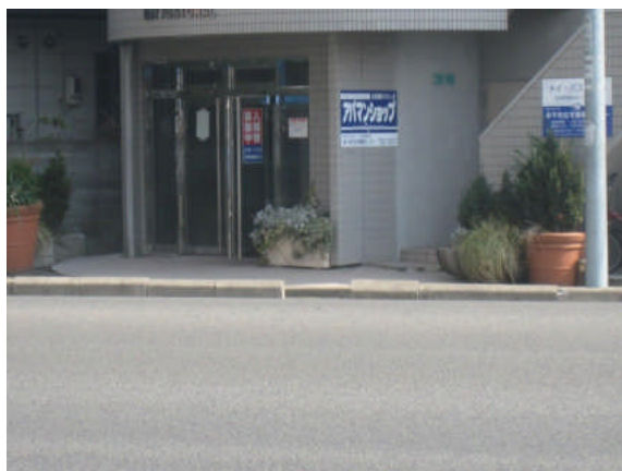
写真 5.5.2.3-21 建物に対する地盤の相対沈下（仙塩街道の南側）
