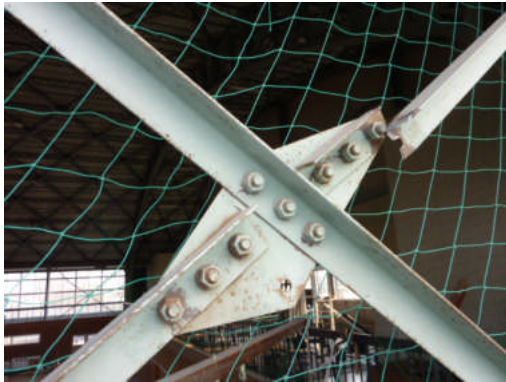
(a) 接合部の破断
