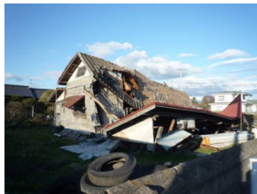
写真 5.2.3-10 倒壊した納屋
