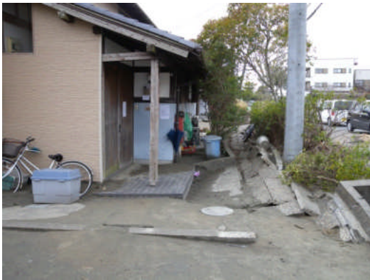
写真 5.5.2.1-29 住宅玄関付近の沈下
