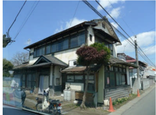
写真 5.2.2-19 外壁が剥落し、傾斜した木造住宅
