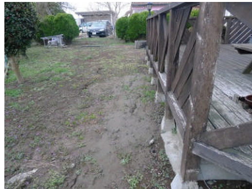
写真 5.2.12-4 液状化による噴砂痕
