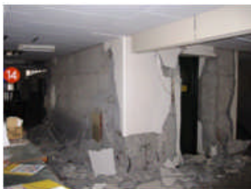
写真 5.4-120 コア壁のせん断破壊
