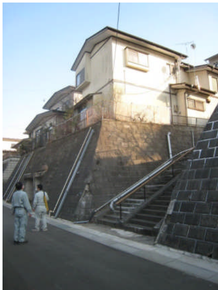
写真 5.5.2.3-13 宅地盛土の滑動・地盤変状による宅地擁壁の損傷（青山2丁目付近）
