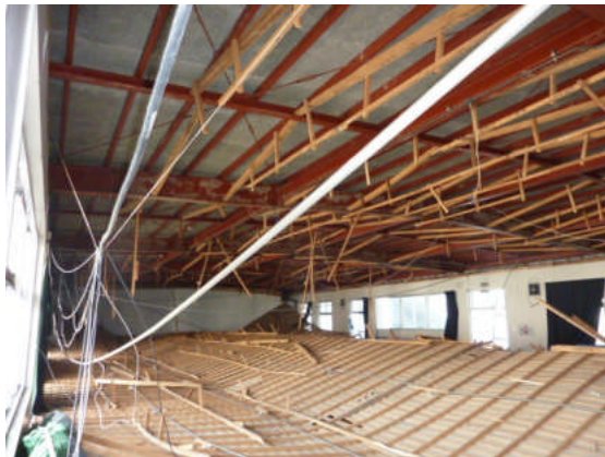
写真 5.3-42 天井材脱落 (MIT-5)
