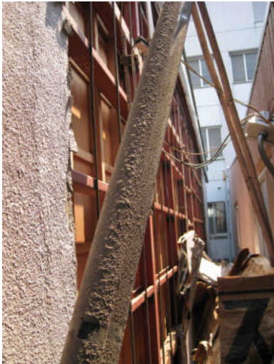
写真 5.3-46 外装仕上げの落下 (MIT-5)
