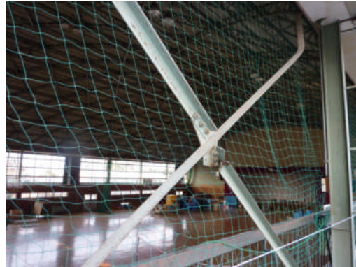
(b) 座屈と接合部の破断
