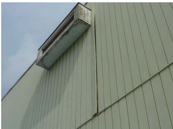
写真 5. 6-64 外壁の金属サイディングの外れ
