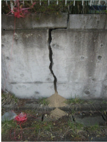
写真 5.5.2.3-31 写真 5.5.2.3-30 の住宅の盛土擁壁の破壊
