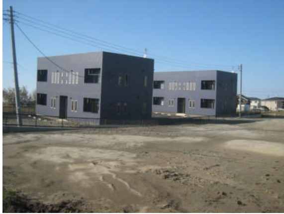
写真 5.5.2.1-45 液状化による宅地盛土および小型集合住宅の沈下・傾斜
