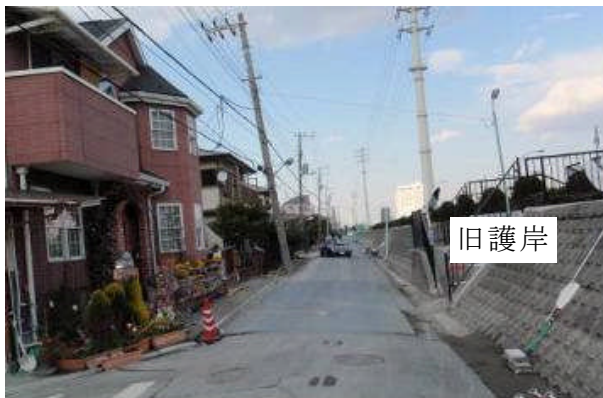
写真 5.5.2.2-11 右側に傾斜した道路
