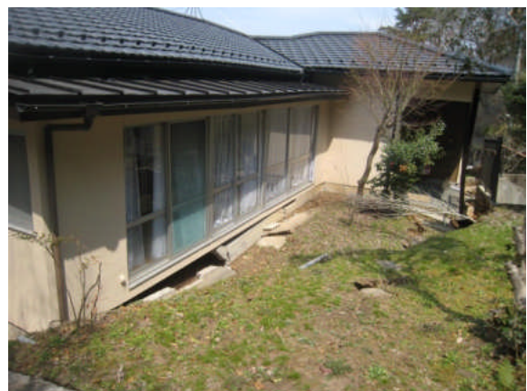
写真 5.5.2.3-8 写真 5.5.2.3-7 の住宅の宅地盛土の滑動・地盤変状による基礎の破壊
