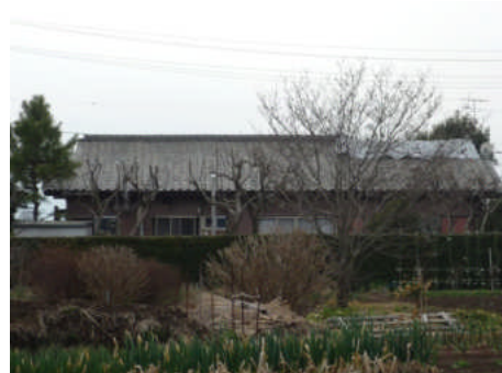
写真 5.2.13-2 屋根瓦の落下 (龍ヶ崎市高須町)
