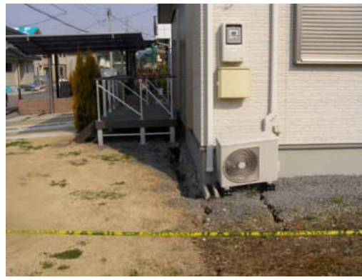
写真 5.2.8-4 地盤のひび割れとすべり
