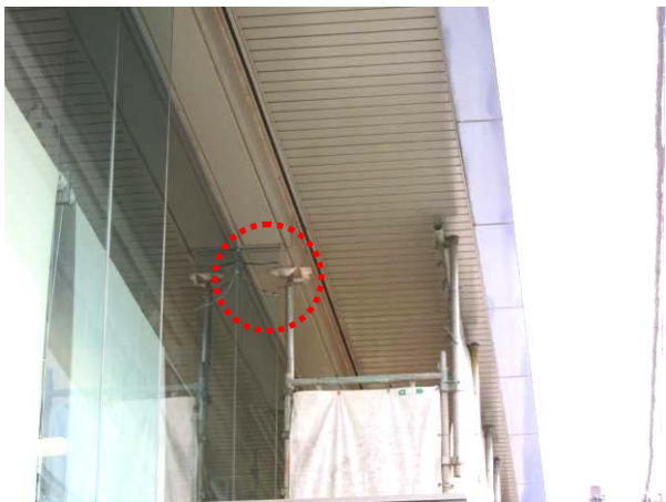
写真 5. 6-35 ガラススクリーンの被害
