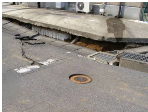
写真 5.2.8-8 宅地地盤の浮沈
