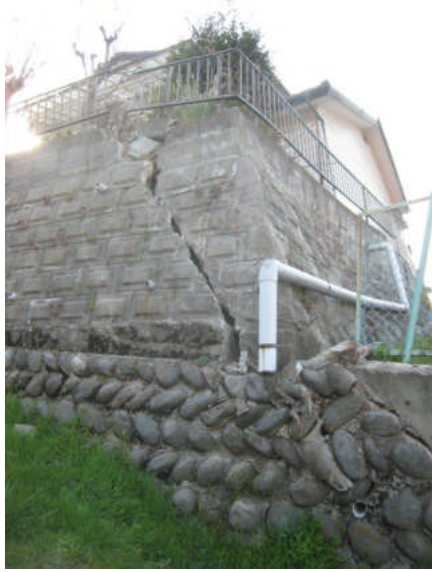
写真 5.5.2.3-11 写真 5.5.2.3-10の住宅の斜面側に位置する擁壁の損傷（青山2丁目付近）
