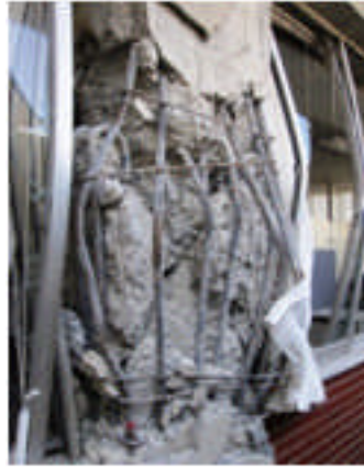
写真 5.4-123 主筋段落とし部を起点としたせん断破壊の状況
