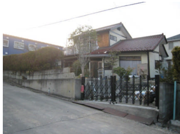
写真 5.5.2.3-16 宅地盛土の滑動・地盤変状による住宅の大変形
