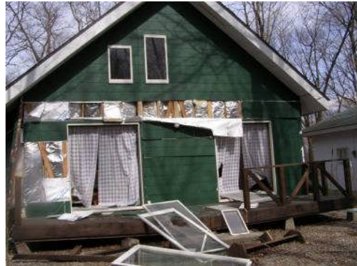
写真 5.2.7-8 大きく損壊した建物 (豊原乙地区)
