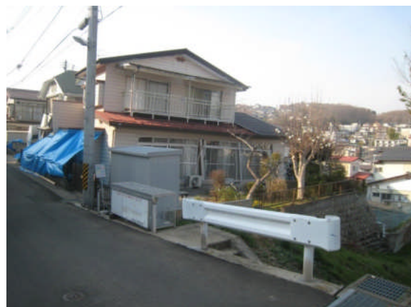
写真 5.5.2.3-10 宅地盛土の滑動・地盤変状による住宅の変形（青山2丁目付近）
