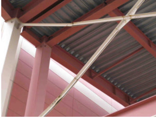
(a) ブレース（山形鋼ダブル）の座屈
