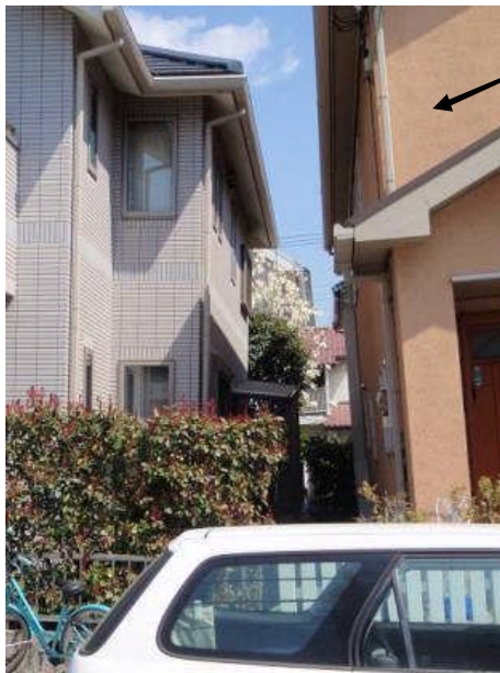
写真 5.5.2.2-5 沈下・傾斜した住宅
