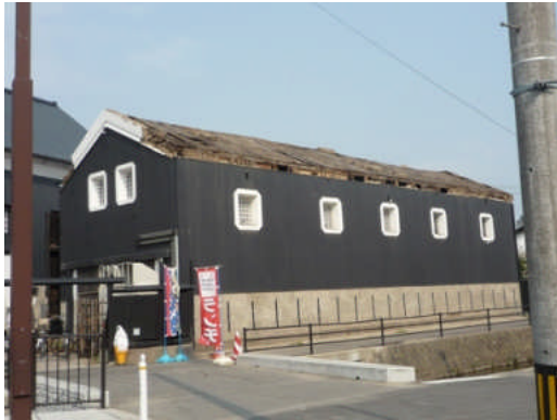
写真 5.2.2-2 屋根が崩落した土蔵
