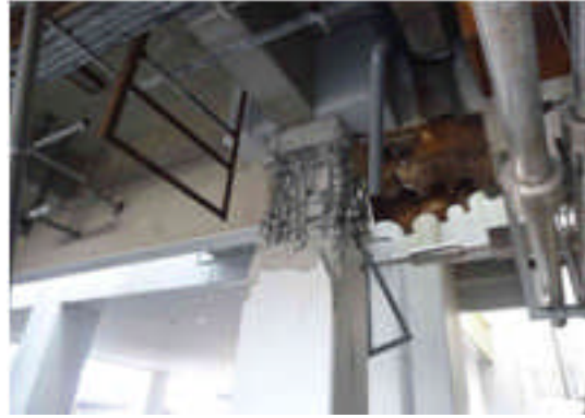
写真 5.4-60 柱頭での曲げ破壊
