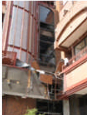
写真 5.4-174 外壁仕上げの落下
