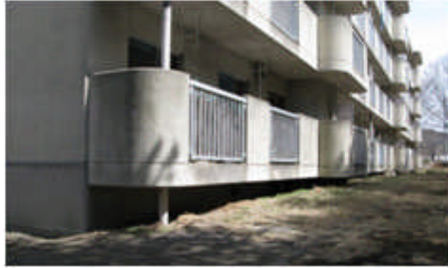
写真 5.4-164 a 棟外観 (沈み込みの小さい妻面側から見る)
