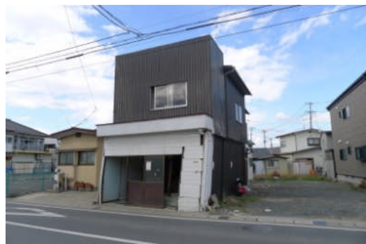
写真 5.2.4-4 傾斜した店舗併用木造住宅
