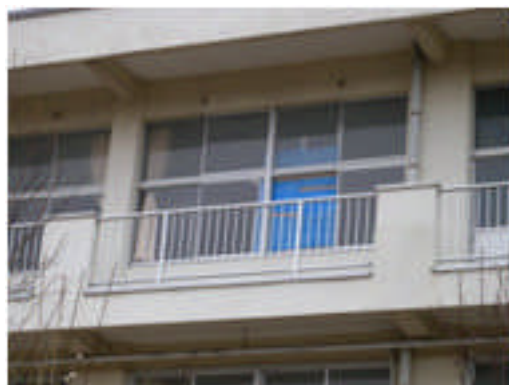
写真 5.4-179 ガラス窓の脱落 （写真 5.4-178 の○印内）
