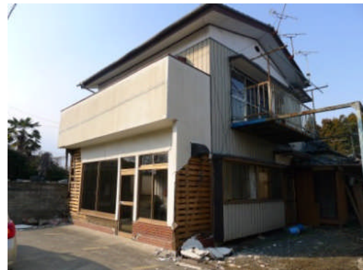
写真 5.2.10-6 モルタルの剥落 (那珂市瓜連)
