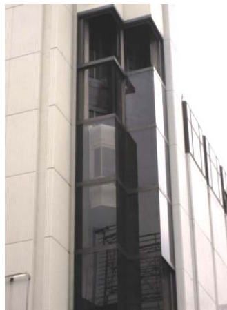
写真 5. 6-11 エレベーター周りのガラス被害
