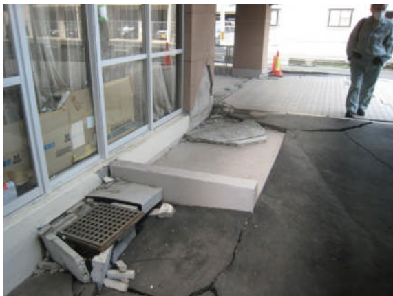
写真 5.5.2.3-27 建物 A の傾斜側の地表面に生じた盤ぶくれ
