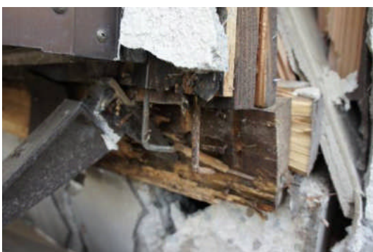
写真 5.2.7-24 写真 5.2.7-23 の柱脚接合部 及び生物劣化
