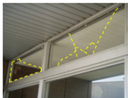
写真 5.4-67 ガラスの破損
