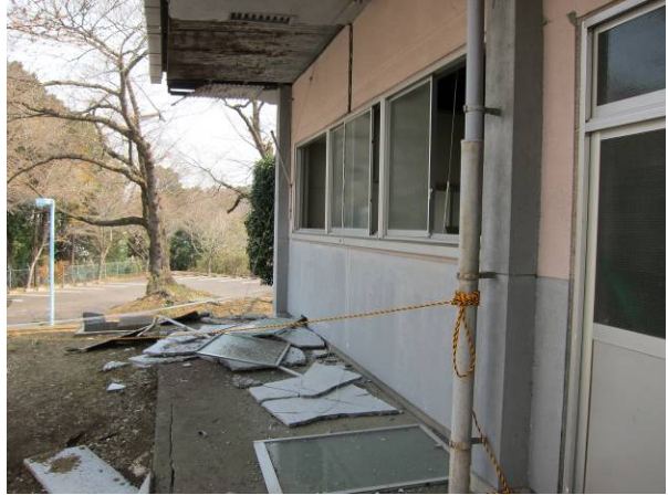
写真 5. 6-49 ラスモルタルによる軒天井の被害
