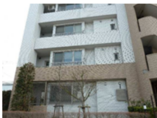
写真 5.4-89 非構造外壁の損傷
