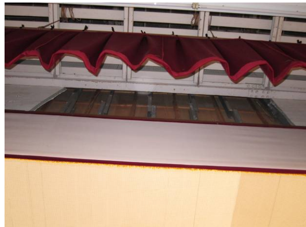
写真 5. 6-51 舞台上部の内壁の脱落被害
