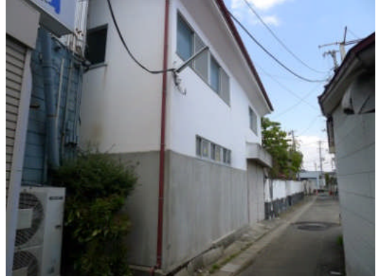
写真 5.2.2-26 外壁モルタルが剥落した倉庫
