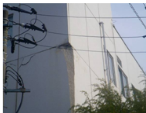
写真 5.4-92 かぶりコンクリートの剥落状況
