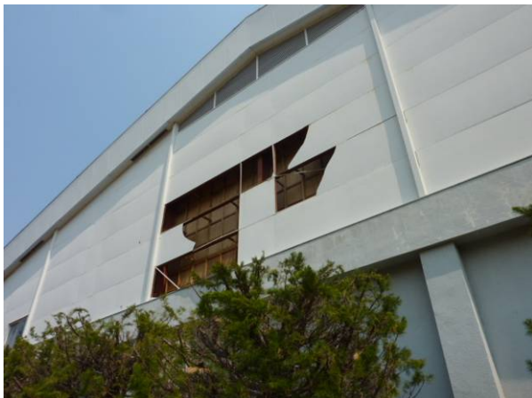
写真 5. 6-61 外装板の破損・脱落
