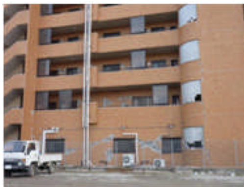
写真 5.4-94 非構造外壁の損傷
