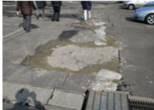
写真 5.4-62 地盤の変状の跡
