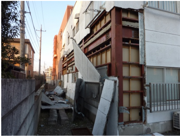
写真 5.6-28 ラスモルタル外壁の脱落被害
