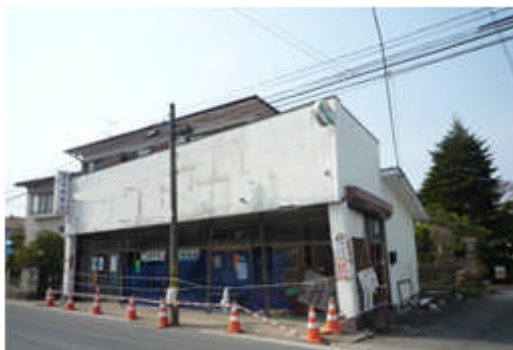
写真 5.2.2-13 残留変形が大きい店舗併用住宅
