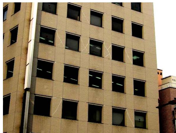
写真 5.6-27 外壁タイルの被害
