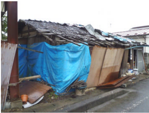
写真 5.2.1-9 老朽化した家屋の倒壊
