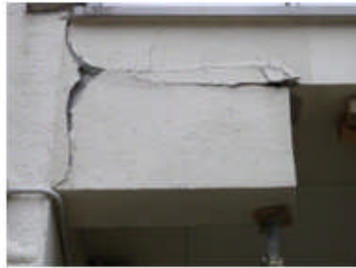
写真 5. 4-190 支持部分の損傷 （写真 5. 4-189 の○印内）
