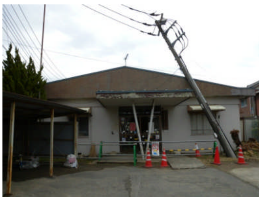
写真 5.5.2.1-3 保健センター入口付近の状況
