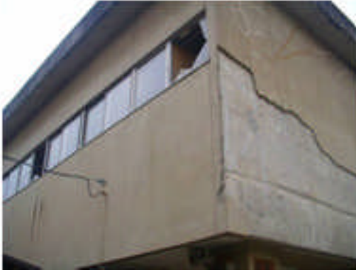
写真 5.4-72 体育館の外装被害
