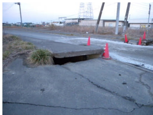
写真 5.5.2.1-42 周辺歩道部分の被害(段差約40cm)
