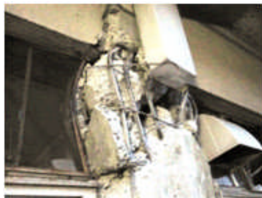
写真 5. 4-200 極短柱のせん断破壊
