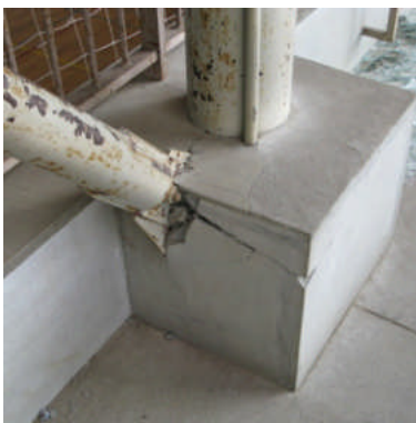
写真 5.3-32 ひび割れ (HKT-2)
