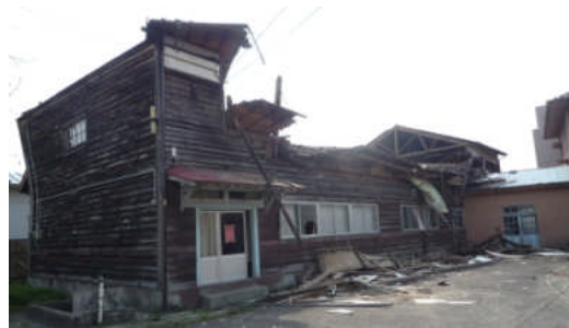
写真 5.2.2-10 2階が崩壊した学校建築
