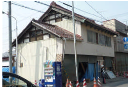
写真 5.2.2-12 残留変形が大きい店舗併用住宅
