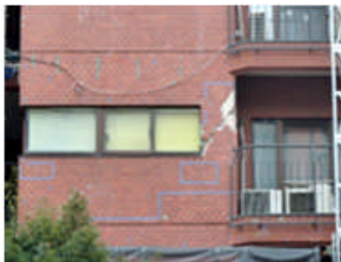
写真 5.4-17 短スパンの間柱のせん断破壊
