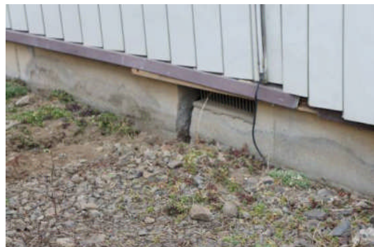
写真 5.2.7-22 写真 5.2.7-19 の無筋基礎の ひび割れ
