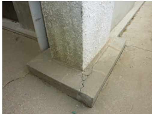
写真 5.3-33 ひび割れ (MIT-13)
