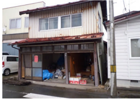
写真 5.2.1-6 町屋形式の住宅の被害
