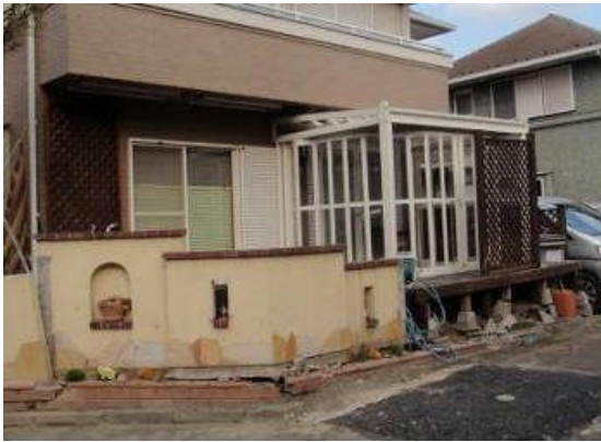
写真 5.5.2.2-9 バルコニー基礎部の被害
