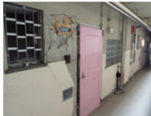
写真 5.4-15 非構造壁のせん断破壊
