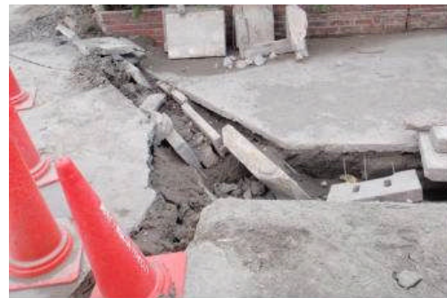
写真 5.5.2.2-12 破断した道路面
