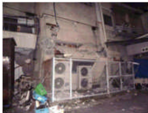
写真 5.4-111 1階耐力壁頂部の曲げ破壊
