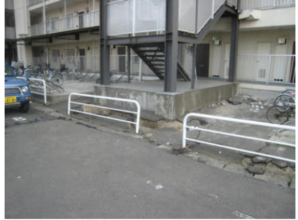
写真 5.5.2.3-24 建物 A の傾斜していない棟に対する地盤の相対沈下
