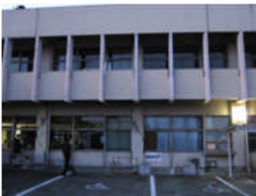
写真 5. 4-199 建築物の被害の外観
