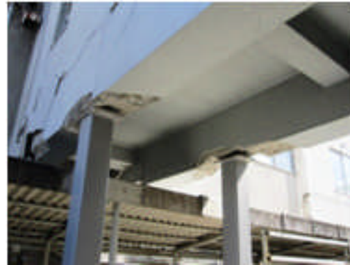
写真 5.4-126 渡り廊下の損傷
