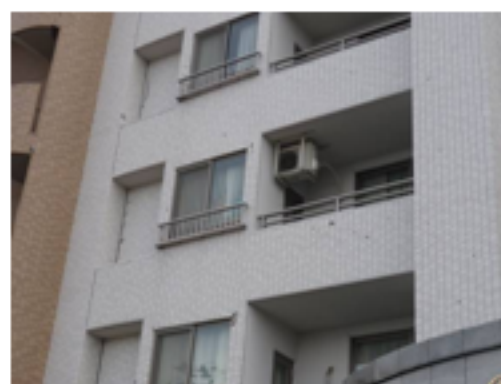
写真 5.4-90 軽微なせん断ひび割れ(梁及び柱)
