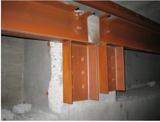
写真 5.3-23 ホールインアンカーの抜け出し跡 (MIT-1)
