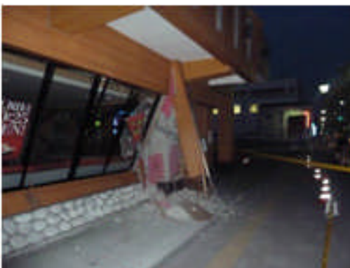
写真 5.4-105 1階柱のせん断破壊
