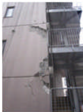
写真 5.4-11 鉄骨造外階段手すりとの接続部の損傷
