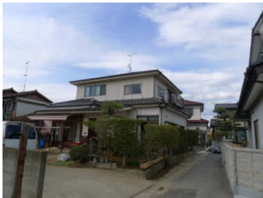
写真 5.2.4-9 外壁に亀裂の入った木造住宅
