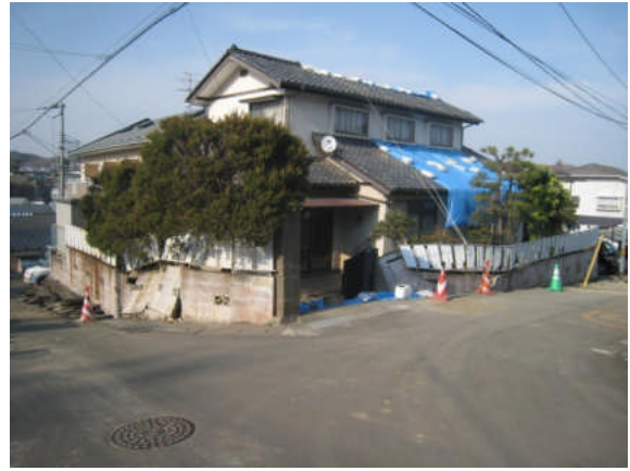
写真 5.5.2.3-12 宅地盛土の滑動・地盤変状により被災した住宅（緑ヶ丘4丁目付近）
