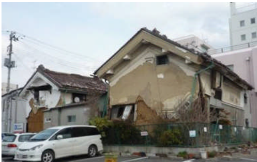
写真 5.2.6-11 大きく損壊して残留変形 がある土蔵
