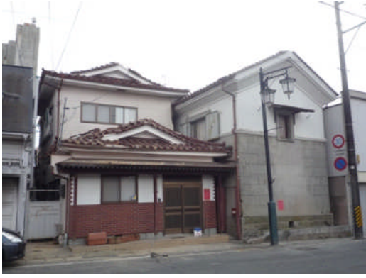
写真 5.2.6-17 残留変形が残る木造住宅
