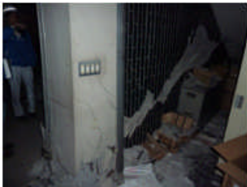
(a) 耐震壁のせん断破壊
