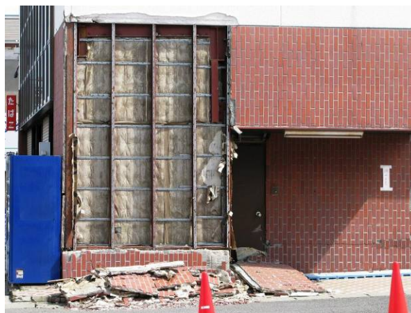
写真 5.6-15 ラスモルタル外壁の脱落被害
