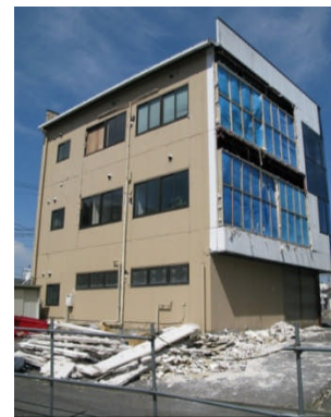
写真 5.3-10 ALCパネルの脱落 (白河市)
