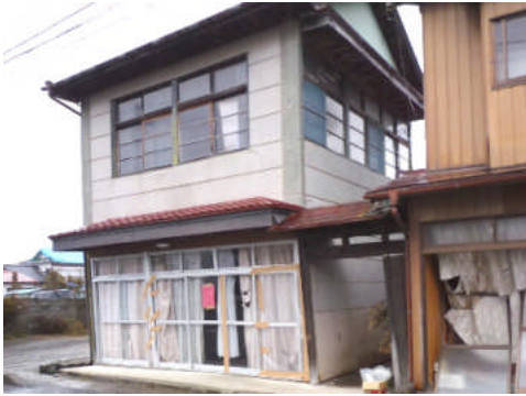
写真 5.2.1-7 町屋形式の住宅の被害
