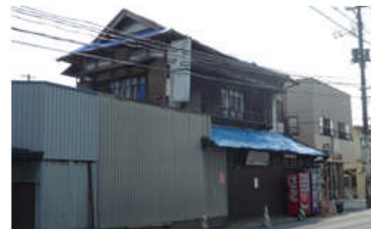
写真 5.2.2-14 2階の方が1階より残留変形が大きい店舗併用住宅
