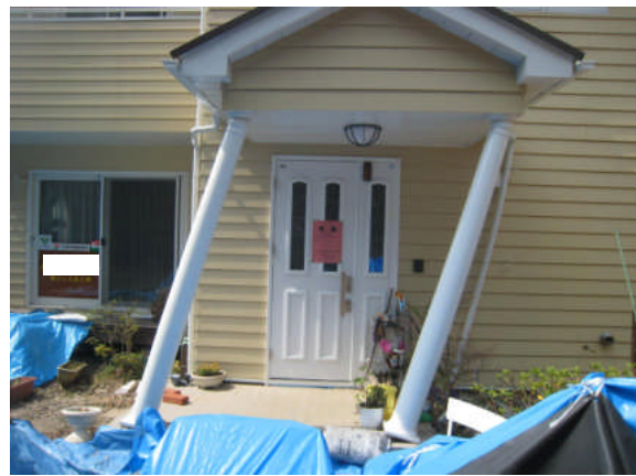
写真 5.5.2.3-2 宅地盛土の滑動・地盤変状の差異により生じた門柱の傾斜
