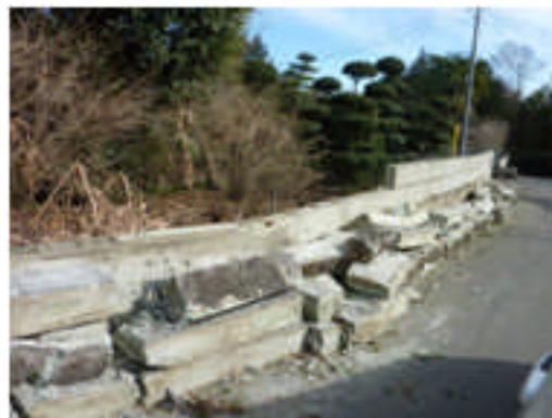
写真 5.4-212 ブロック塀の被害
