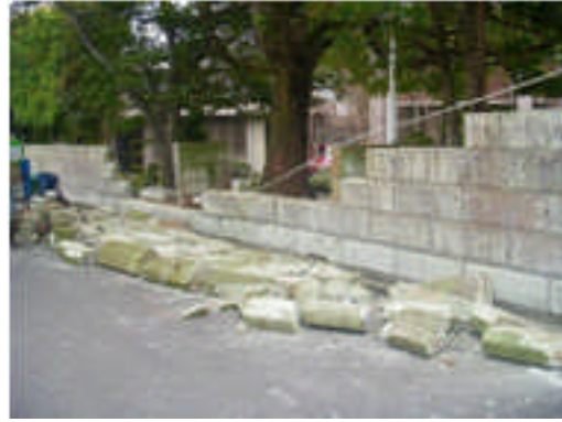
写真 5.4-73 知事公館の石塀の崩壊
