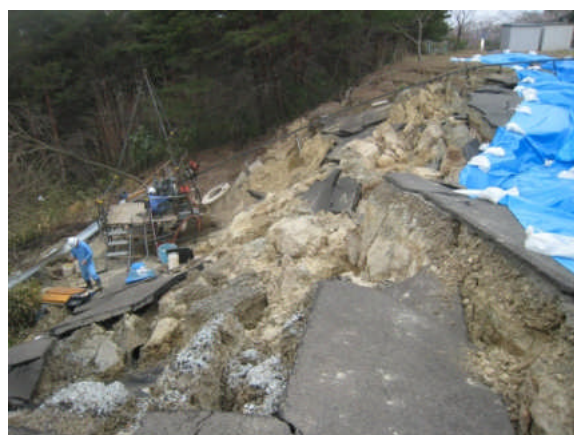
写真 5.5.2.3-37 高台の端部斜面①の地すべり(ボーリング調査が行われている)
