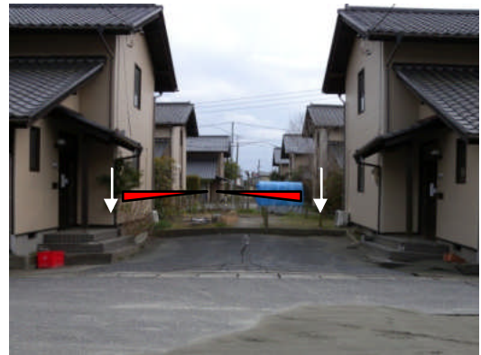
写真 5.5.2.1-30 空地进行を挟んだ2棟の沈下
