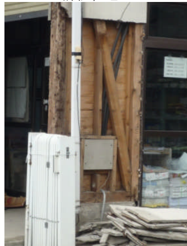
写真 5.2.3-16 写真 5.2.3-15 の隅角部の柱の腐朽
