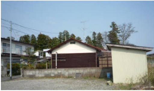
写真 5.2.2-15 大きく傾いた平屋建て住宅
