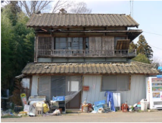
写真 5.2.10-3 店舗併用住宅の被害 (那珂市門部)
