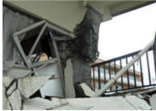
写真 5.4-46 腰壁付き短柱の軸崩壊
