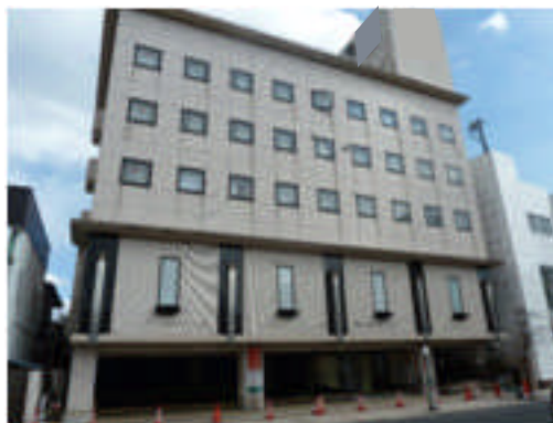
写真 5.4-138 外壁の損傷、タイルの落下
