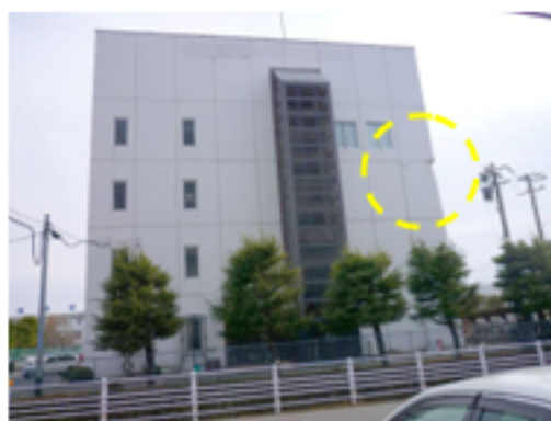
写真 5.4-91 事務所ビル A の外観 (丸印が剥落箇所)
