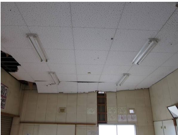
写真 5. 6-44 在来工法による天井の周辺部の被害
