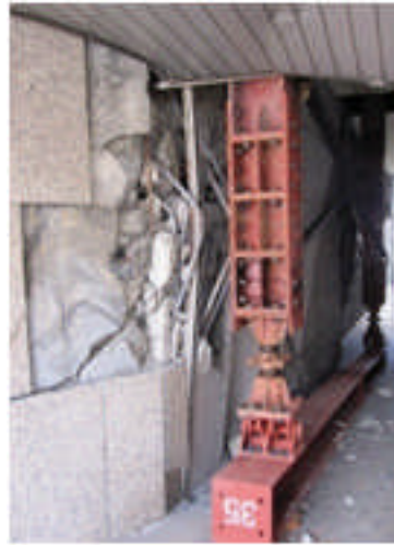
写真 5.4-140 1階柱のせん断破壊
