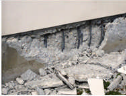
写真 5.4-149 1階袖壁脚部のコンクリートの剥落と壁筋の座屈
