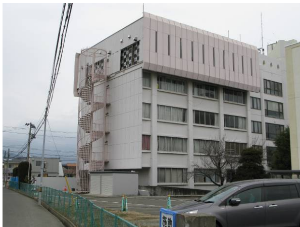
写真 5.6-21 ALC パネル外壁の脱落被害
