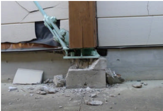
写真 5.2.10-9 基礎コンクリートの破損
