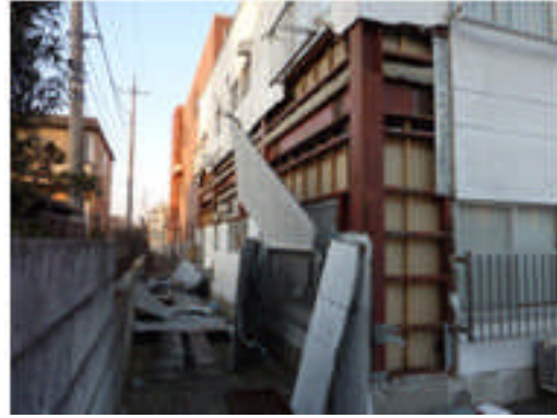
写真 5. 4-198 鉄骨造建築物の外壁仕上げの剥落
