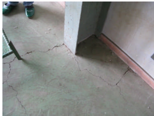
写真 5.3-31 柱脚部のひび割れ (HKT-1)
