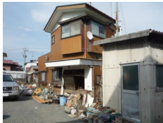
写真 5.2.4-8 大きく傾斜した木造住宅
