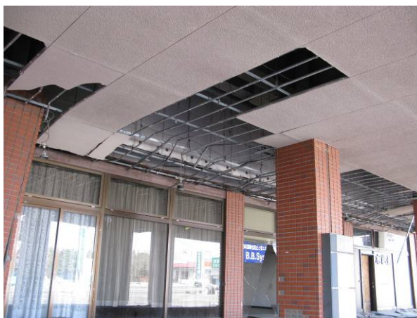
写真 5.6-25 軒天井の被害
