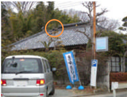
写真 5.4-184 瓦屋根の被害
