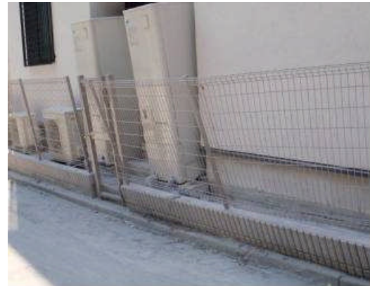
写真 5.5.2.2-2 変形したフェンス
