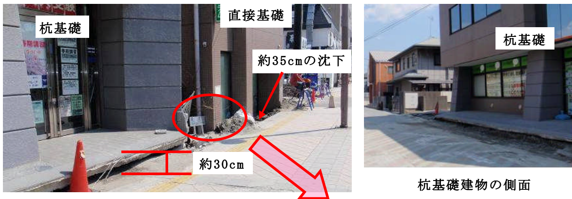
写真 5.5.2.2-14 支持機構による被害状況の違い
