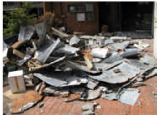
写真 5.4-175 落下した外壁の仕上げ
