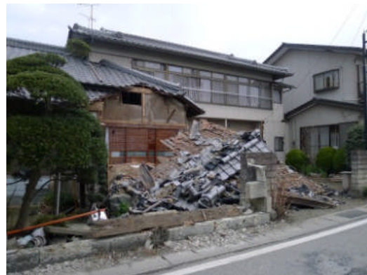
写真 5.2.9-2 住宅の玄関部分の崩壊
