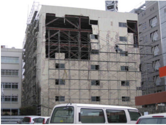
写真 5.3-11 駐車場の外装材の脱落（水戸市）
