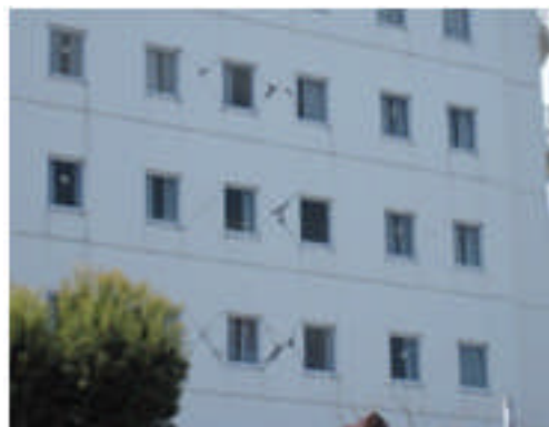
写真 5.4-134 非構造壁のせん断ひび割れ
