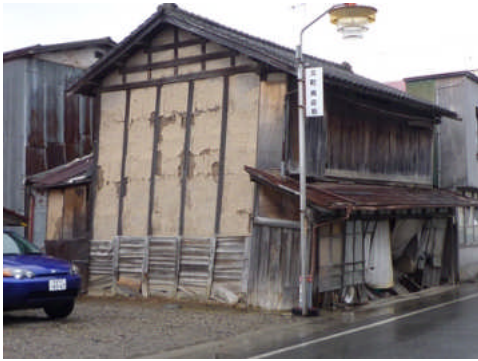
写真 5.2.1-5 町屋形式の住宅の被害
