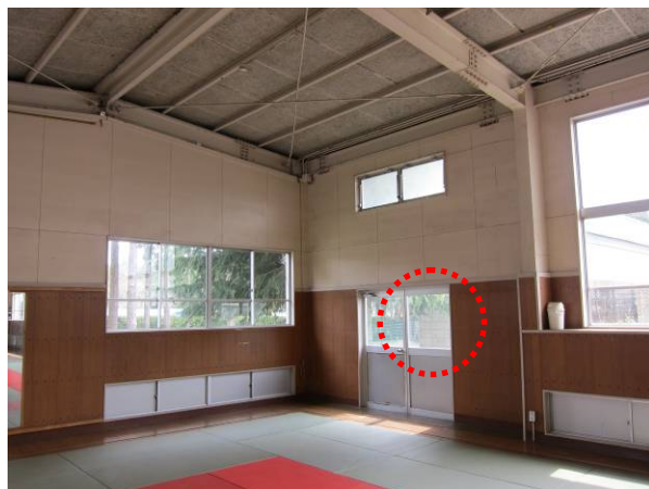
写真 5.6-57 両開きドアのガラスの被害
