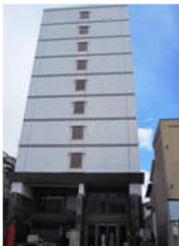
写真 5.4-135 建築物外観 1 (3階壁にせん断ひび割れ)
