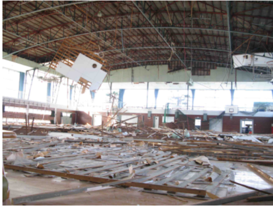
写真 5.3-40 天井材脱落 (HTC-4)
