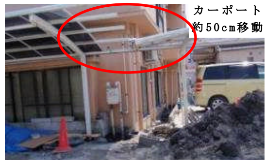
写真 5.5.2.2-4 移動したカーポート
