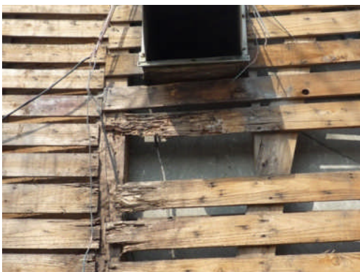
写真 5.2.2-5 写真 5.2.2-4 の南側における生物劣化
