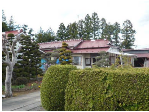
写真 5.2.3-6 残留変形が認められる住宅
