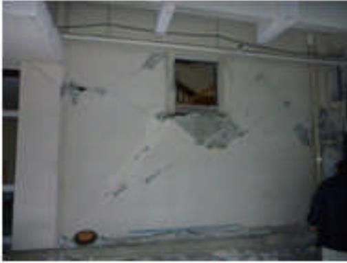
写真 5.4-201 開口部付き耐力壁の破壊
