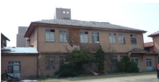
写真 5.2.2-9 屋根瓦と外壁に被害を受けた学校建築
