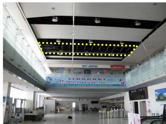
写真 5.6-66 出発ロビー（黄点線が脱落箇所）
