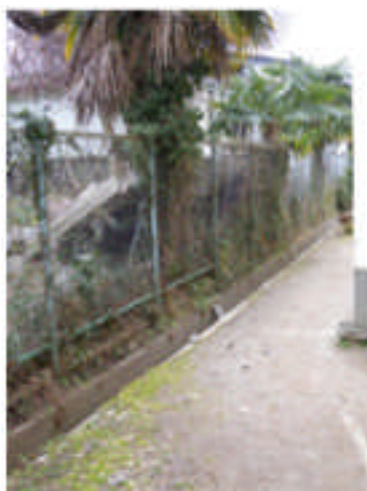
写真 5.4-180 校舎裏のブロック塀の被害
