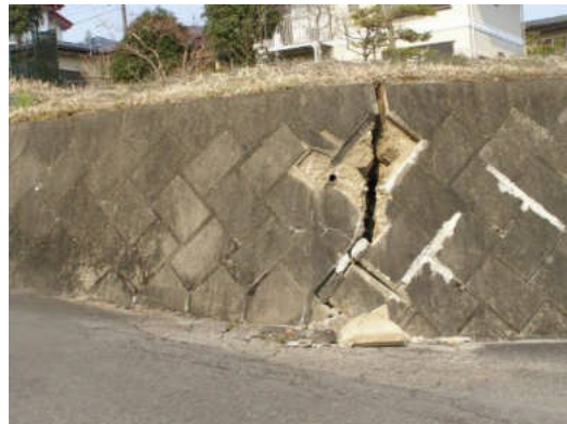
写真 5.2.8-6 擁壁のひび割れ
