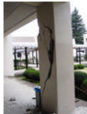
写真 5.4-36 余震でせん断破壊した柱
