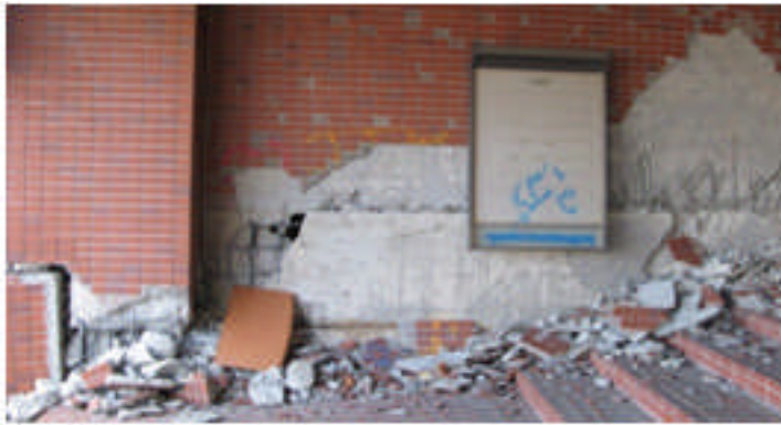
写真 5.4-171 壁及びSRC柱脚の損傷
