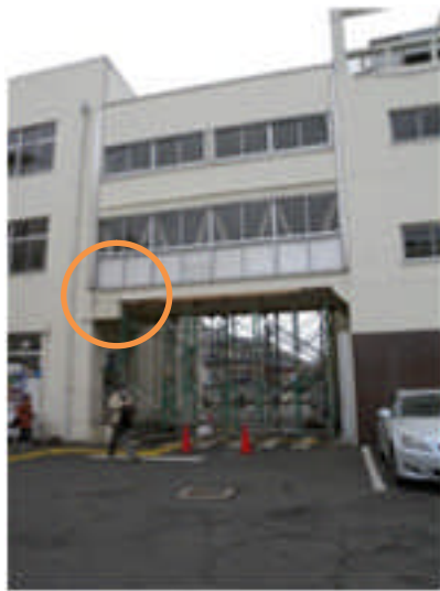
写真 5. 4-189 使用禁止の渡り廊下
