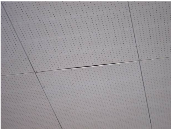
写真 5. 6-46 天井板のとめつけ箇所での浮き
