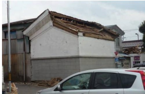
写真 5.2.6-12 屋根だけが崩壊した土蔵
