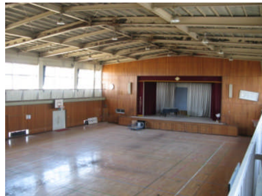
写真 5.3-38 塗装の剥がれ (MIT-27) (梁に沿って床面に跡)
