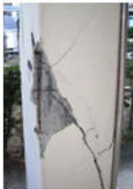
写真 5.4-35 1 階柱のせん断破壊
