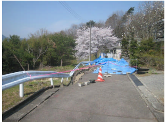
写真 5.5.2.3-32 斜面地②の滑動・地盤変状による道路の陥没
