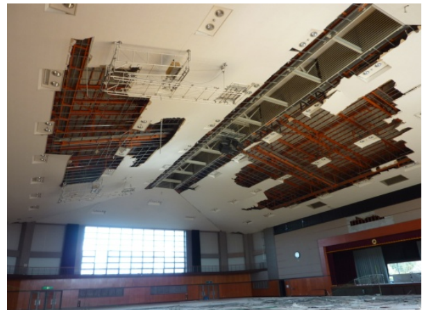
写真 5.6-39 在来工法による天井の脱落被害
