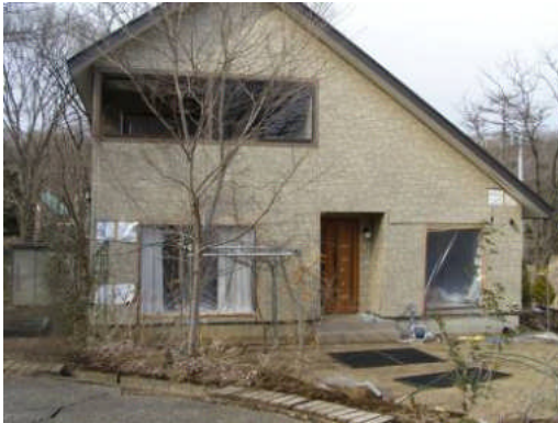
写真 5.2.7-11 サイディングの剥落 (豊原乙地区)
