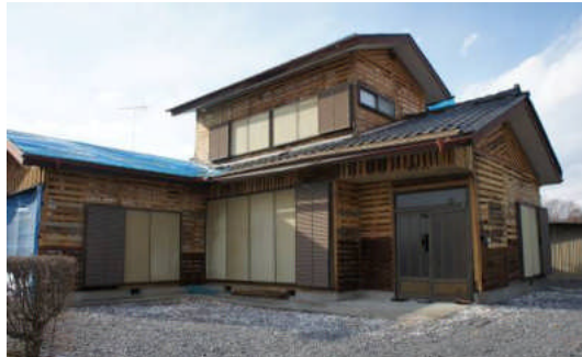
写真 5.2.7-14 住宅の外壁の剥落 (西大久保地区)
