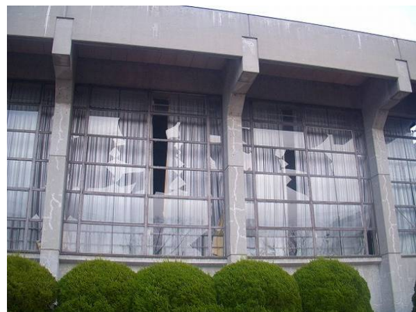
写真 5.6-23 体育館の窓ガラスの被害
