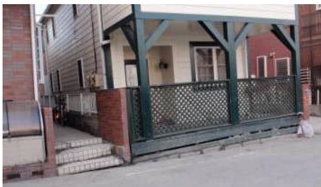
写真 5.5.2.2-13 左側が沈下・傾斜した住宅
