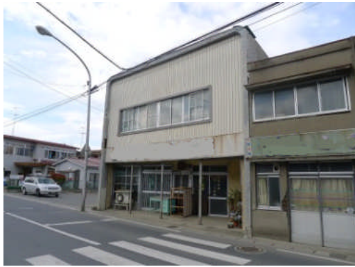
写真 5.2.4-5 傾斜した店舗併用木造住宅
