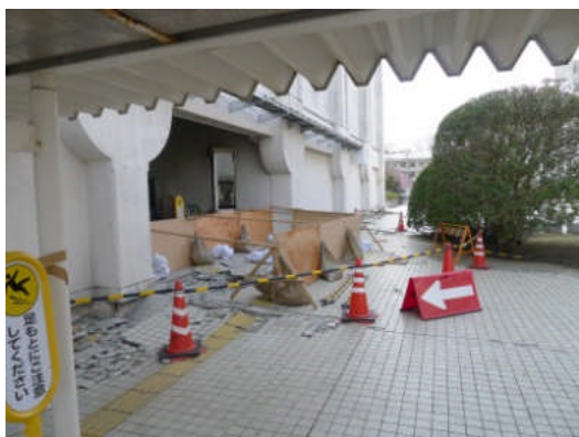
写真 5.2.11-1 市役所周辺の地盤変状
