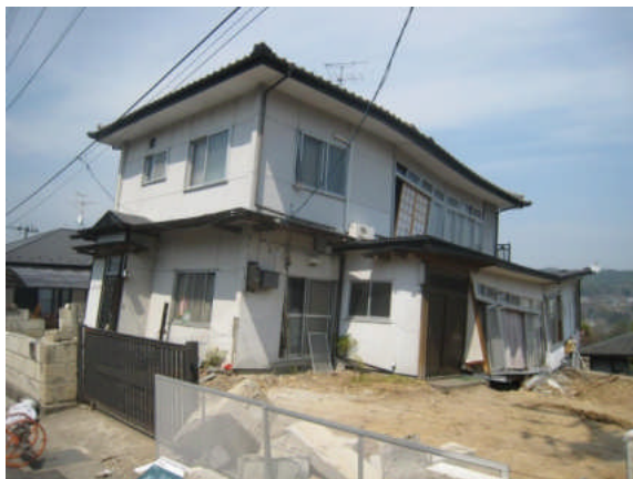
写真 5.5.2.3-5 宅地盛土の滑動・地盤変状による住宅の大変形
