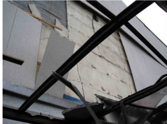
写真 5.3-47 外装仕上げの落下 (MIT-12)
