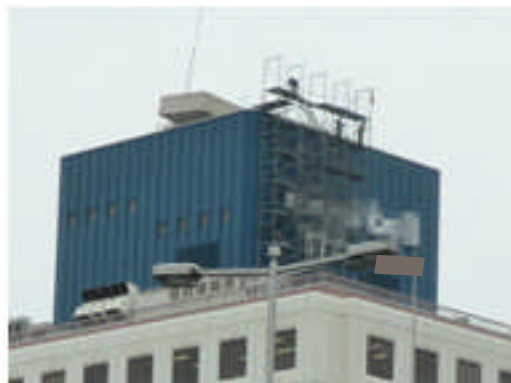
写真 5.4-12 ペントハウスの傾斜
