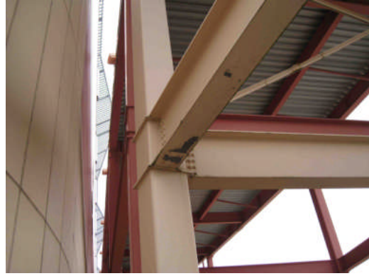
(b) 梁端部塗装の剥がれ
