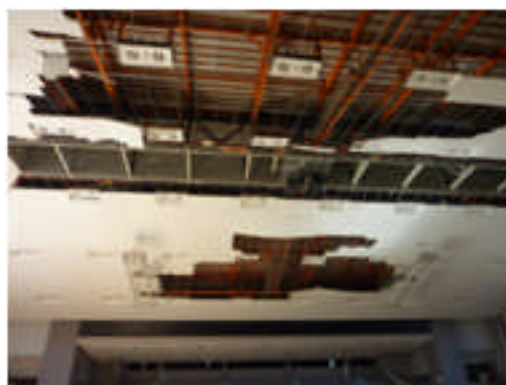
写真 5.4-209 脱落部分の拡大2
