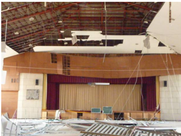
写真 5. 6-50 舞台上部の内壁での被害
