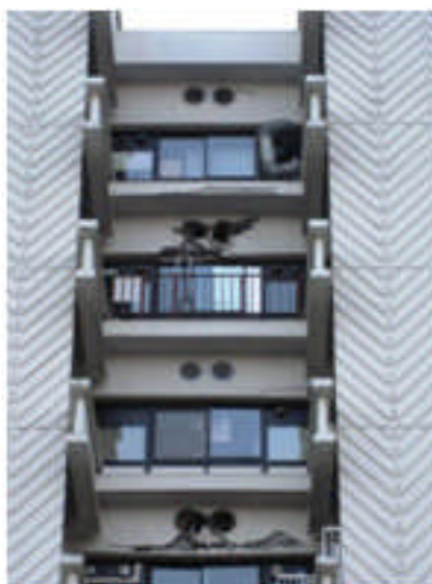
写真 5. 4-32 開口付き境界梁の損傷
