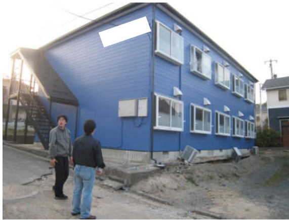
写真 5.5.2.3-17 周辺地盤の沈下・変状による住宅基礎とのギャップ
