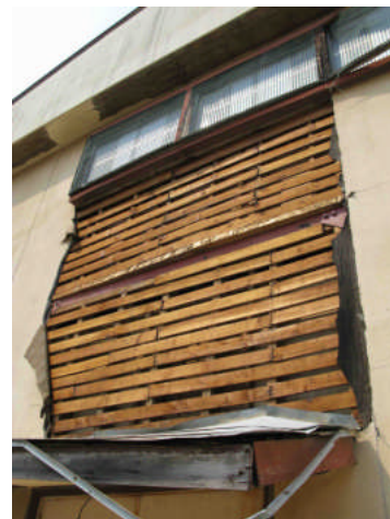
写真 5.3-45 外装仕上げの落下 (SSM-2)
