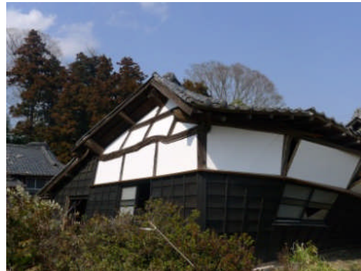
写真 5.2.10-2 大きく傾斜した納屋 (那珂市門部)
