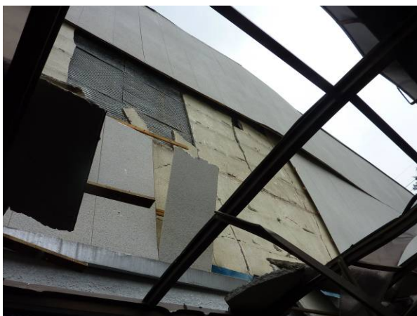
写真 5. 6-63 外装板とラスモルタル外壁の被害
