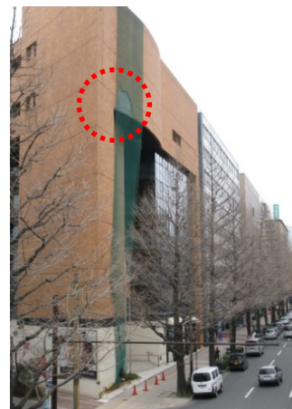
写真 5.6-2 外壁タイルの脱落被害
