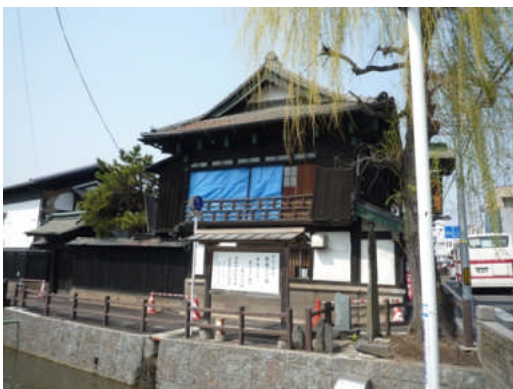
写真 5.2.2-3 店舗として活用されている伝統的構法による民家の被災例
