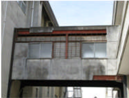
写真 5.4-161 鉄骨造渡り廊下のモルタル壁の剥落
