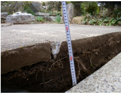
写真 5.5.2.1-9 入口付近の沈下
