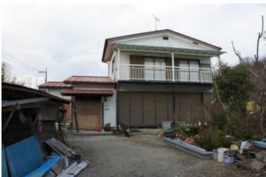
写真 5.2.7-23 大きく損壊した木造住宅 (茶臼地区)
