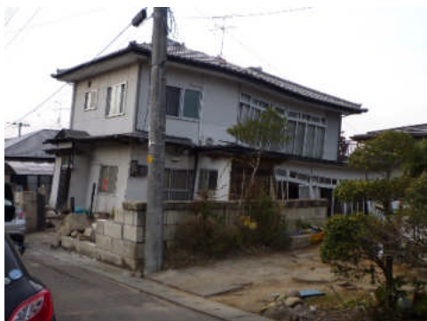
写真 5.2.5-6 地盤変状に伴う住宅被害 (青葉区折立 5 丁目)
