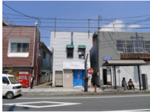
写真 5.2.2-30 傾斜した店舗併用住宅
