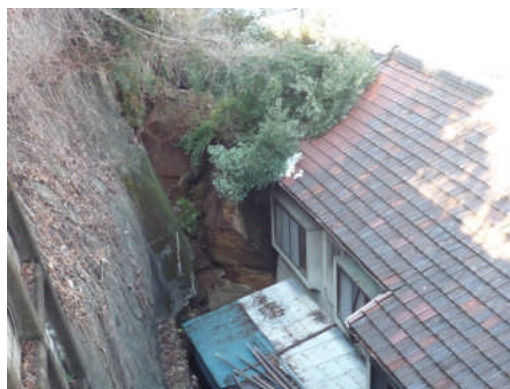
写真 5.2.5-13 崩壊した旅館の裏山
