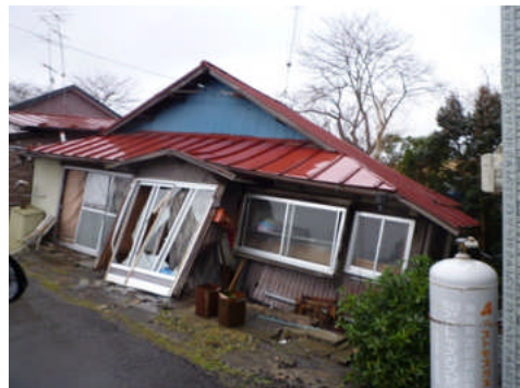
写真 5.2.1-4 地盤変状によると見られる被害
