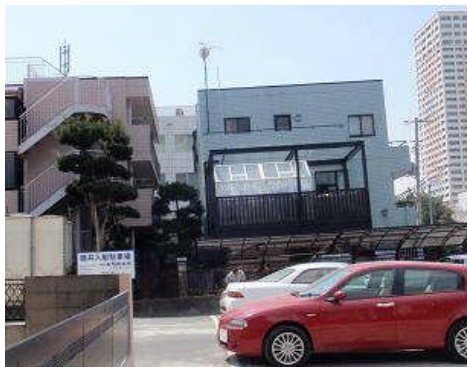
写真 5.5.2.2-15 沈下・傾斜した建物
