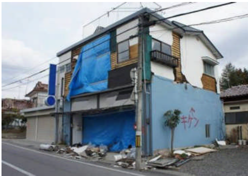
写真 5.2.6-3 店舗併用住宅の被害
