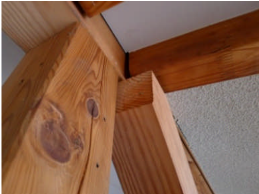
写真5.2.10-11 写真5.2.10-10の筋かいのはずれ
