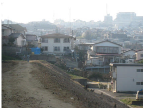
写真 5.5.2.3-9 宅地盛土の滑動・地盤変状により被災した住宅群（青山2丁目付近）
