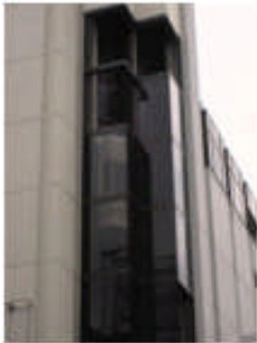
写真 5.4-9 エレベータ回りのガラスの落下
