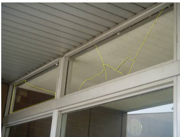
写真 5.6-22 建物入口のガラスの被害
