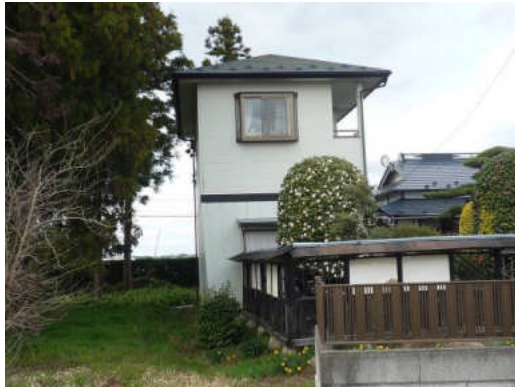
写真 5.2.3-5 2階増築と思われる建物の 残留変形
