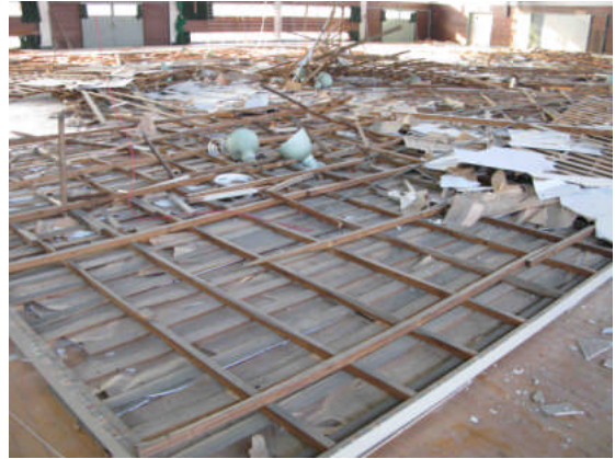
写真 5.3-41 落下した天井と照明 (HTC-4)
