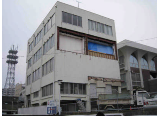
写真 5.3-12 事務所の外装材の脱落（水戸市）
