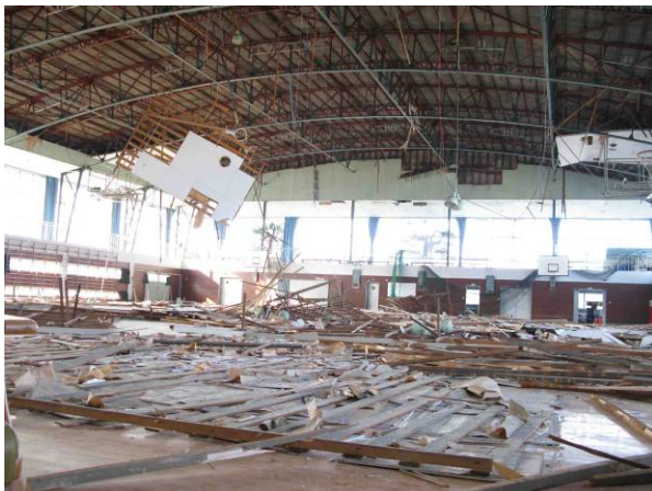
写真 5.6-38 木下地による天井の脱落被害
