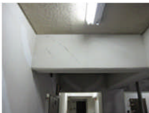
写真 5.4-20 短スパン梁に生じたせん断ひび割れ
