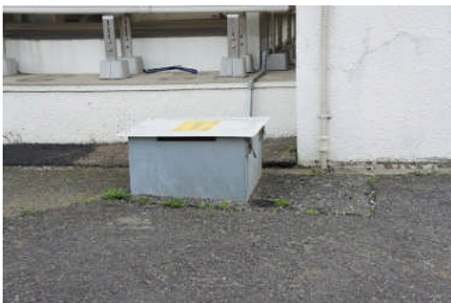
写真 5.2.13-1 龍ヶ崎市震度計設置状況
