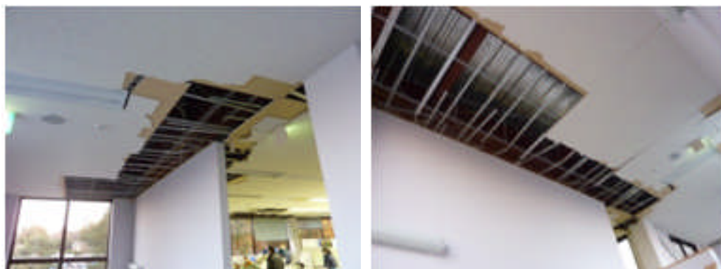
写真 5.4-192 付近の建築物の天井被害1 写真 5.4-193 付近の建築物の天井被害2
