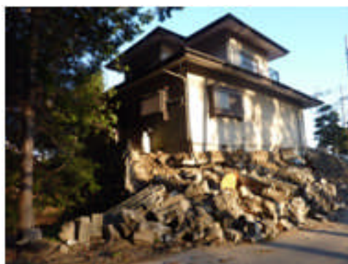
写真 5.4-195 地盤変状の被害
