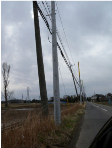
写真 5.5.2.1-1 電柱の傾斜（復旧中）
