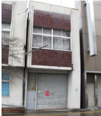
写真 5.3-4 1階の残留変形（仙台市若林区）
