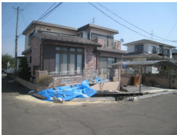
写真 5.5.2.3-33 丘陵地の頂部付近③で宅地盛土の変状により被災した住宅
