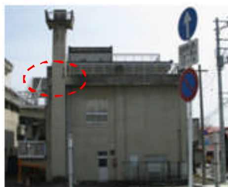
写真 5.4-156 煙突の曲げひび割れ
