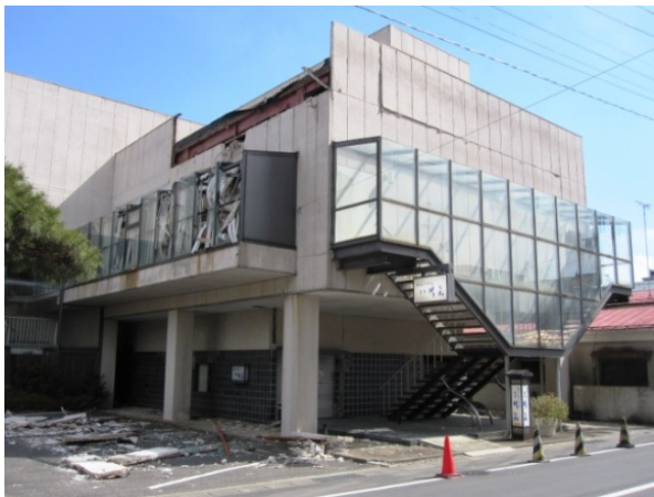
写真 5.6-20 ALC パネル外壁の脱落被害
