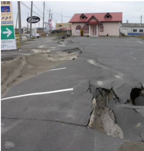
写真 5.5.2.1-13 駐車場路面の変状 (左側が県道 11 号)
