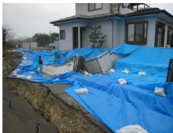
写真 5.5.2.3-38 写真 5.5.2.3-37 の地すべりに伴う地盤変状により被災した住宅
