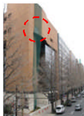
写真 5.4-8 外壁タイルの剥落
