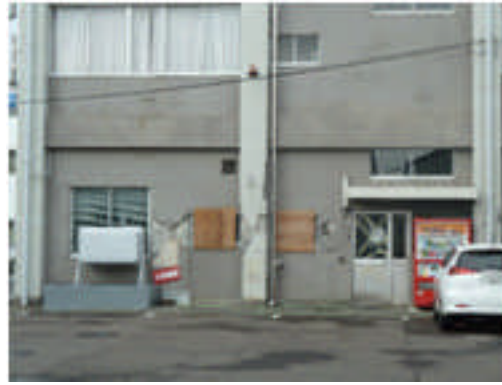
写真 5.4-38 腰壁付き短柱のせん断破壊
