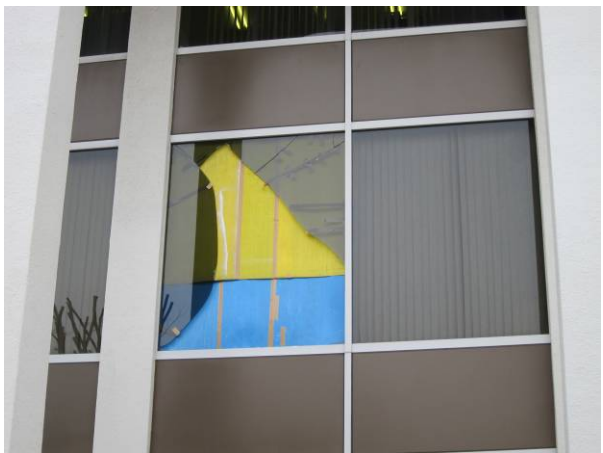
写真 5. 6-34 窓ガラスの被害
