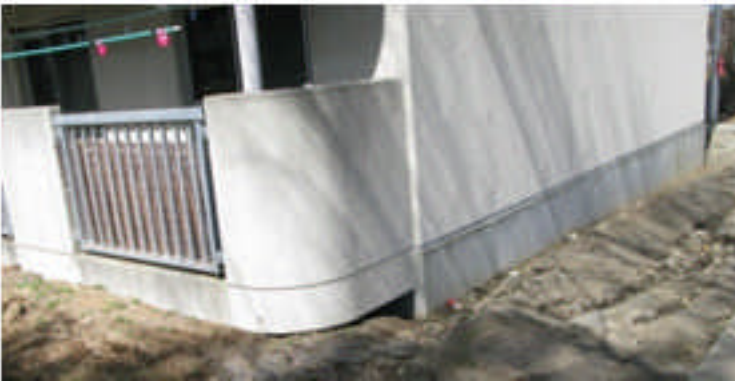
写真 5.4-165 a 棟 (沈み込みの大きい妻面)
