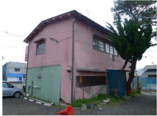
写真 5.2.2-28 傾斜した木造住宅
