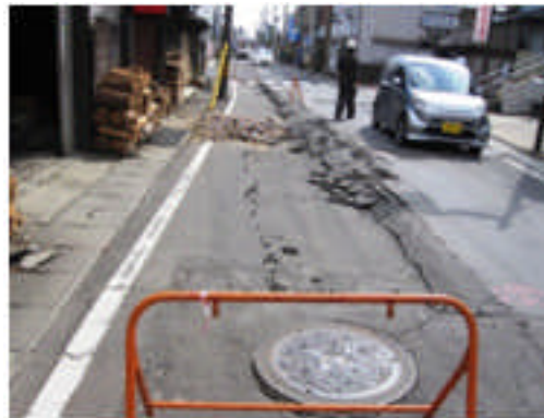
写真 5.4-154 道路の地盤変状
