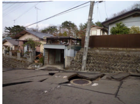
写真 5.2.5-4 道路の路面破壊 (青葉区折立 5 丁目)
