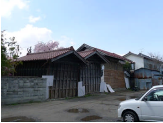
写真 5.2.2-25 傾斜した土蔵、倉庫
