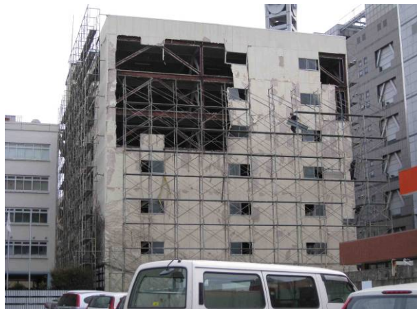
写真 5.6-31 ALC パネル外壁の被害
