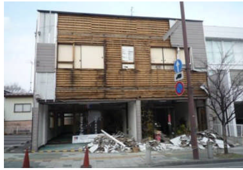
写真 5.2.6-2 ほぼ全面に渡り外壁モルタルが剥落した店舗併用住宅
