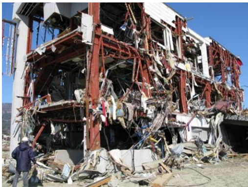
写真 6. 4. 2-15 残存する 3 階建て S 造 (陸前高田市)
