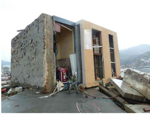
写真 6.4.1-3 3階建て建築物の転倒
