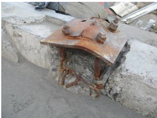
写真 6.4.2-1 柱脚部の破断 (陸前高田市)
