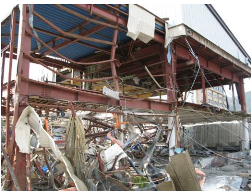
写真 6. 4. 2-27 間柱等の非構造部材の変形（釜石市）
