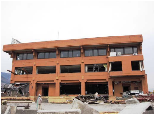
写真 6. 4. 1-13 衝突による非構造部材の損傷
