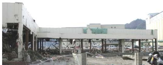
写真 6.5.2-1 残存 S 造骨組み
