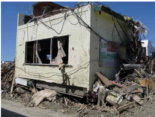
写真 6.4.1-1 2階建て建築物の層崩壊
