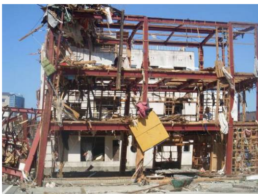
写真 6. 4. 2-12 傾斜した重層建築物（女川町）
