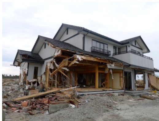
写真 6. 4. 3-6 建築物隅部を流失しつつも残存した事例(1)
