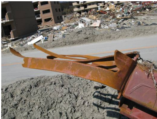
写真 6. 4. 2-5 引き裂かれた梁フランジ（陸前高田市）
