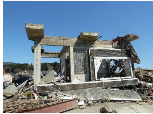
写真 6.4.1-4 上下逆さまになった2階建て建築物
