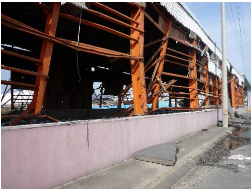
写真 6. 4. 2-25 柱の変形（石巻市） （コンクリート塊や道路の舗装アスファルト等の漂流物によると考えられる）
