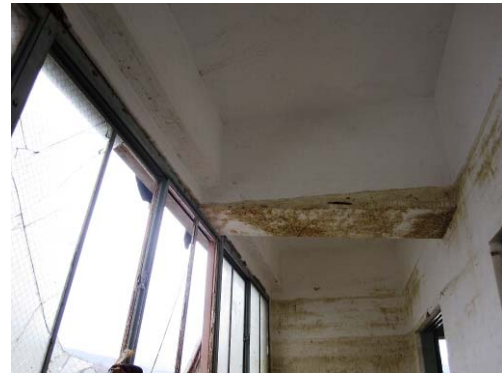
写真 6.4.1-6 建物内部の水の汚れの痕跡
