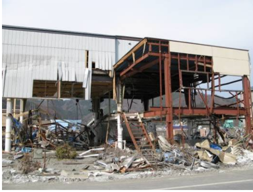
写真 6. 4. 2-18 残存する S 造（釜石市）
