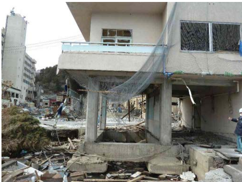
写真 6.4.1-9 洗掘による基礎露出
