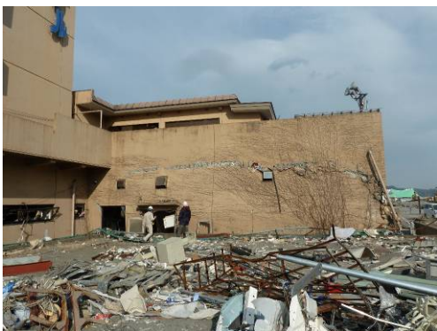
写真 6.4.1-11 非構造壁の面外破壊
