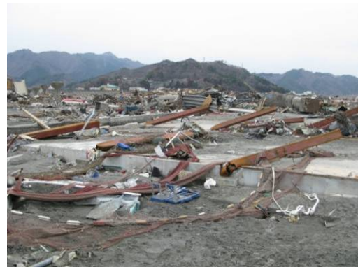
写真 6. 4. 2-6 1階柱の残存（大槌町）
