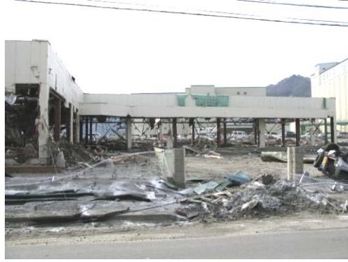
写真 6. 4. 2-19 残存する S 造（釜石市） （ブレース破断）
