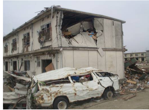
写真 6. 4. 1-14 漂流物の衝突による壁脱落
