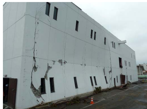
写真 6.4.1-12 床を持たない連層壁の面外破壊
