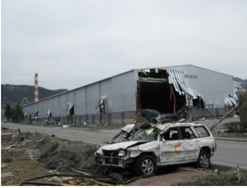
写真 6. 4. 2-24 倉庫（大船渡市） （津波の流出口として妻壁及び開口部が外側に変形）
