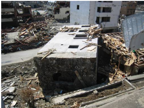
写真 6.4.1-5 4階建て杭基礎建築物の転倒
