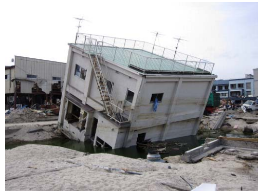
写真 6.4.1-10 洗掘による2階建て建築物の傾斜
