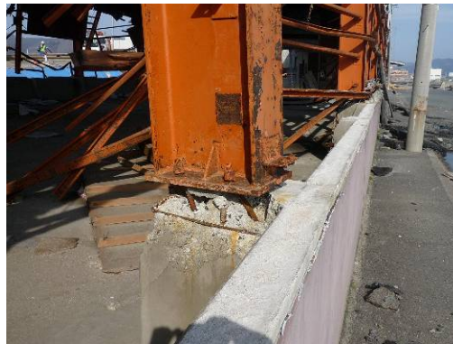
写真 6. 4. 2-26 柱脚部の移動（石巻市）
