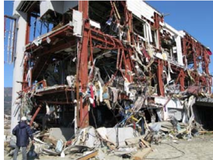
写真 6.5.2-3 残存 S 造骨組み
