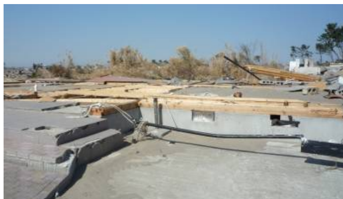
写真 6.4.3-1 上部構造が流失し土台が残った例
