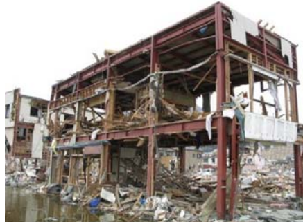
写真 6.5.2-2 残存S造骨組み
