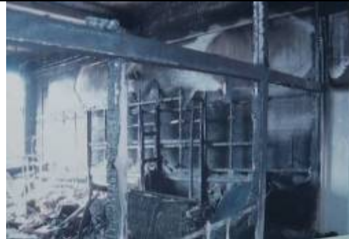
写真 7.3.16-2 火災室（備品庫）
