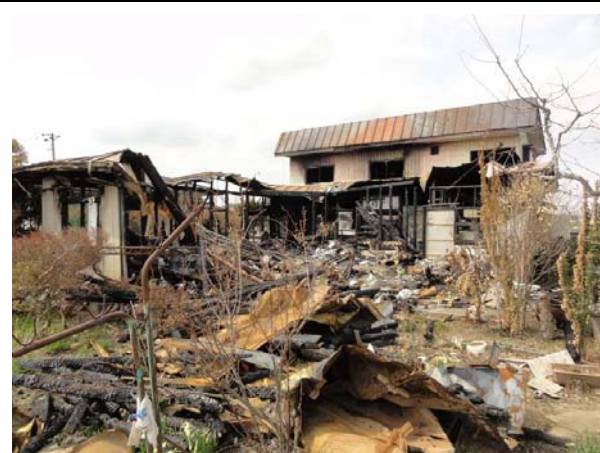
写真 7.3.22 奥州市水沢区小石田の火災
