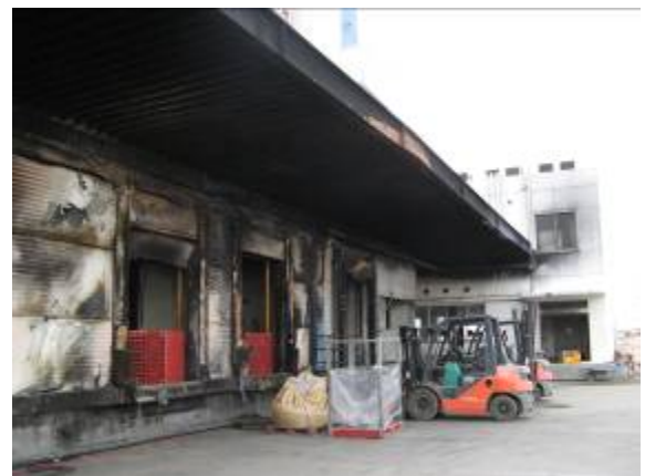
写真 7.3.1-2 仙台塩釜港北側の倉庫1の火災
