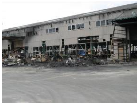
写真 7.3.1-4 仙台塩釜港北側の駐車場2の火災
