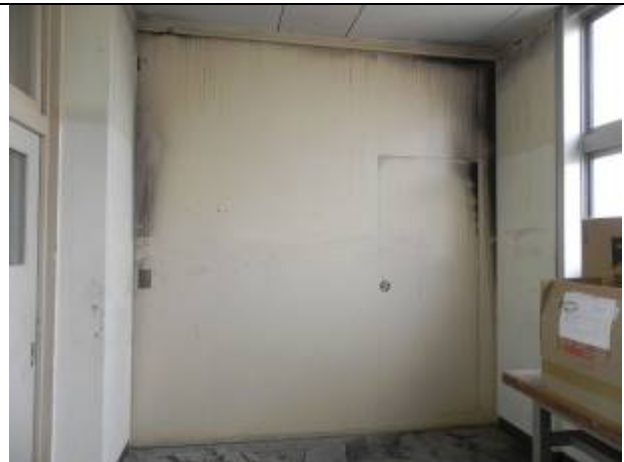
写真 7.3.16-6 防火戸（非火災側）
