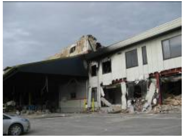
写真 7.3.1-3 仙台塩釜港北側の倉庫2の火災
