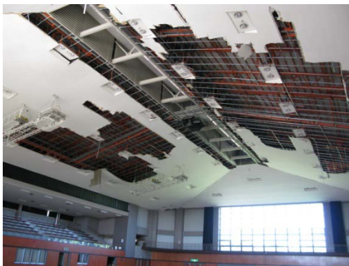
写真 4.3-1 体育館の天井脱落被害
