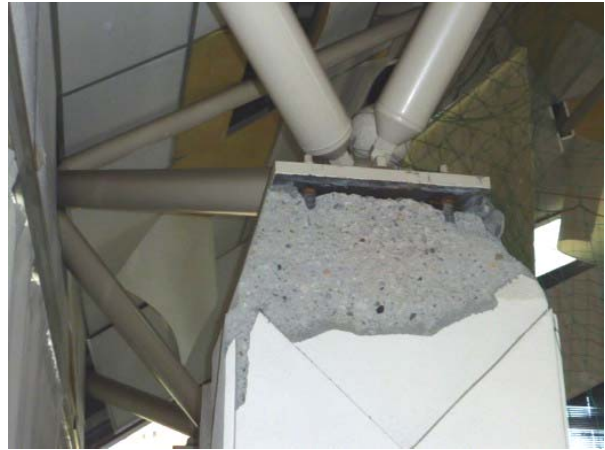
写真 5.3-11 RC 柱と S 造屋根接続部（支承部）のコンクリート剥落
