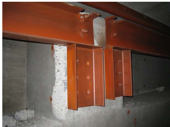
写真 5.3-9 妻壁と S 造屋根接続部ホールインアンカー抜け出し
