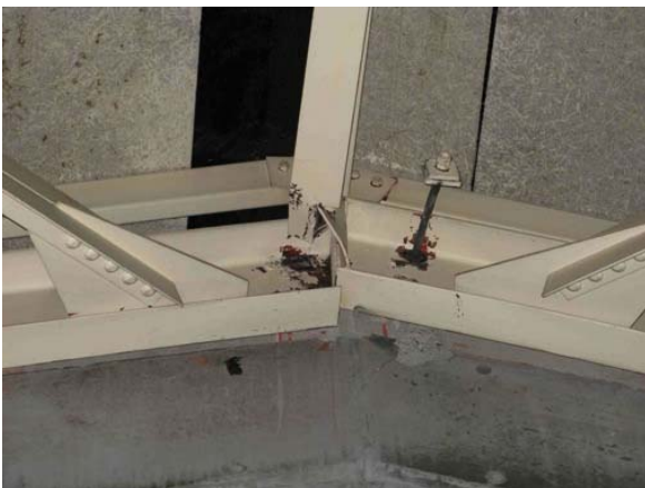
写真 5.3-8 妻壁と S 造屋根接続部ボルト抜け出し
