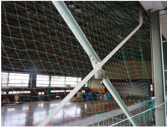
写真 5.3-1 ブレース材の座屈と接合部破断
