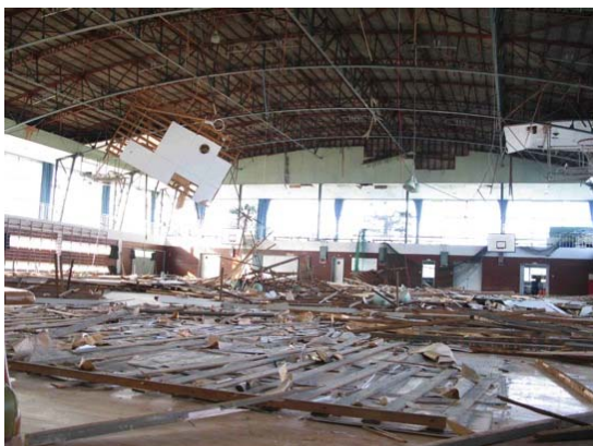
写真 5.3-5 天井、照明の落下
