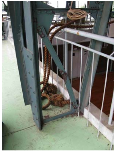
写真 5.3-2 ラチス柱斜材の座屈
