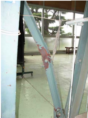
写真 5.3-3 ラチス柱斜材の座屈
