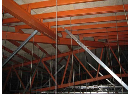
写真 5.3-17 斜め補剛材のはずれ
