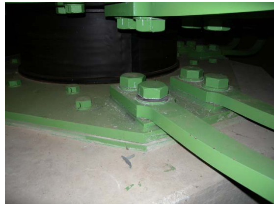
写真 5. 5. 1-32 鋼材ダンパー基部のボルトの緩み
