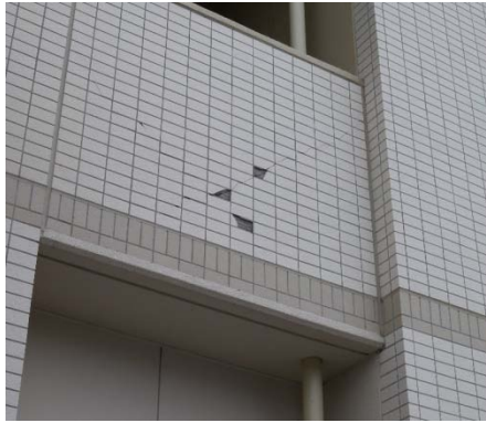
写真 5.5.1-13 外装タイルの落下
