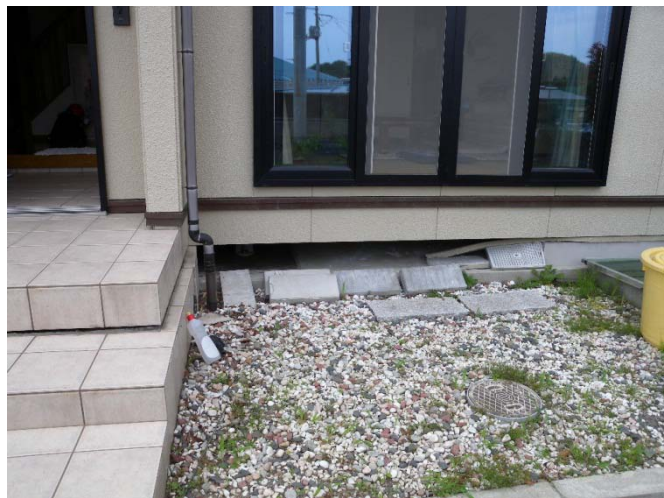
写真 5.5.1-37 基礎立上り部破損状況
