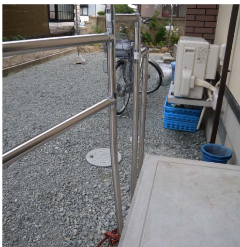
写真 5. 5. 1-45 勝手口の手すりの損傷
