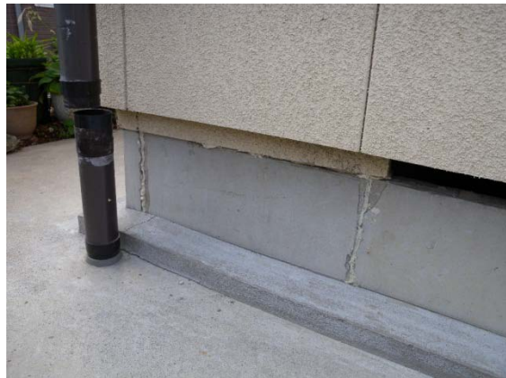
写真 5.5.1-42 基礎立上り部の補修跡
