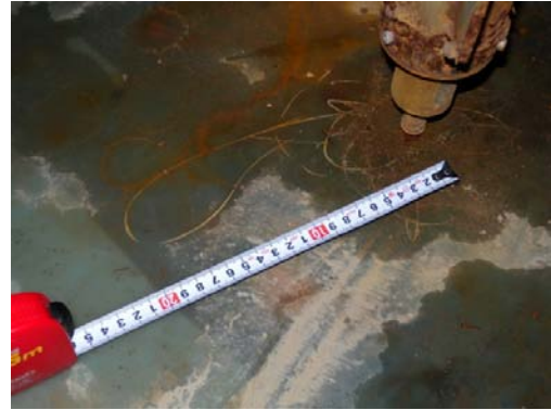
写真 5.5.1-11 罫書き式変位計による記録
