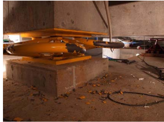
写真 5. 5. 1-19 鋼棒ダンパーの塗装剥がれ
