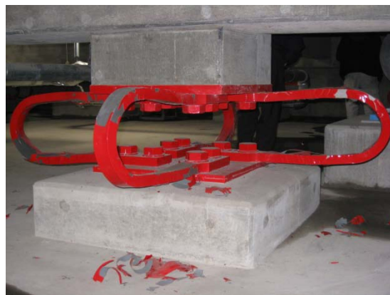
写真 5.5.1-16 U型鋼材ダンパーの塗料はがれ
