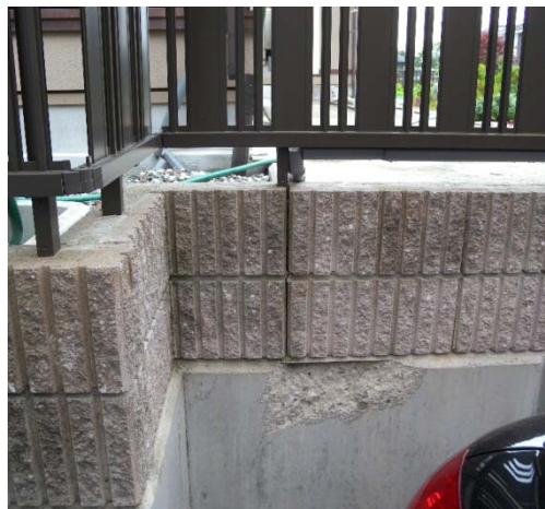
写真 5.5.1-33 ブロック塀脚部の被害
