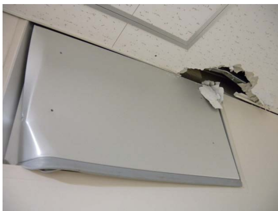
写真 5.5.1-2 衝突等によるカバーの破損
