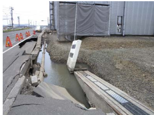
写真5.5.1-9 建築物周囲の地盤変状
