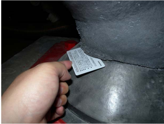
写真 5. 5. 1-18 鉛ダンパーのひび割れ状況
