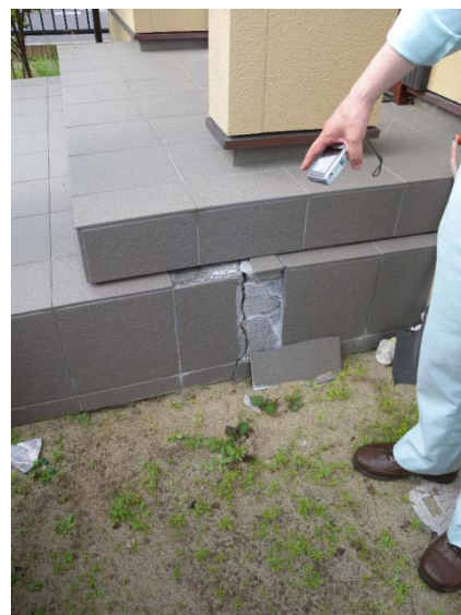
写真 5.5.1-44 玄関階段部分の損傷
