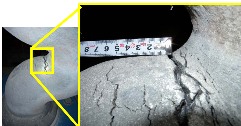
(b) 屈曲部のひび割れの状況
