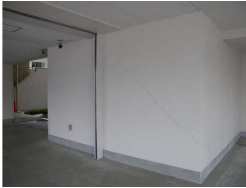
写真 5.5.1-14 駐車場壁のひび割れ
