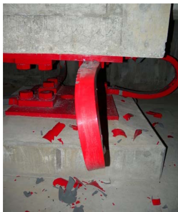
写真 5. 5. 1-22 U型鋼材ダンパーの変状
