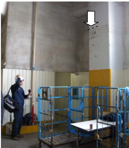
写真5.5.1-8 隣棟内部（1F）の浸水跡
