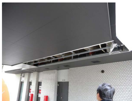
写真 5.5.1-3 天井カバーの脱落
