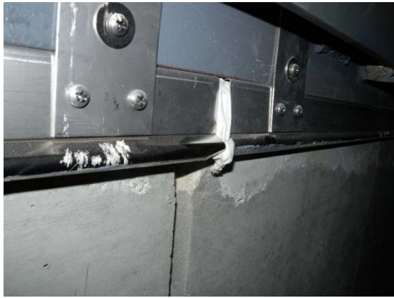
写真 5. 5. 1-47 シール材のはみ出し
