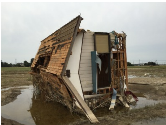
写真6 転倒した住宅Cの2階部分
