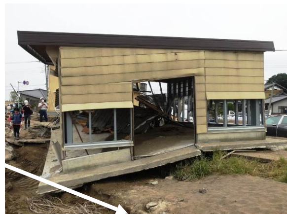
写真33 流出車庫の基礎の破損 (矢印は水流の方向)
