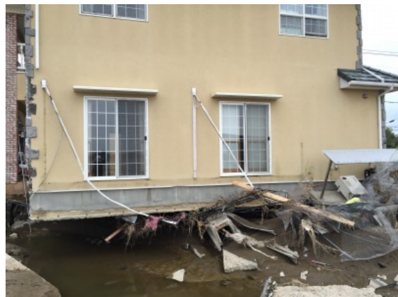
写真13 住宅Fでの地盤の洗掘
