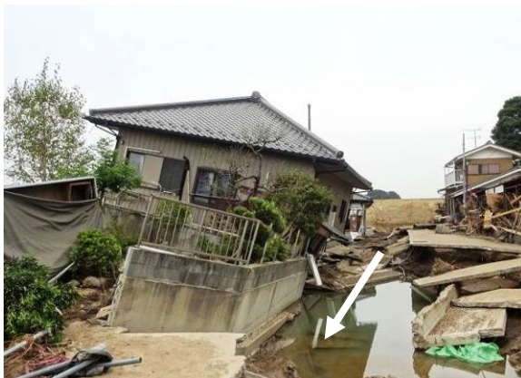
写真38 大きく傾いた土留め (矢印は水流の方向)
