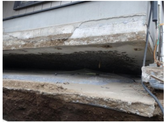
写真19 基礎底盤の浮上がりと 緊結ボルトの破断 (住宅I)
