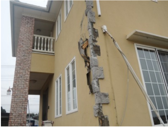
写真14 外壁の損傷（住宅F）
