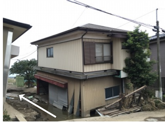
写真15 傾斜した倉庫兼住宅G (矢印は水流の方向)
