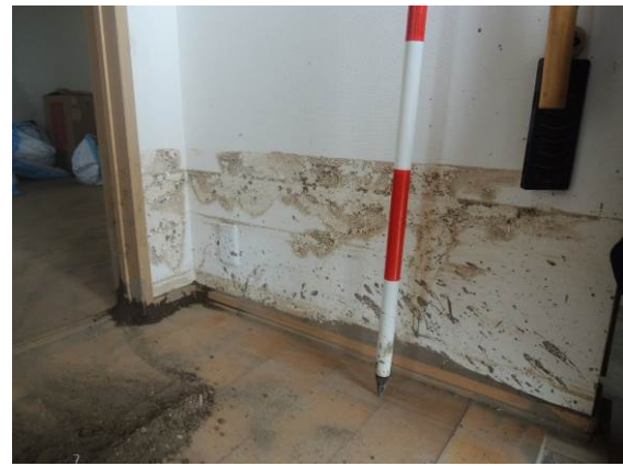
写真31 浸水の痕跡（室内）
