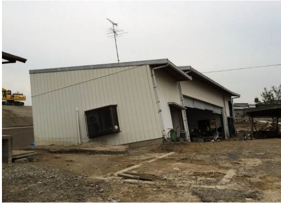
写真34 ガソリンスタンド奥の傾斜した建屋
