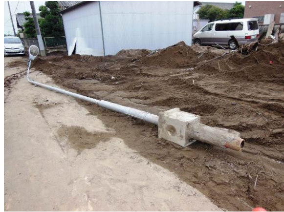
写真 4 0 基礎ごと地盤から引抜けた街灯
