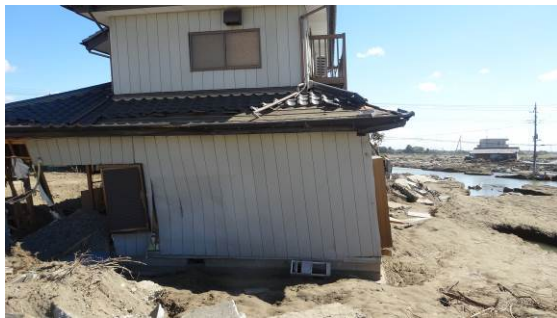
写真22 外壁や開口部の脱落と地盤洗掘 による住家の傾斜 (住宅J)
