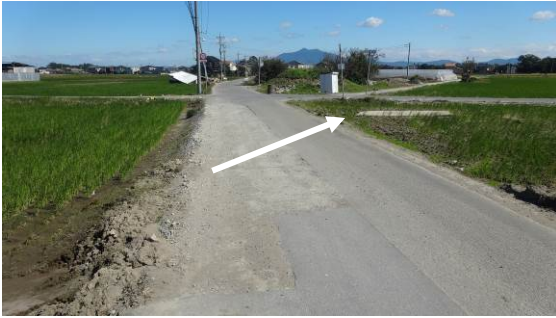
写真5 2 アスファルト路盤の流出（矢印は流出方向）
