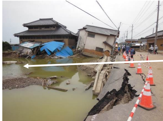
写真 4 2 アスファルト路盤の被害 (矢印は水流方向)
