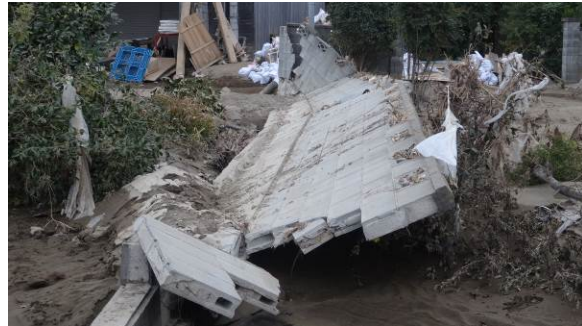
写真37 傾斜したコンクリートブロック塀
