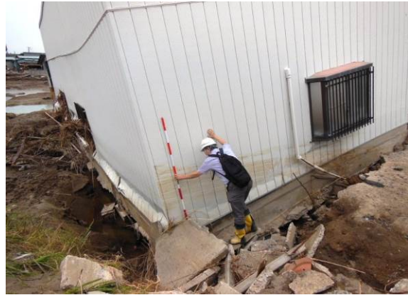
写真35 建屋まわりの洗掘
