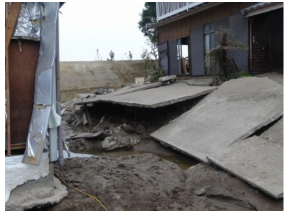
写真23 敷地の地盤の洗掘 (住宅J)
