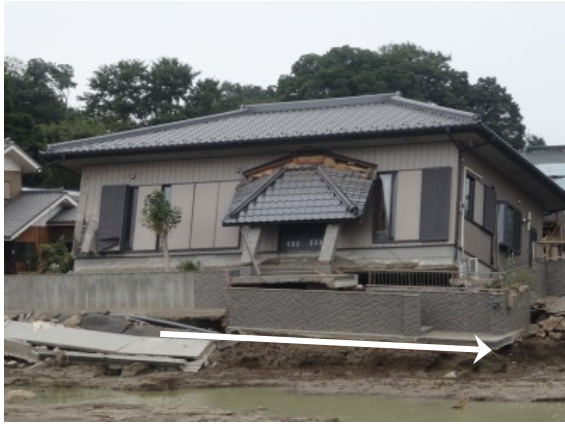
写真18 住宅Iの外観 (矢印は水流の方向)
