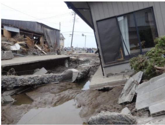
写真20 敷地の地盤の洗掘 (住宅I)
