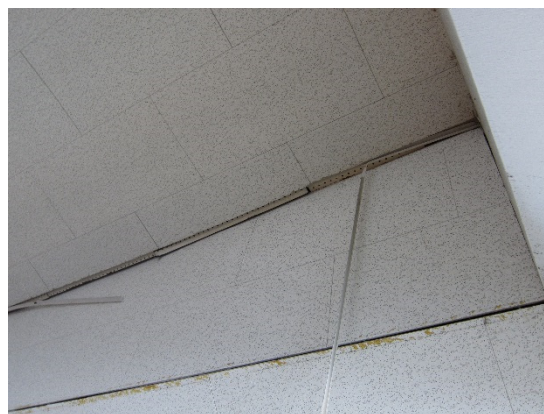
写真4-23 天井面端部の損傷
