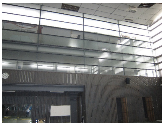
写真 4-61 3階での教室と廊下の間仕切り壁の転倒及びガラスの損傷 (アリーナ)
