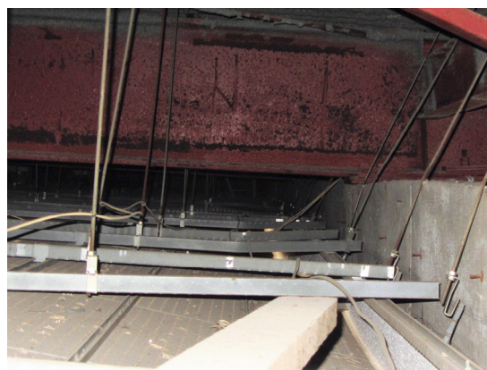
写真4-25 天井裏の状況 (ハンガー及びクリップのずれ・外れ、野縁受けの曲がり、天井面のたわみ)
