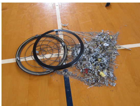
写真4-3 床に落下した部材（メインアリーナ）
