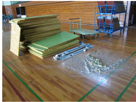
写真4-100 脱落した部材 (大体育室)
