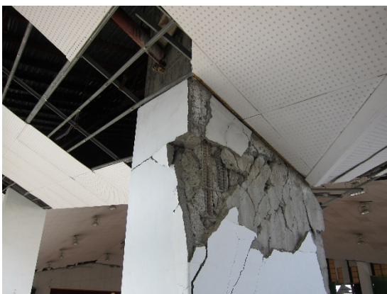
写真 4-88 屋根支承部 RC 造柱の損傷 (3 階観覧席)
