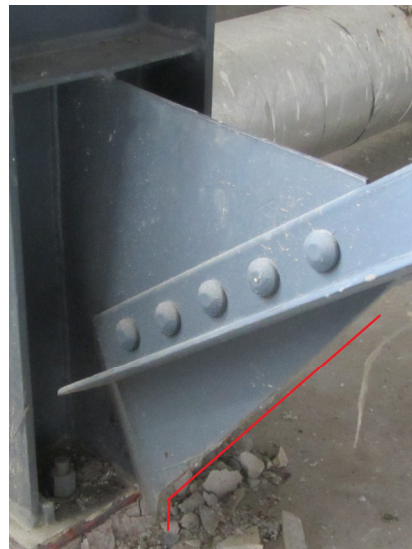
写真 4-12 屋根支承部鉛直ブレース下端のガセットプレートの変形（赤線箇所。メインアリーナ。）
