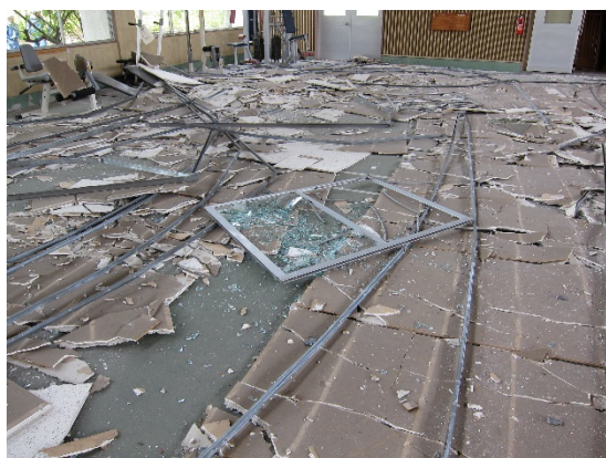
写真 4-52 脱落した天井材及び窓障子
