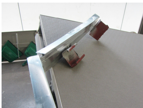
写真 4-67 転倒した間仕切り壁、上部ランナー、C形鋼ピース (2階)
