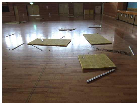
写真4-106 脱落した部材（メインアリーナ）
