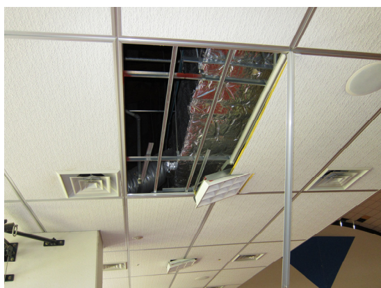
写真4-107 観客席上部の天井の損傷（メインアリーナ）
