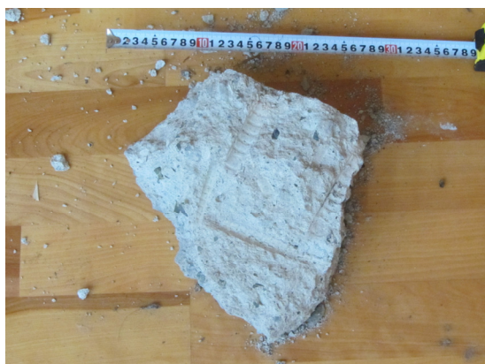
写真4-111 支承部から落下したコンクリート片 (サブアリーナ)
