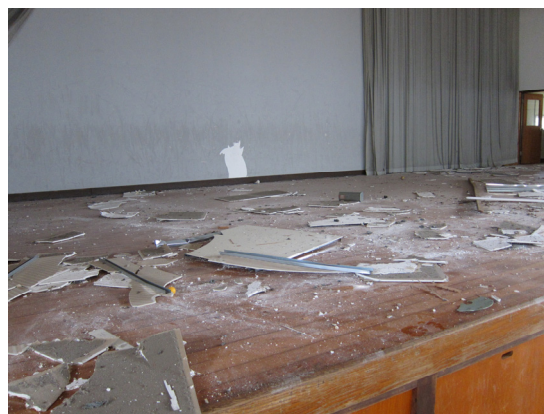
写真 4-29 被害に伴う落下物
