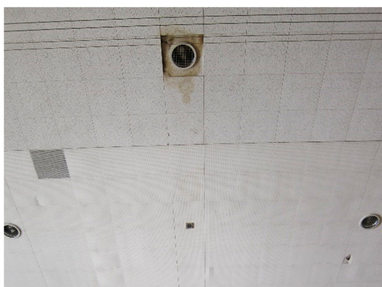
写真 4-35 漏水跡の見られる天井面
