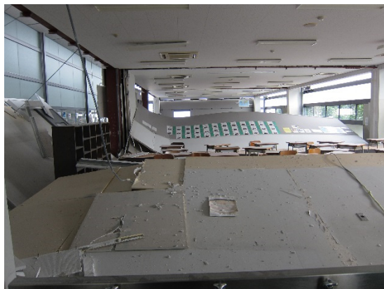
写真 4-63 教室間の間仕切り壁の転倒 (3階)
