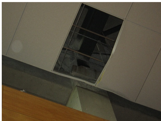
写真4-17 天井面端部の損傷（サブアリーナ）
