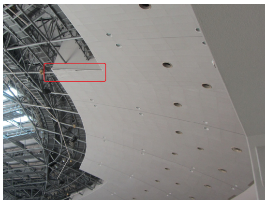
写真4-39 天井面のゆがみ（赤枠内。メインプール。）
