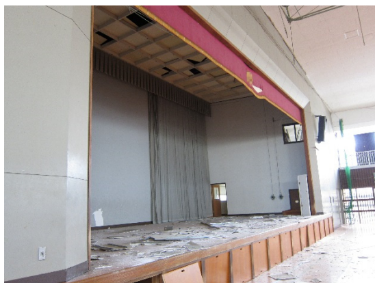
写真 4-28 舞台上部の天井の損傷
