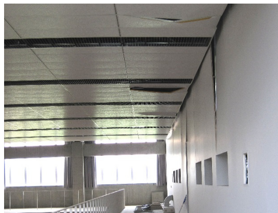
写真 4-10 天井面端部と壁の衝突による損傷（メインアリーナ）
