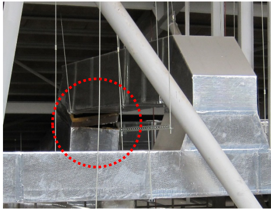
写真4-99 天井裏ダクトの外れ (大体育室)
