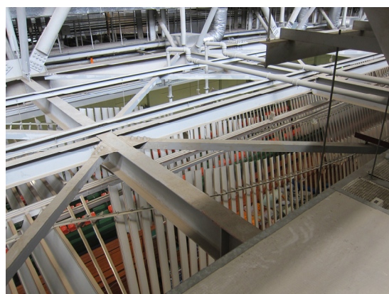
写真 4-98 損傷部を天井裏から見る（大体育室）
