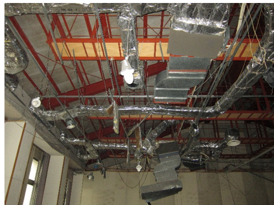
写真4-71 天井裏の損傷状況
