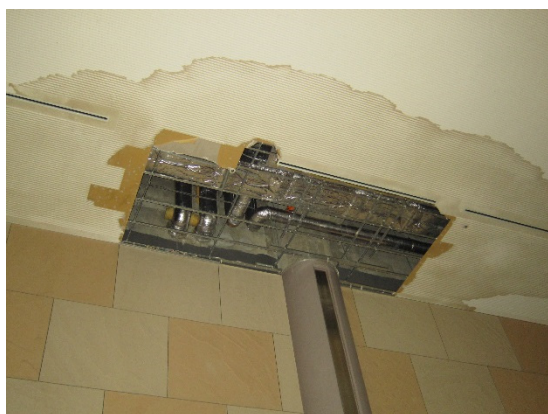
写真 4-117 天井板が脱落した箇所（展示ギャラリー）
