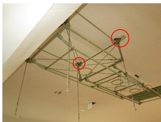
写真4-27 バスケットゴール近傍の損傷 (赤円内)
