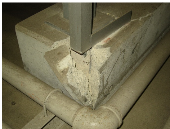
写真 4-115 前写真の損傷箇所の近景
