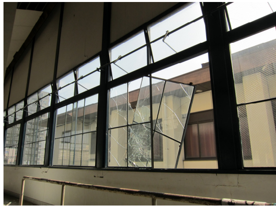
写真 4-85 ガラスの損傷及び窓障子の外れ (3 階観覧席)
