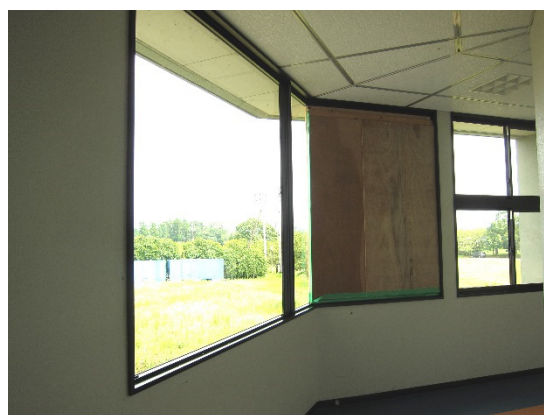
写真4-108 メインアリーナ周囲の通路での窓ガラスの損傷
