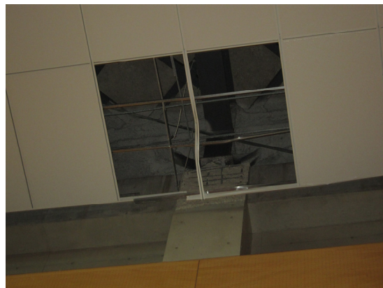
写真4-16 天井面端部の損傷（サブアリーナ）
