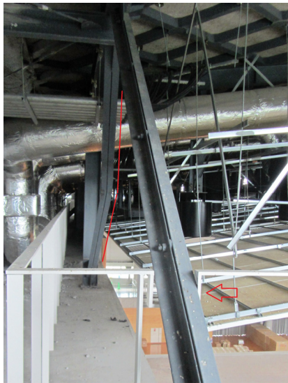
写真 4-11 屋根支承部鉛直ブレースの座屈（赤線箇所。手前のブレースは手摺に当たり（赤矢印）、ブレースは座屈せずに下端のガセットプレートが変形。メインアリーナ。）
