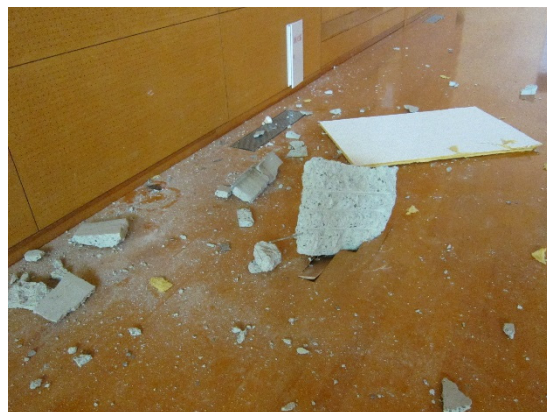
写真4-18 損傷に伴う落下物（サブアリーナ）
