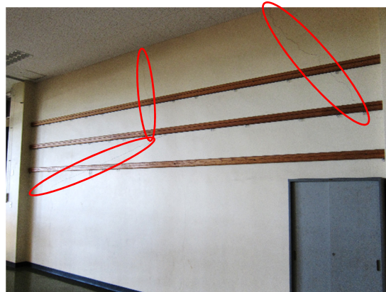
写真 4-36 RC 造躯体のひび割れ (赤円内)
