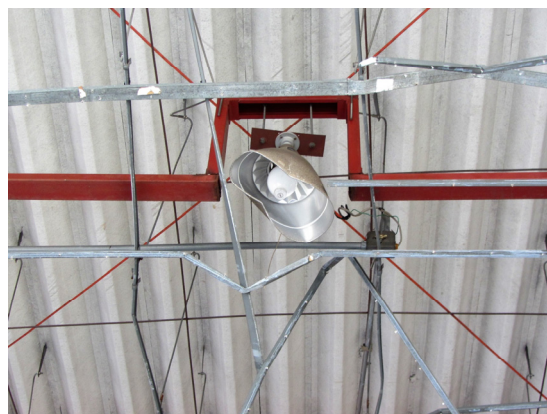
写真 4-51 天井下地及び照明の笠の変形
