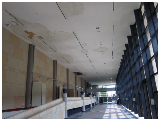
写真 4-116 天井への漏水（展示ギャラリー）
