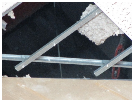
写真 4-34 天井板が外れた箇所の下地の状況
