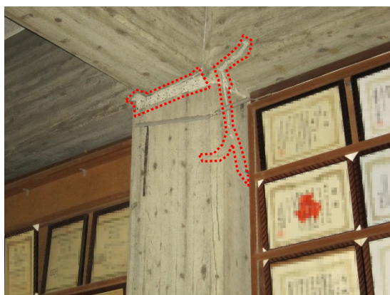
写真 4-92 RC造柱の損傷 (1階)
