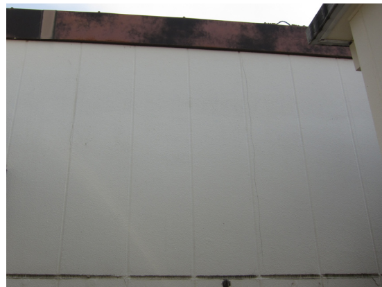
写真4-102 ALCパネルの損傷 (屋上)
