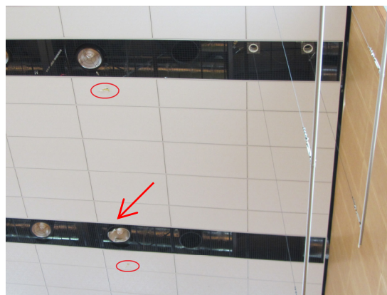
写真 4-6 天井面の孔（赤丸部分）と照明の笠の変形（矢印箇所）（メインアリーナ）
