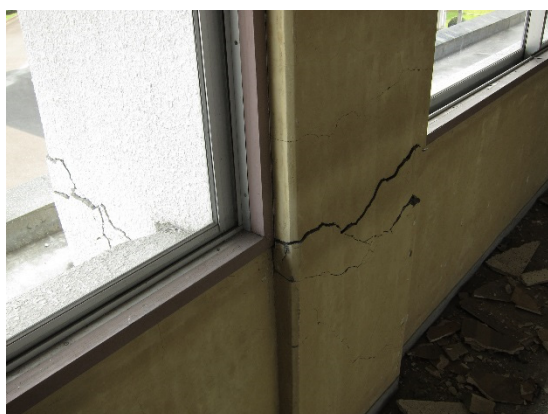
写真 4-54 ギャラリー一部での柱の曲げひび割れ
