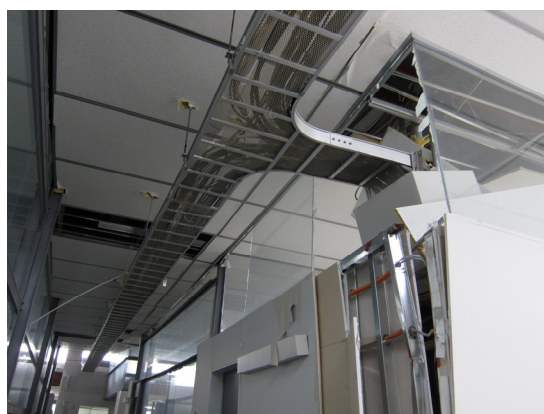
写真 4-68 間仕切り壁上部のガラス及び天井の損傷 (3階)
