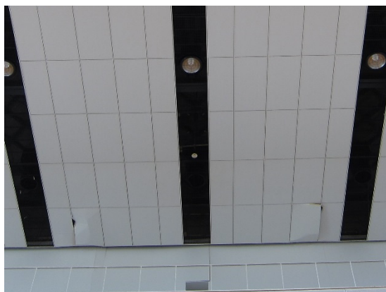
写真 4-5 天井面端部の損傷（メインアリーナ）
