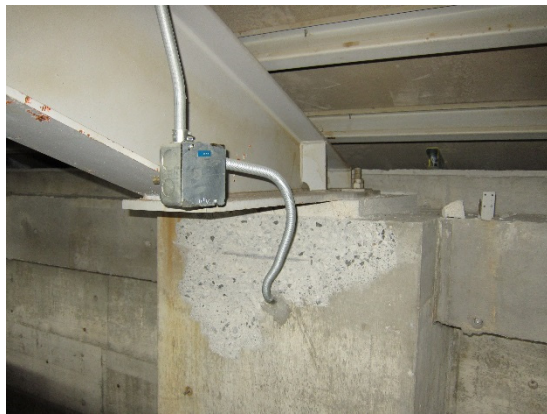
写真4-101 屋根支承部の被害 (大体育室)
