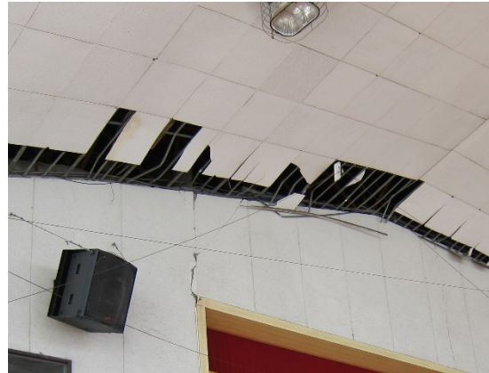
写真4-79 端部での損傷（アリーナ）
