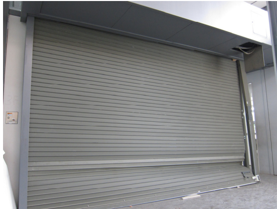
写真4-69 誤作動したシャッター（3階）
