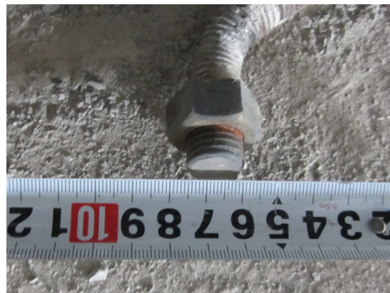
写真 4-14 前写真の円内の破断したアンカーボルト（メインアリーナ）
