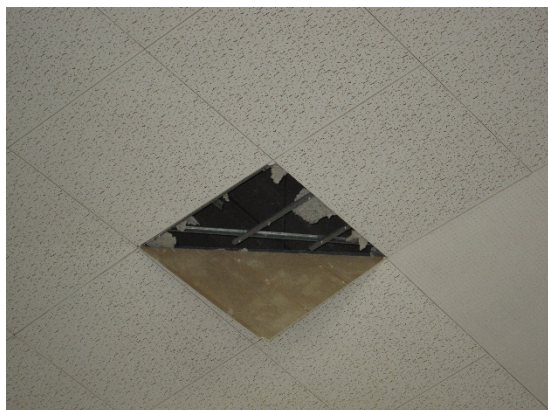
写真 4-33 天井板の外れ
