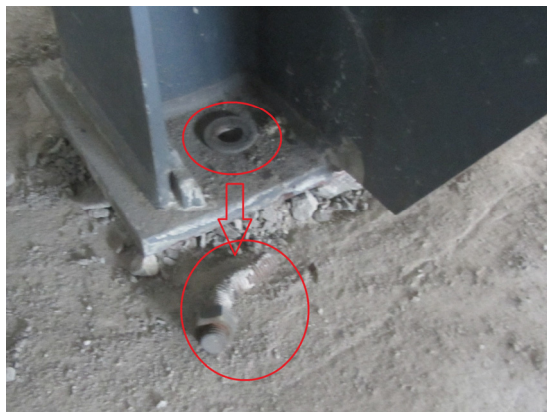
写真 4-13 屋根支承部鉛直ブレース下端のアンカーボルトの破断（メインアリーナ）
