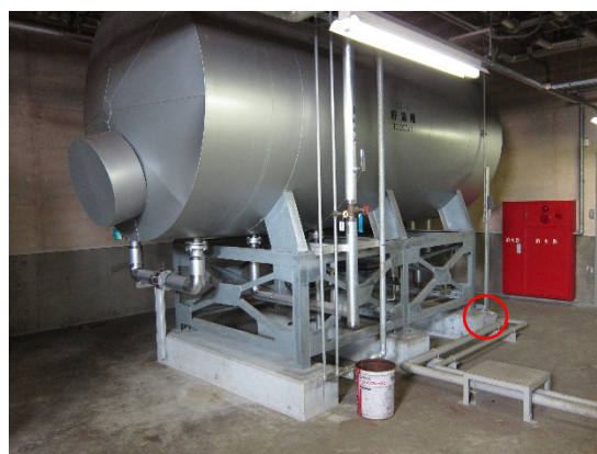
写真4-114 貯湯槽の支持部の損傷 (赤丸内が損傷箇所)
