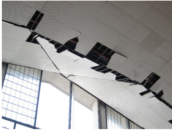
写真4-78 折れ曲がり部での損傷（アリーナ）
