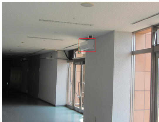
写真 4-42 通路に設置された仮設のエアコン（赤枠内）
