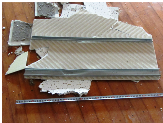
写真 4-30 野縁で補強した天井板などの落下物
