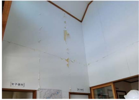
(b) 内部仕上材の損傷
