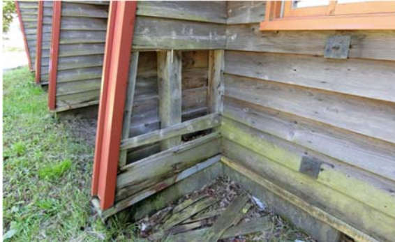
(c) 下見板の脱落 (今回の被害かどうかは不明)
