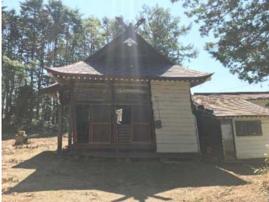
写真 5.2.11 寺社建築 C 北側の破壊状況
