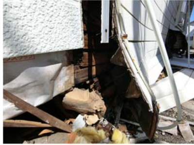
(d) 一部の構造躯体の腐朽
