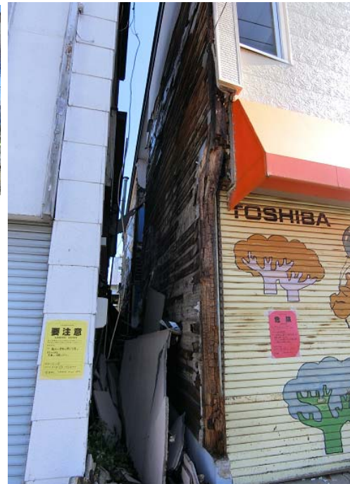
写真 5.3.27 写真 5.3.25 の外壁の激しい腐朽と残留変形
