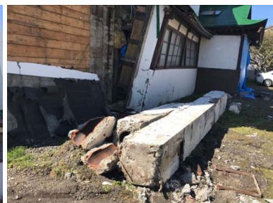
(c) 倒壊した煙突
