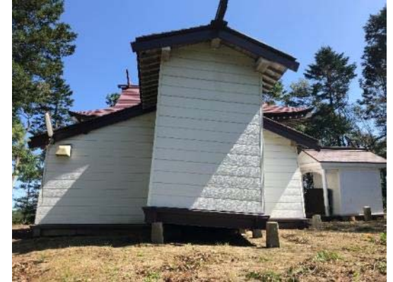
写真 5.2.12 寺社建築 C 西側の破壊状況
