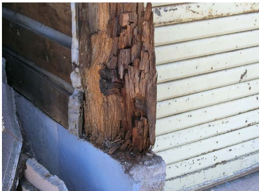
写真 5.3.26 写真 5.3.25 の柱脚の激しい腐朽
