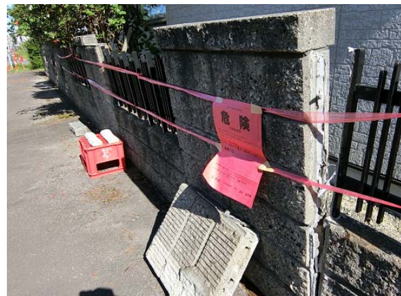
写真 5.3.29 写真 5.3.28 に附属し、傾斜したブロック塀
