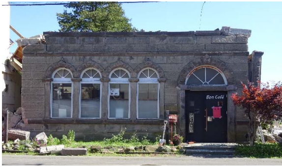
写真 5.3.15 比較的古い組積造の2層の崩壊
