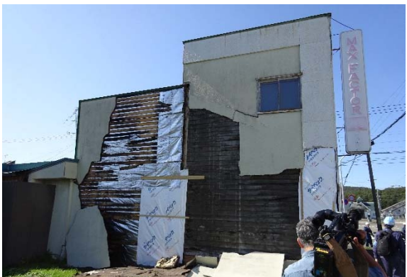
写真 5.3.21 外装材の脱落した建築物
