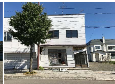
(c) 建築物 4 の傾斜の様子
