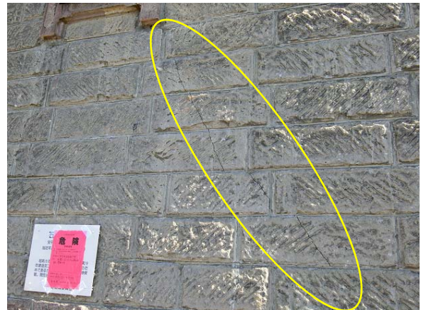
写真 5.3.20 写真 5.3.19 前面のせん断ひび割れ
