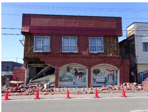
写真 5.3.11 外壁煉瓦の木造建築物の被害
