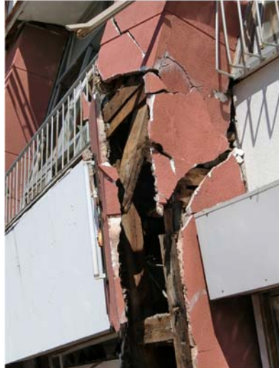
(e) 4 本柱の折損
