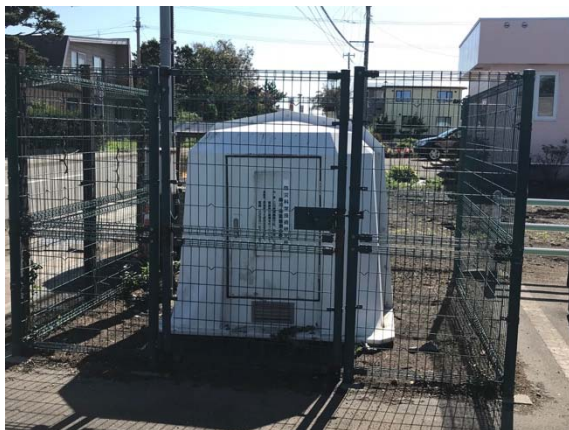
(a) 地震計の設置状況①
