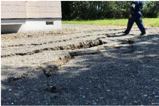
(a) 西側の地割れ
