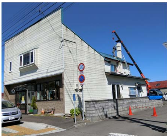
写真 5.1.18 煙突の崩壊の可能性により応急危険度判定の結果が“危険”の店舗併用住宅
