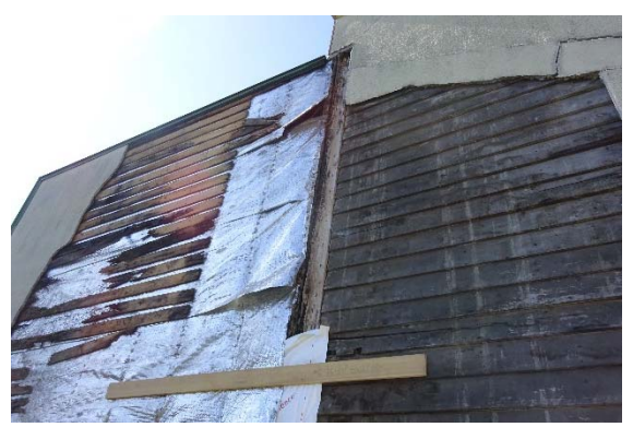
写真 5.3.22 写真 5.3.21 の壁面(柱・壁の腐朽)
