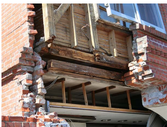
写真 5.3.13 写真 5.3.11 の露出した躯体の腐朽・蟻害
