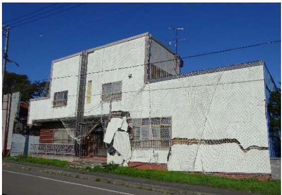
写真 5.3.41 外壁の剥落（今回の地震動による被害ではない可能性が高い）
