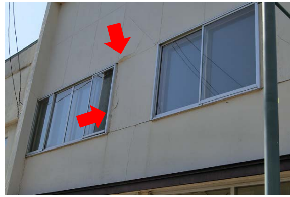
写真 5.3.24 写真 5.3.23 の壁面のひび割れ
