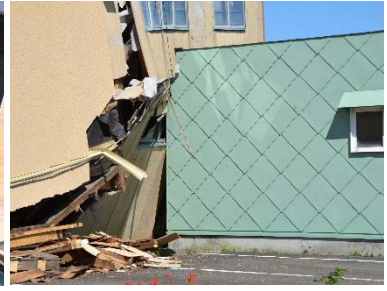
(f) 隣接建築物との衝突部分
