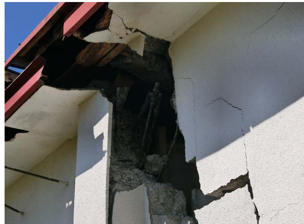
(d) 破壊部分の詳細 (頂部)
