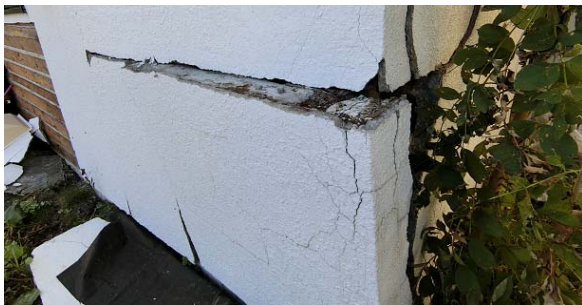
写真 5.3.31 写真 5.3.30 の浴室と思われる部分の立ち上がり基礎部分の脱落
