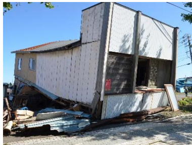
(b) 2階が東側へ倒れた正面部分
