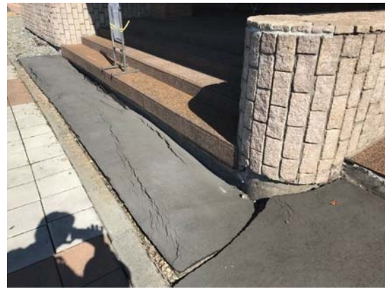
(d) 隣接する産業会館の入り口の被害状況②
