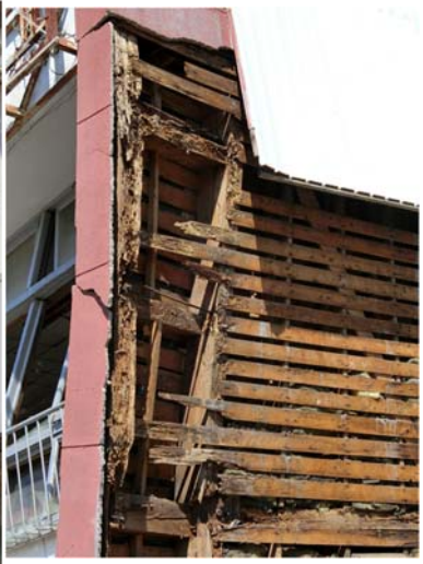
(f) 柱等の腐朽・蟻害
