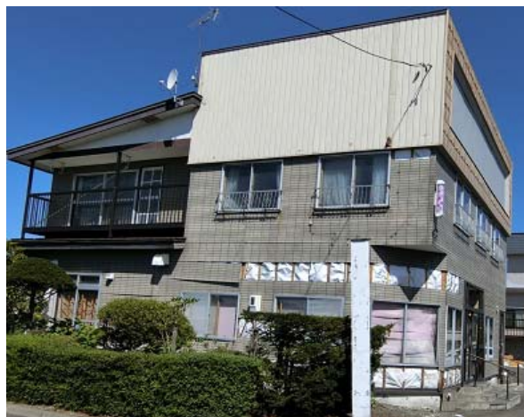
写真 5.1.19 旧国道である中央通り以外で一部損壊した店舗併用住宅
