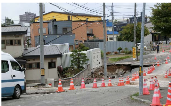
写真 5.1 道路舗装の損壊と著しい地盤変状
