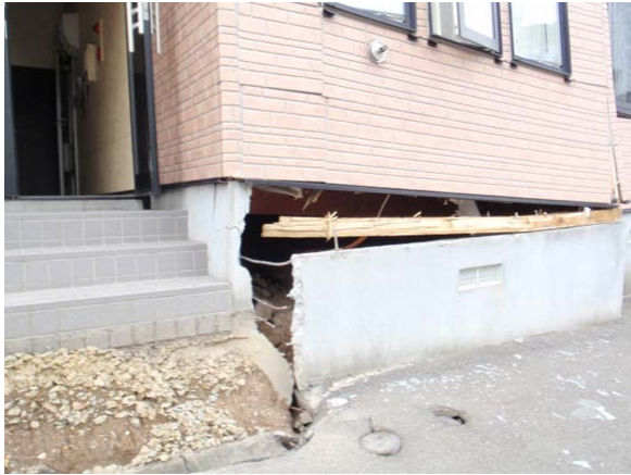
写真 5.13 地盤沈下による基礎の被害
