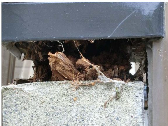
写真 5.22 写真 5.21 の住宅の土台の腐朽
