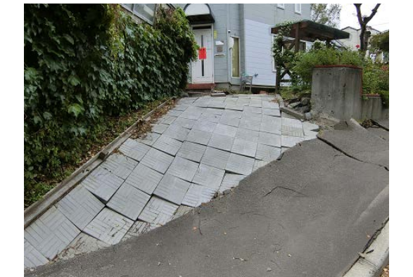
写真 5.12 敷地入口が約 1.5m 沈下した住宅
