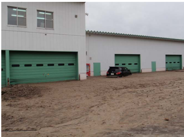
写真 5.32 流出土砂の堆積状況（約 50～70 cm 堆積）
