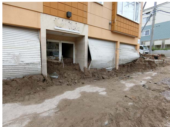
写真 5.29 シャッターを押し破って建築物内 部にも堆積した土砂
