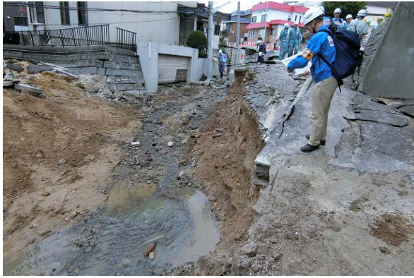
写真 5.5 道路にできた約 1.5 m の段差
