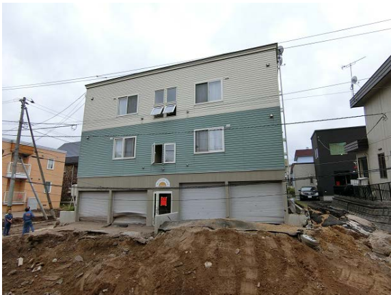
写真 5.7 流出土砂が数十 cm 堆積し、前面の路盤が沈下、又は削られた住宅
