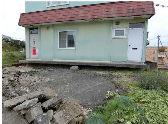
写真 5.8 地盤が沈下したとみられる住宅
