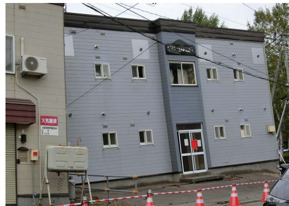
写真 5.4 大きく傾いたものの上部構造に目立った被害が認められない住宅
