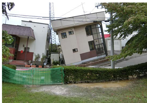
写真 5.3 最大傾斜(建築物全体)を有すると見られる住宅
