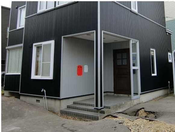
写真 5.17 地盤が隆起・沈降しているにもかかわらず、ほぼ無被害に見える基礎
