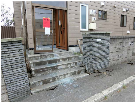
写真 5.21 著しい地盤変状により基礎の沈下、 建具の破損等の被害を受けた住宅
