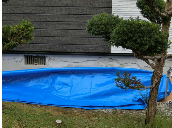
写真 5.14 ひび割れの入った基礎
