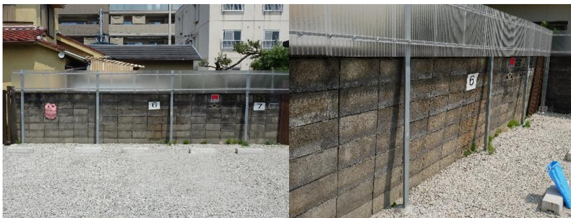
(a) 全景（被災後）
