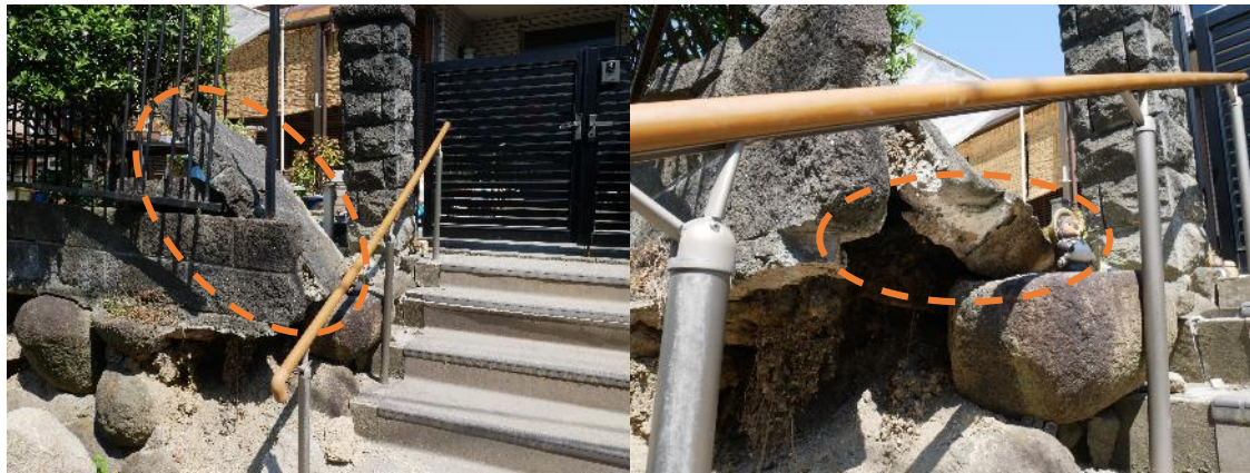
(a) 転倒した南北方向の補強ブロック塀
