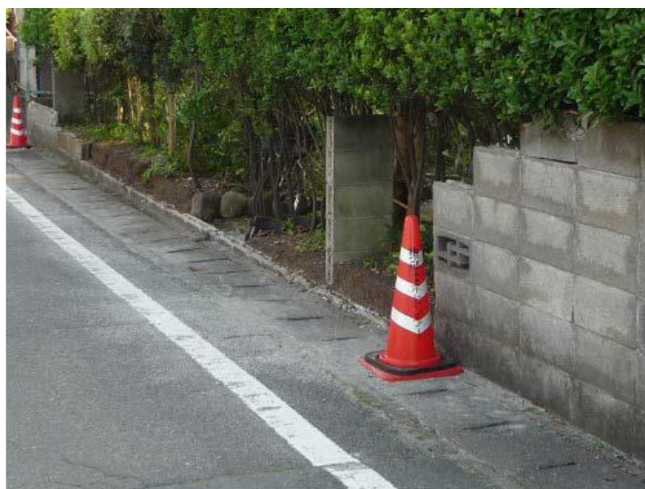
図 7.26 控え壁付き補強ブロック塀の転倒例 9)
