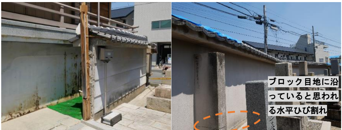
(a) 南北方向の補強ブロック塀（敷地側から） (b) 東西方向の補強ブロック塀（敷地側から）
