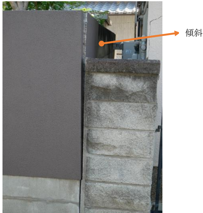
図 7.16 高槻市 1 の補強ブロック塀の被害状況
