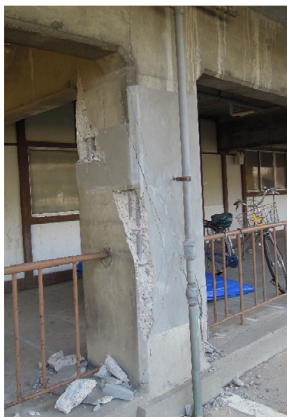
(a) ピロティ柱のせん断破壊
