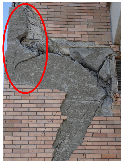
(b) 壁の損傷
