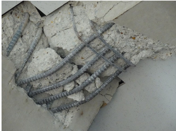
(b) 3 階梁端部の損傷
