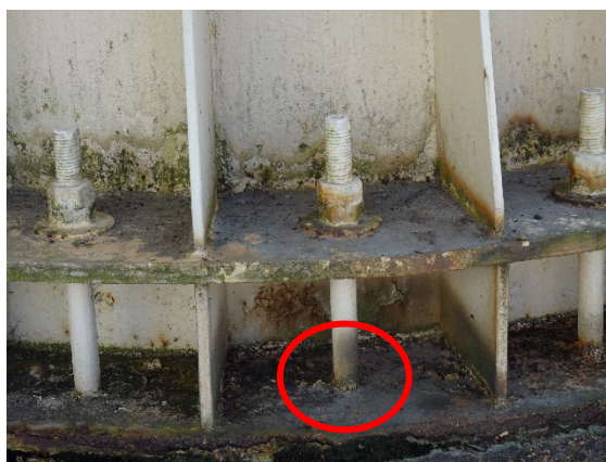
(d) 鋼製煙突の下部の拡大
