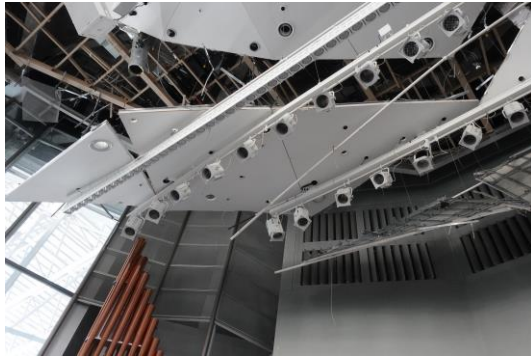
写真5-11 ステージ上部の天井の損傷状況
