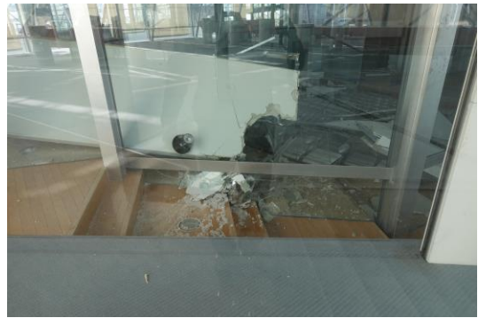
写真5-14 脱落した天井が衝突し損傷したとみられるガラス壁
