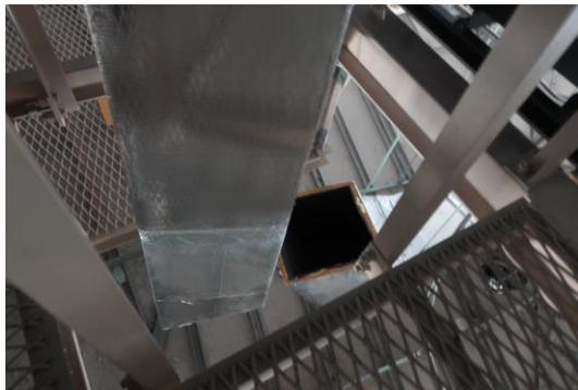
写真5-15 ダクトの外れ
