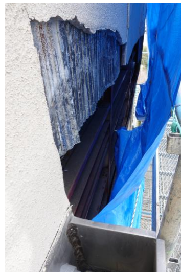
写真5-37 ラスシートモルタルの脱落
