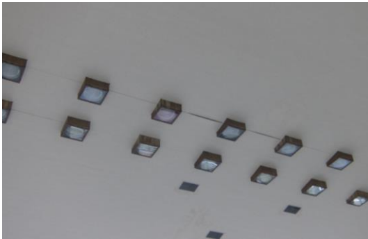
写真 5-25 経年劣化による天井面の隙間
