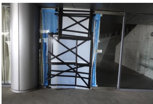
写真5-47 メインアリーナ入口ガラス扉のはずれた箇所（被害箇所はシートにより養生済み）
