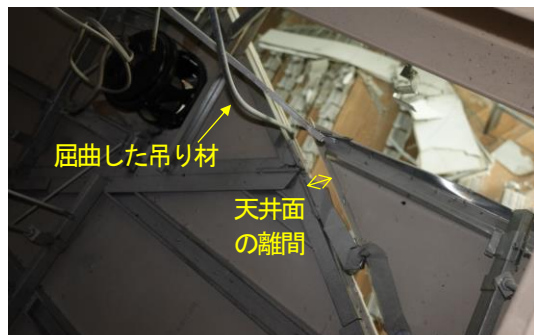
写真5-10 天井の勾配変化部付近を支持していた吊り材の屈曲、天井面の離間
