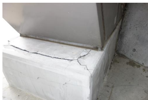
写真5-46 鉄骨柱部材と鉄筋コンクリート部材の接合部のコンクリートのひび割れ
