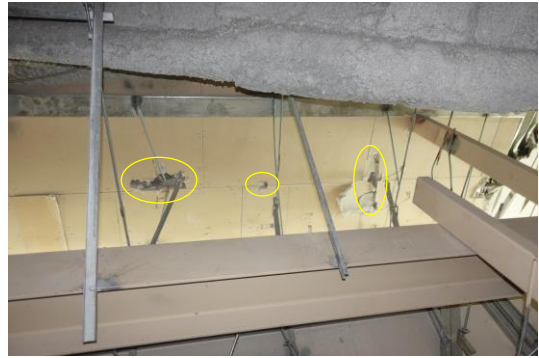
写真5-12 投影室側の壁の損傷状況
