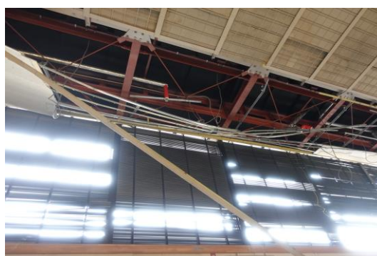
写真5-31 客席部分の天井の脱落
