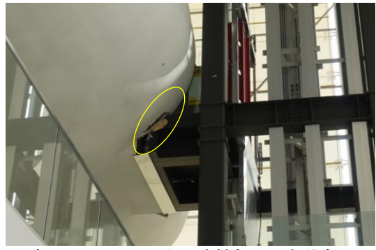
写真5-16 エレベータの支持部分と喫茶室の取り合い部分の損傷
