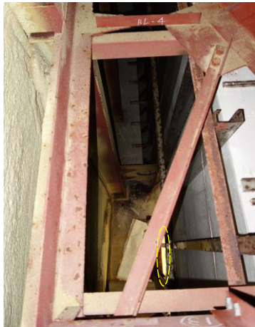
写真 5-23 内装ボード落下箇所における下地材上部周辺の状況 (丸が落下箇所)
