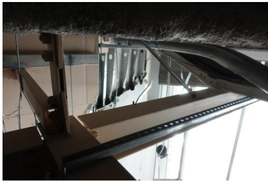
写真5-13 投影室側の壁の損傷状況
