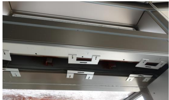
写真5-18 損傷したためカバー部材を取り外したエキスパンションジョイント部分
