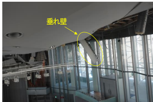
写真5-8 落下せず一部残った垂れ壁
