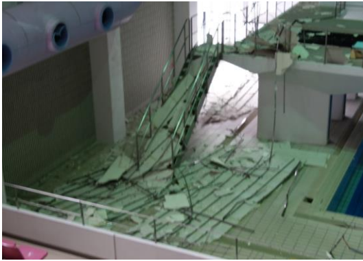
写真 5-53 飛び込みプール付近への天井材の飛散状況
