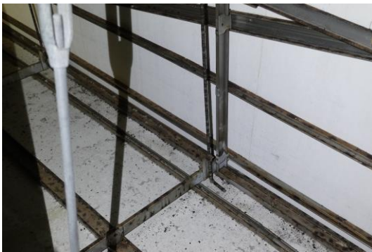
写真 5-55 脱落箇所付近の天井下地材の発錆状況
