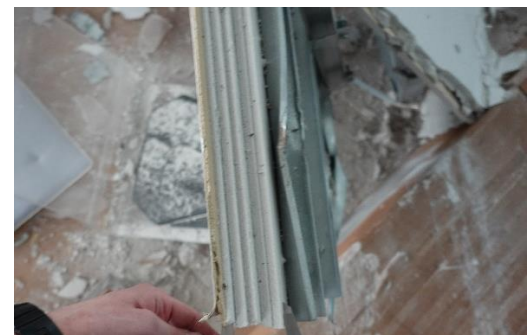
写真5-9 脱落した天井板 (せっこうボード5枚張り)
