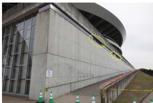
写真5-42 ガラス窓の破損
