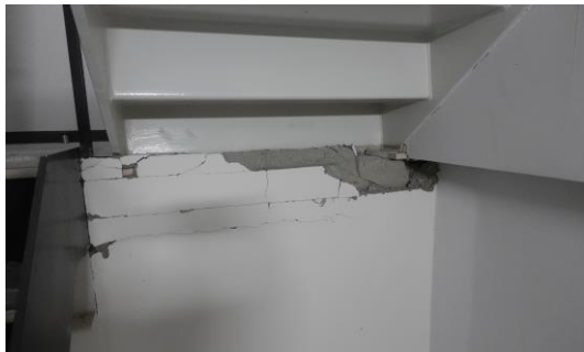
写真5-17 内部階段の損傷
