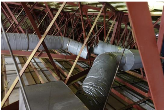
写真 5-27 ダクトの損傷
