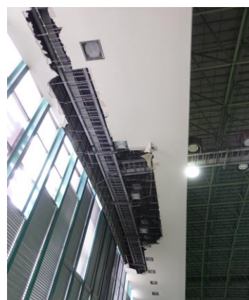
写真5-52 飛び込みプール上部の天井の脱落
