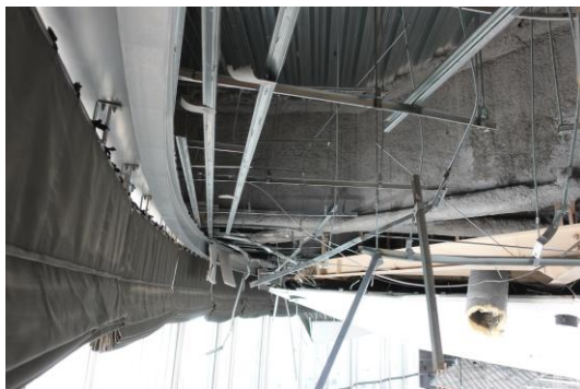
写真5-7 音楽ホール天井端部付近の損傷状況
