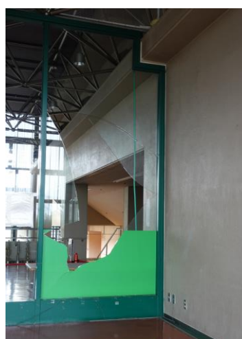
写真5-33 間仕切りのガラスの破損
