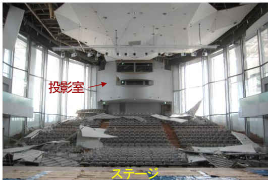
写真5-5 音楽ホールの被災状況 (天井脱落)
