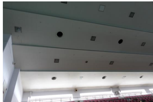
写真 5-56 客席部分の天井のたわみ、ずれ
