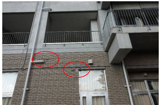
図 4.1.2 (l) タイルの剥落
