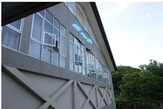
図 4.1.2 (v) 体育館外壁の損傷
