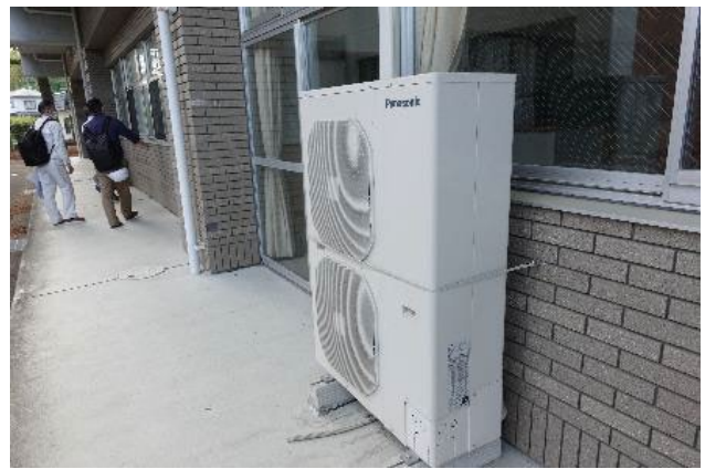
図 4.1.2 (j) 室外機の転倒防止金具
