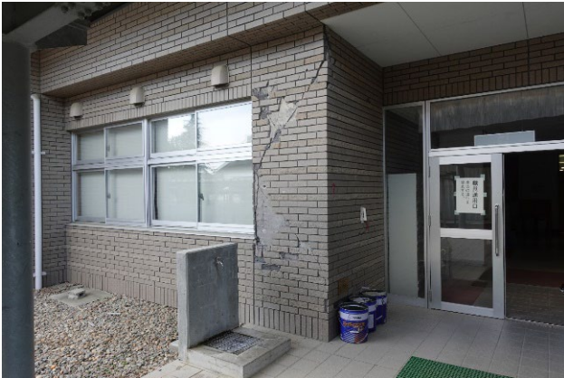
図 4.1.2 (d) 非構造壁せん断ひび割れとタイルの剥落
