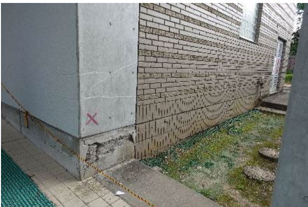
図 4.1.2 (h) 壁脚部コンクリートの圧壊
