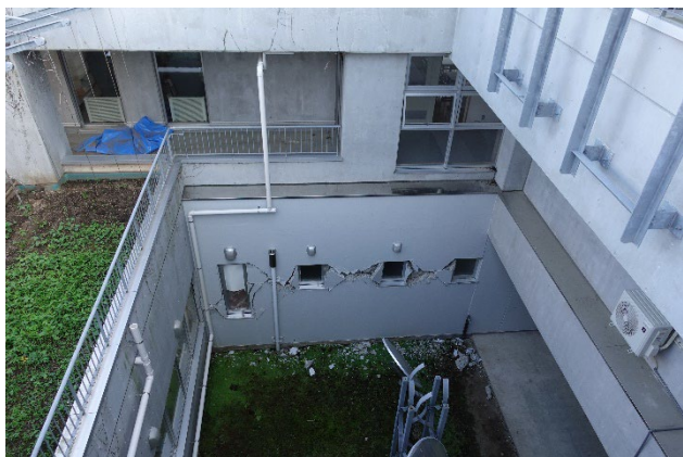
図 4.1.2 (a) 非構造壁のせん断破壊
