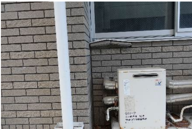
図 4.1.2 (k) タイルの浮き
