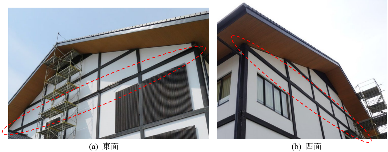
図 4.2.2 外観から見た被害状況
