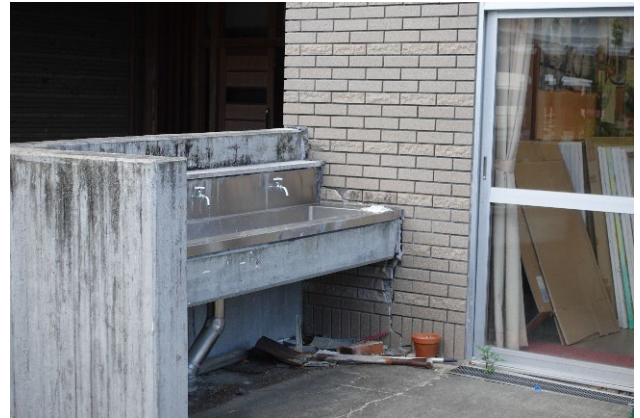
図 4.1.2 (e) 水飲み場と非構造壁の接続部のひび割れ
