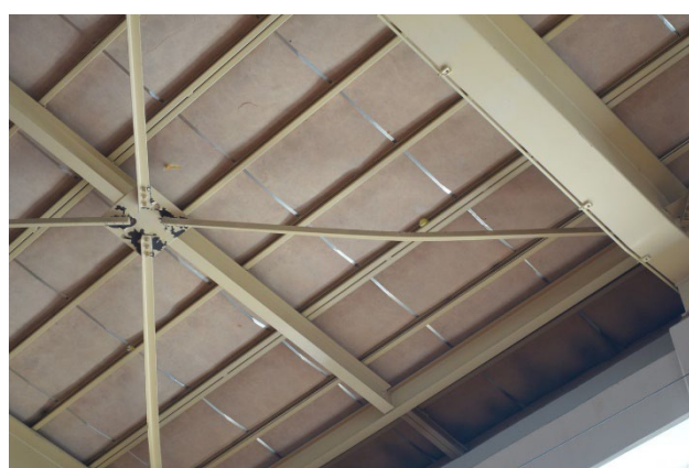
(b) ブレースの座屈と接合箇所における塗料の剥がれ
