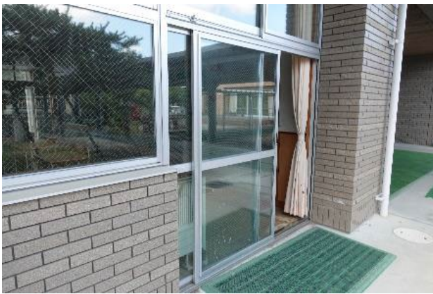
図 4.1.2 (i) 扉の鍵部の変形
