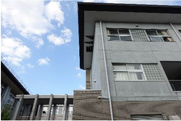
図 4.1.2 (m) 軒下板の落下
