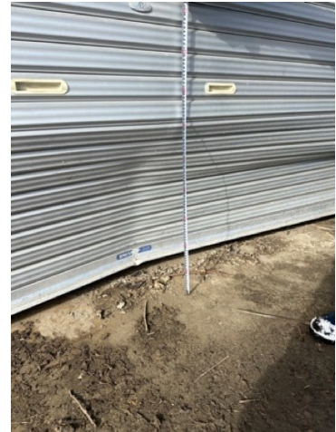
図 6.2.12 変形したシャッター
