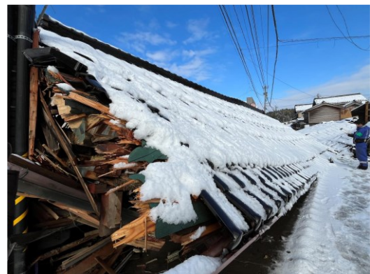
図 6.2.17 倒壊した建築物の瓦屋根
