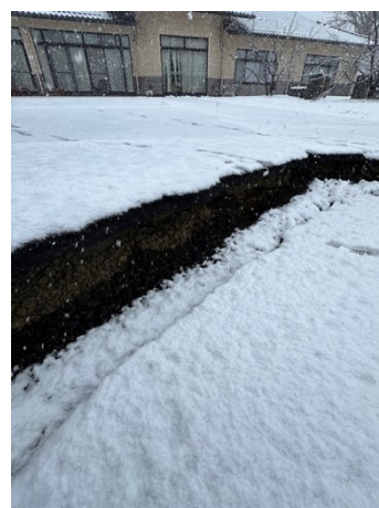
図 5.4.3 正院公民館付近の地割れ
