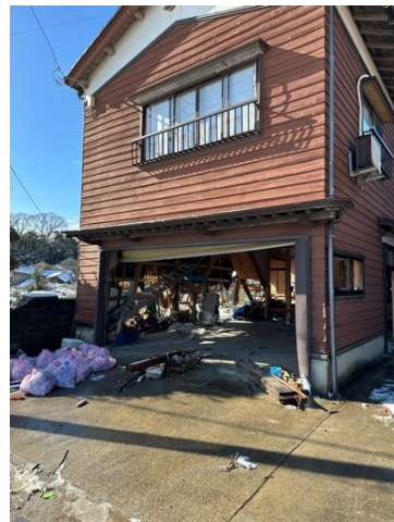
図 6.3.3 津波による開口部の損傷
