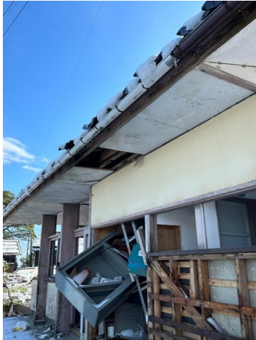
図 6.3.12 軒天井の損傷
