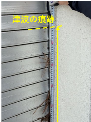
図 6.1.1 シャッターに付着した痕跡の高さ
