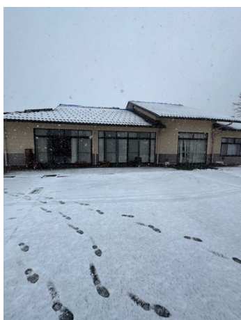
図 5.4.1 正院公民館の被害状況
