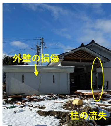
図 6.3.6 外壁の損傷と隅柱の流失
