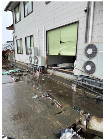
図 5.2.2 木造建築物の被害
