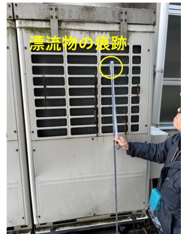
図 6.1.3 室外機に付着した漂流物の痕跡
