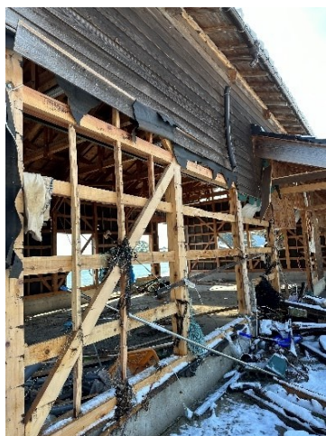
図 6.3.5 陸側の外壁の損傷
