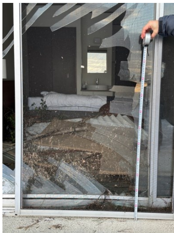
図 6.1.4 痕跡高さとガラスの被害
