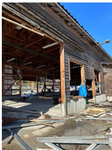
図 6.3.4 海側の開口部の損傷
