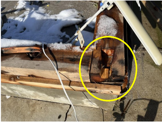
図 6.3.10 流失した住宅の土台の状況(1)
