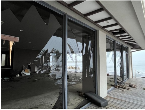
図 5.1.3 1階の窓ガラスの損傷(2)
