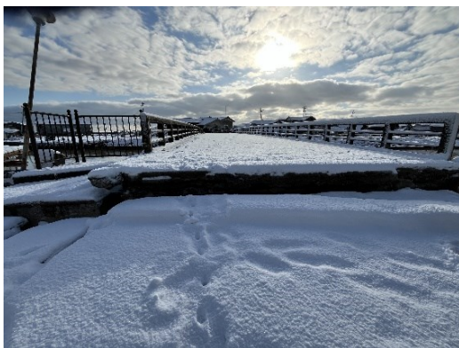
図 6.2.16 橋と道路との間の段差
