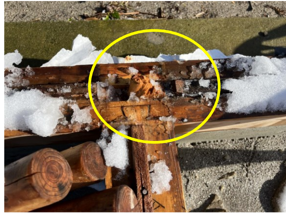
図 6.3.11 流失した住宅の土台の状況(2)
