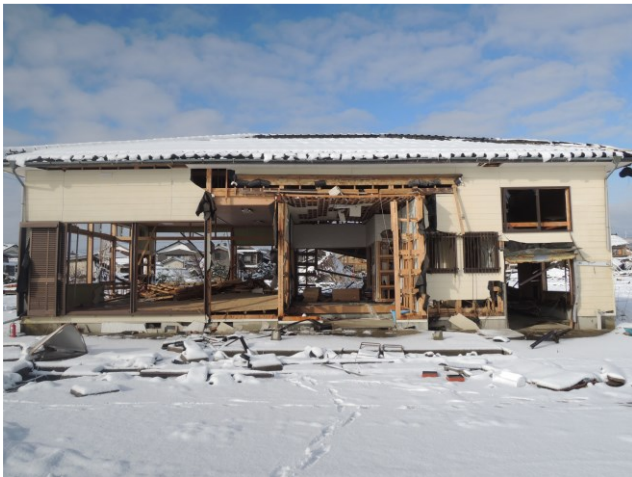
図 6.2.8 津波による前面の被害
