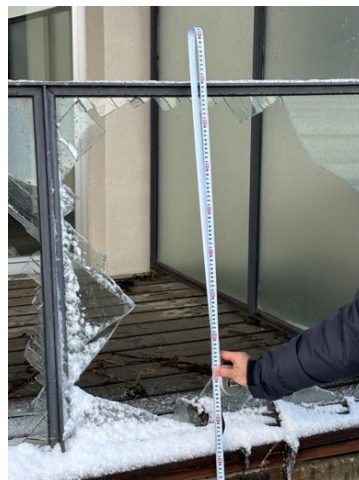
図 6.1.5 損傷したガラスの高さ
