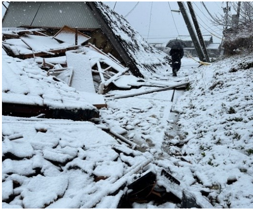
図 5.4.6 周辺の建築物の被害状況
