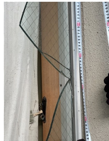
図 6.1.6 損傷した窓ガラスの高さ
