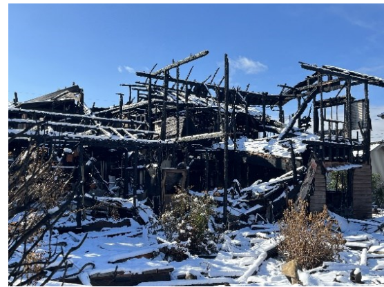
図 6.3.16 火災被害状況(2)
