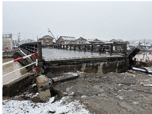
図 5.2.5 橋と道路との間の段差
