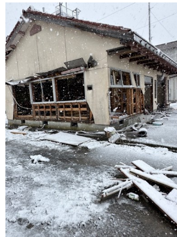
図 5.3.5 側面及び陸側の壁の損傷
