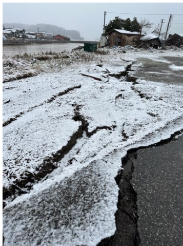
図 5.2.7 大規模な地割れ
