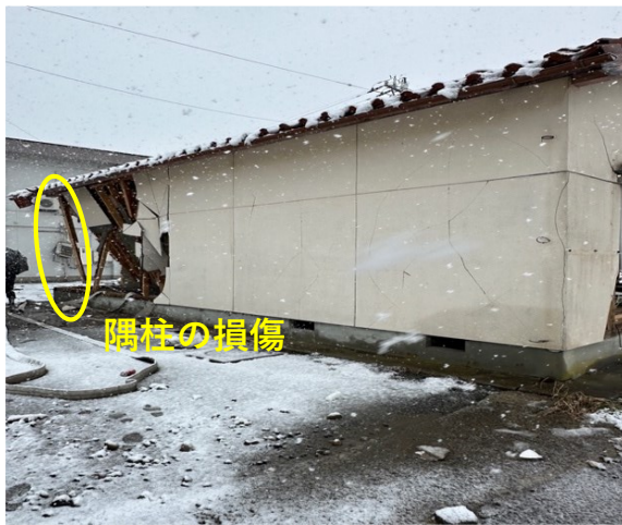
図 5.3.4 津波の正圧による損傷
