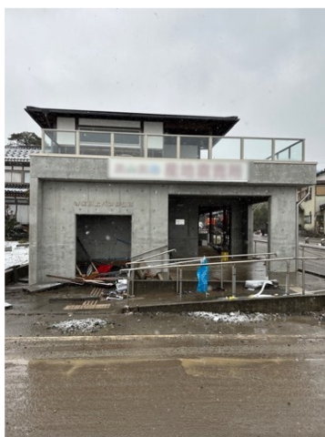
図 5.5.5 RC 造の建築物の被害状況(1)
