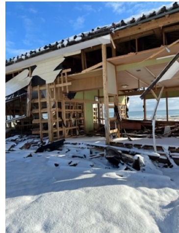
図 6.2.9 津波による背面の被害
